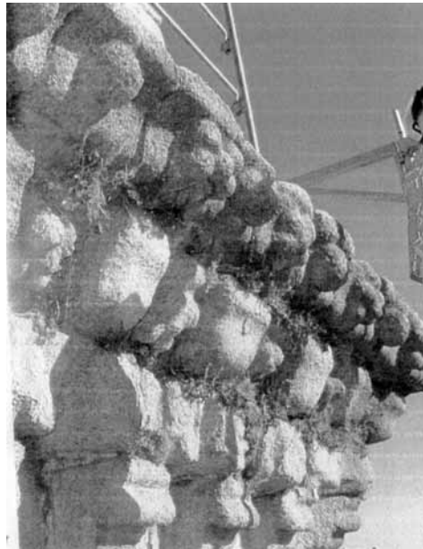
Cornisa O, mortero de juntas deteriorado y acumulación de plantas.
