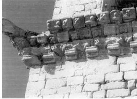
Detalle de la cornisa E, antes de la restauración.
