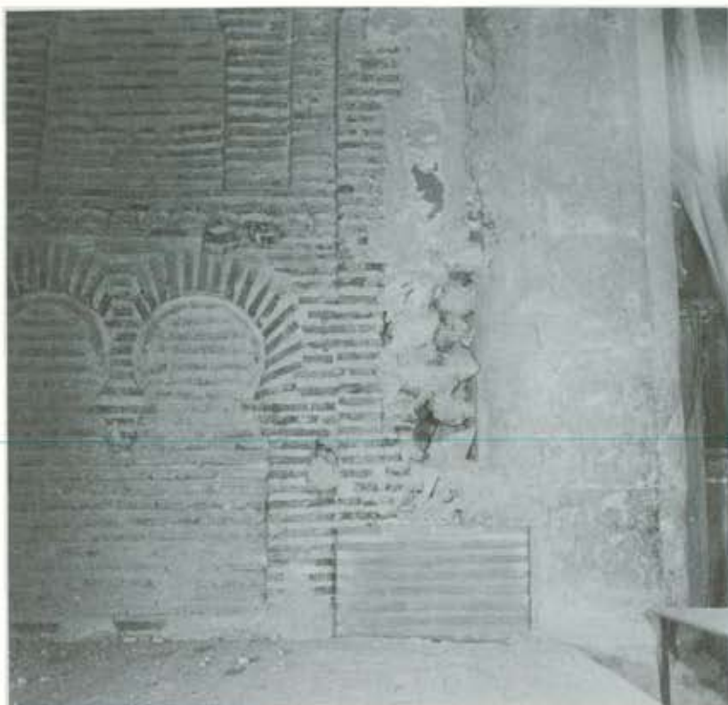
1. Detalle del suelo de tarima que cubría el tramo recto, en el comienzo de las obras de restauración.
