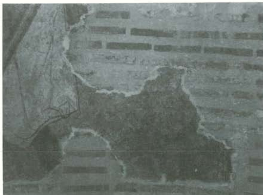
(Lám. 34). Otro aspecto del muro reconstruido siguiendo la estructura original. Se observa la diferencia entre ladrillos antiguos y nuevos.
