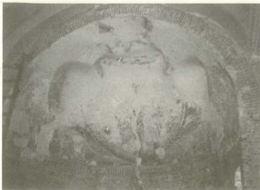
(Lám. 19). En ésta vista general se observa la grieta que recorría el ábside transversalmente.
