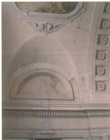
Detalle de las humedades y grietas en el arranque de la bóveda
