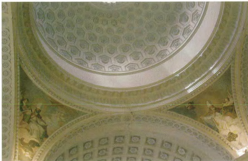
Detalle de las grietas de la cúpula en su unión con la bóveda de la nave central
