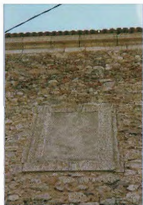
Hueco cegado en el lado norte de la Capilla del Rosario
