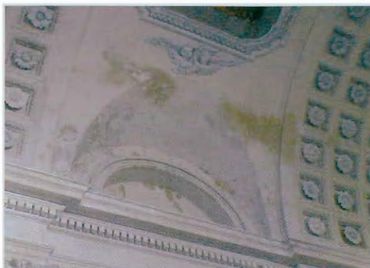
Detalle de una humedad por filtración localizada en la bóveda central
