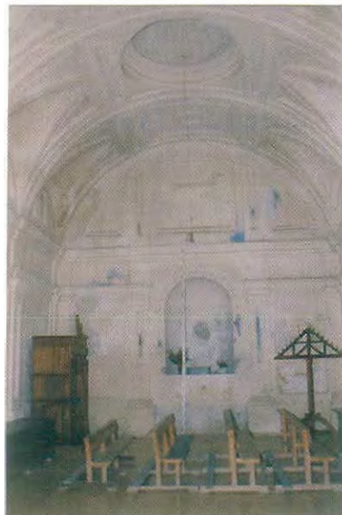
Detalle de grietas y humedades en el interior de la capilla
