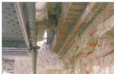
Estado previo. Alero inexistente
