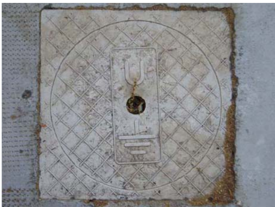
Figura 15. Toma de tierra.
