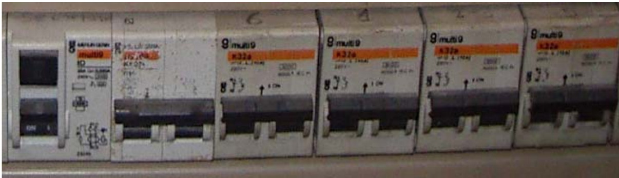
Figura 10. Pequeños interruptores automáticos (PIAs).
