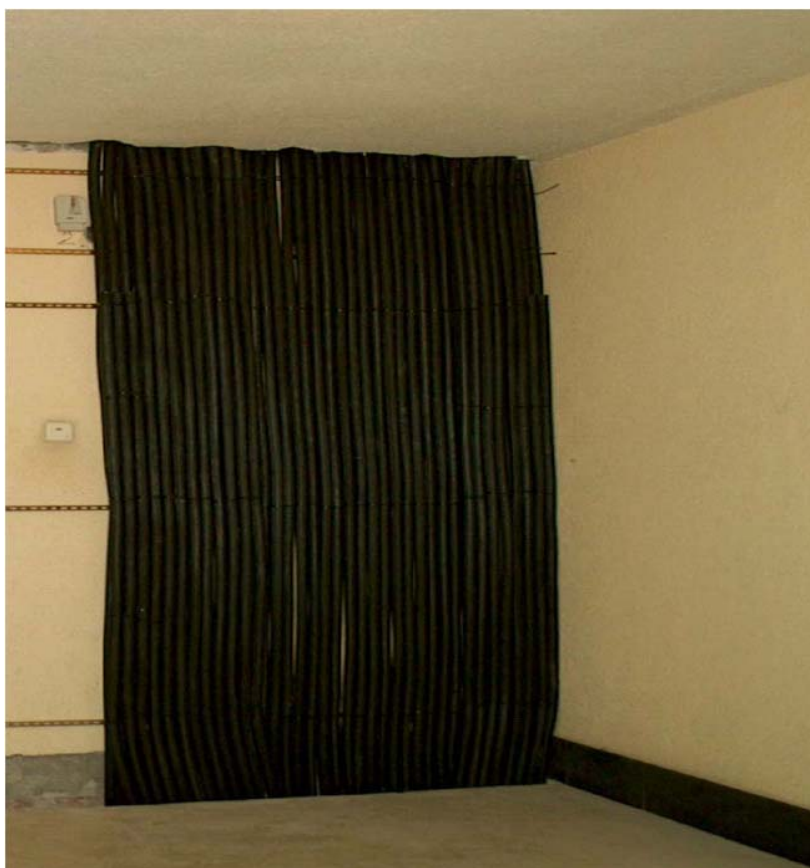
Figura 8. Canalizaciones de derivaciones individuales.
