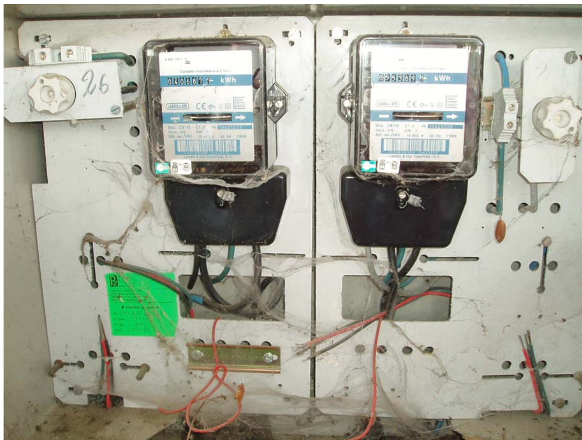
Figura 7. Detalle de contadores de inducción.
