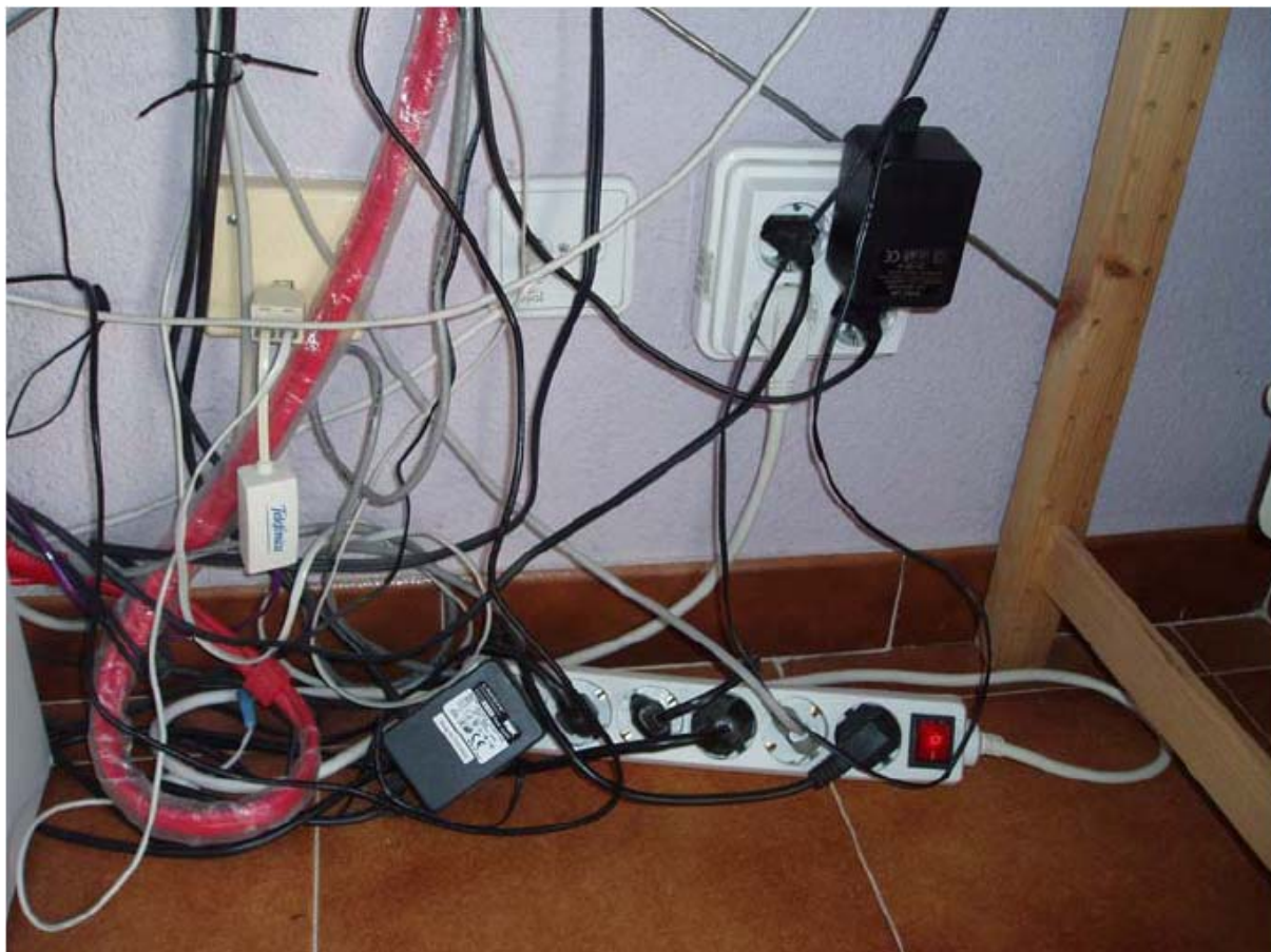
Figura 16. Incorrectas conexiones en enchufes múltiples.
