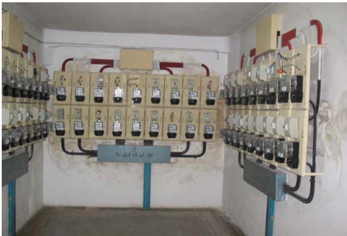
Figura 5. Centralización de contadores.
