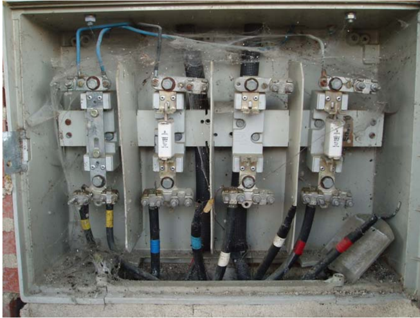
Figura 3. Caja general de protección.
