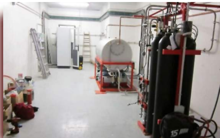
▲ Instalaciones de Protección Contra Incendios (P.C.I.) a nivel de andén.
