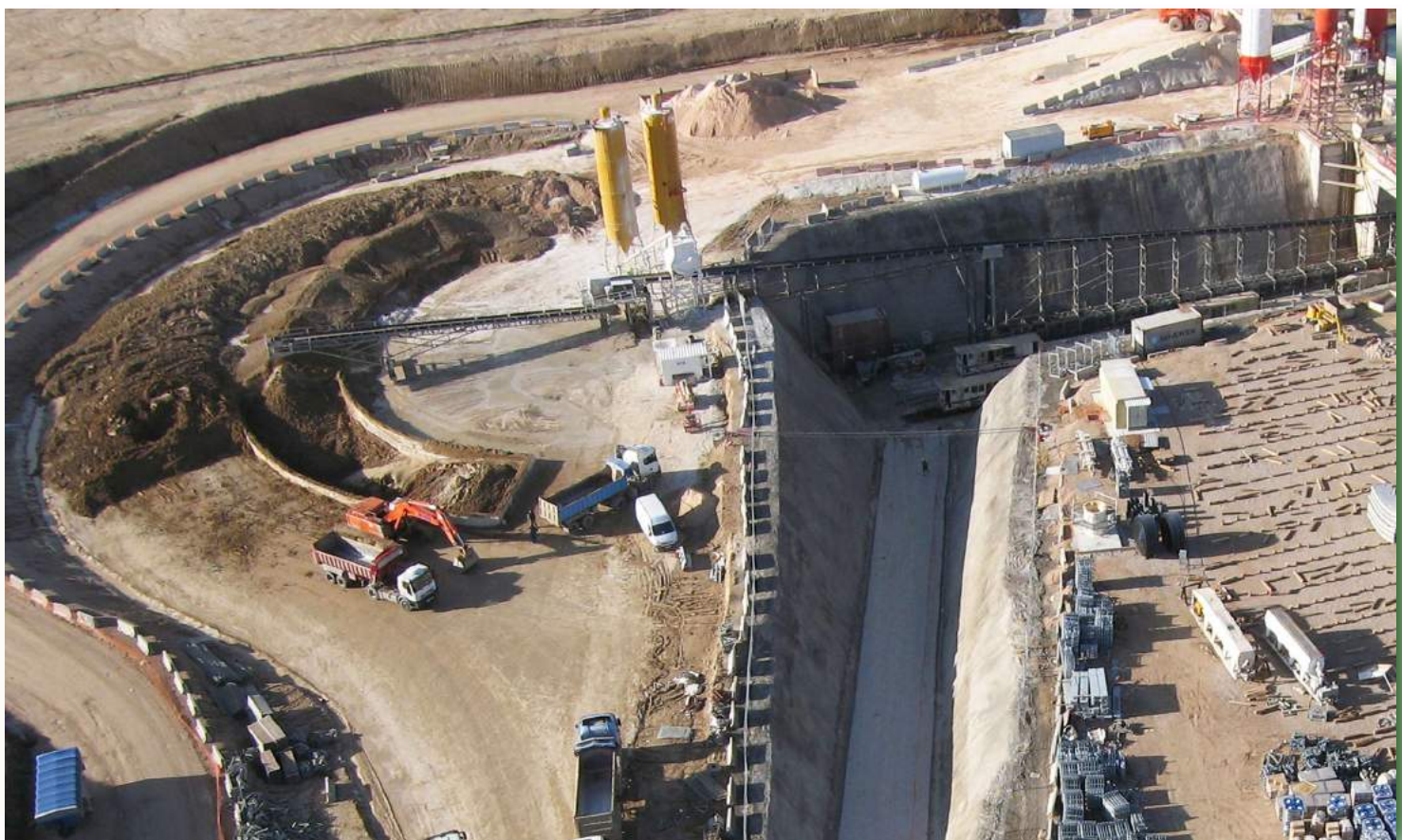
▲ Vista aérea de las instalaciones del tratamiento con cal.
