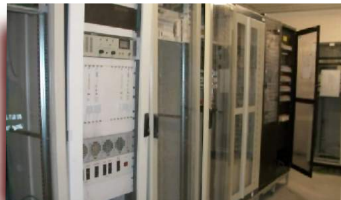
▲ Cuarto de comunicaciones.
