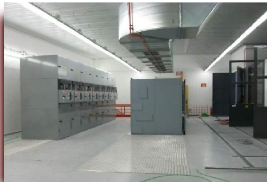
▲ Subestación Eléctrica de Tracción.
