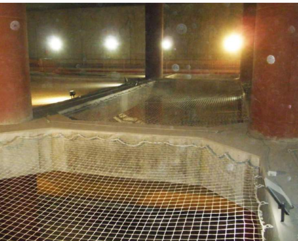
▲ Protecciones colectivas en estaciones: Redes horizontales en huecos, líneas de vida en estampidores.
