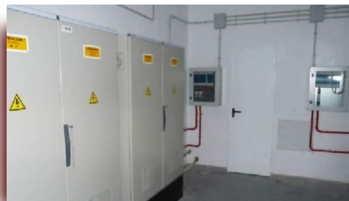
▲ Cuarto para los cuadros de control de las escaleras.
