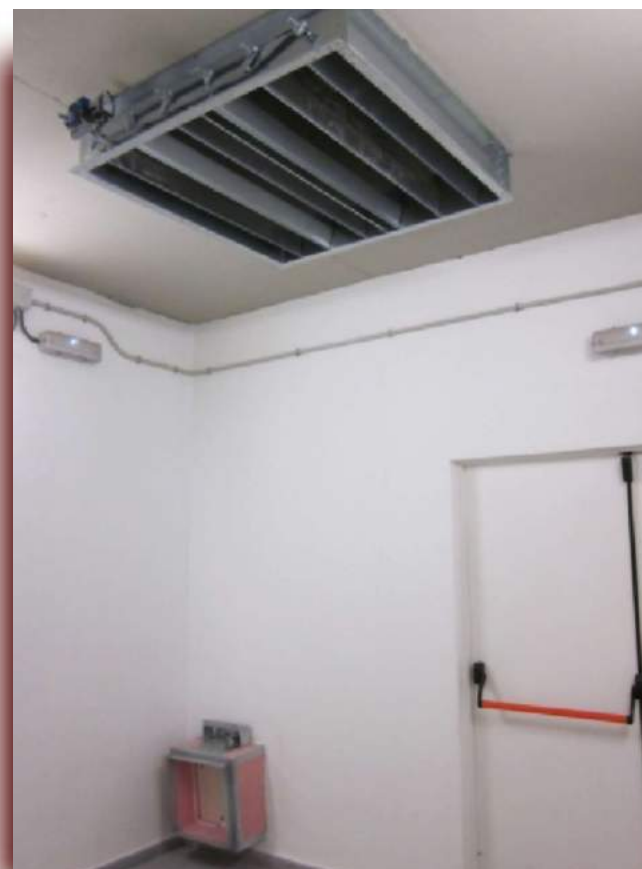
▲ Elementos de impulsión y regulación para presurizar el vestíbulo de independencia en las salidas de emergencia.
