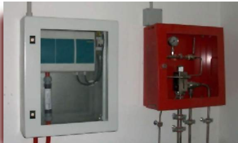
▲ Unidad de Detección VESDA y Válvula de Extinción.
