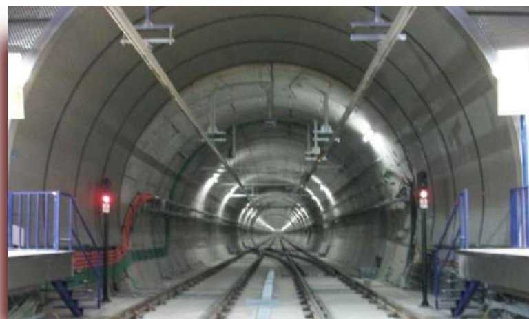
▲ Catenaria y Señalización en túnel.
