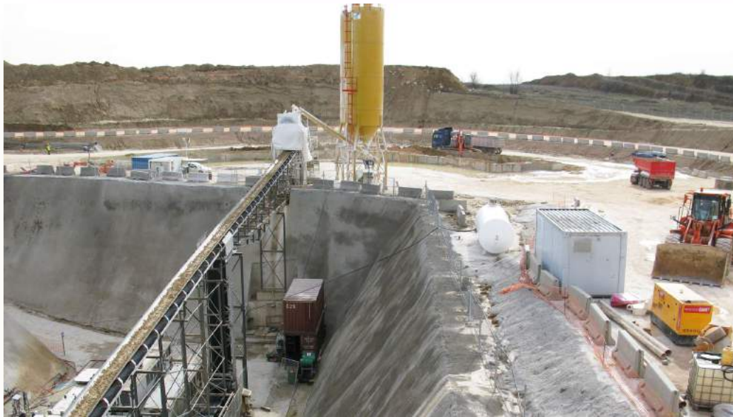
▲ Instalaciones del tratamiento con cal.
