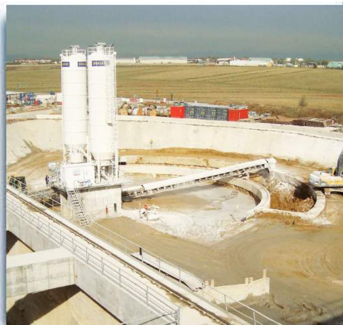
▲ Planta de tratamiento con cal.
