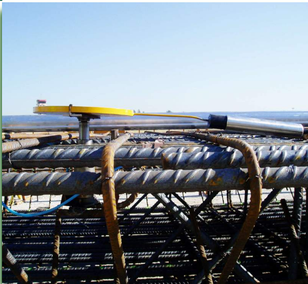
◀ Célula de presión en armadura de pantalla.
