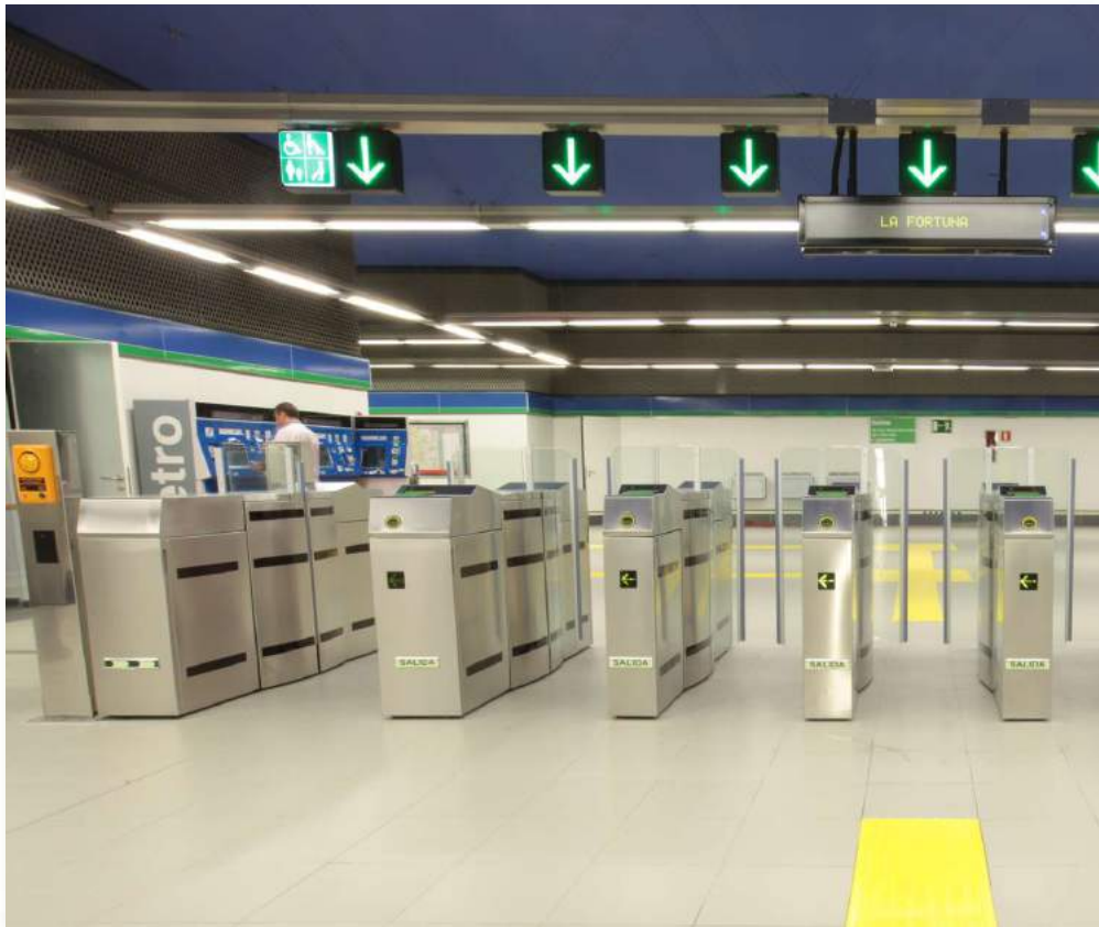
▲ Batería de equipos de peaje en vestíbulo.
