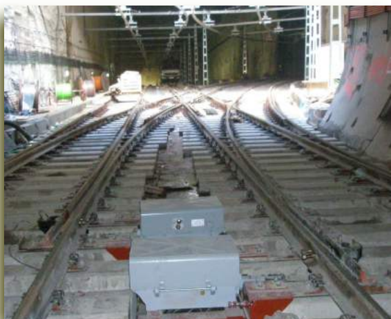
Motores de accionamiento del desvío hacia el ramal. ◀
