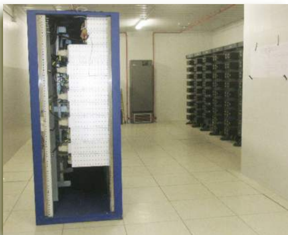
Vista del cuarto de Enclavamiento. ◀
