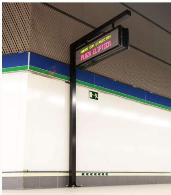
▲ Señalización fotoluminiscente en estación.
