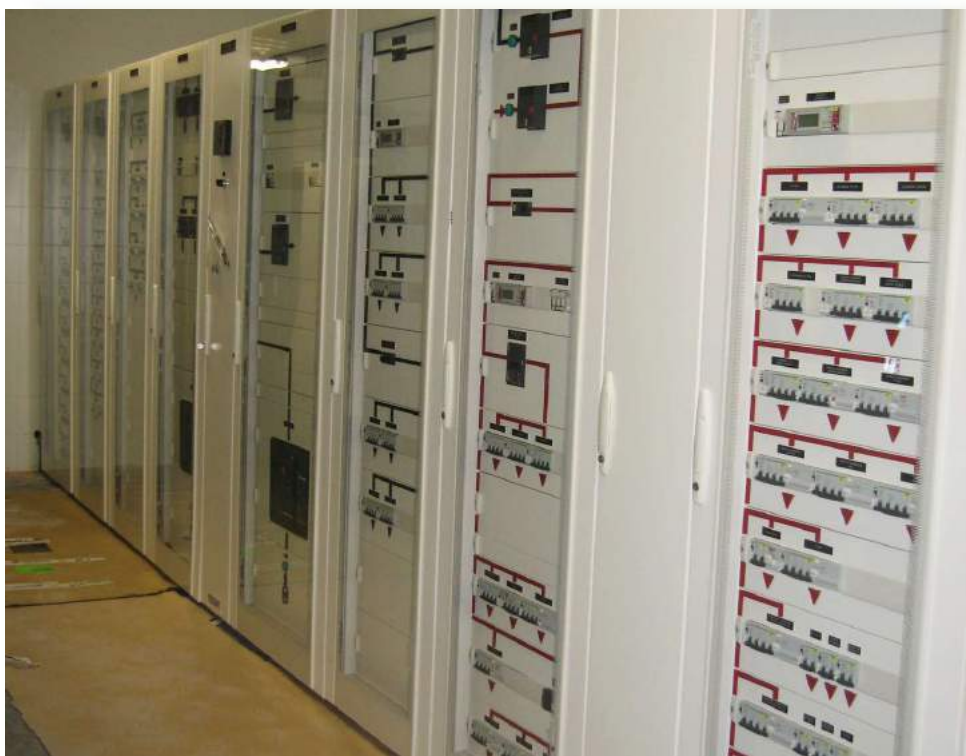
▲ Cuadro General de Baja Tensión.
