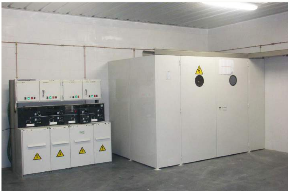
▲ Equipos de C.T.
