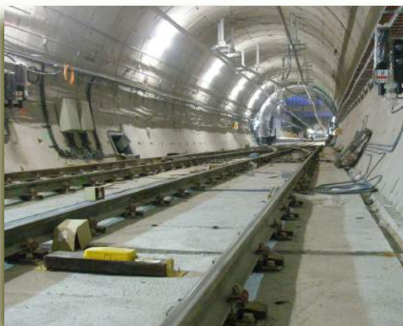
Dispositivos de Señalización en túnel (señales verticales, balizas de posicionamiento del tren, armarios de señalización, etc.). ◀
