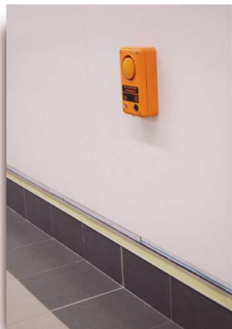
▲ Interfono ubicado a altura accesible para personas usuarias de silla de ruedas.
