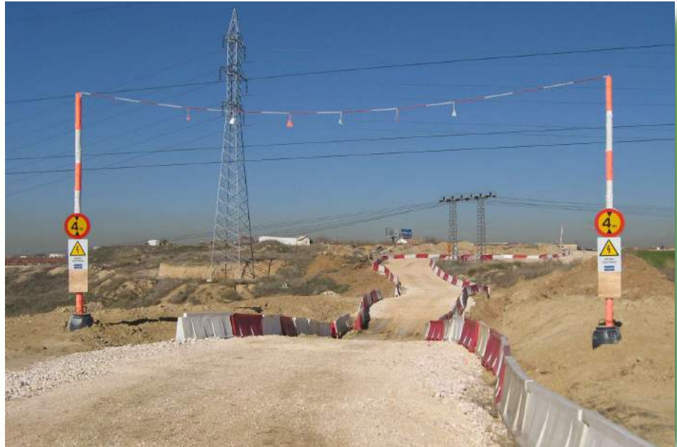
▲ Pórtico de gálibo con señalización de riesgo eléctrico y limitación de altura en cruce de caminos de obras bajo líneas eléctricas aéreas.
