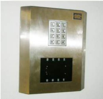
▲ Elementos del sistema de control de la estación y del control de accesos.
