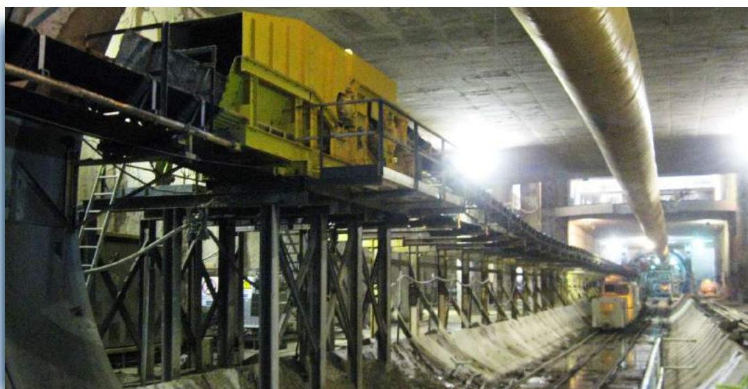
Cinta de extracción de material y booster en estación. ◀
