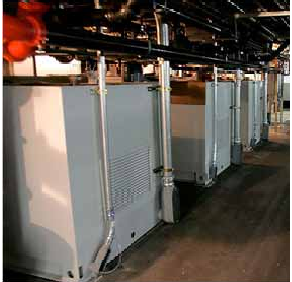
Foto A1.9. Grupos de cogeneración (Fuente: Earthfirst).
