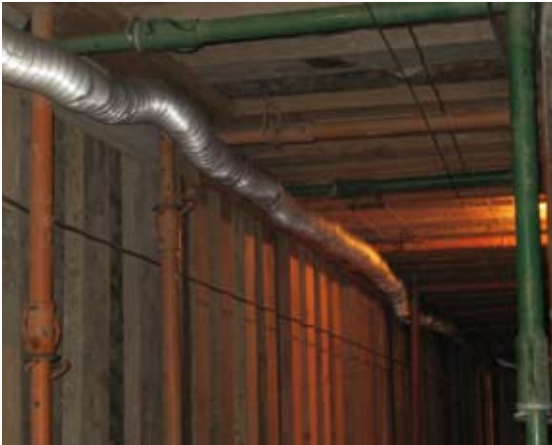
Ejecución de pozo que requiere la aplicación de ventilación forzada por impulsión de aire.
