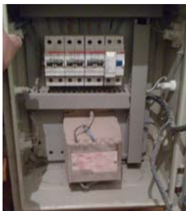
Conjunto de obra básico en el que se ha dispuesto un transformador para la alimentación de un circuito a muy baja tensión de seguridad (24 V).
