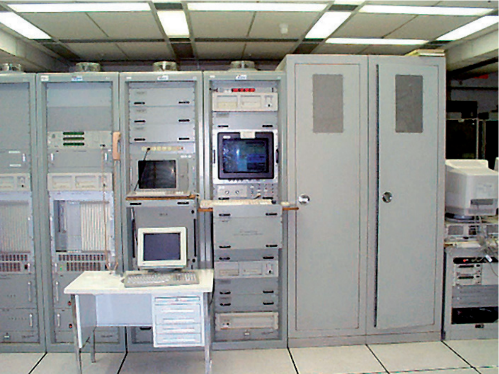
Fig. 13. Sala de decodificación. Fig. 13. Decoding room.
