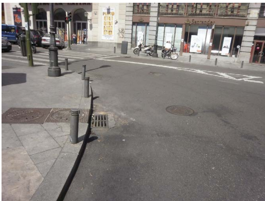
Fotografía 3. Vista general de cruce en zona de ubicación de caudalímetro. Estado de pavimento y tipología de bordillo y pavimento de acera de losa de granito..
