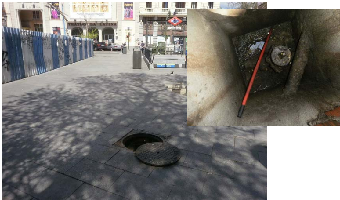
Fotografía 5. Vista general de ubicación e interior de pozo de registro en acera de válvula VA.54IJ-555.
