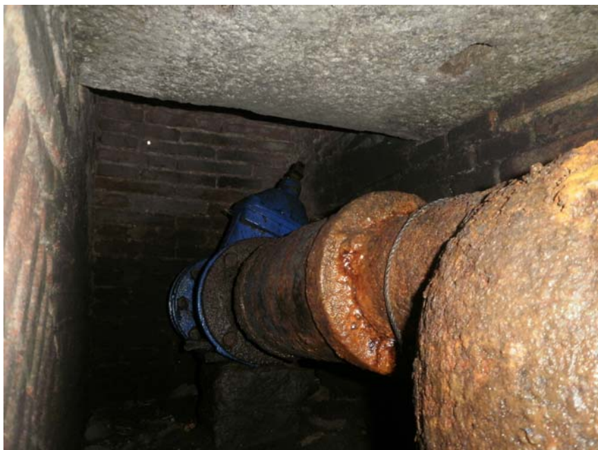
Fotografía 07. Punto de conexión en Galería de Calle Merques de Riscal. Válvula VA.54GK-1172
