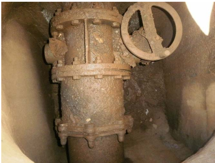
Fotografía 1. Vista interior de pozo de registro de válvula VD.54IJ-395.
