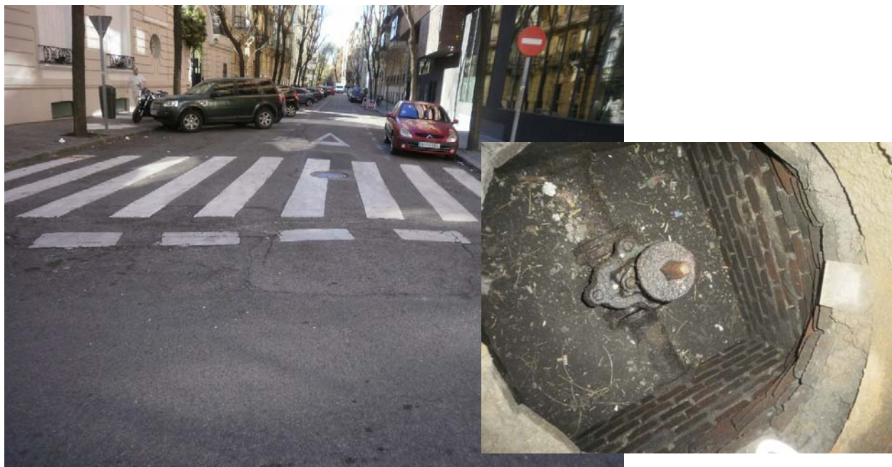
Fotografía 05. Vista general de cruce de C/ Jenner y C/ del Monte Esquinza. Marcas viales e interior de pozo de registro de válvula VA.54GK-888
