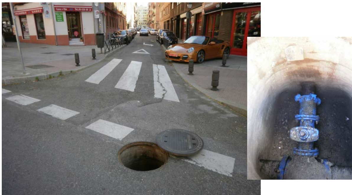
Fotografía 05. Vista general e interior de punto de conexión de válvula VA.54JJ-1453, a cambiar, ya que esa válvula ha de ser de Ø 300.
