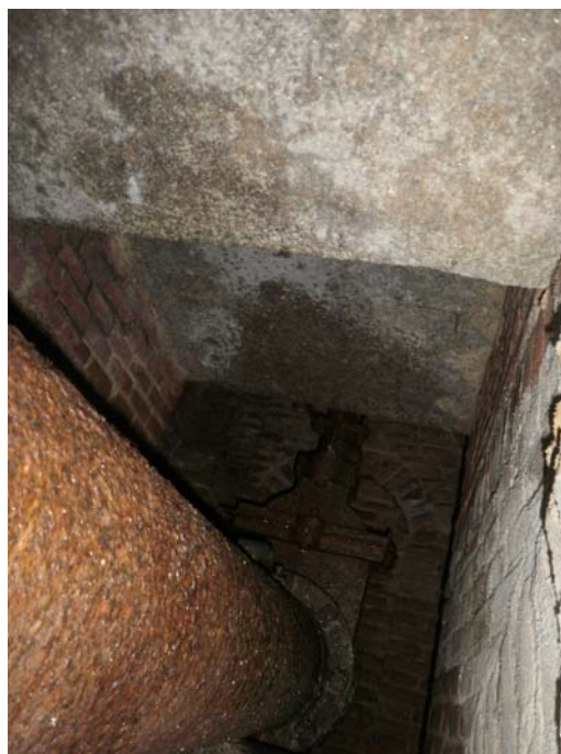
Fotografía 05. Vista interior de galería. Cobijas de granito y válvula en desuso en la conducción de Ø300.
