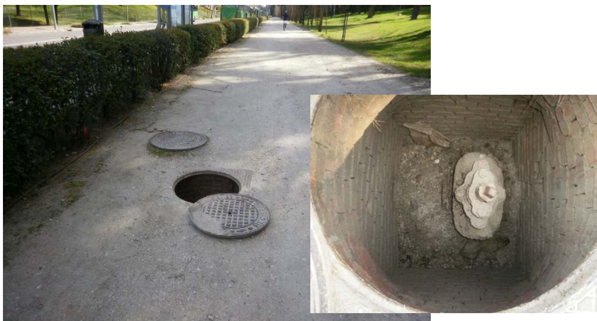
Fotografía 6. Vista general e interior de pozo de registro de válvula VA.54GH-50.
