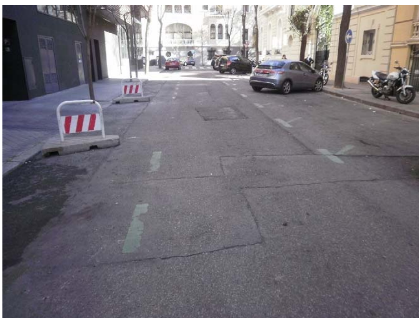
Fotografía 04. Vista general del estado del pavimento en la C/ Monte Esquinza, desde nº 44 hacia número ascendente.
