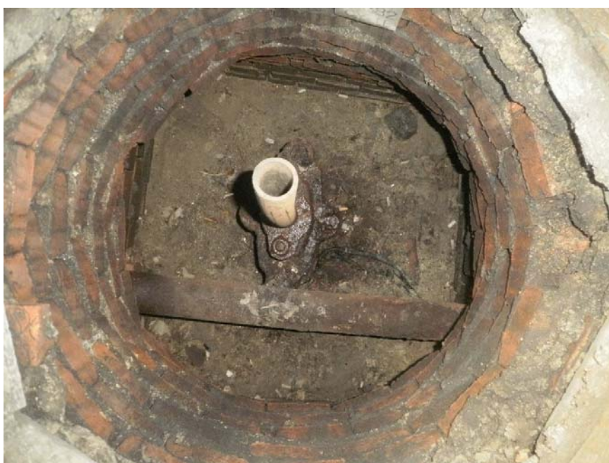
Fotografía 02. Vista interior de pozo de registro de válvula VA.54GK-1135.
