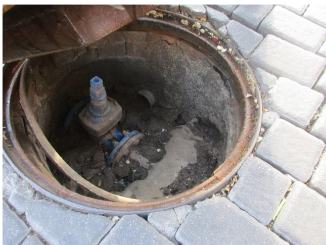
Fotografía 45: Válvula existente a la altura del nº 40 de la Avenida del Ejército
