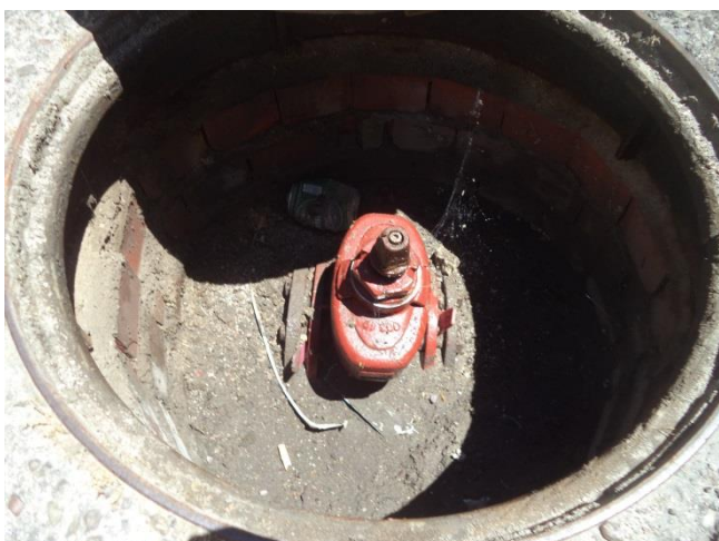
Fotografía 39: Válvula VA.65DE-274 a la altura del nº 7 de la calle Comuneros de Castilla
