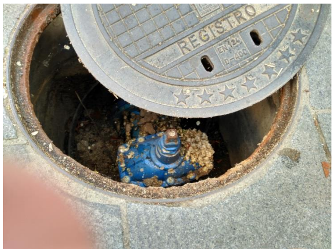
Fotografía 54: Válvula VA.65DE-459 en el cruce de la calle Virgen del Rosario y Paseo de la Misericordia
