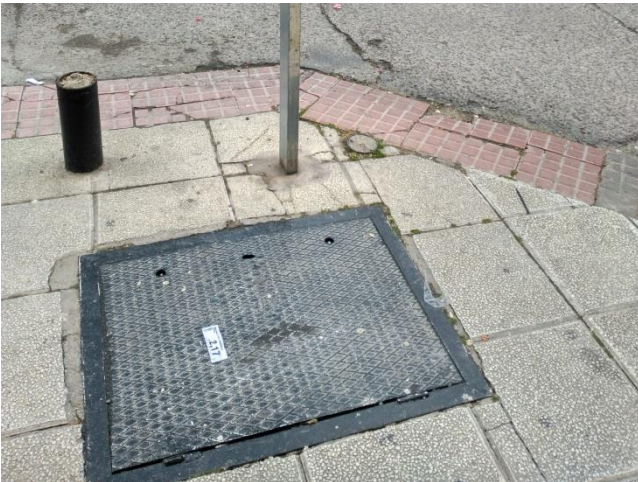
Fotografía 51: Arqueta de Gas en la esquina de las calles Virgen del Rosario y Virgen del Pilar
