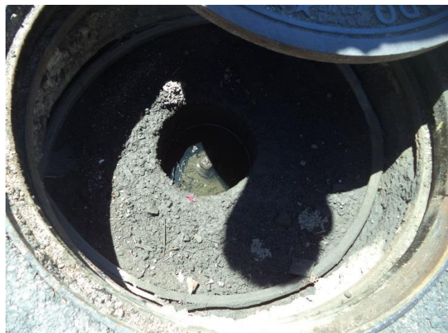
Fotografía 12: Válvula VA.65DF-2 a la altura del nº 36 de la calle Miguel de Unamuno
