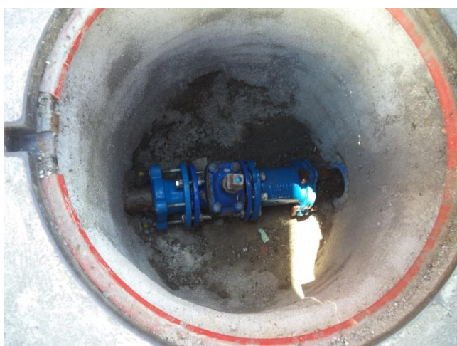
Fotografía 29: Válvula VA.65DF-14 en el cruce de las calles Lope de Vega y Ronda del Olivar
