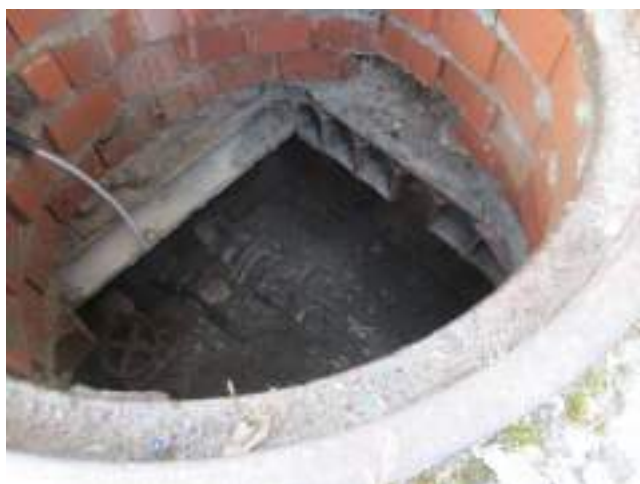
Fotografía 28: Válvula localizada al inicio de las calle las Viñas
