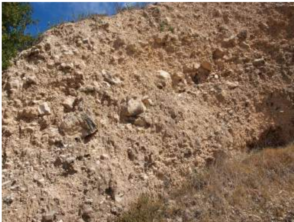
Fotografía 1. Material observado en un talud excavado.
