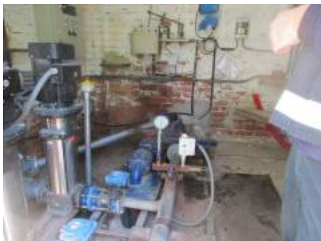
Fotografía 1: Interior de la Estación Elevadora de Villar del Olmo
