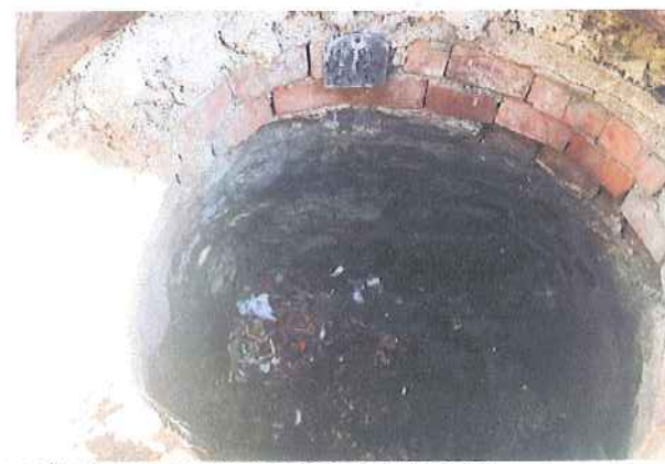
78 VÁLVULA EN CALLE DE LOS MONTES DE TOLEDO
