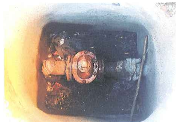
42 VALVULA EN CALLE DEL PUERTO DE LAS PILAS
