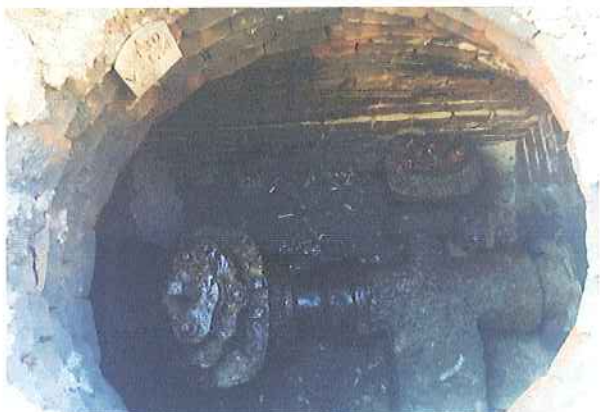
43 VÁLVULA Y DESAGÜE EN CALLE DE SIERRA VIEJA
