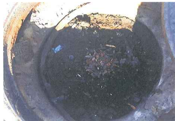
82 VÁLVULA EN CALLE REAL DE ARGANDA
