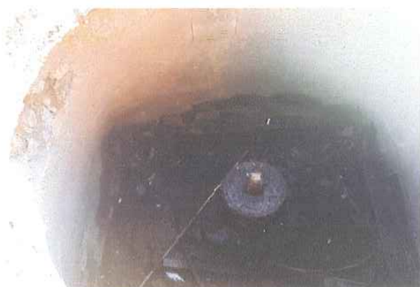
47 VÁLVULA EN CALLE DEL MONTE AYA
