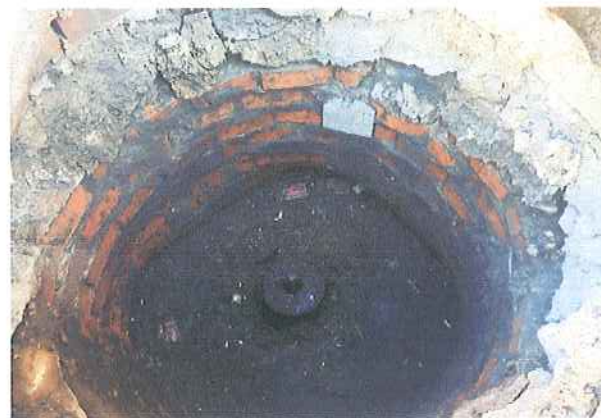
70 VÁLVULA EN CALLE DE PICO MAMPODRE
