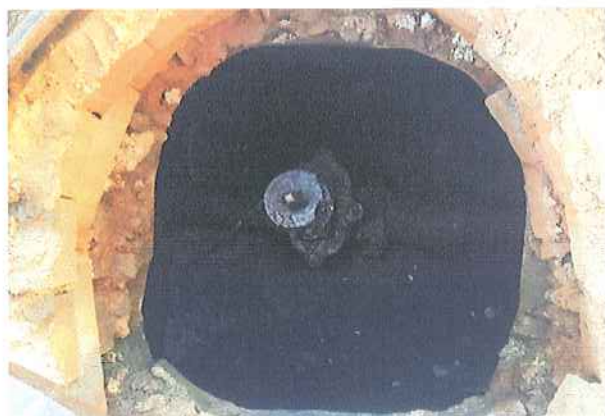
63 VÁLVULA EN CALLE DE PICO MAMPODRE
