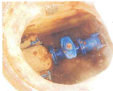
28 VÁLVULA CALLE DEL SOLANILLO
