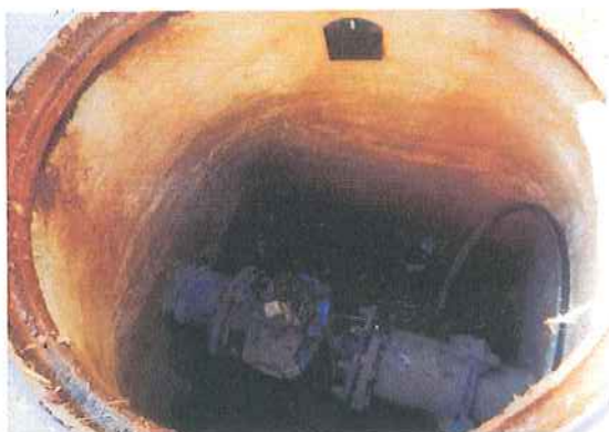
27 VÁLVULA CALLE DE JUAN PEDRA
