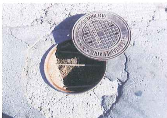
14 VÁLVULA CALLE DE SAN ANTONIO
