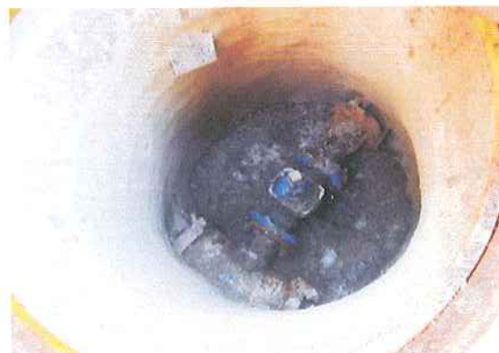
4 VÁLVULA CALLE DEL DEPÓSITO
