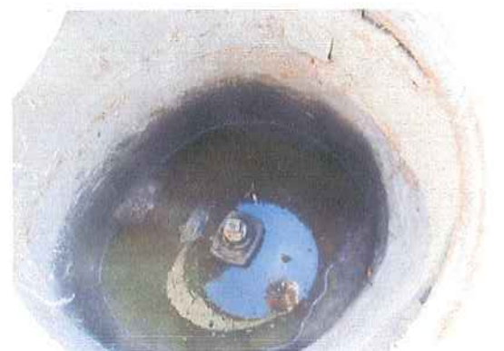
17 VÁLVULA AVENIDA DE MADRID
