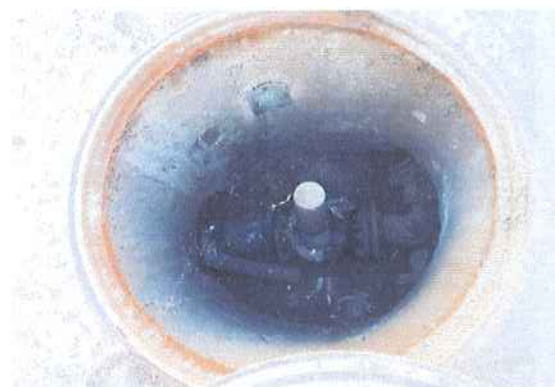
15 VÁLVULA CALLE DE SAN ANTONIO
