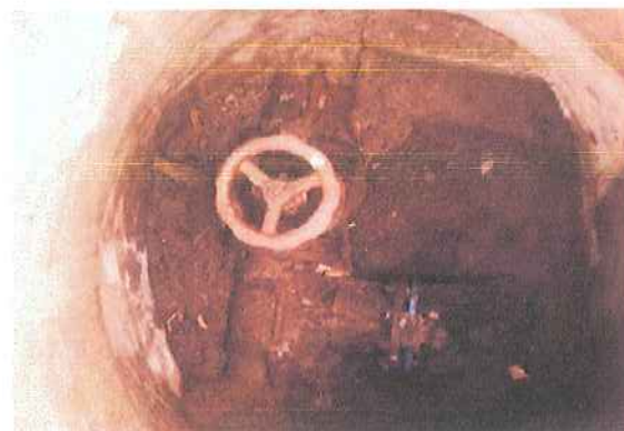
11 VÁLVULA AVENIDA DE LA CONSTITUCIÓN
