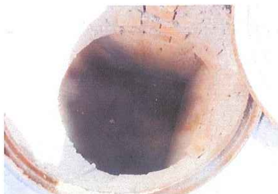
3 VÁLVULA AVENIDA DE LA CONSTITUCIÓN
