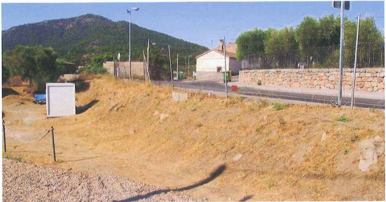
F.6. Vista del trazado por la carretera de Cenicientos. Talud con suelos arenosos y bolos y bloques de roca, que en buena parte parecen rellenos.
