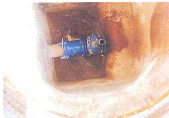
28 VÁLVULA CARRETERA DE ROZAS
