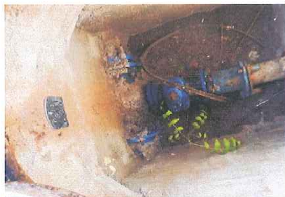
20 VÁLVULA CALLE DEL MANZANO
