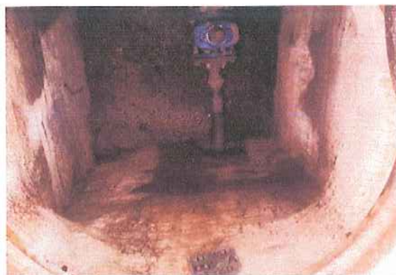
39 VÁLVULA CALLE DE GUATEMALA
