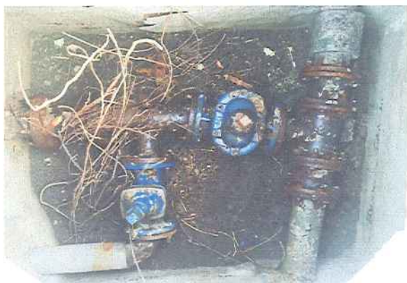
9 VÁLVULA Y DESAGÜE CALLE FRANCISCO PACHECO
