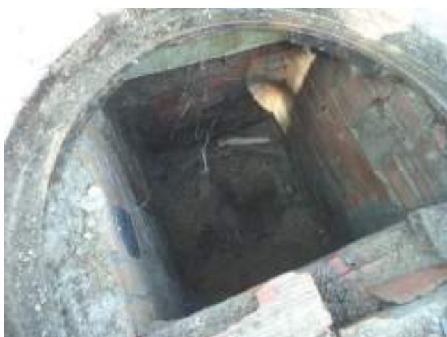
Fotografía 5: Válvula VA.34GF-64 en el cruce de las calles Paseo de Monte Real y Monte Cervino.
