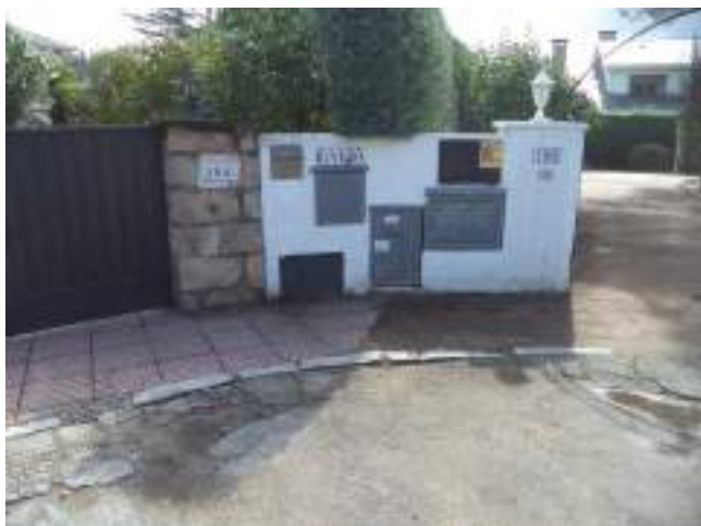
Fotografía 81: Armario de registro de contador en el nº 7 de la calle Salamanca.
