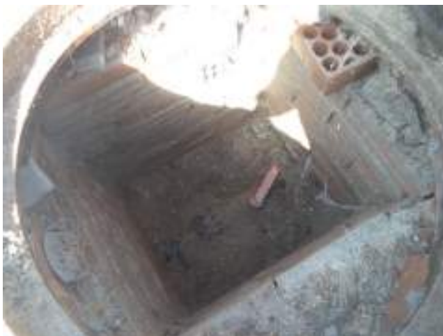
Fotografía 10: Válvula VA.34GF-65 en el cruce de las calles Paseo de Monte Real y del Monte Zamorano.
