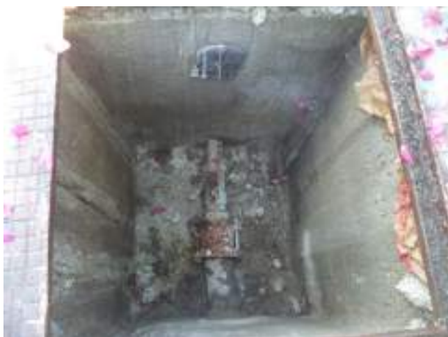
Fotografía 45: Válvula VA.34GF-23 en el cruce de la calle de Málaga y la Avenida Soto.
