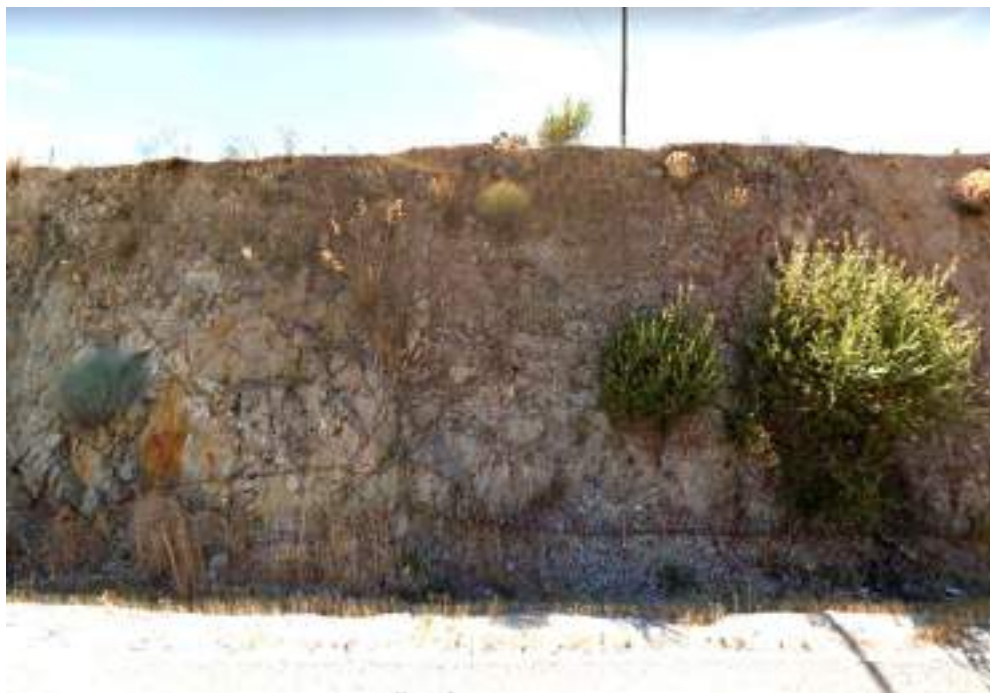
Fotografía 2. Material observado en talud de la carretera M-608
