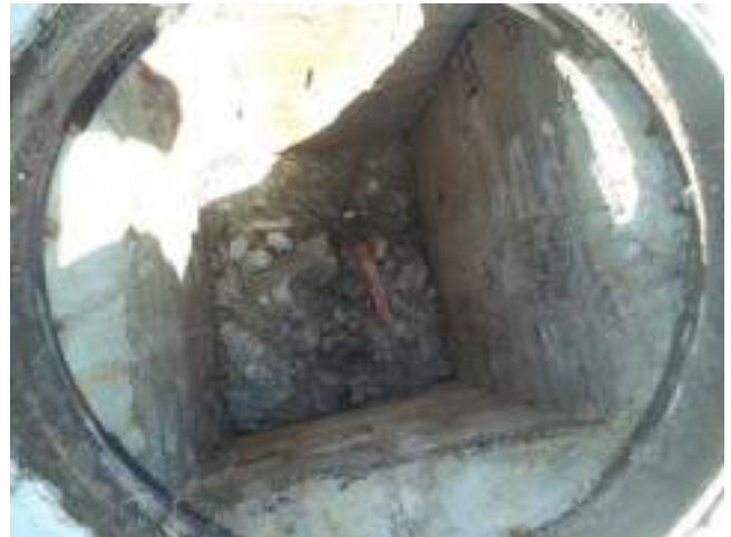
Fotografía 28: Válvula VA.34GF-74 en el cruce de las calles Paseo de Monte Real y Monte Picayo.
