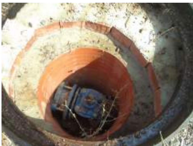
Fotografía 77: Válvula VA.34HF-38 a la altura del nº 47 de la Avenida Bertolez.
