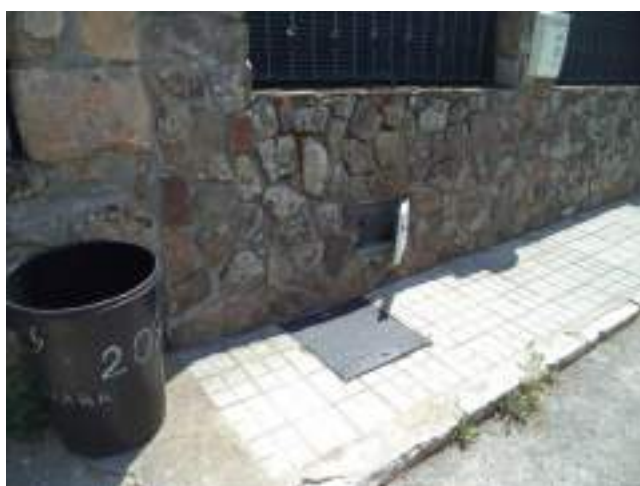
Fotografía 42: Armario de contador del nº 6 de la calle Guadalajara.
