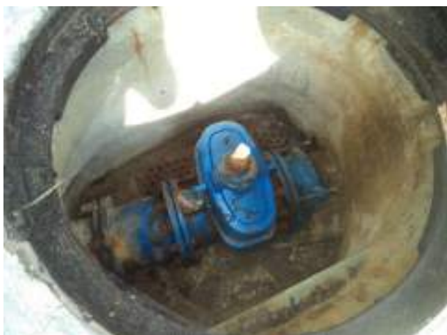
Fotografía 83: Válvula VA.34HF-54 a la altura del nº 49 de la Avenida Madrid.
