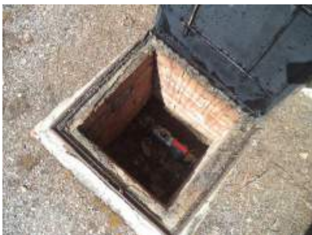
Fotografía 63: Válvula VA.34GF-22 en el cruce de la calle Murcia y la Avenida Soto.
