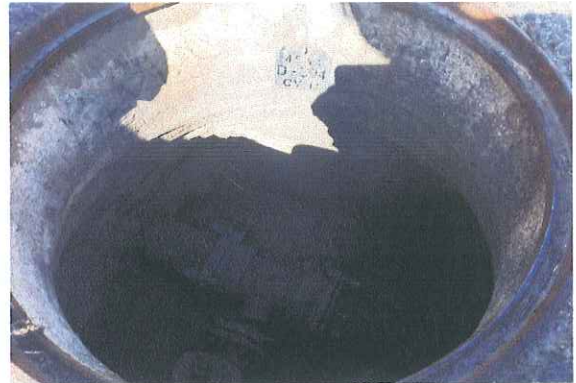
8 DESAGÜE CALLE INDUSTRIA
