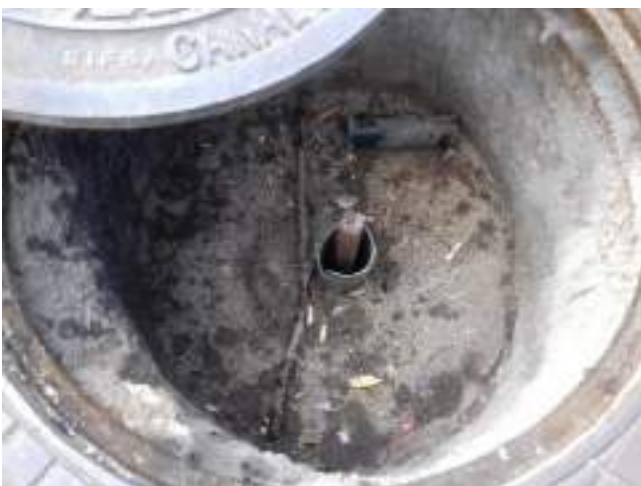
Fotografía 77: Válvula VA.44MN-417 en el cruce de la calle de Francisca Delgado y el Bulevar de Salvador Allende.
