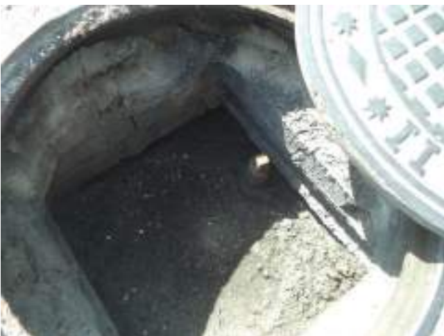
Fotografía 35: Válvula VA.44NM-50 a la altura del nº 3 de la calle de Francisco Gervás.
