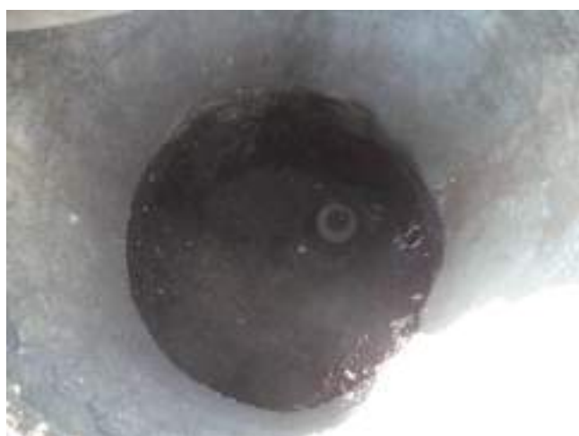
Fotografía 41: Desagüe DE.44NM-85 a la altura del nº 9 de la calle de Francisco Gervás.
