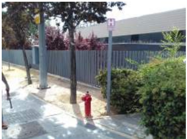
Fotografía 76: Hidrante HI.44MN-1021 en el cruce de la calle de Francisca Delgado y el Bulevar de Salvador Allende.
