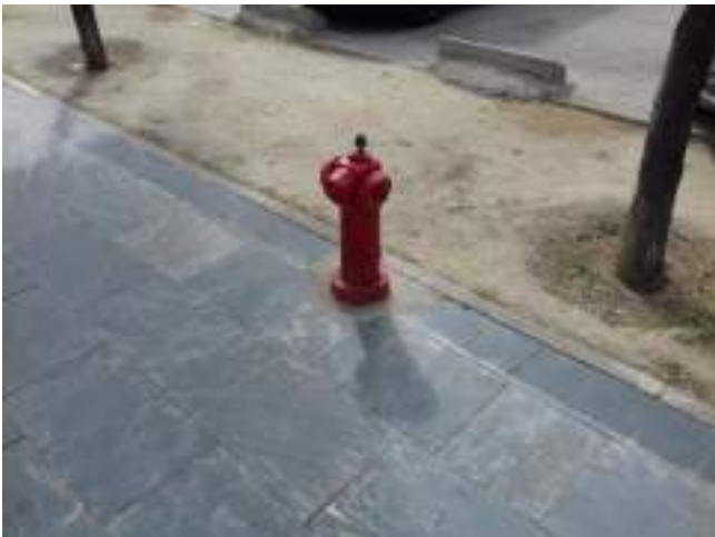
Fotografía 81: Hidrante HI.44MN-1041 a la altura del nº 25 del Bulevar de Salvador Allende.
