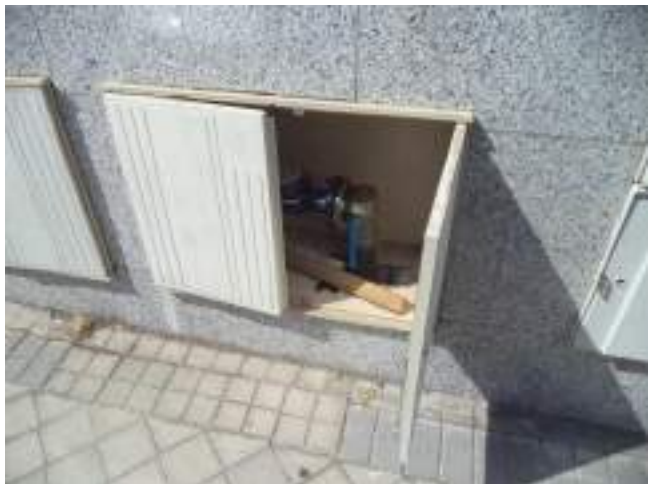
Fotografía 28: Armario de registro y contador del nº 1 de la calle de Francisco Gervás.
