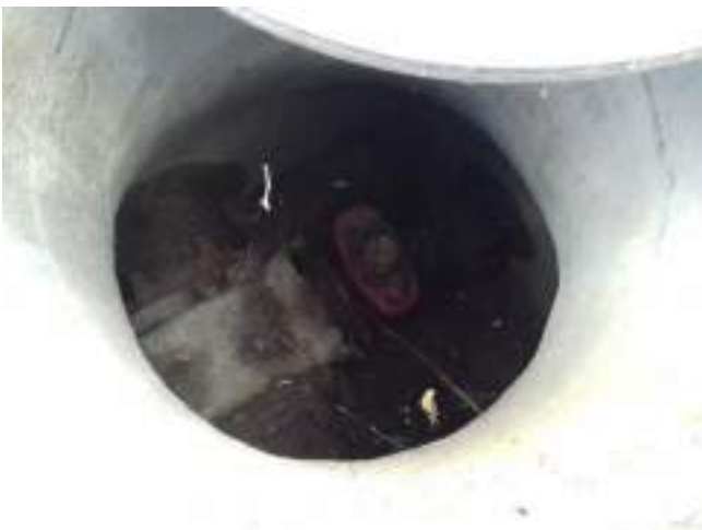
Fotografía 83: Válvula VA.44MN-238 en el cruce del Bulevar de Salvador Allende y la calle Anabel Segura.
