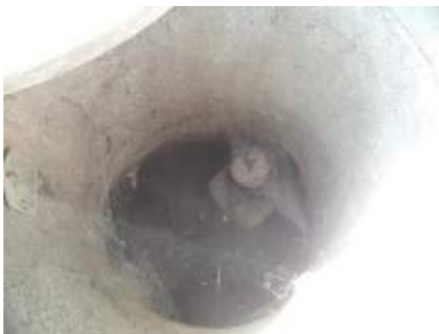
Fotografía 40: Desagüe DE.44NM-15 a la altura del nº 7 de la calle de Francisco Gervás.
