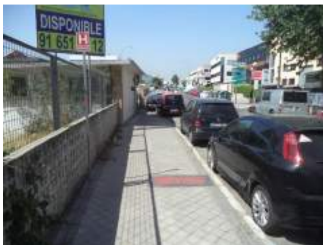
Fotografía 52: Hidrante HI.44NM-288 a la altura del nº 33 de la Avenida de la Industria.
