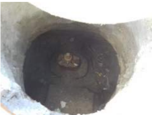
Fotografía 71: Válvula VA.44MN-139 en el cruce de la calle Badajoz y el Bulevar de Salvador Allende.
