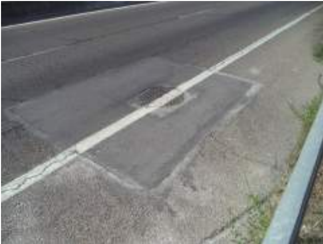
Fotografía 9: Válvula VA.44NM-2 a la altura del nº 44 de la carretera de Fuencarral (M-603).
