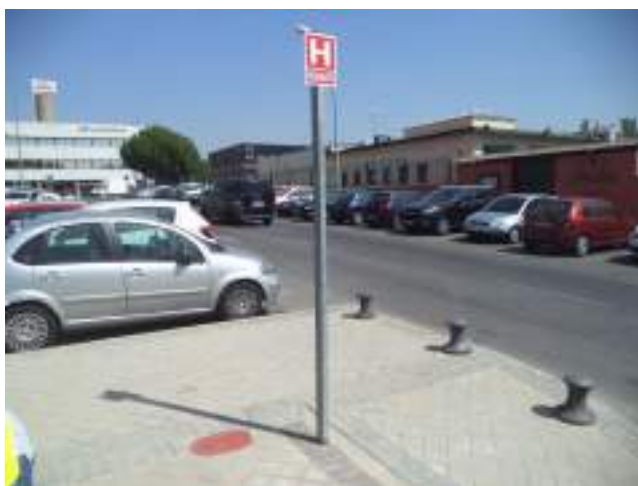
Fotografía 46: Hidrante HI.44NM-208 a la altura del nº 13 de la calle de Francisco Gervás.
