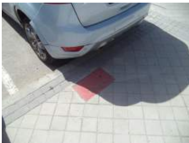
Fotografía 62: Hidrante HI.44NM-172 a la altura del nº 2 de la calle de los Calabozos.
