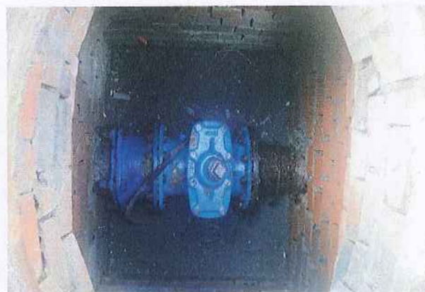
64 VÁLVULA EN EL CRUCE DE LA CALLE DE ALONSO CANO CON LA CALLE DE ESPRONCEDA
