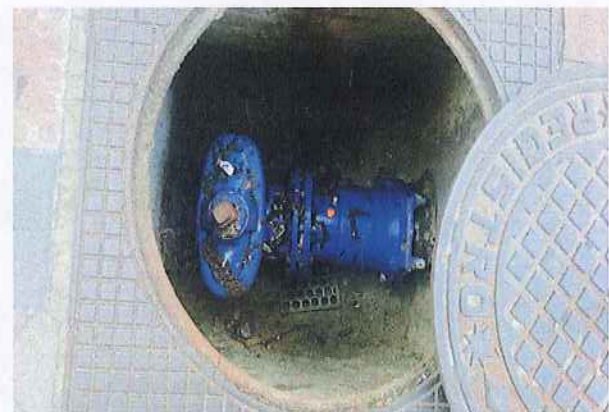
84 VÁLVULA EN LA CALLE DE MODESTO LAFUENTE
