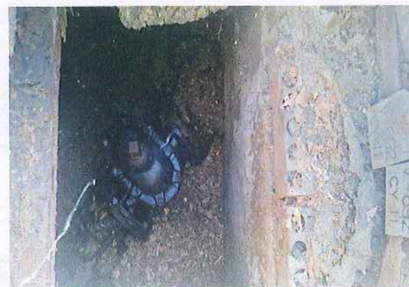
30 VÁLVULA EN EL CRUCE DE LA CALLE DE JOSÉ ABASCAL CON LA CALLE DE ZURBANO
