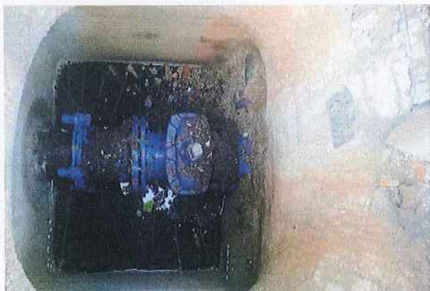
37 VÁLVULA EN EL CRUCE DE LA CALLE DE GARCÍA DE PAREDES CON LA CALLE DE MODESTO LAFUENTE
