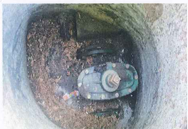
95 VÁLVULA EN EL CRUCE DE LA CALLE DE MODESTO LAFUENTE CON LA CALLE DE JOSÉ ABASCAL
