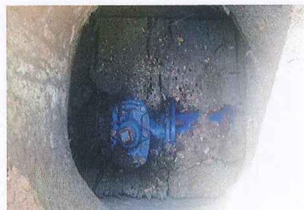
90 VÁLVULA EN EL CRUCE DE LA CALLE DE FERNÁNDEZ DE LA HOZ CON LA CALLE DE VIRIATO
