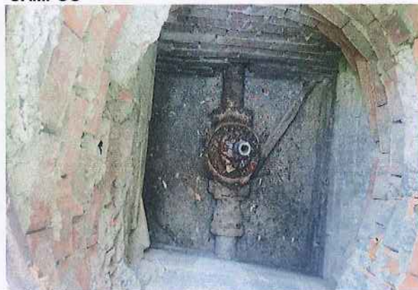
94 VÁLVULA EN EL CRUCE DE LA CALLE DE MODESTO LAFUENTE CON LA CALLE DE JOSÉ ABASCAL
