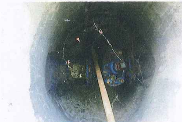
20 VÁLVULA EN EL CRUCE DE LA CALLE DE JOSÉ ABASCAL CON LA CALLE DE MODESTO LAFUENTE
