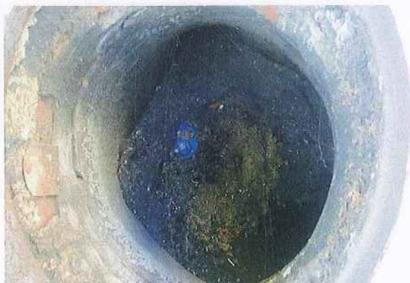
13 VÁLVULA EN EL CRUCE DE LA CALLE DE ESPRONCEDA CON LA CALLE DE ZURBANO
