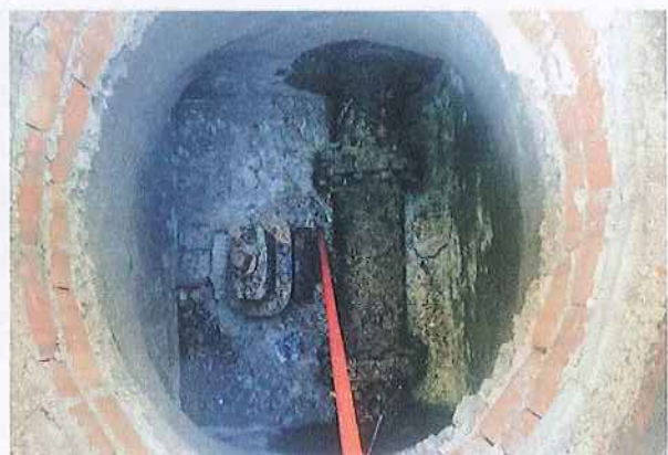
11 DESAGÜE EN LA CALLE DE ESPRONCEDA
