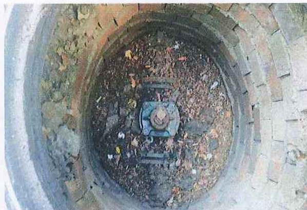
86 VÁLVULA EN EL CRUCE DE LA CALLE DE FERNÁNDEZ DE LA HOZ CON LA CALLE DE JOSÉ ABASCAL
