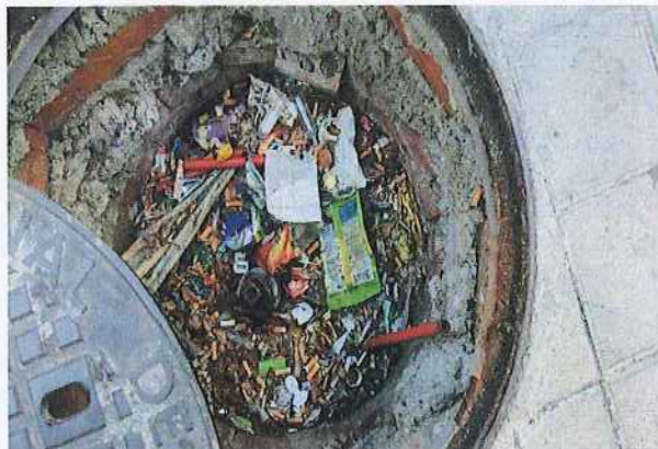
14 VÁLVULA EN EL CRUCE DE LA CALLE DE BRETÓN DE LOS HERREROS CON LA CALLE DE PONZANO
