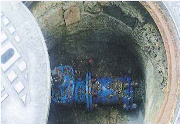
79 VÁLVULA EN EL CRUCE DE LA CALLE DE ALONSO CANO CON LA CALLE DE VIRIATO
