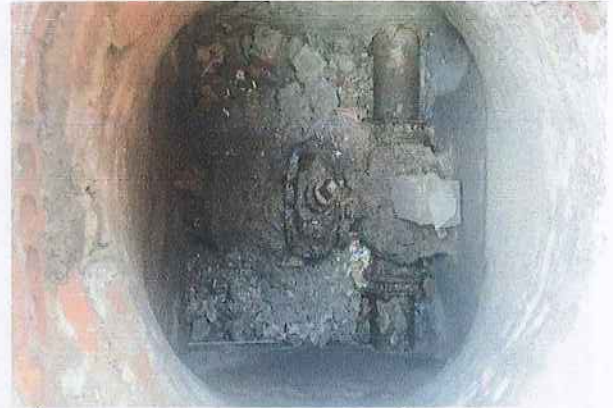
32 VÁLVULA EN LA CALLE DE GARCÍA DE PAREDES
