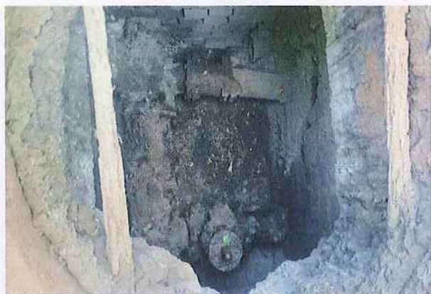
93 VÁLVULA EN EL CRUCE DE LA CALLE DE MODESTO LAFUENTE CON LA CALLE DE JOSÉ ABASCAL
