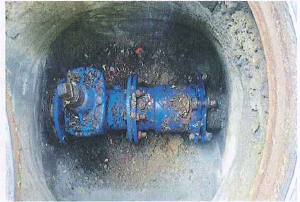
80 VÁLVULA EN EL CRUCE DE LA CALLE DE ALONSO CANO CON LA CALLE DE VIRIATO
