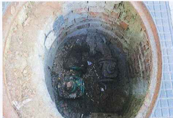
50 VÁLVULA Y DESAGÜE EN EL CRUCE DE LA CALLE DE PONZANO CON LA CALLE DE JOSÉ ABASCAL
