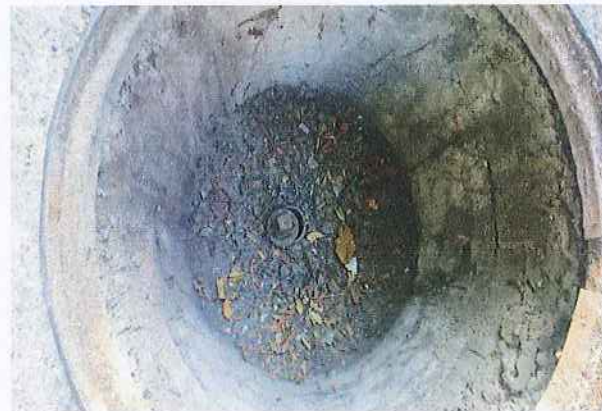
52 VÁLVULA EN EL CRUCE DE LA CALLE DE VARGAS CON LA CALLE DE BRETÓN DE LOS HERREROS
