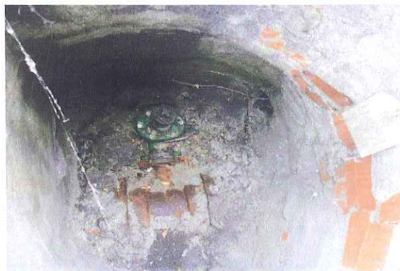
72 DESAGÜE DE.54JI-251 EN PASEO IMPERIAL
