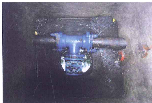
64 DESAGÜE DE-54JI-798 EN CALLE SAN ALEJANDRO
