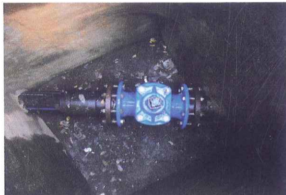
50 VÁLVULA VA.54II-1126 EN CALLE FÓSFORO
