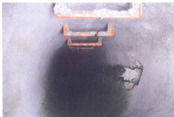
68 POZO CONEXION GALERIA EN LA CALLE SAN ALEJANDRO
