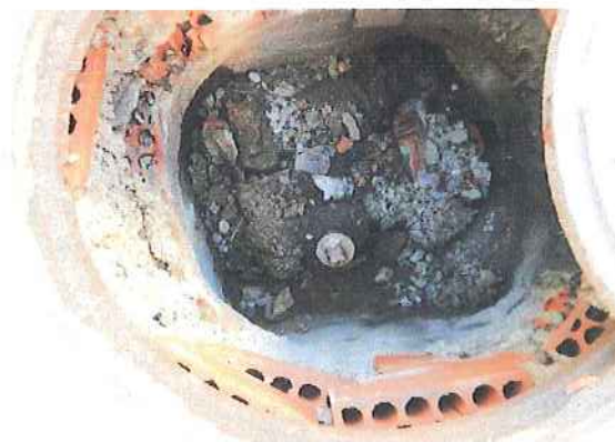
46 VÁLVULA CALLE DE LA VEREDA DEL CARMEN
