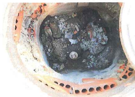
46 VÁLVULA CALLE DE LA VEREDA DEL CARMEN
