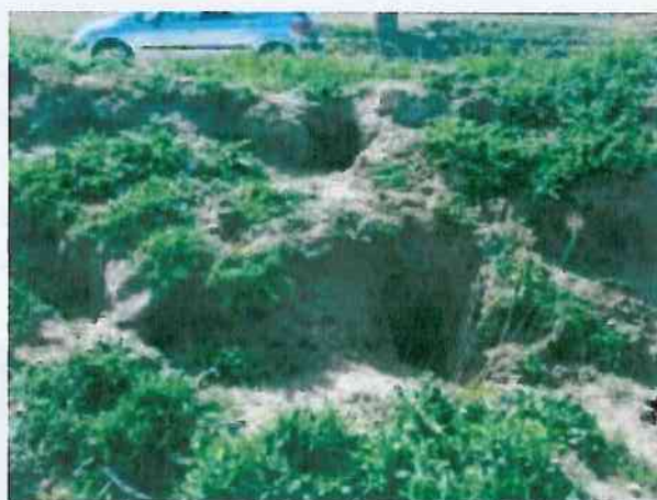
Ilustración 15. Madrigueras de conejo en los caballones de la margen izquierda del camino.
