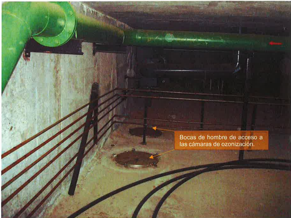
Bocas de hombre de acceso a las cámaras de ozonización intermedia existentes.
