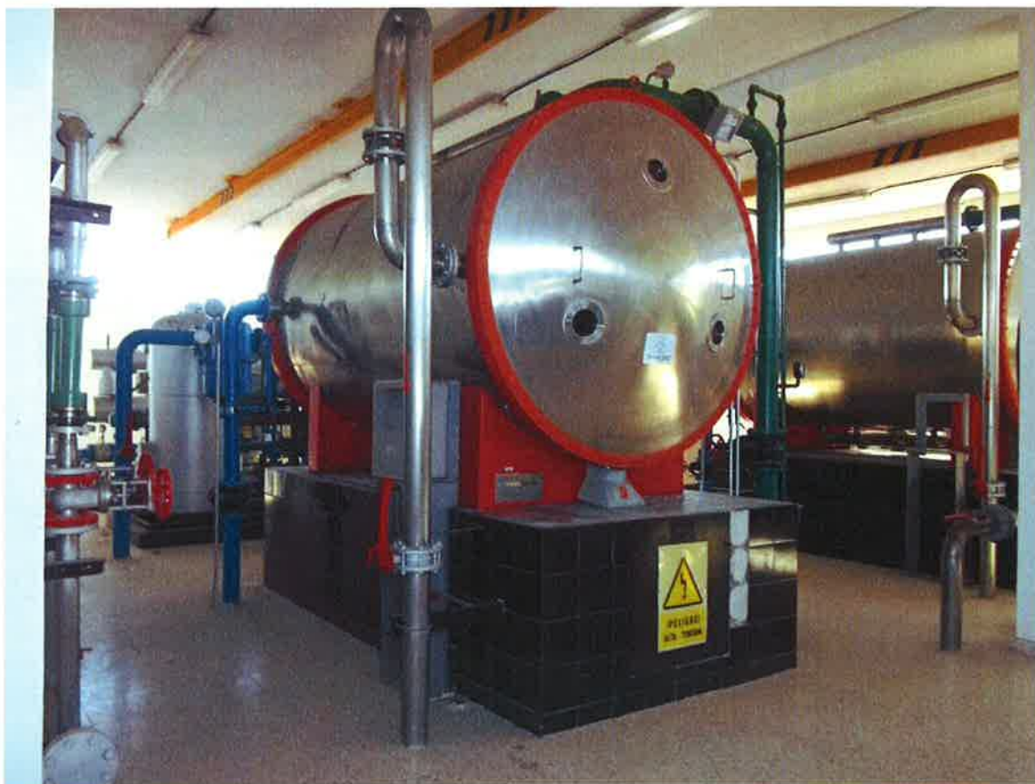
Instalación de generadores de ozono, fuera de servicio.
