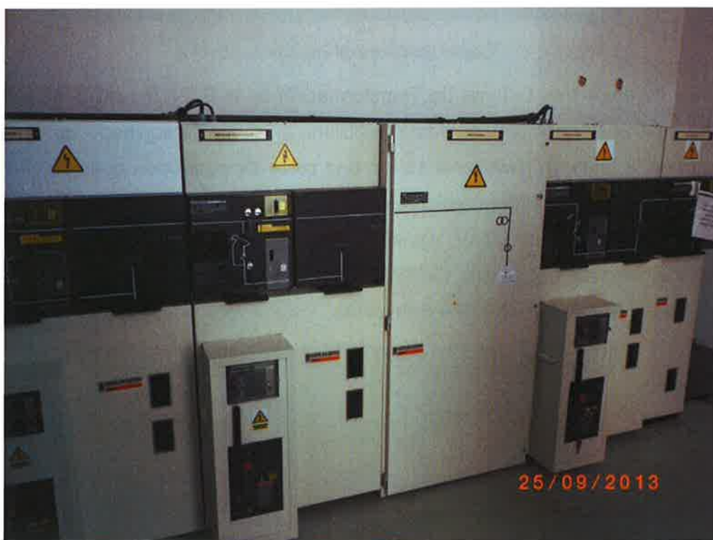
Celdas del Centro de Transformación nº 2.
