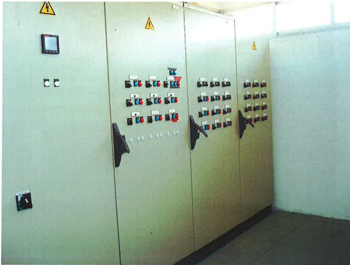
Vista frontal del CCM-1LL, de tipo ejecución fija.
