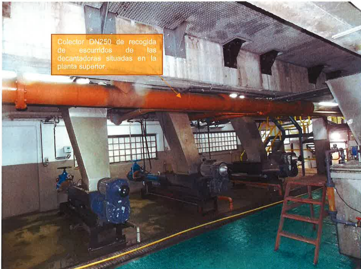
Recogida de los fangos y de los escurridos de la deshidratación.
