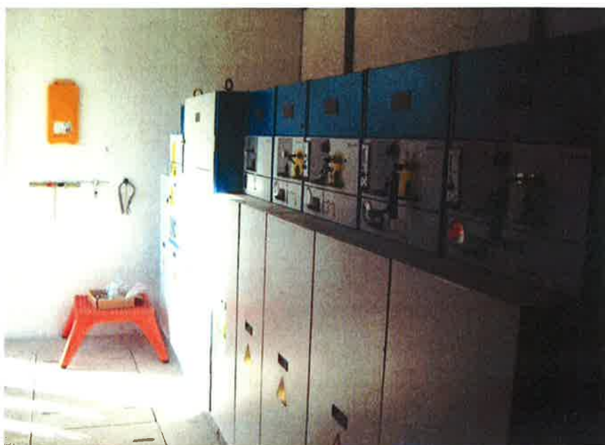
Celdas del C.T. de bombeo “Elevadora Santillana III”.
