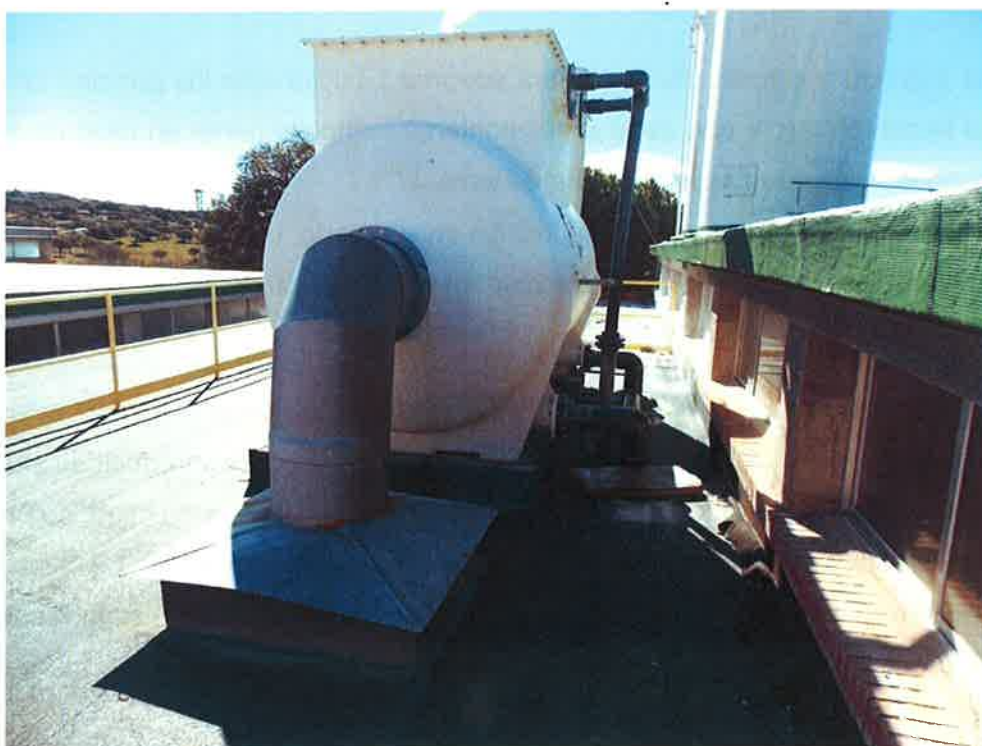
Torre de neutralización sobre la cubierta del edificio.
