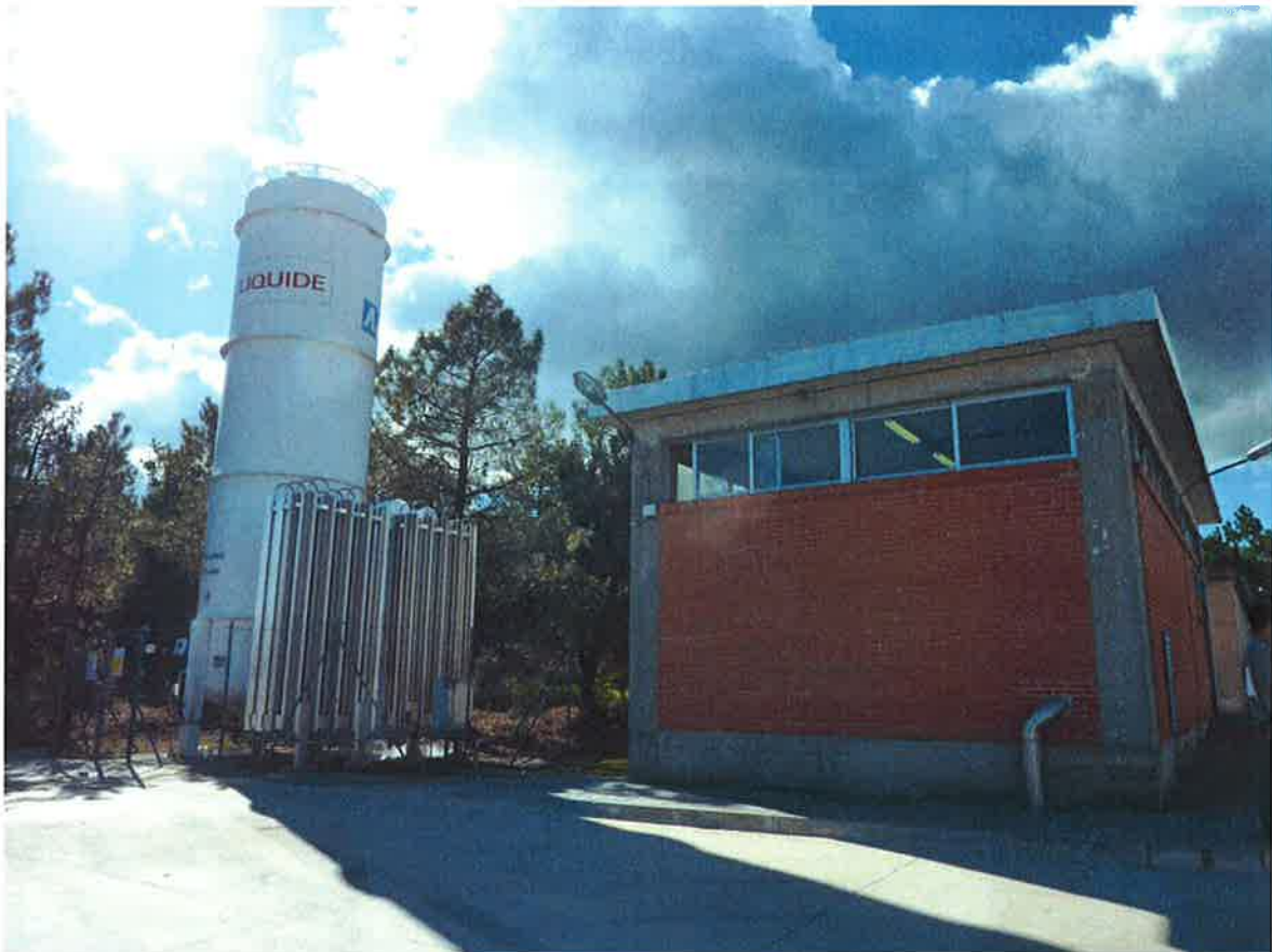
Edificio de generación de ozono junto a la instalación de almacenamiento y dosificación de oxígeno líquido.
