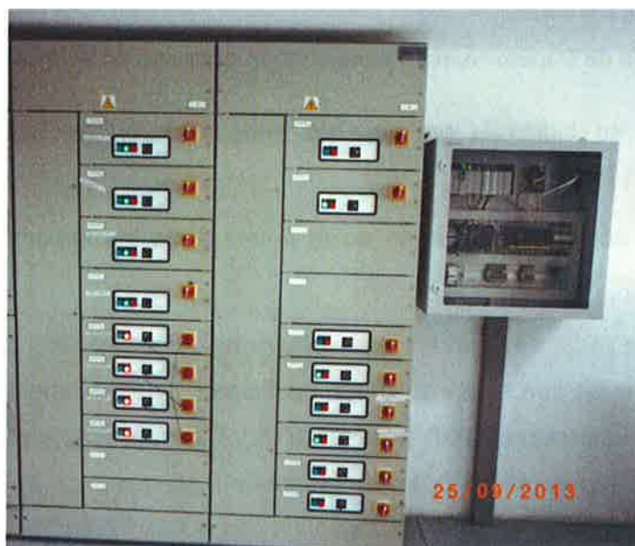
CCM-1G, situado frente al edificio de C.T. nº 1
