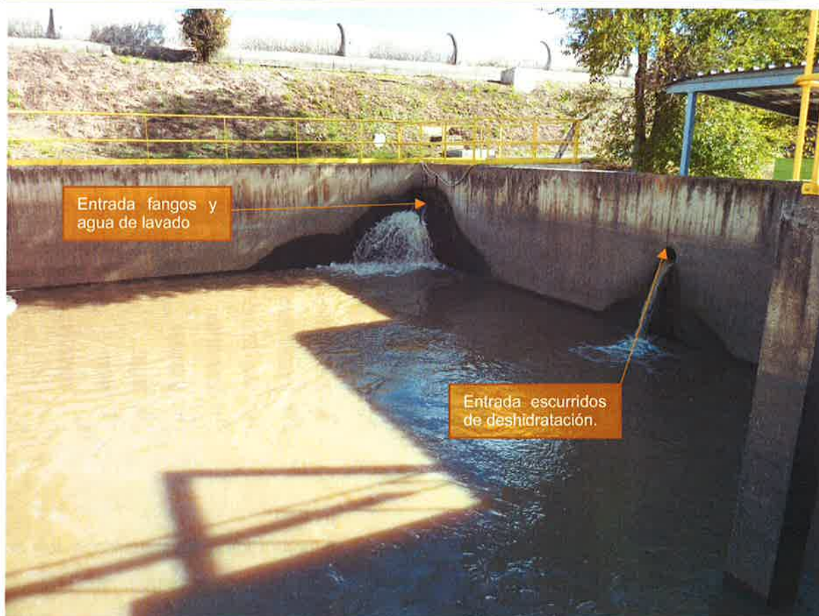
Depósito de homogenización, con las distintas entradas de fangos y escurridos.
