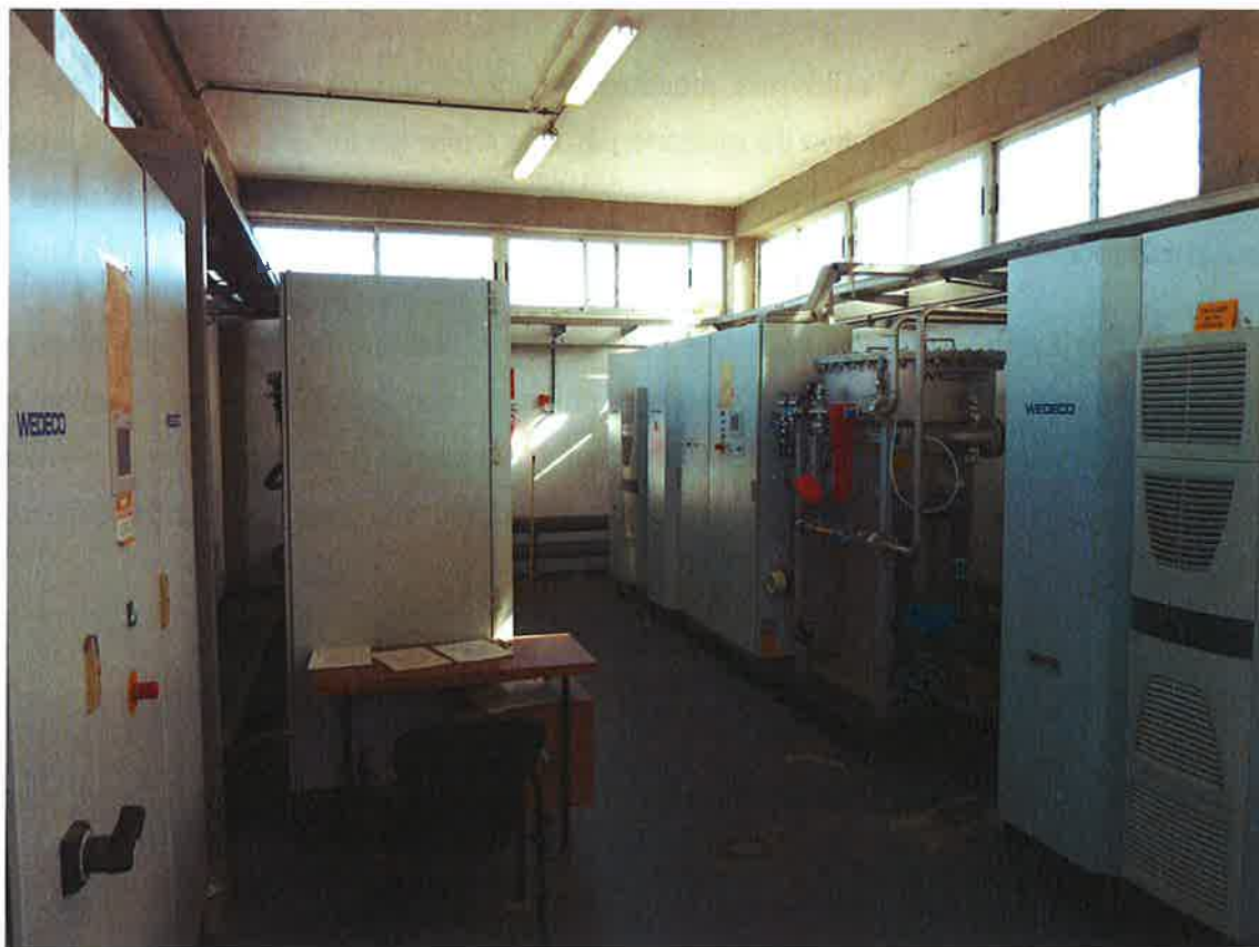
Interior del edificio de generación de ozono, con el autómatas master en primer término.
