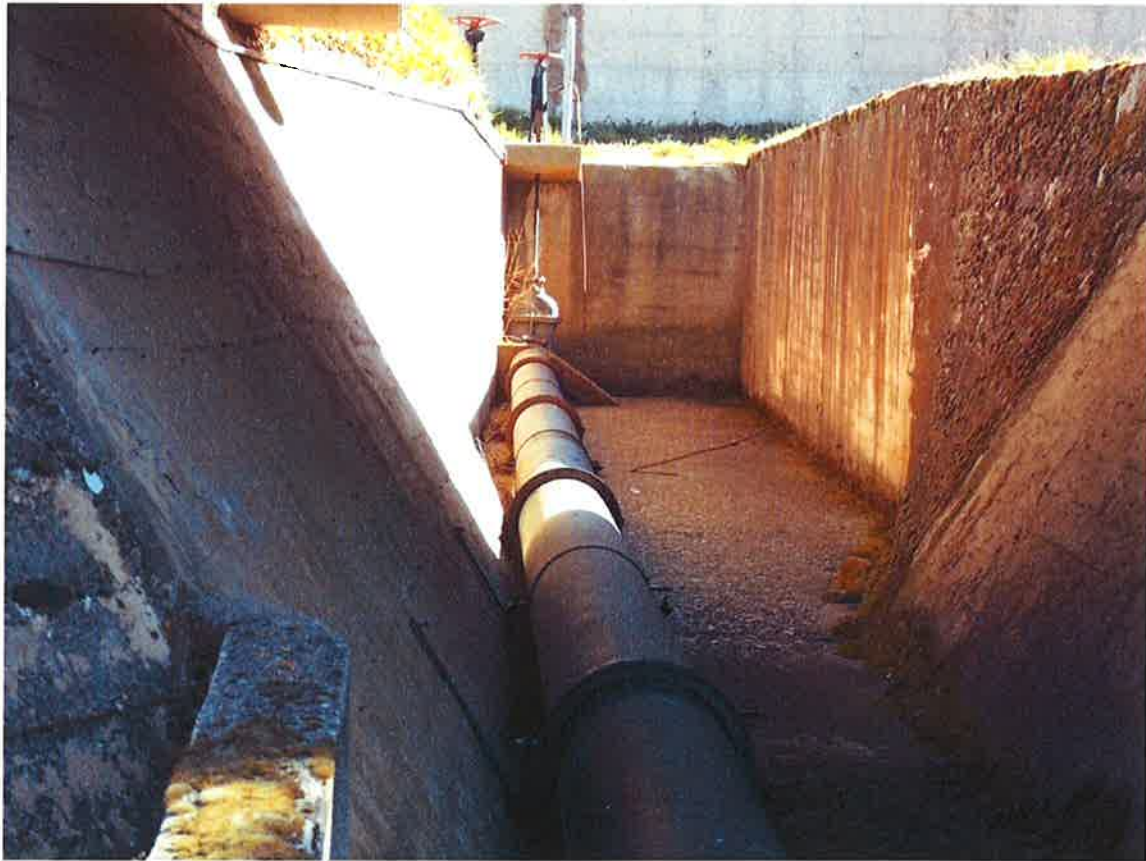
Conducción de purga de fangos, instalada en la obra de vertido original
