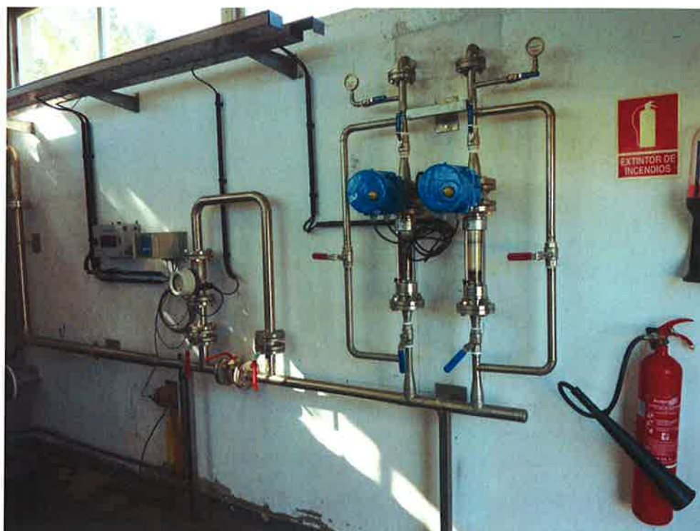
Colector de impulsión de ozono a la cámara de preozonización.
