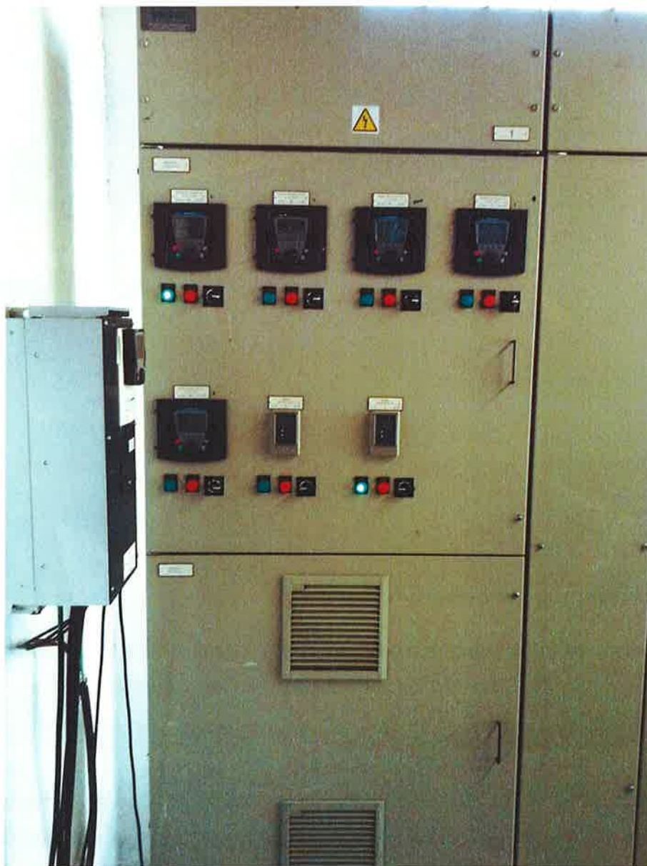
Columna de variadores de frecuencia del CCM-3G.
