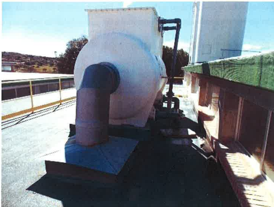
Torre de neutralización a proteger.
