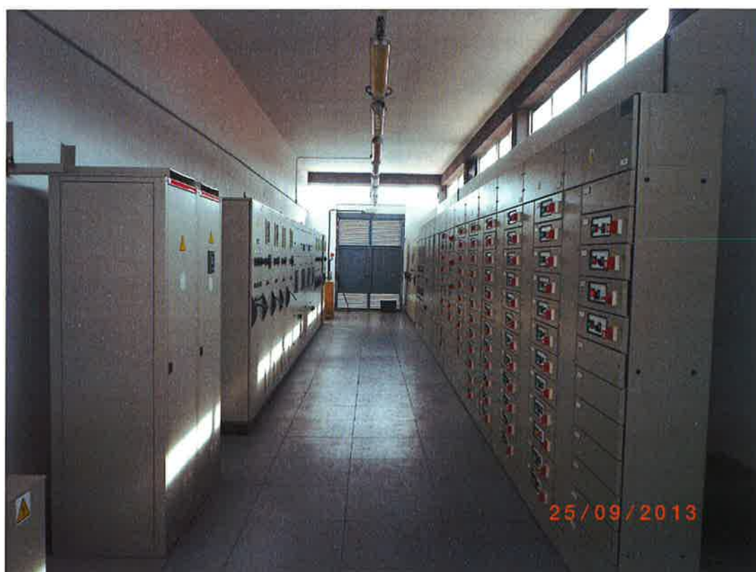
Sala eléctrica donde se encuentra el PLC-2.
