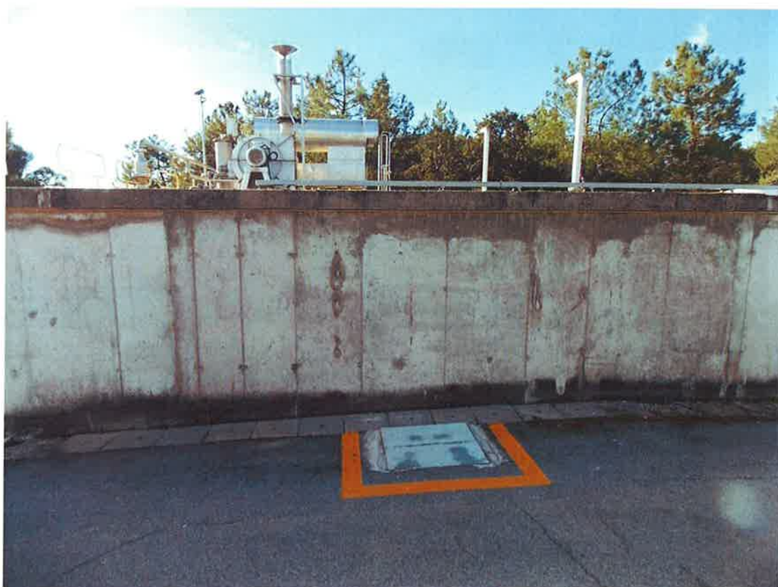
Aspecto exterior de la cámara de preozonización, con el destructor de ozono sobre su losa superior.
