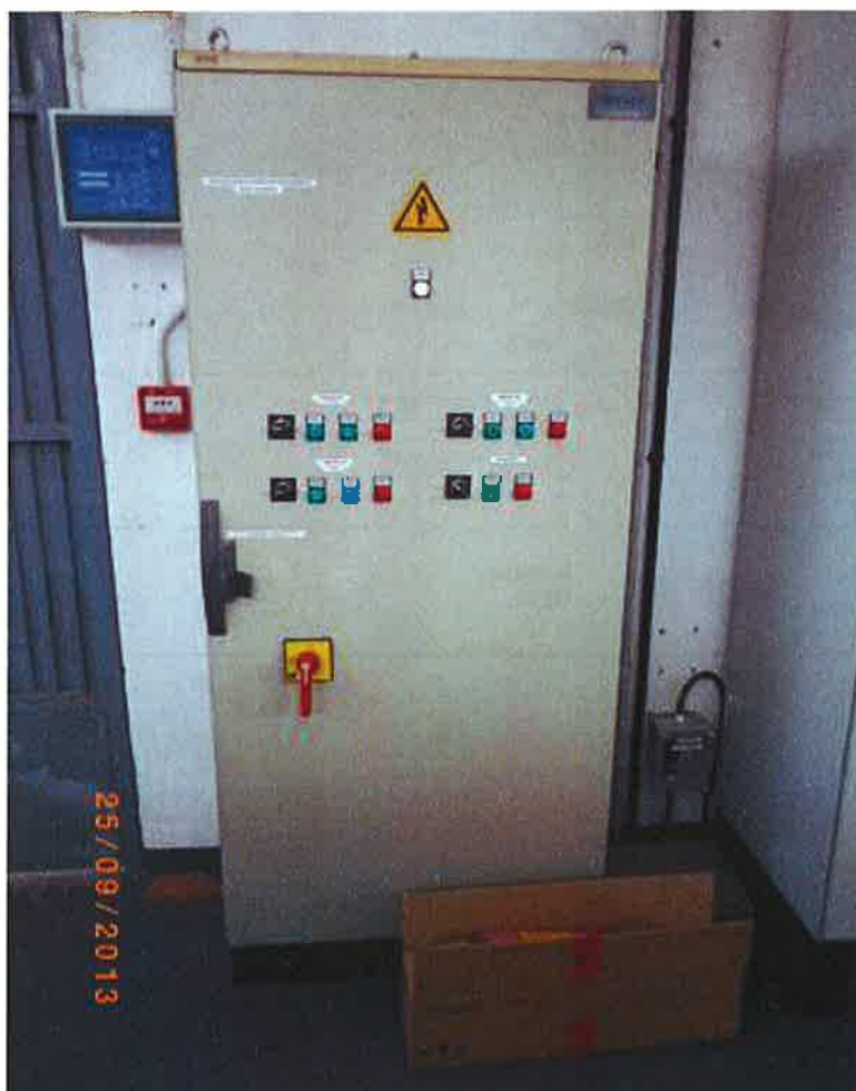
CCM Sistema de Ozono, situado en la sala de generadores de ozono.
