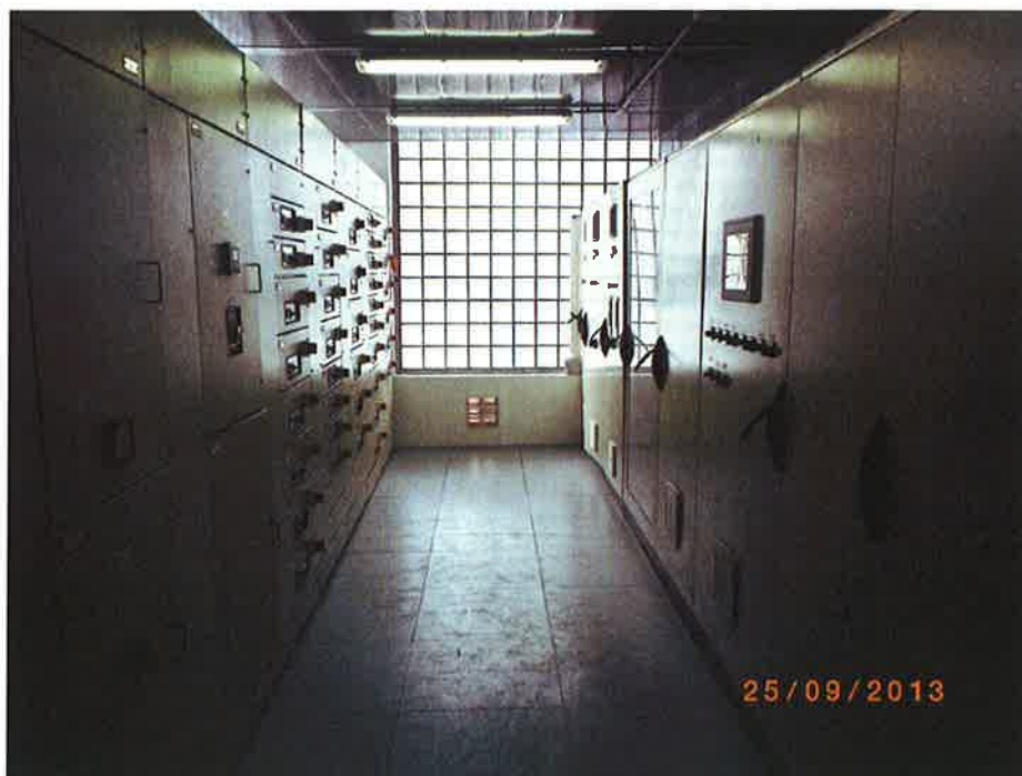
CCM-3G, situado junto al edificio de C.T. nº 3
