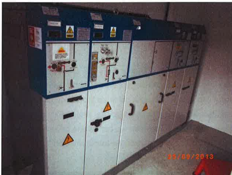
Celdas del Centro de Transformación nº 3.
