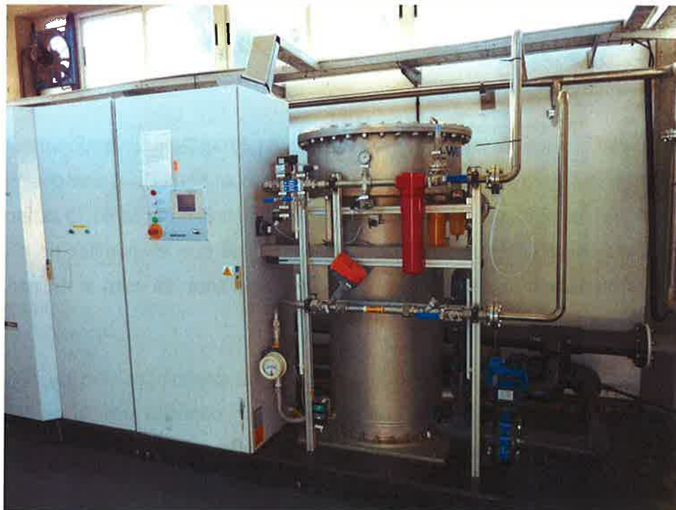
Vista de uno de los tres generadores de ozono existentes.
