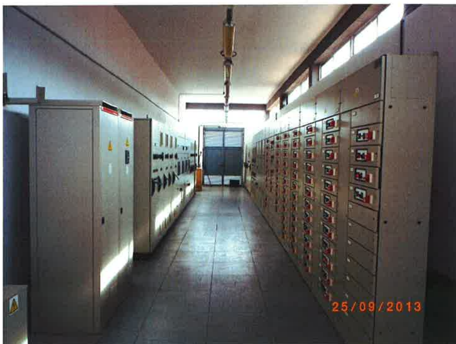
CGBT-2 y CCM-2G, situado en el edificio de C.T. nº 2
