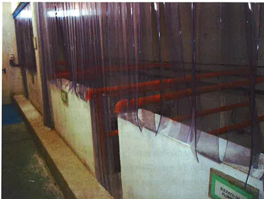
Instalación actual de almacenamiento del sulfato de alúmina.
