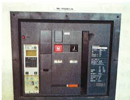
Interruptor post-ozonización existente
