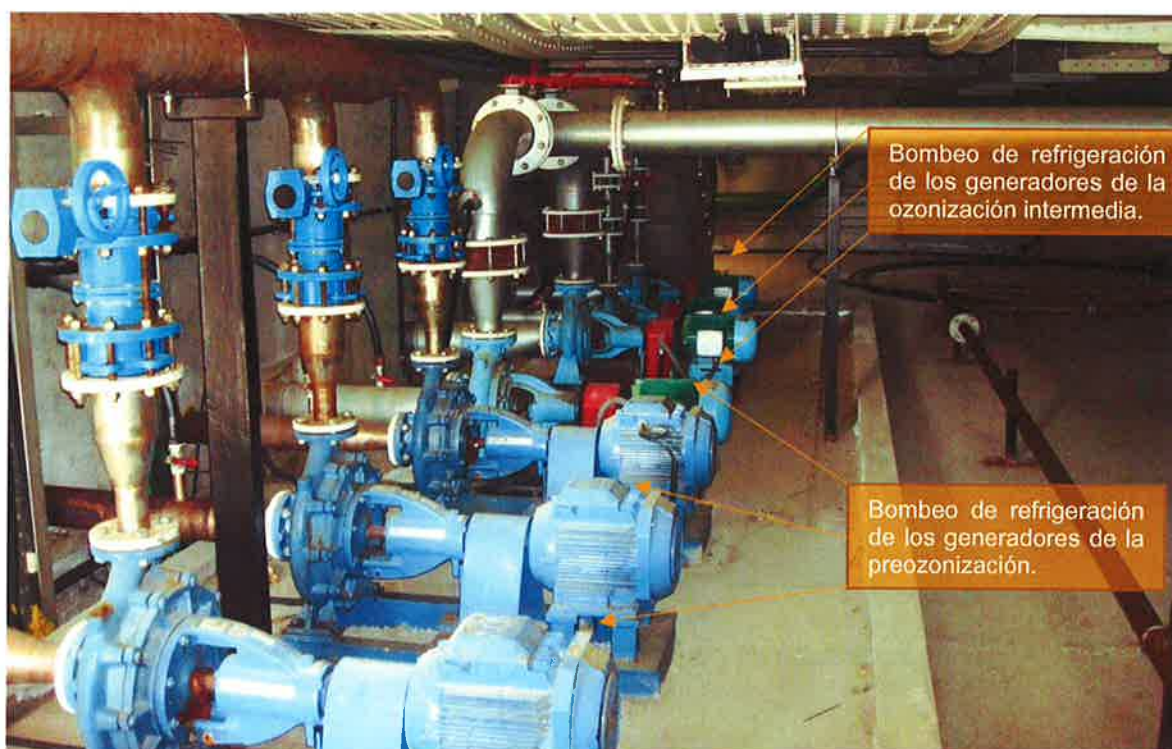
Bombeo de refrigeración de los generadores de ozono.
