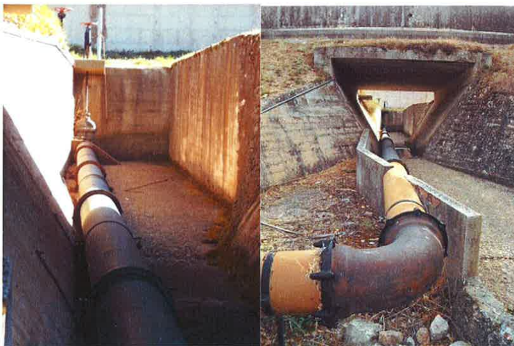
Conducción de purga de fangos, instalada en la obra de vertido original
