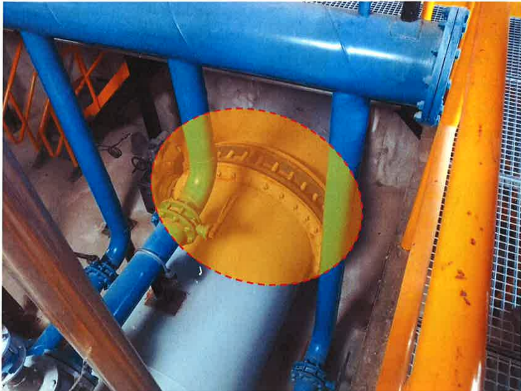
Válvula de mariposa instalada en la actualidad DN1200.
