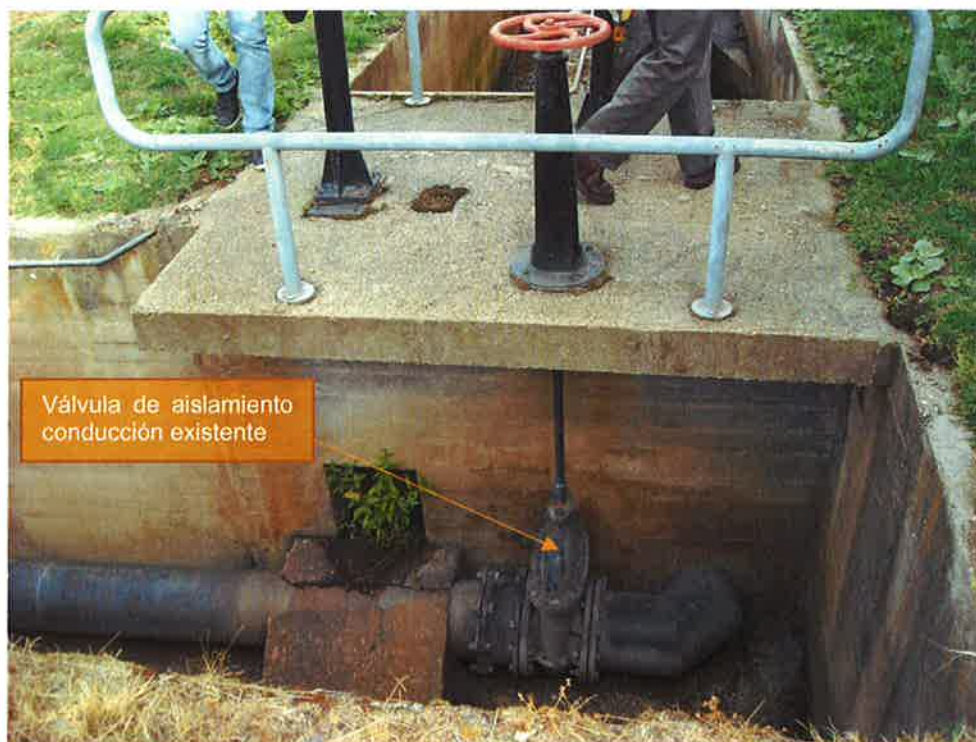
Salida de la conducción común DN300, con válvula de aislamiento en cabecera.
