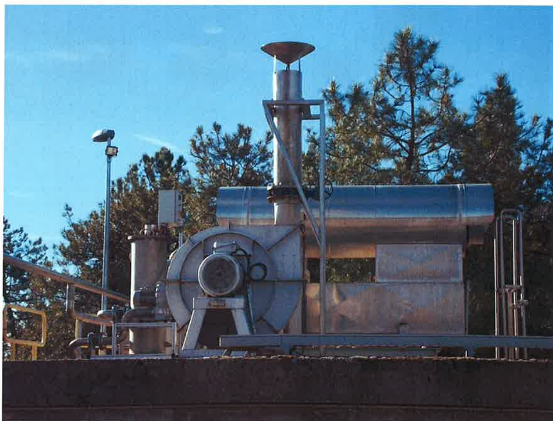
El destructor de ozono de la cámara de preozonización, común a las dos líneas.
