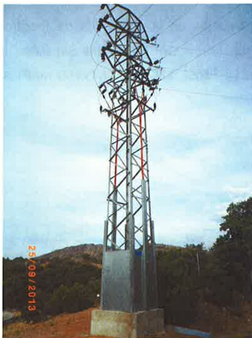
Apoyo n° 37 de la línea de 15 kV "Navallar", propiedad de CANAL DE ISABEL II GESTIÓN
