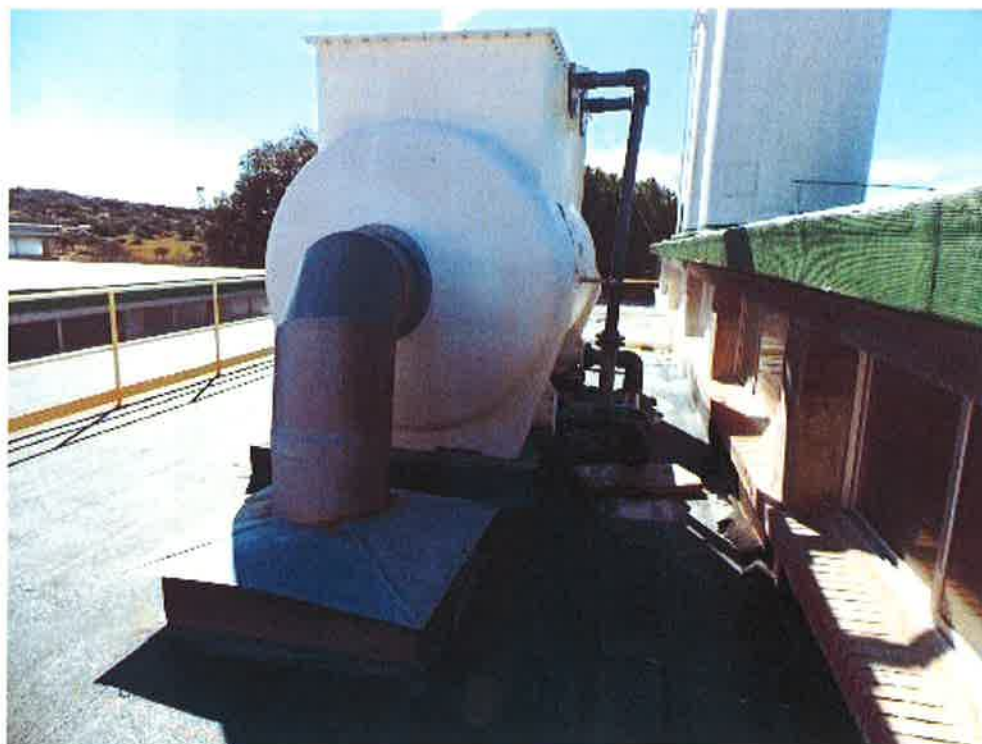
Torre de neutralización sobre la cubierta del edificio.
