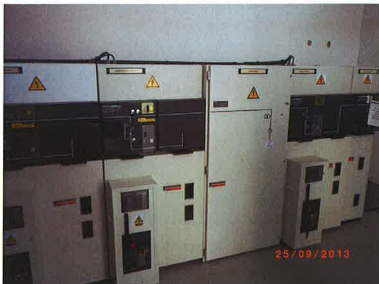
Celdas del Centro de Transformación nº 2.
