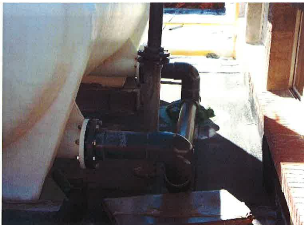
Detalle de la interconexión entre la torre y el depósito de hidróxido sódico.
