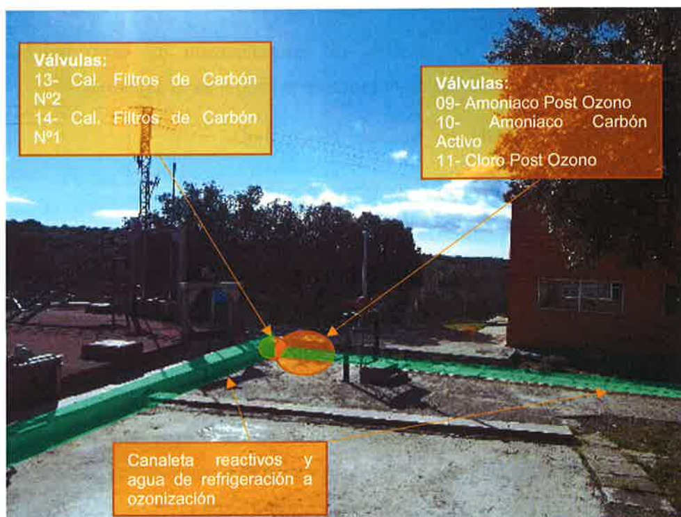
Situación de las válvulas de dosificación N09 a N16
