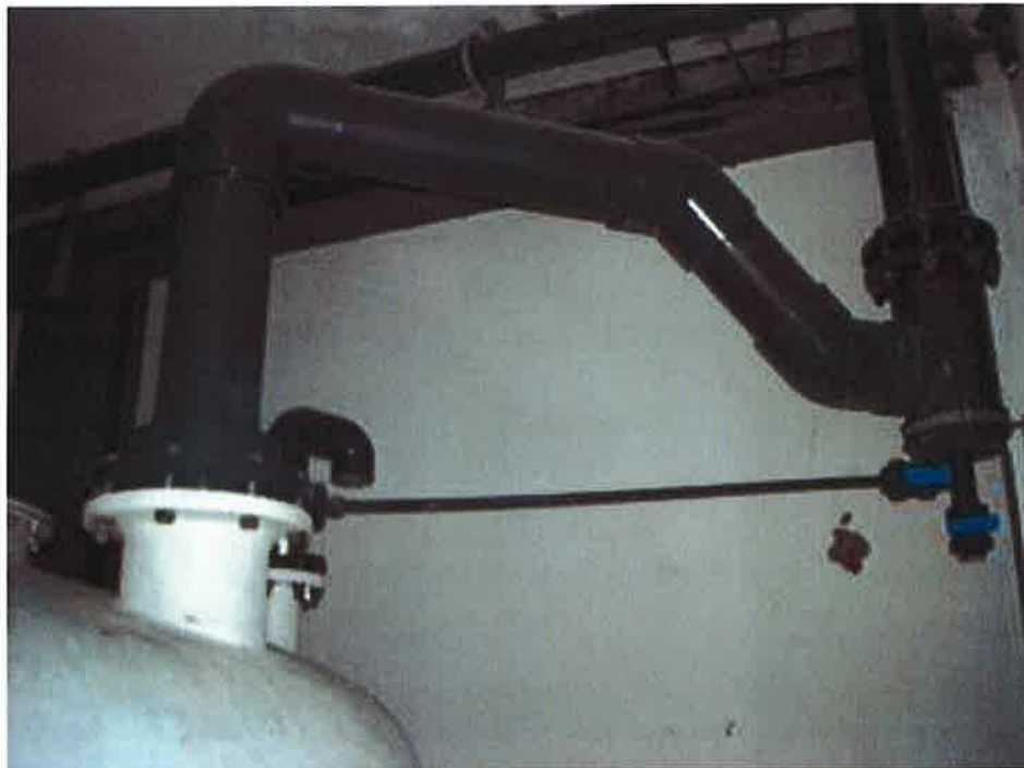
Detalle del sifón en la salida del depósito de hidróxido sódico a la torre.
