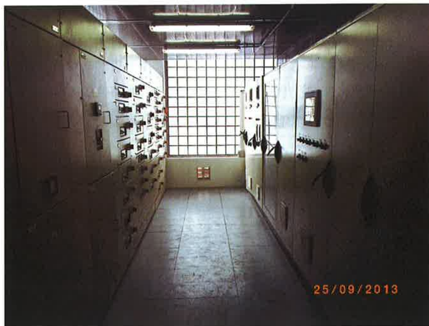
CCM-3G, situado junto al edificio de C.T. n° 3
