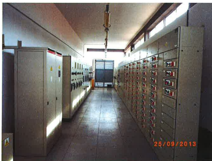
CGBT-2 y CCM-2G, situado en el edificio de C.T. n° 2
