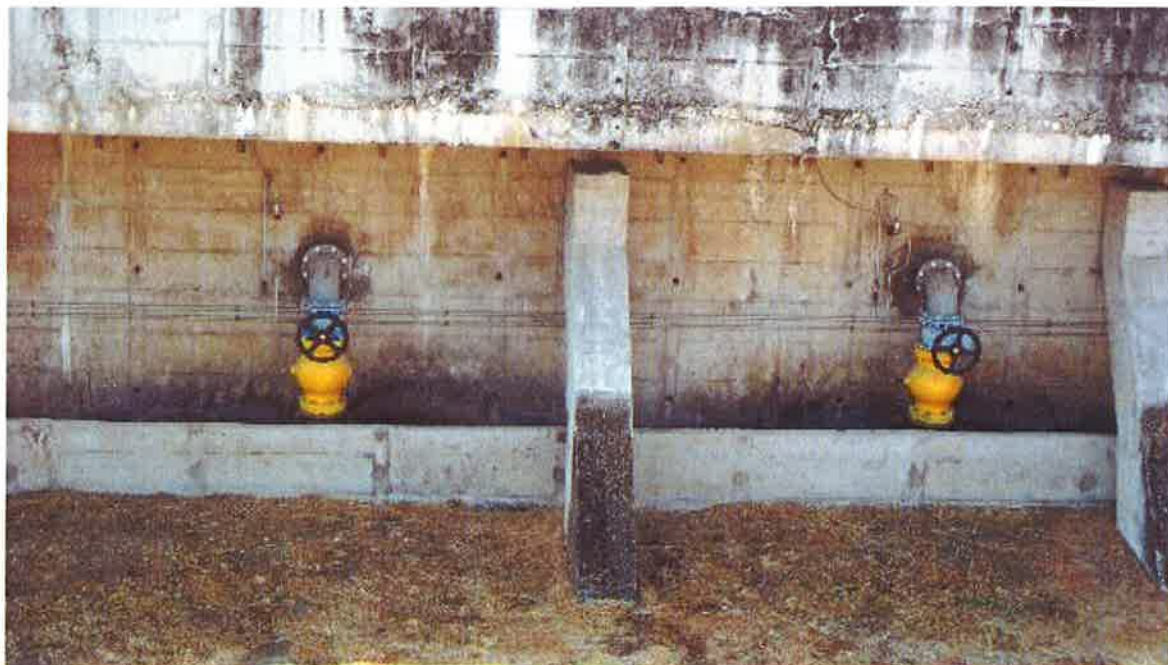
Válvulas de aislamiento de dos tuberías de purga de fangos.
