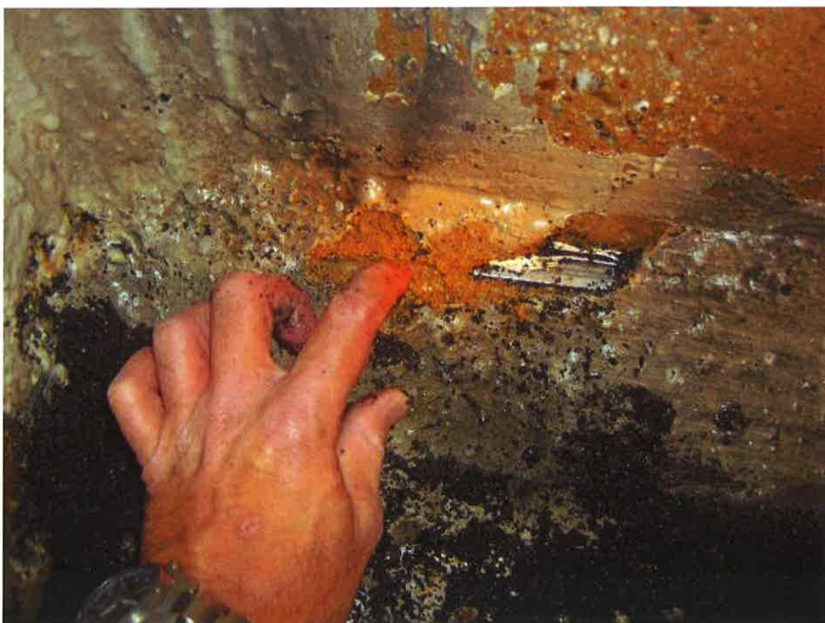
Detalle de la degradación de los muros interiores de los filtros.
