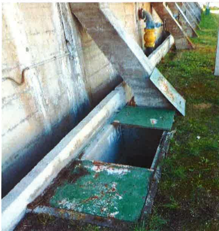
Vista exterior de la arqueta de vaciados de un decantador.
