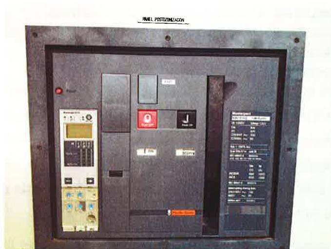
Interruptor post-ozonización existente
