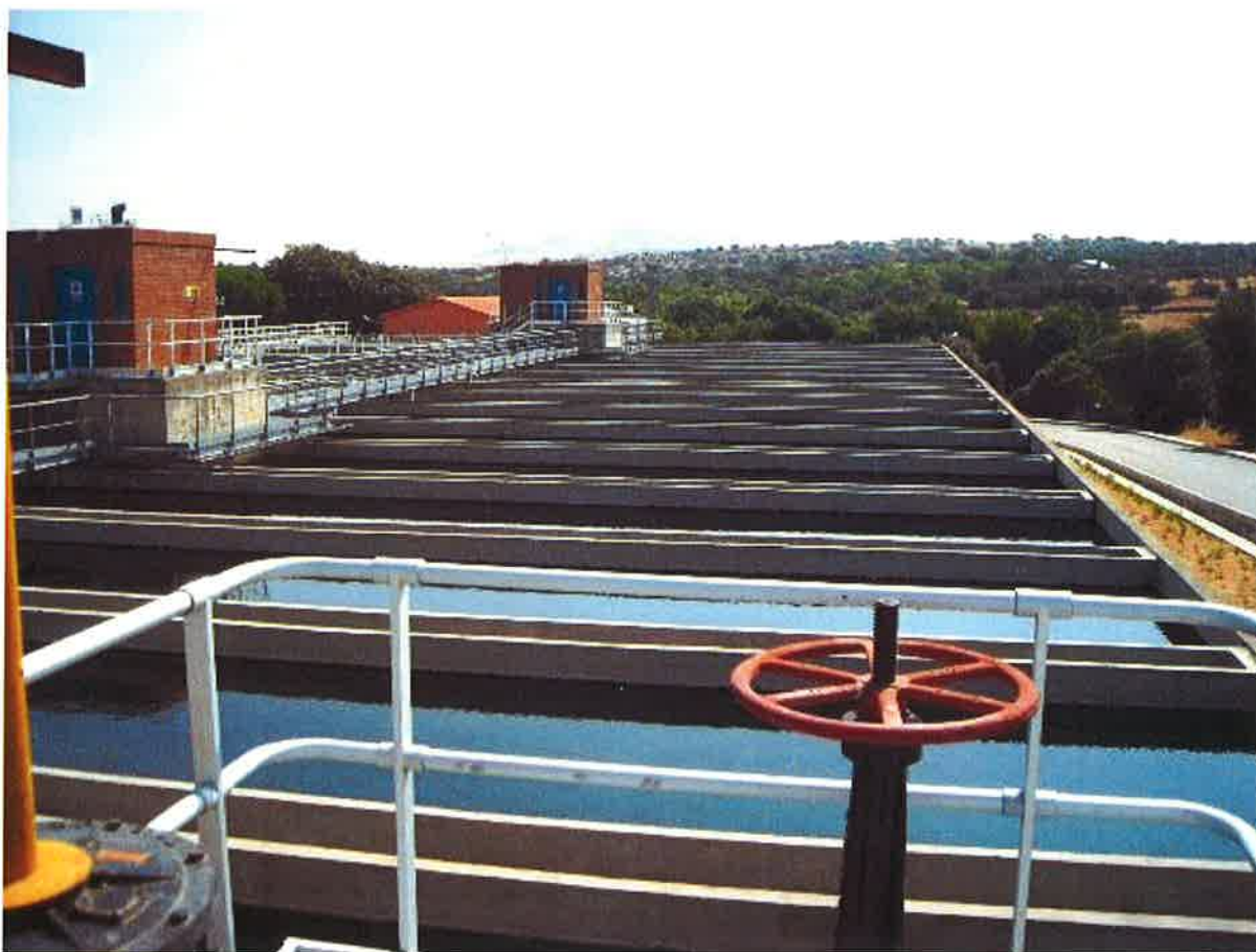
Vista de dos decantadores desde la cámara de mezcla, situada en medio de la decantación.
