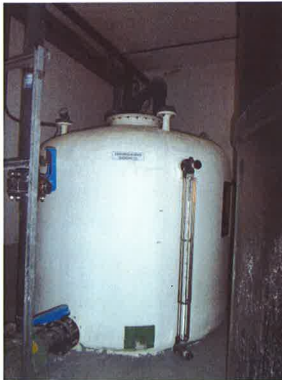
Depósito de hidróxido sódico.
