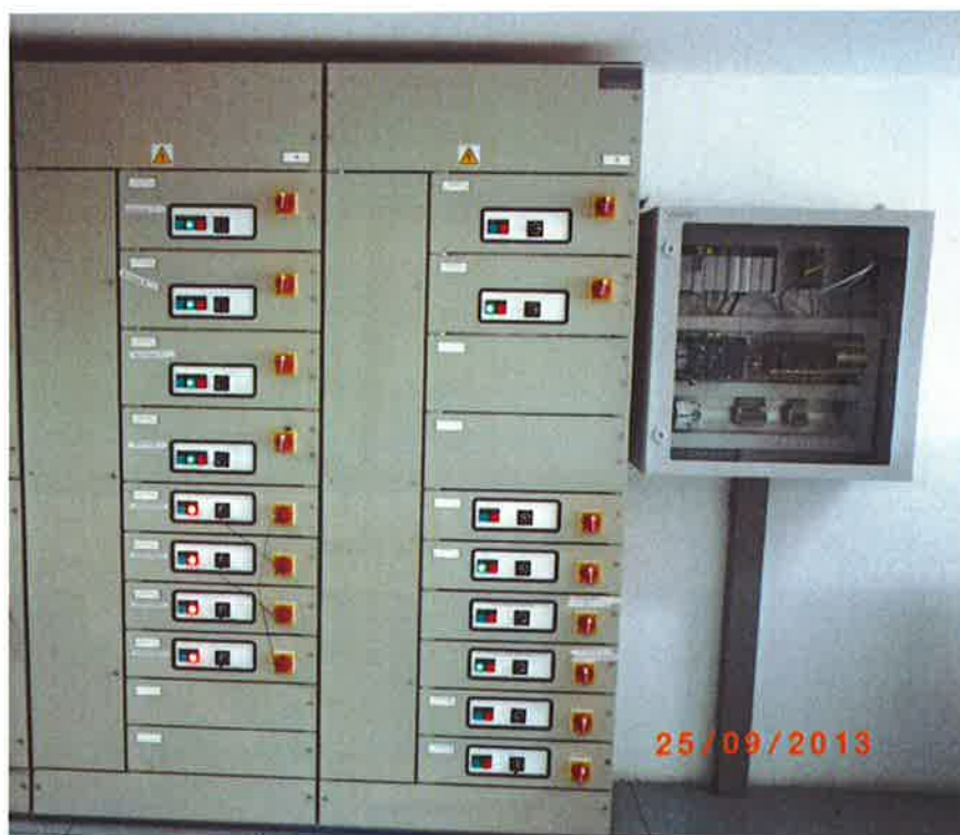
CCM-1G, situado frente al edificio de C.T. n° 1
