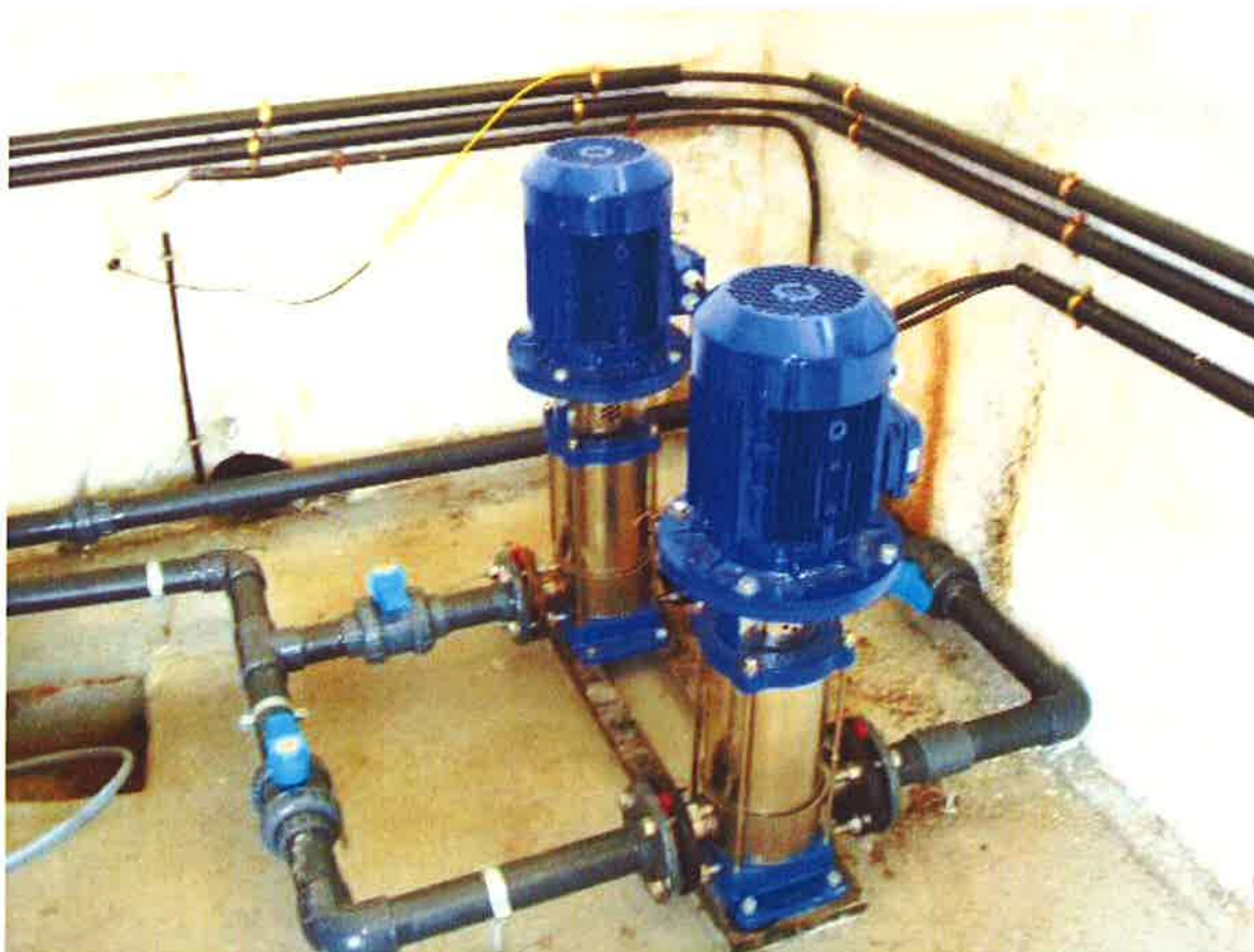
Vista de las dos bombas verticales.
