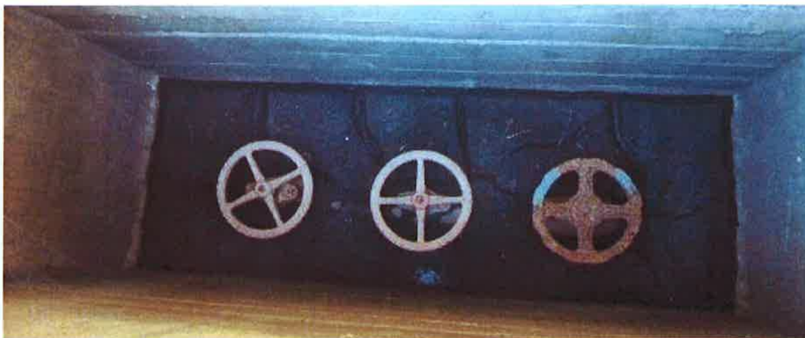
Vista interior de la arqueta con las válvulas de aislamiento de los vaciados de un decantador.
