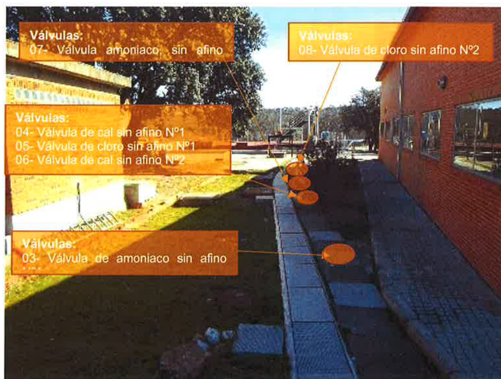
Situación de las válvulas de dosificación N03 a N08.
