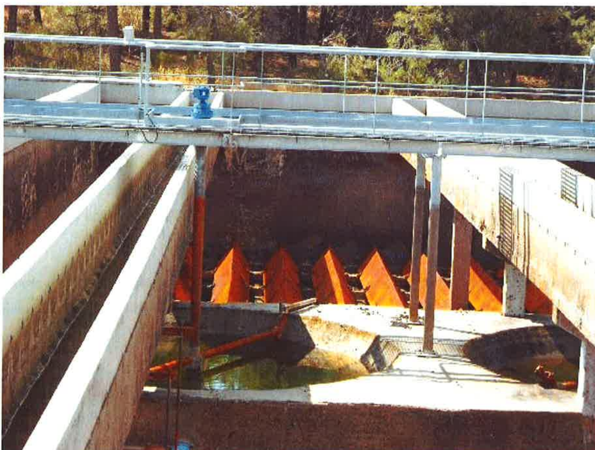
Concentradores de fangos, a media altura entre las placas tranquilizadoras y las canaletas de recogida de agua.
