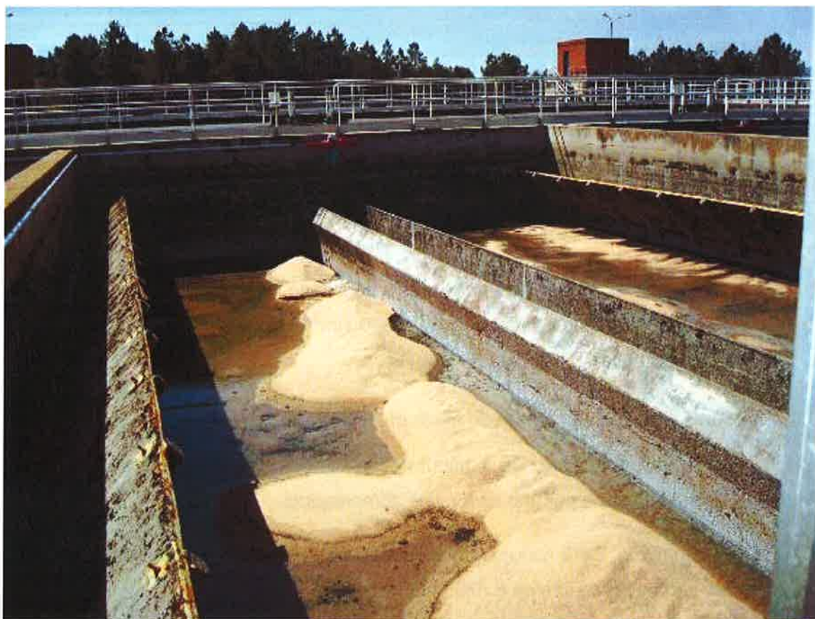
Filtro de arena fuera de servicio.
