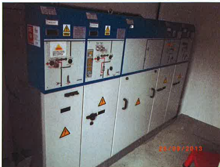
Celdas del Centro de Transformación nº 3.
