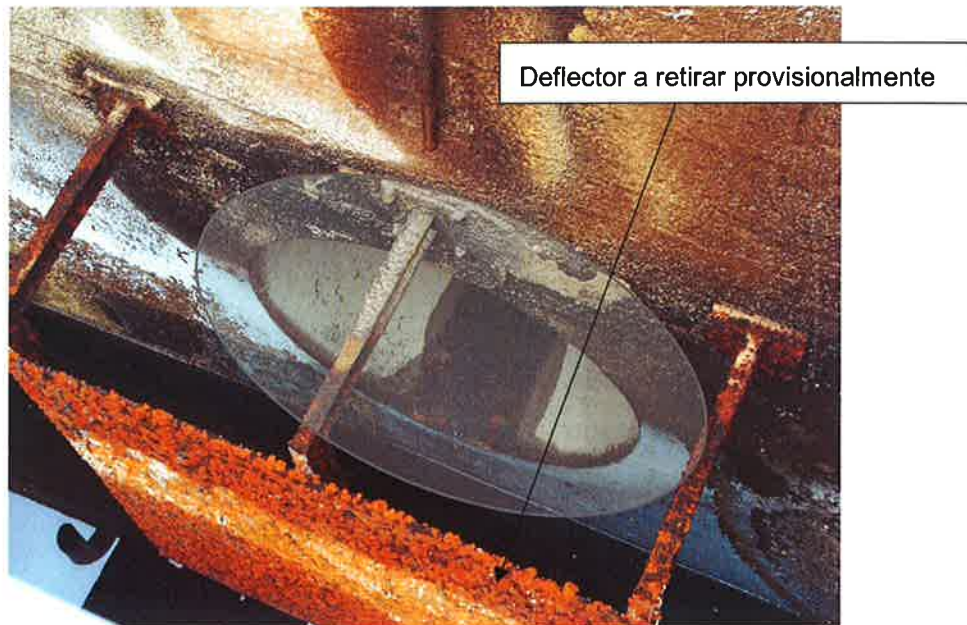
Entrada a las cámaras de mezcla.
