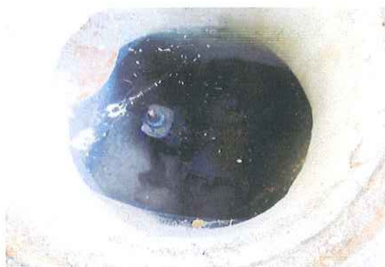
53 DESAGÜE AVENIDA BADAJOZ
