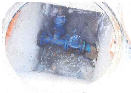
46 VÁLVULA CALLE TORRELAGUNA
