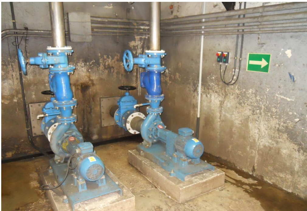
Bombas de impulsión de escurridos de centrifugas
