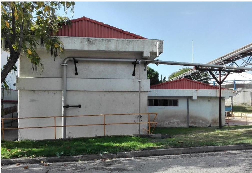
Tubería impulsión escurridos
