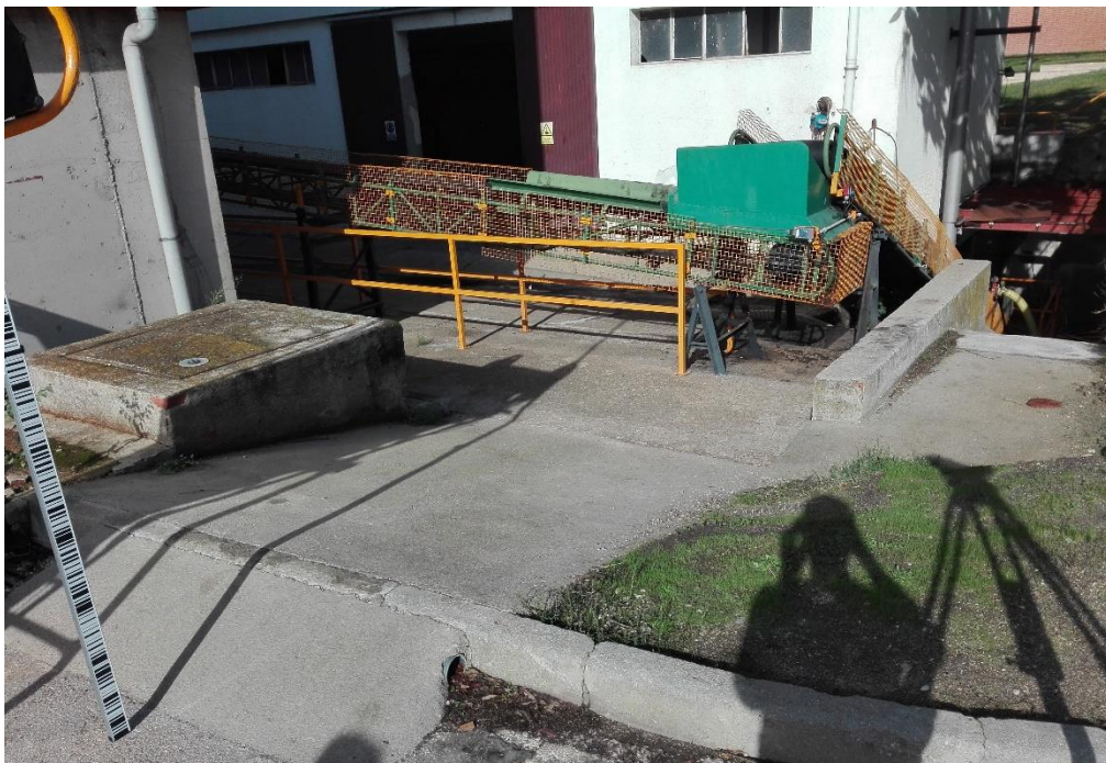
Ubicación bombas fangos
