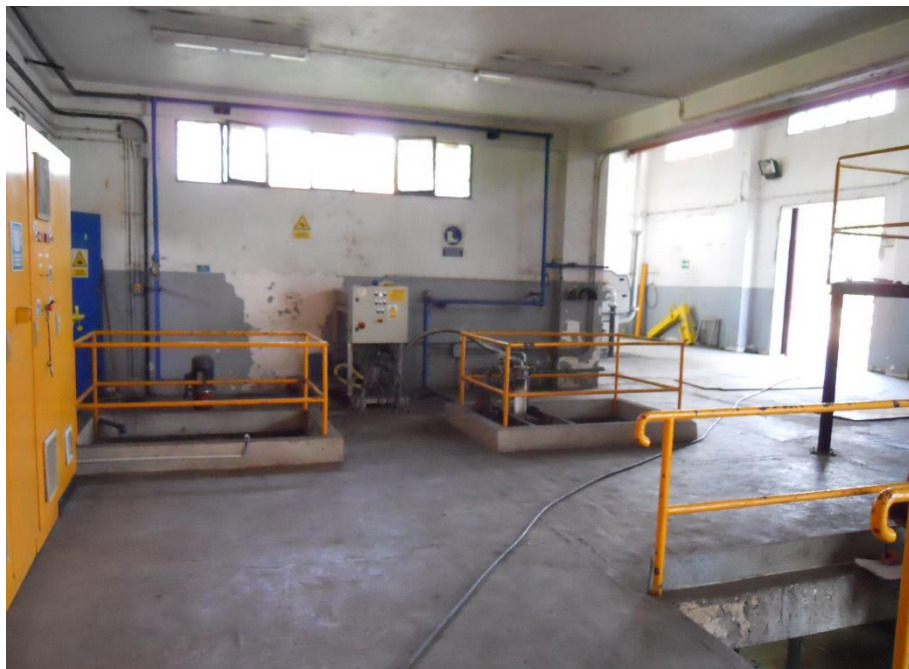
Equipo preparacion polielectrolito
