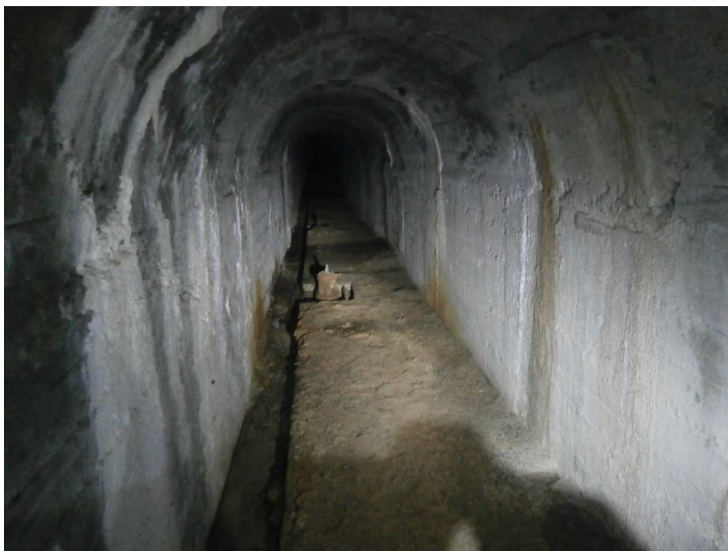
Foto 14. Vista de la galería con las válvulas de los desagües de fondo.
