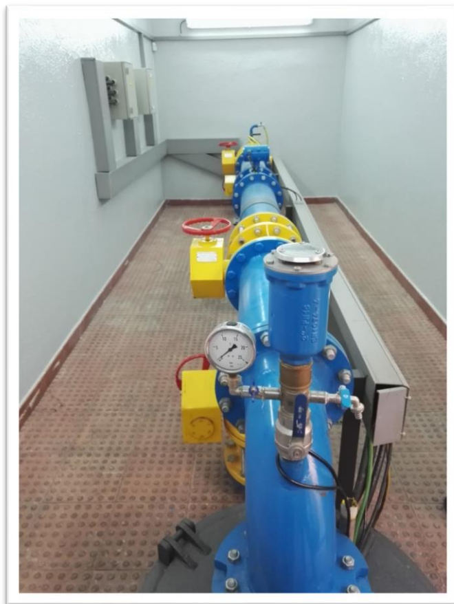
Interior arqueta pozo FA-1
