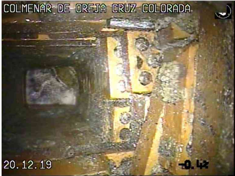
4_fbe1ca6b-6e5e-4c58-9dd7-e1dc1428f06a_20191220_092501_638.jpg, 00:01:22, 14.34 ACOMETIDA EN TECHO SOBRESALIENTE a 12
