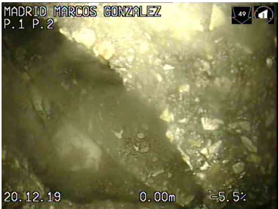
1_b618e15c-ac5c-4303-aab8-4e8ff5d8f6b6_20191220_112416_120.jpg, 00:00:20, 1.20 ACOMETIDA LADO DERECHO SOBRESALIENTE desde 12 a 2
