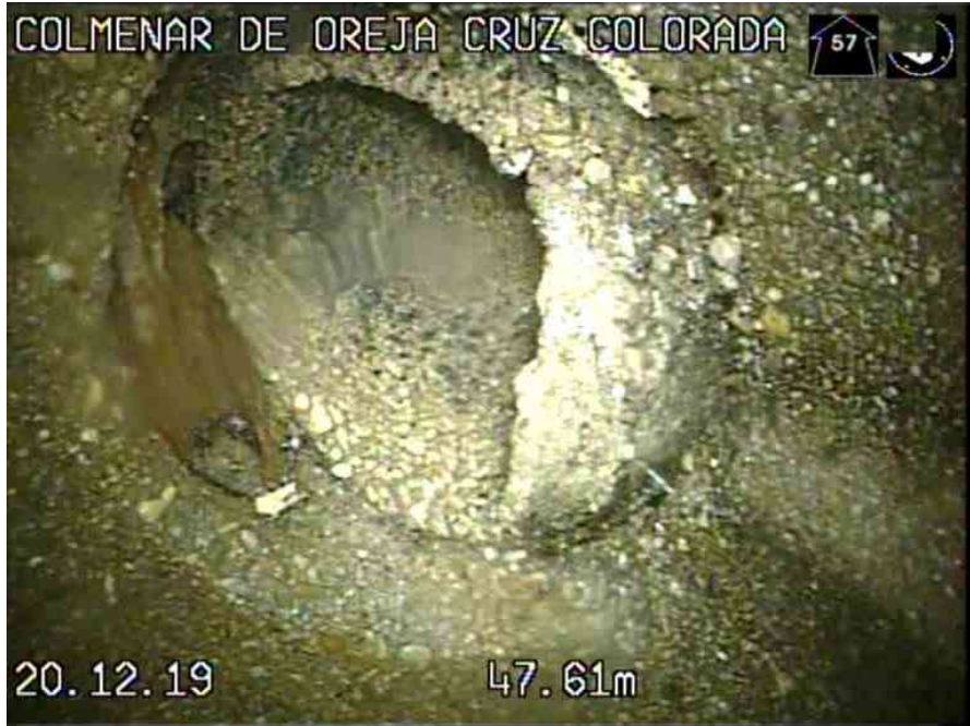
2_b83e7a63-95a8-4bcc-88df-89995e9eed53_20191220_085909_073.jpg, 00:03:40, 47.61 ACOMETIDA LADO DERECHO SOBRESALIENTE desde 12 a 2
