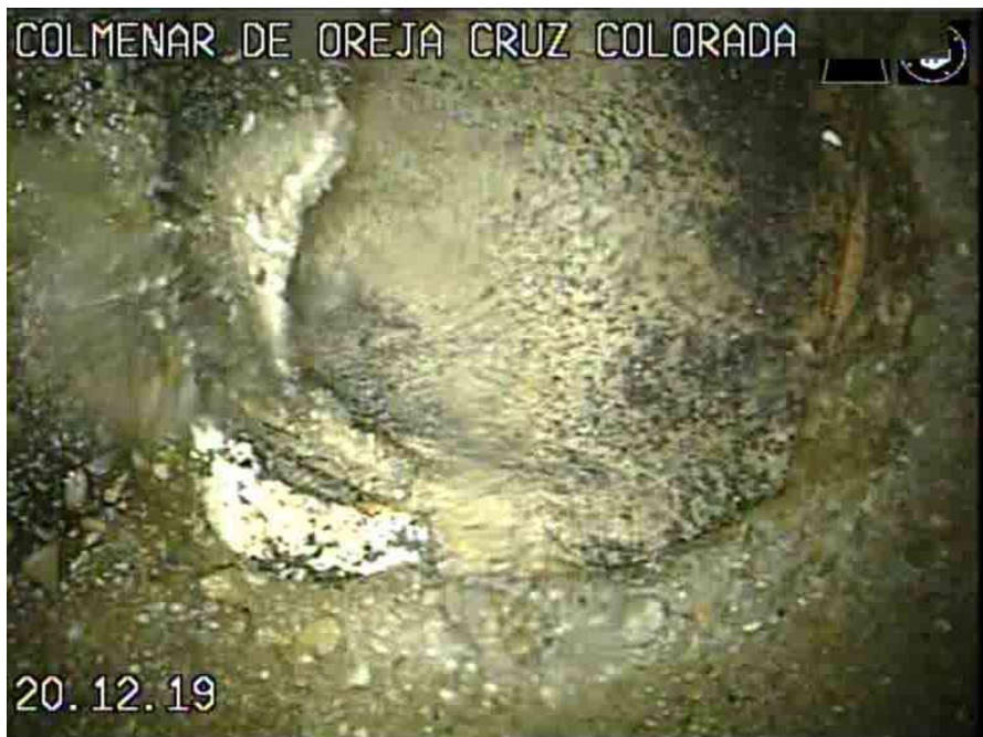
2_cb7396c9-cda9-4e7e-bc5b-4aff25376f0b_20191220_085826_618.jpg, 00:03:09, 41.64 ACOMETIDA LADO IZQUIERDO SOBRESALIENTE desde 10 a 12
