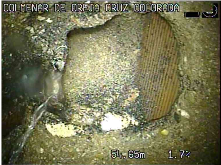
2_352b61df-1ed2-49a9-8da7-9ea0dd064b67_20191220_090033_231.jpg, 00:04:40, 54.65 ACOMETIDA LADO IZQUIERDO SOBRESALIENTE desde 10 a 12
