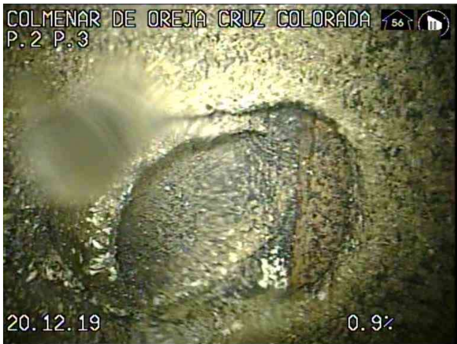
2_509d4374-a667-4f3d-a35b-ff58372efe2c_20191220_085702_672.jpg, 00:02:22, 39.15 ACOMETIDA LADO IZQUIERDO SOBRESALIENTE desde 10 a 12
