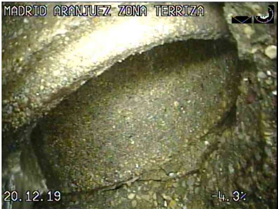
2_ ee62fcc9-49af-46df-8070-3b93f1c8301a_20191220_124213_950.jpg, 00:02:29, 26.18 ACOMETIDA LADO IZQUIERDO SOBRESALIENTE desde 10 a 12
