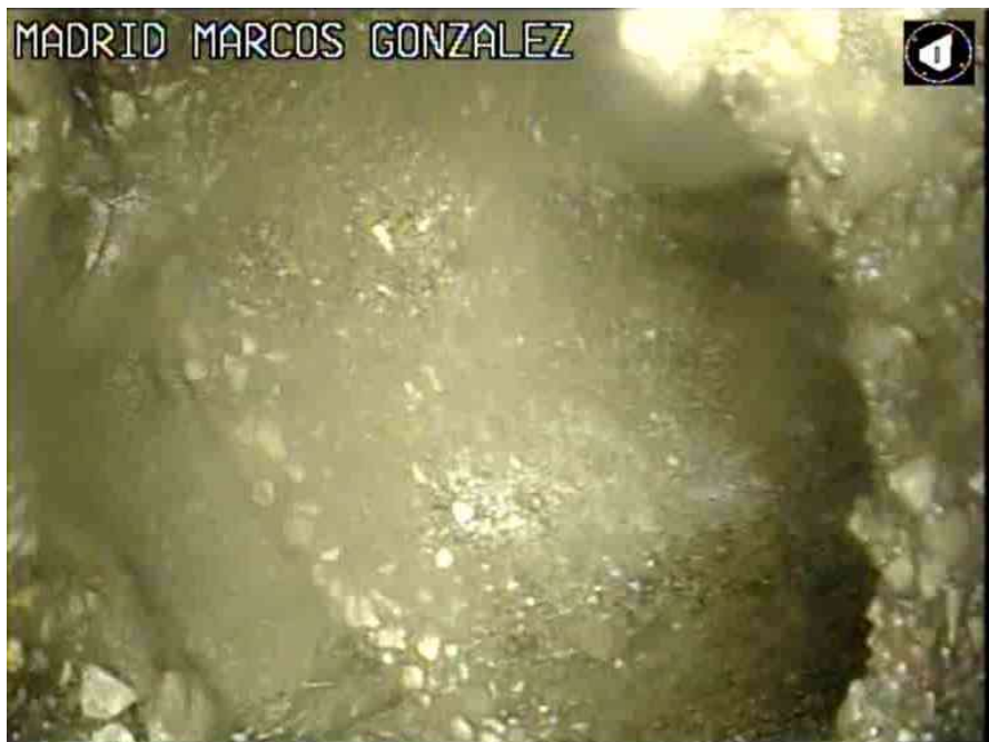
1_e01b6e8d-d21c-422b-b982-8a0ac856cfe9_20191220_112724_046.jpg, 00:02:28, 16.93 ACOMETIDA LADO DERECHO SOBRESALIENTE desde 12 a 2
