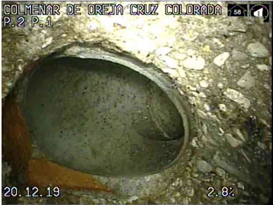
1_e8b5702d-6afa-48b8-8183-f409183446c9_20191220_083103_195.jpg, 00:00:50, 4.20 ACOMETIDA LADO DERECHO SOBRESALIENTE desde 12 a 2
