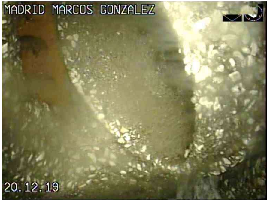
1_4b050460-4654-4cc4-9a57-59755e7ada6e_20191220_113203_601.jpg, 00:06:15, 53.37 ACOMETIDA LADO DERECHO SOBRESALIENTE desde 12 a 2
