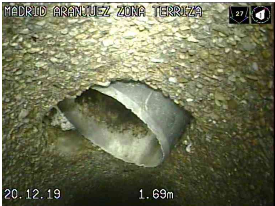
3_234e6185-6a79-41d6-9b65-988b326ff021_20191220_125106_471.jpg, 00:00:12, 1.69 ACOMETIDA LADO DERECHO SOBRESALIENTE desde 12 a 2
