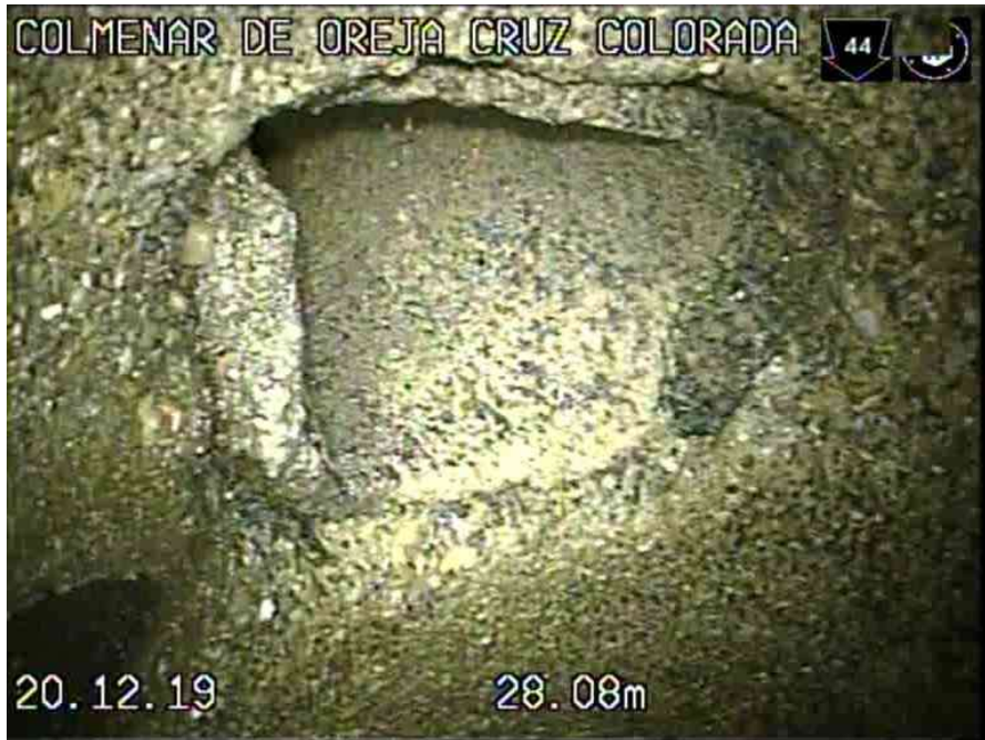
2_7035e071-09cf-4bcf-9a73-03f76ea0d212_20191220_085355_112.jpg, 00:00:45, 28.08 ACOMETIDA LADO DERECHO SOBRESALIENTE desde 10 a 12
