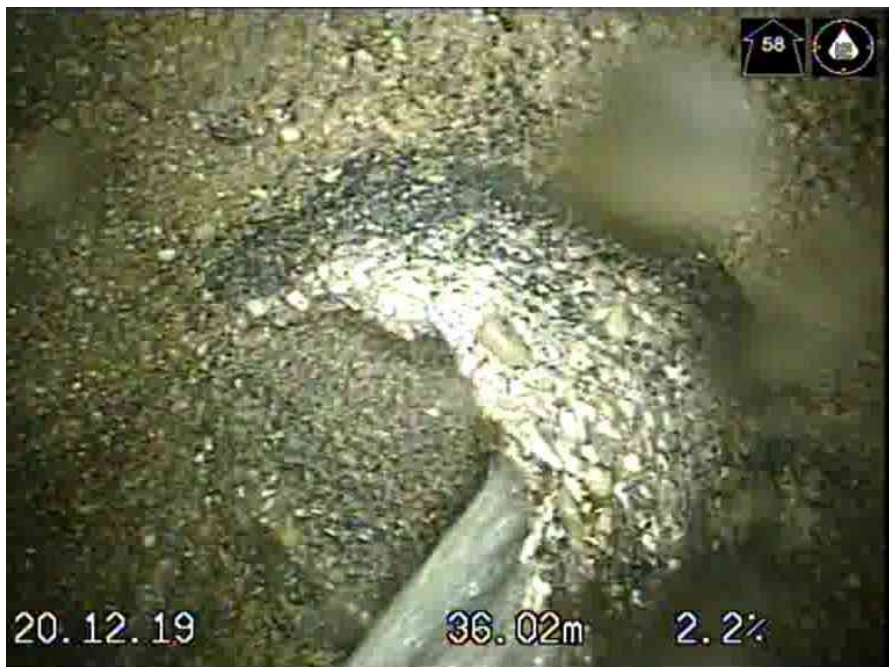
2_cdabb09c-5891-407c-8137-3151ce4306bd_20191220_085528_051.jpg, 00:01:52, 36.02 ACOMETIDA DE IMBORNAL A LADO DERECHO SOBRESALIENTE desde 12 a 2
