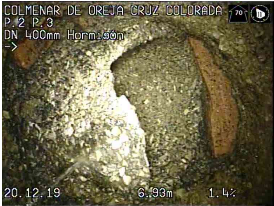
2_b62d8263-e169-4cf3-a40c-e0287c0ba815_20191220_083600_180.jpg, 00:00:51, 6.93 ACOMETIDA LADO IZQUIERDO SOBRESALIENTE desde 10 a 12
