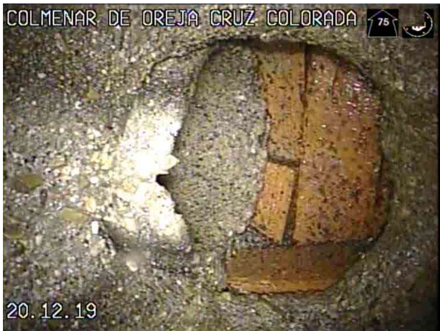
2_13f1c0c4-1280-4604-98e5-a3509fc91ce6_20191220_083724_175.jpg, 00:02:02, 19.73 ACOMETIDA LADO IZQUIERDO SOBRESALIENTE desde 10 a 12
