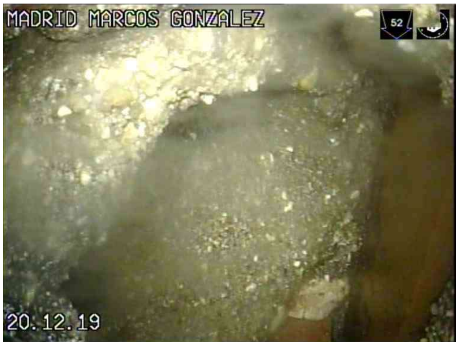
4_193893ec-9c43-496a-a5c2-373ff80c8c92_20191220_114644_938.jpg, 00:00:51, 9.10 ACOMETIDA LADO IZQUIERDO SOBRESALIENTE
