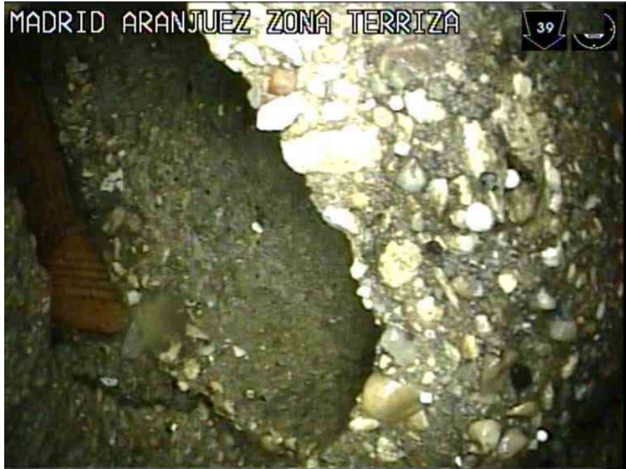
3_24751ea7-0bc7-4b3e-9edc-62091ec7e9bb_20191220_125200_829.jpg, 00:00:54, 9.18 ACOMETIDA LADO DERECHO SOBRESALIENTE desde 12 a 2
