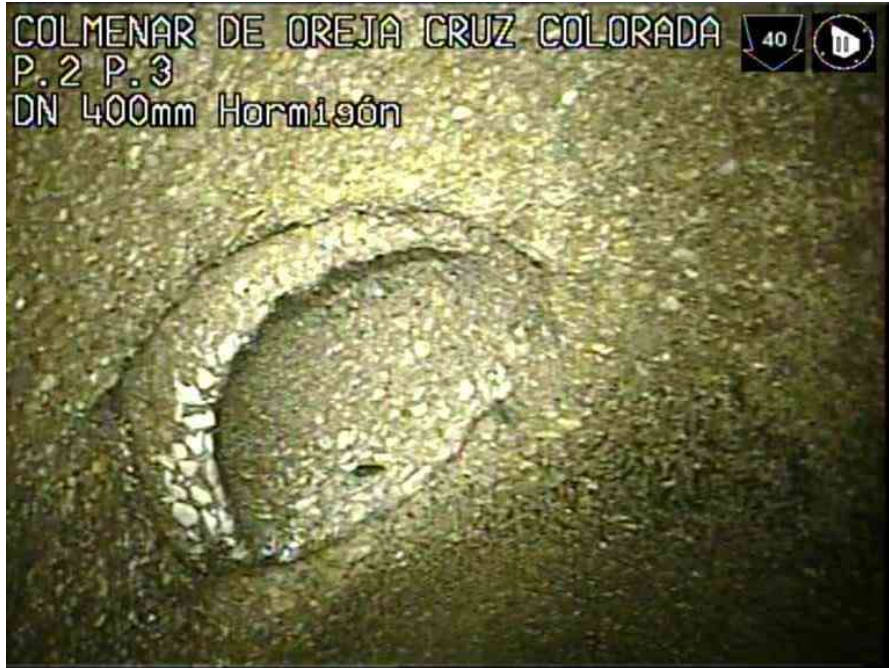
2_7c835dd2-188d-4adf-96b9-bd37ca7b0eb5_20191220_084118_094.jpg, 00:00:00, 20.67 ACOMETIDA LADO IZQUIERDO SOBRESALIENTE desde 10 a 12
