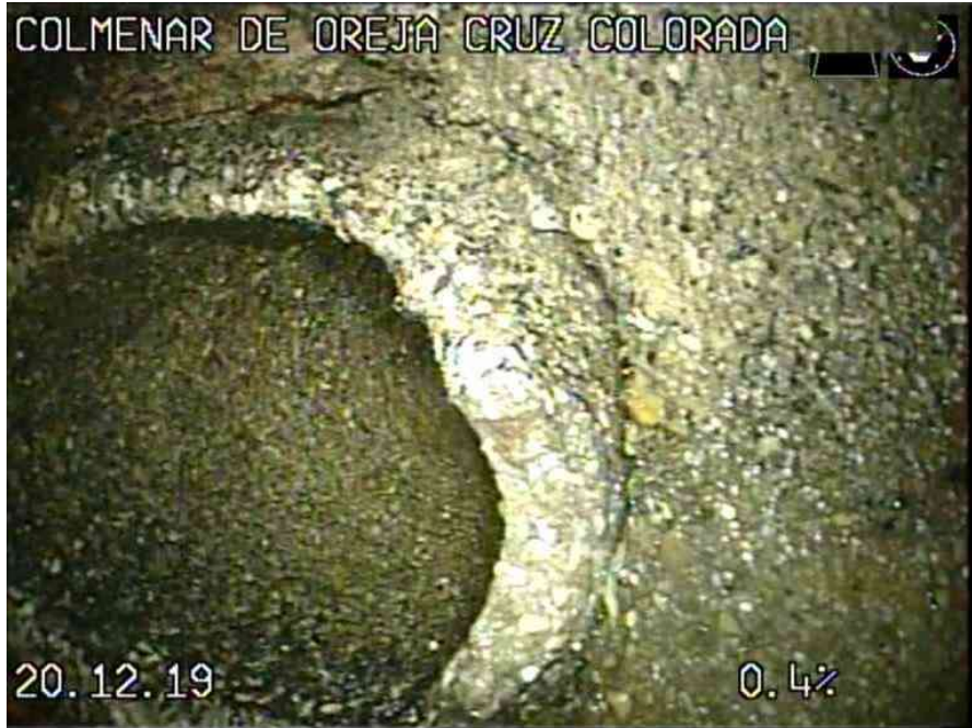
2_db677c49-b544-4a50-8014-accb98cd1296_20191220_085452_020.jpg, 00:01:25, 34.35 ACOMETIDA LADO DERECHO SOBRESALIENTE desde 12 a 2
