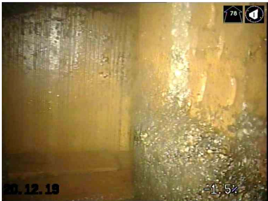
2_5e8234da-7323-438a-b261-c7689b1a8b30_20191220_113428_036.jpg, 00:00:27, 1.32 ACOMETIDA EN TECHO SOBRESALIENTE a 12
