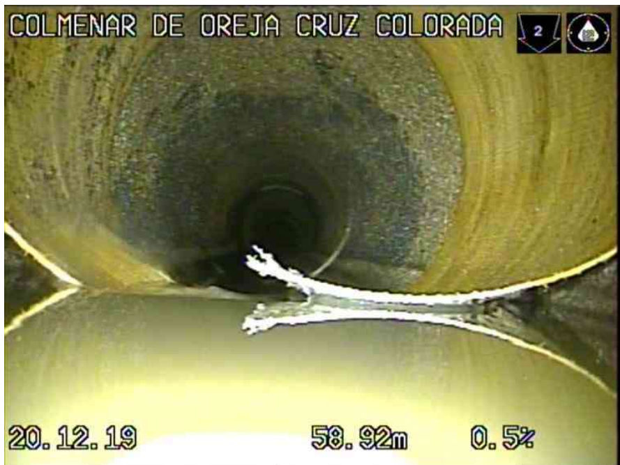
2_17223de7-601e-4b05-afe6-869416f355a9_20191220_090137_524.jpg, 00:05:11, 58.92 REPARACION POR MANGA TOTAL MAL INSTALADA
