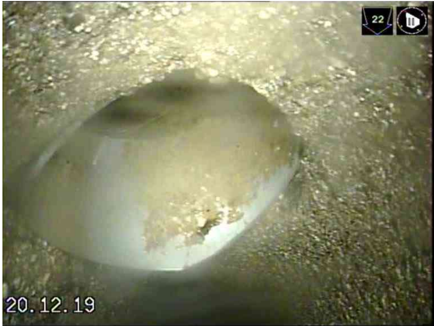
4_92c2bb7d-969d-468a-9627-12c2e228bdce_20191220_114854_128.jpg, 00:02:19, 21.51 ACOMETIDA LADO IZQUIERDO SOBRESALIENTE desde 10 a 12
