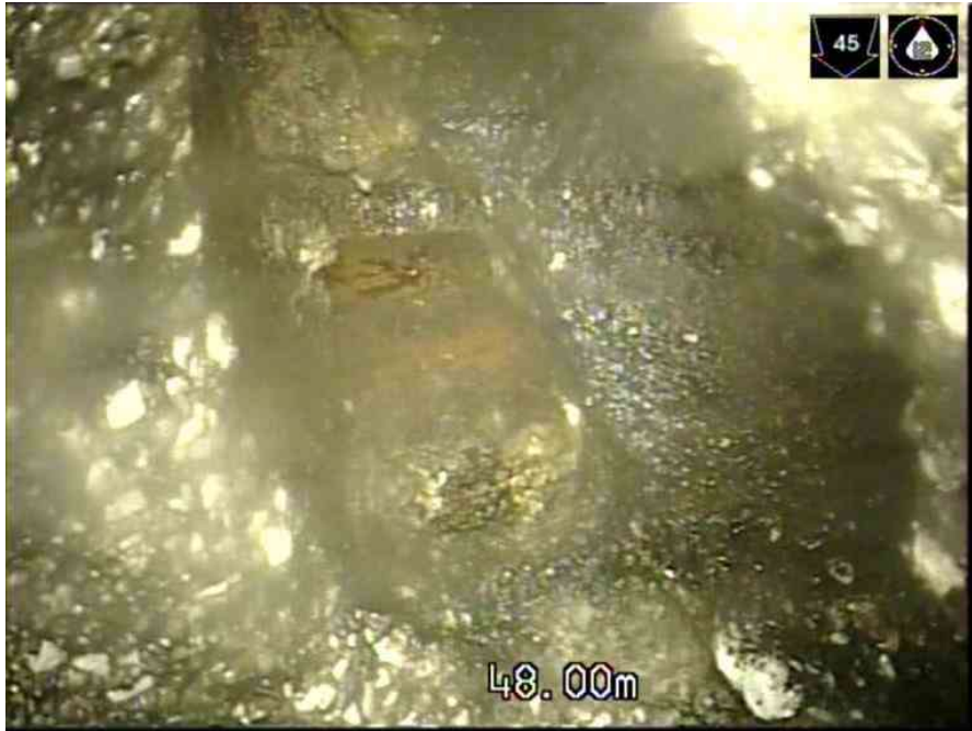
1_144436cc-7900-40c2-b659-f832ea7c6b5b_20191220_113102_722.jpg, 00:05:31, 48.00 ACOMETIDA LADO DERECHO SOBRESALIENTE desde 12 a 2
