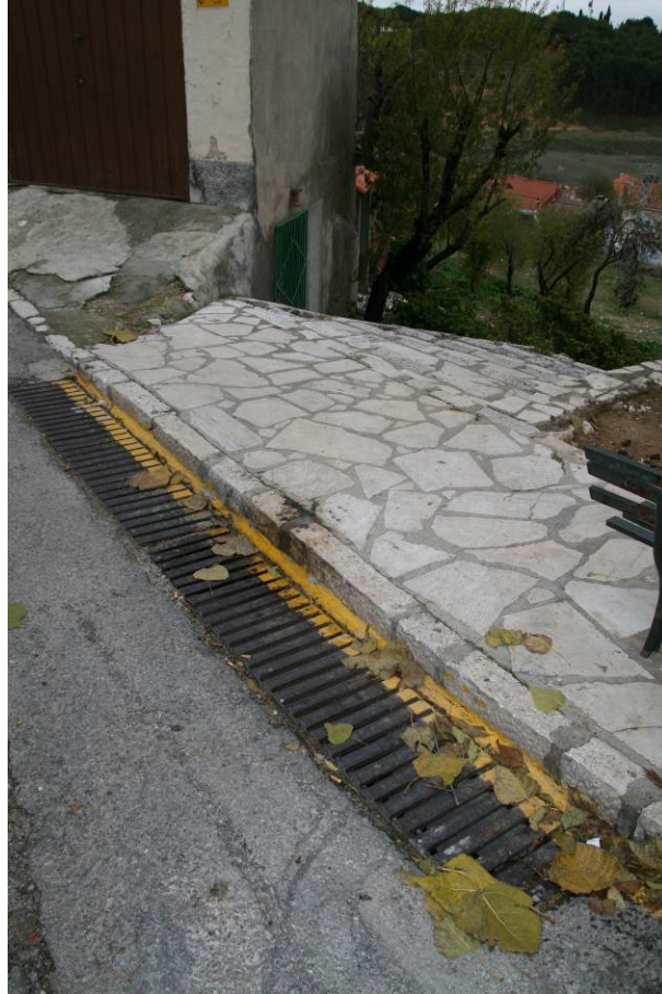
Fotografía nº 20.- Imbornal corrido en la C/ Marcos González
