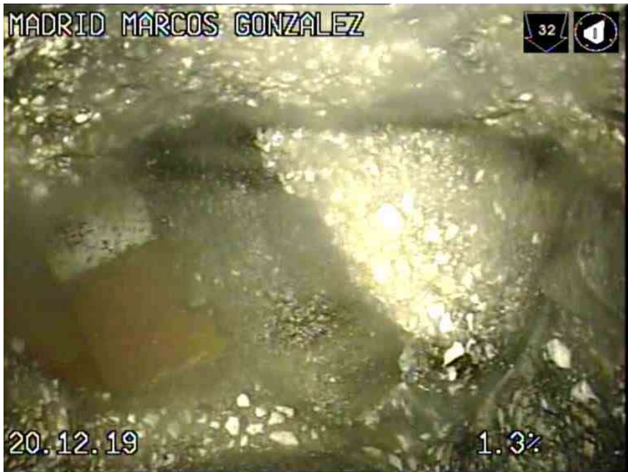
1_7c07d505-0b55-436d-9223-4e39a70ddde6_20191220_113131_264.jpg, 00:05:51, 50.55 ACOMETIDA LADO DERECHO SOBRESALIENTE
