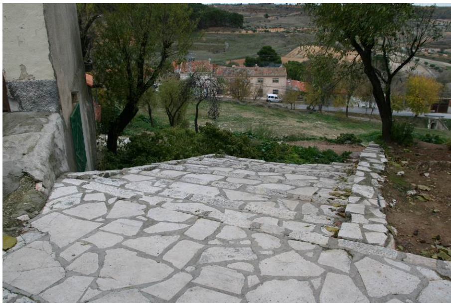
Fotografía nº 21.- Escalera al inicio del tramo (que será necesario reponer)
