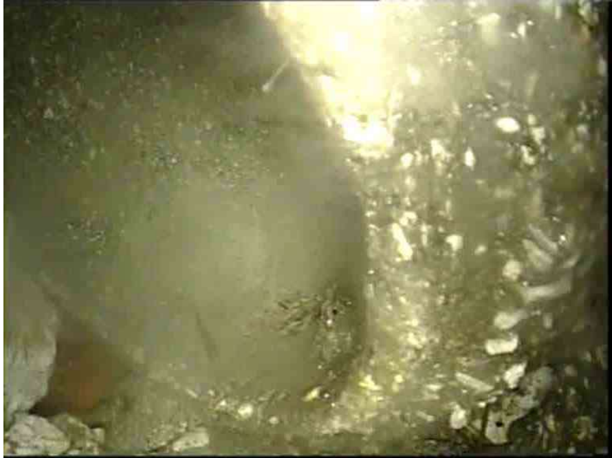
1_a1d0e8cb-56ca-458f-8db4-023e6777e71e_20191220_112848_615.jpg, 00:03:38, 29.77 ACOMETIDA LADO DERECHO SOBRESALIENTE desde 12 a 2
