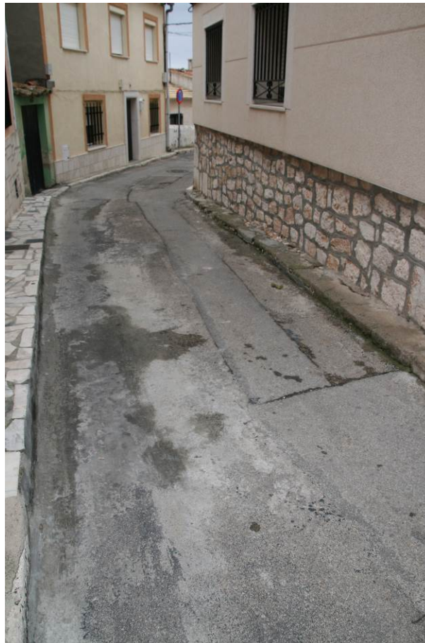
Fotografía nº 11.- Tramo de la C/ Marcos González aguas arriba de la cámara de carga
