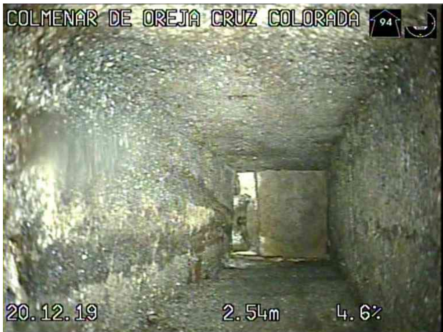
5_d4c1abfa-1312-4d68-b49a-1a7e1f863cdb_20191220_091654_083.jpg, 00:00:43, 2.54 ACOMETIDA EN TECHO SOBRESALIENTE a 12
