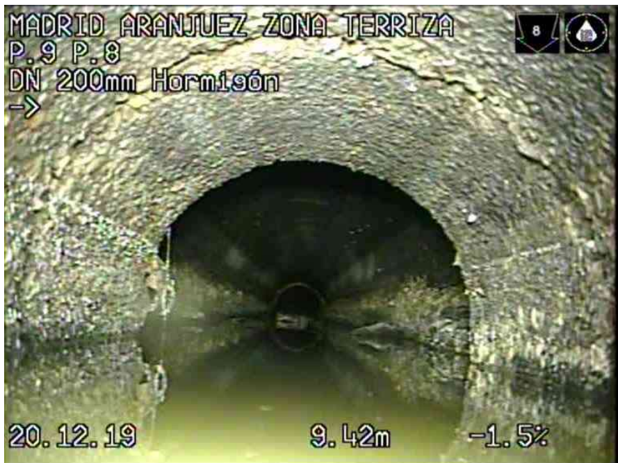
3_9689a7b1-5126-4eec-8dd9-4d79c3ecbd11_20191220_125256_141.jpg, 00:00:54, 9.18 ACOMETIDA LADO DERECHO SOBRESALIENTE desde 12 a 2
