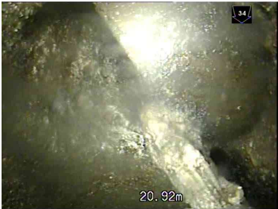
4_92ce27dd-8871-48fe-ab59-b1e9ed657813_20191220_114829_333.jpg, 00:02:06, 20.92 ACOMETIDA LADO DERECHO SOBRESALIENTE desde 12 a 2
