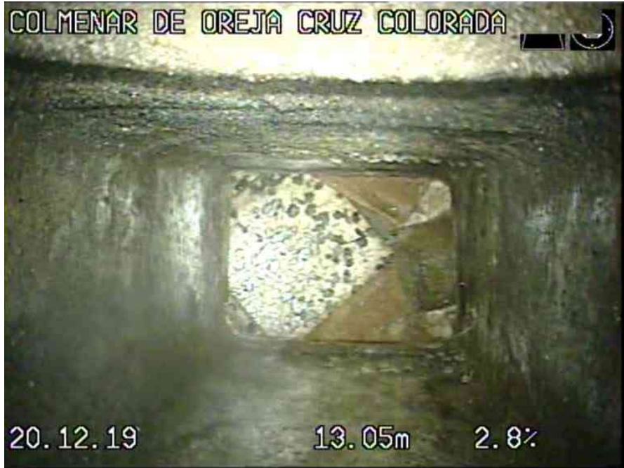
3_a13e9943-2f88-4881-b8d7-653dbaf4eb48_20191220_092212_138.jpg, 00:01:56, 13.05 ACOMETIDA EN TECHO SOBRESALIENTE a 12
