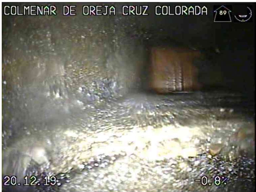
4_8a0acdbd-4374-4053-9824-fb026aeab706_20191220_092410_516.jpg, 00:00:38, 4.52 ACOMETIDA EN TECHO SOBRESALIENTE a 12
