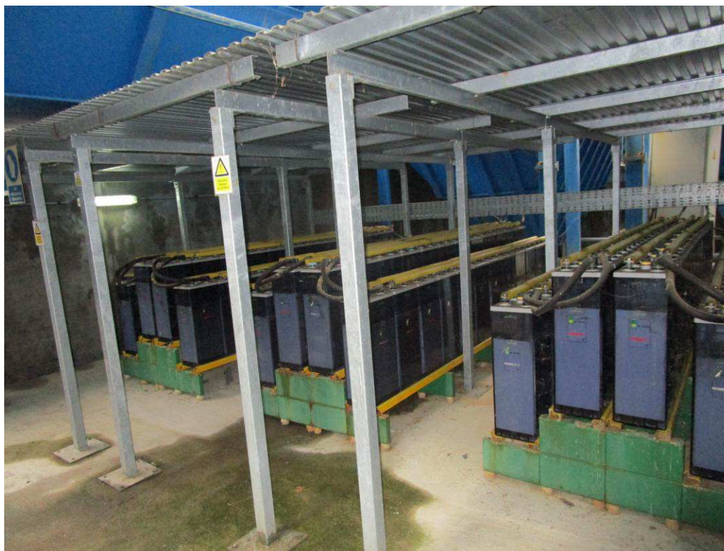
19.- Bancos de baterías para almacenamiento de la energía solar. Ubicación bajo tratamiento biológico.
