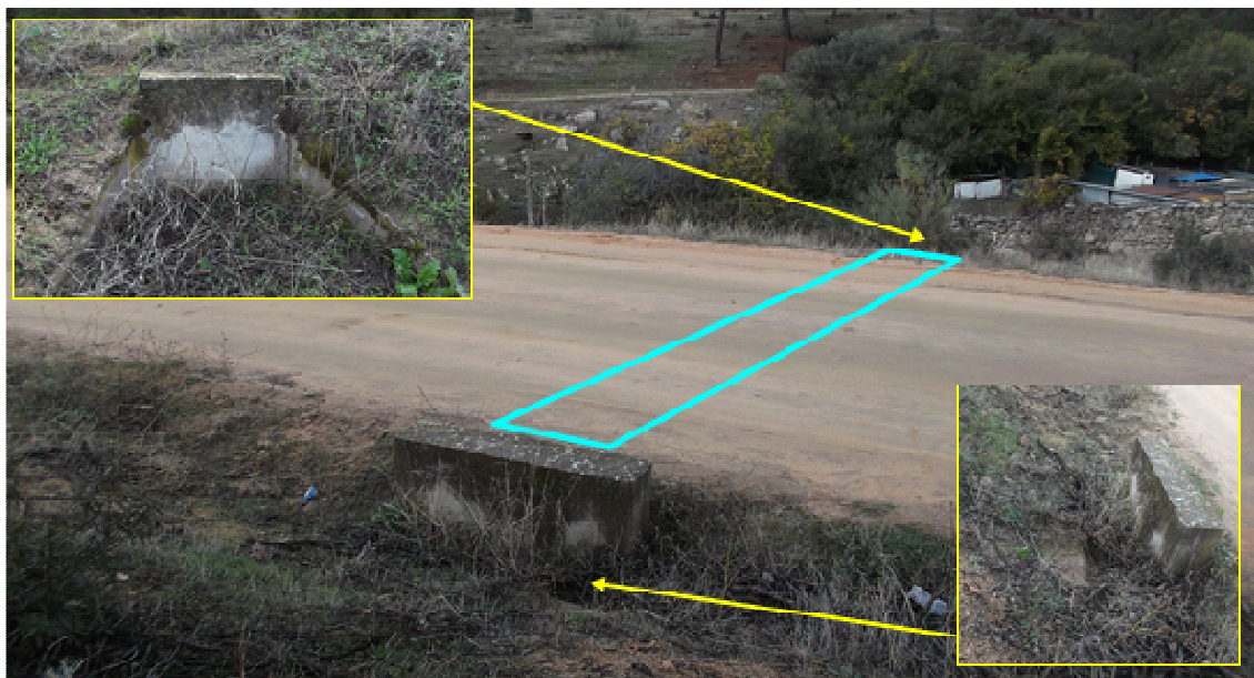
8.- Segundo cruce de drenaje , con detalle de sus bocas prácticamente colmatadas
