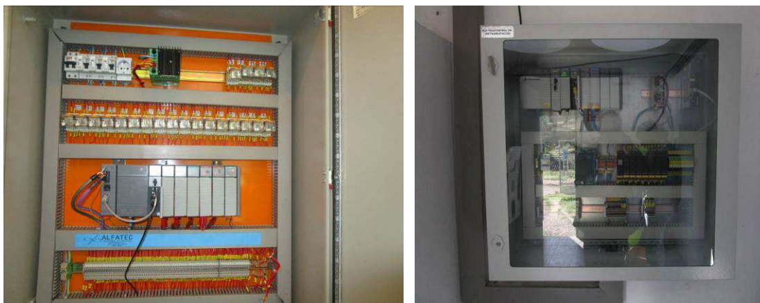
PLC Control Proceso (izquierda) y PLC Instrumentación (derecha), en edificio de servicios.
