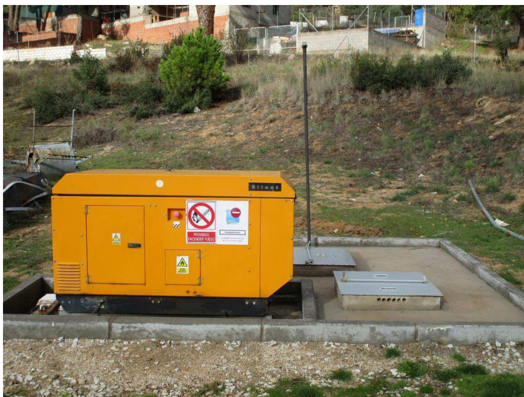
22.- Grupo electrógeno 11kVA de emergencia y depósito de combustible
