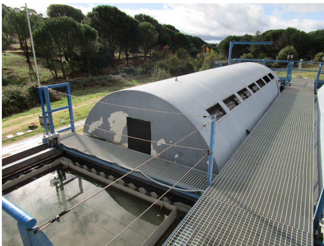
26.- Vista general de una de las dos líneas de tratamiento: decantador primario y biodisco
