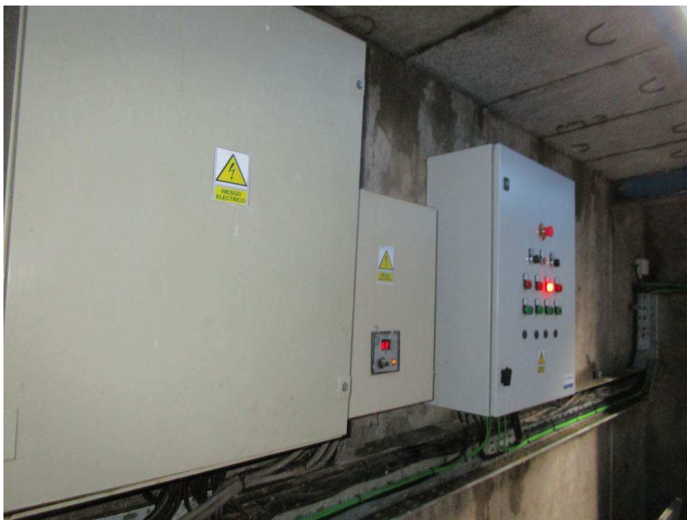
21.- Cuadros eléctricos bajo tratamiento biológico: conmutador alimentación baterías-grupo, control nivel de combustible grupo electrógeno y cuadro local bombas fango helicoidales (en orden de izda. a drcha.)
