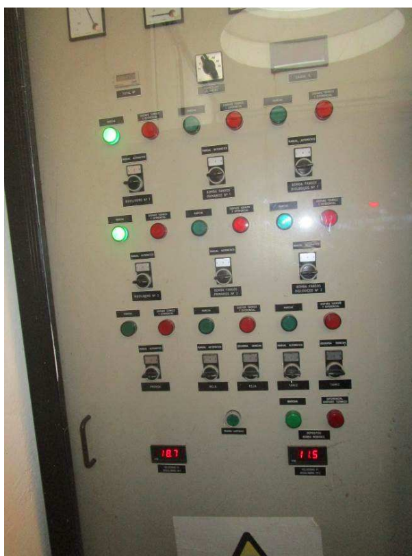
24.- Cuadro General de Distribución, ubicado en edificio de servicios (a la derecha de la entrada de la planta)
