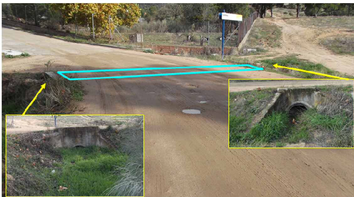
6.- Zona donde concluye el trazado urbano y comienza el camino de tierras, en su tramo inicial antes de conectar con el Camino de Valdemaqueda a Villaescusa, donde se aprecia el primer cruce de drenaje transversal al camino. Vistas del estado de esta obra de drenaje.
