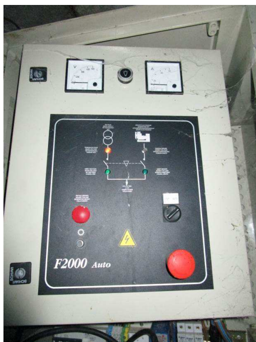
23.- Interior cuadro conmutación fuente de energía: baterías - grupo electrógeno. La salida de éste cuadro alimenta al cuadro general de distribución de la planta.
