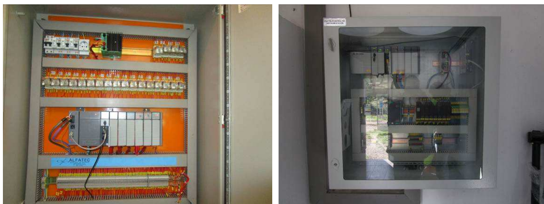
25.- PLC de control general (izq.) y PLC de instrumentación (dcha.). Ubicados junto al CGD en edificio de servicios.
