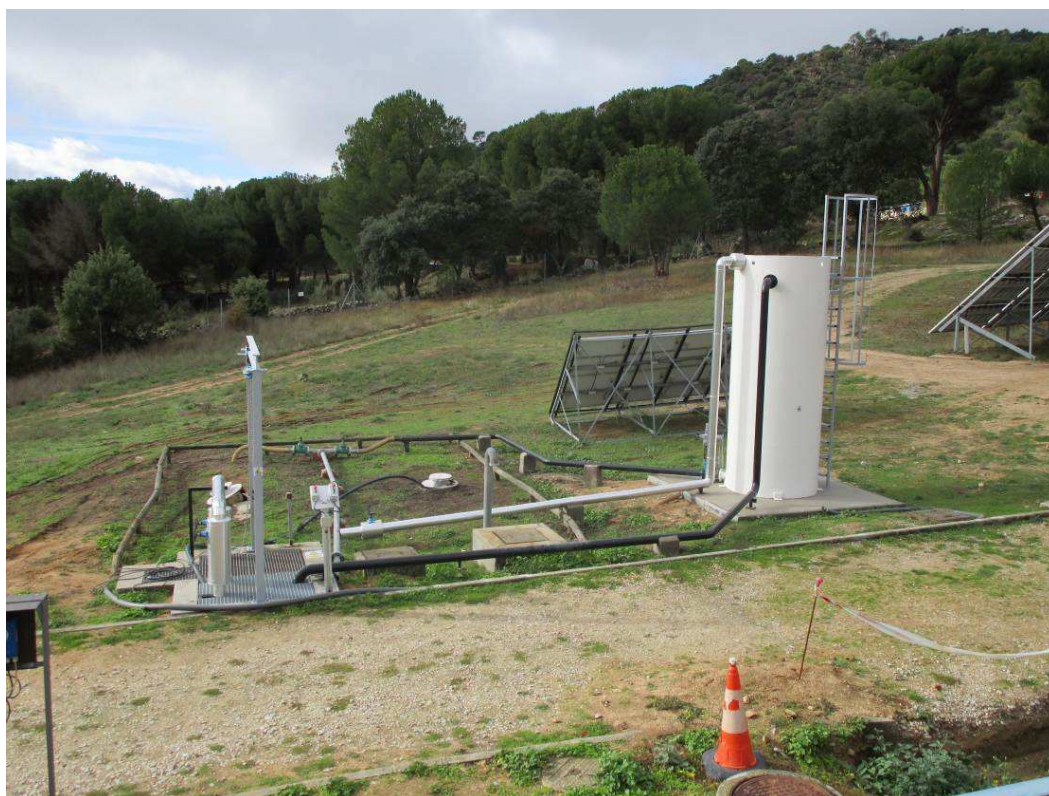
27.- Espesador estático de reciente instalación y depósitos enterrados de fango
