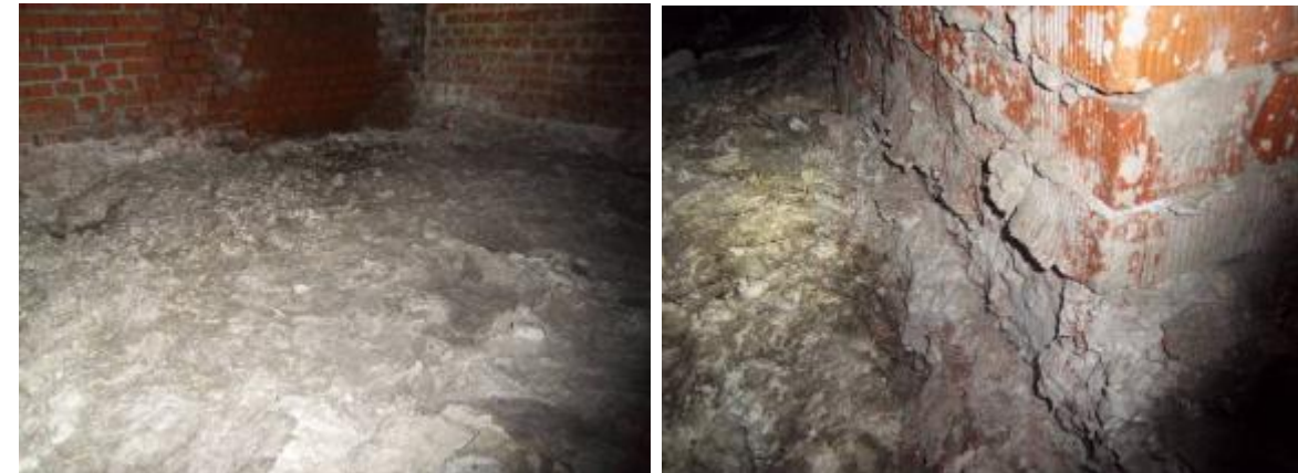
Bajo andén 2: Mortero alterado y roto (izqda.). Alteración muros bajo andén (dcha.)
