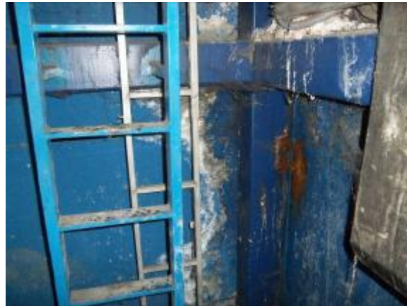
Foso ascensor: agua y sales en paramento izquierdo
