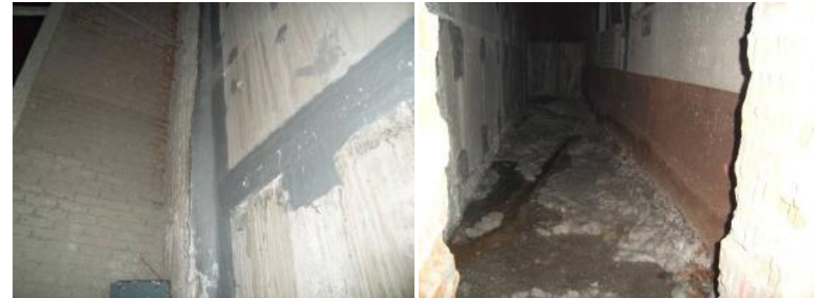
Junta de muro lateral con pantalla estación y detalle impermeabilización (izqda.). Estado de la solera con acumulación de sales
