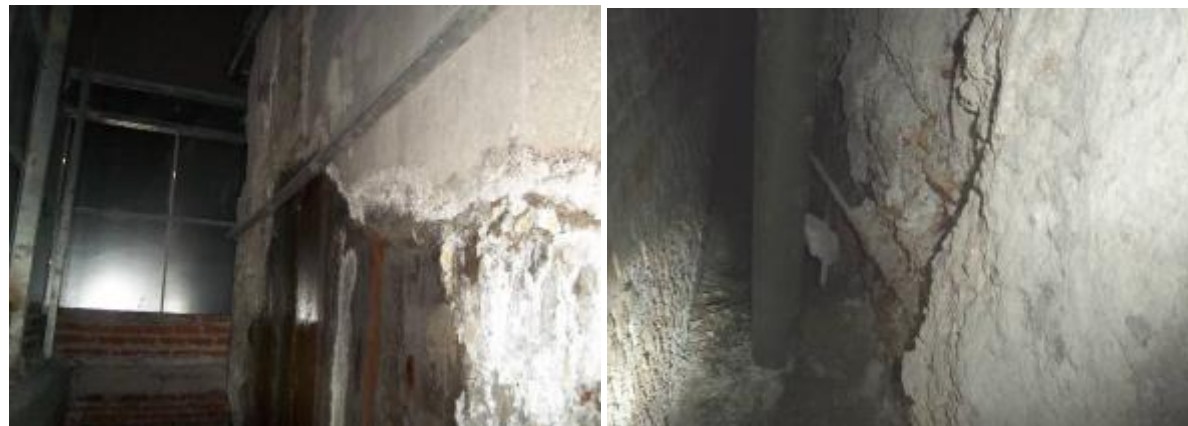
Izqda.: Muro rampa abombado y fisurado en parte inferior. Filtración por fisura con sales.
