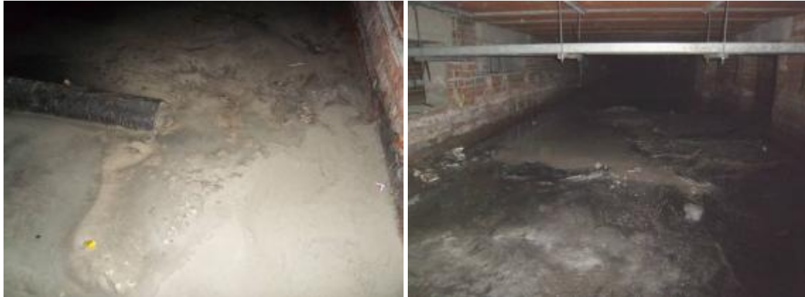
Bajo andén 1: Tubo transversal de PVC vertiendo agua (izqda.) y zona encharcada próxima a la plataforma de vías (dcha.)
