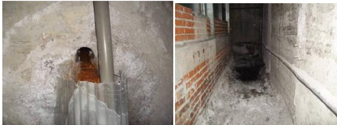
Izqda.: Entrada de agua por taladro en pantalla andén 1
