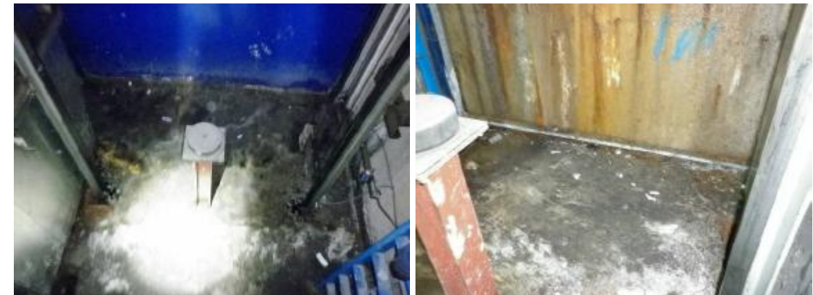
Foso ascensor: solera con agua y sales (izqda.) y detalle mortero alterado (dcha.)
