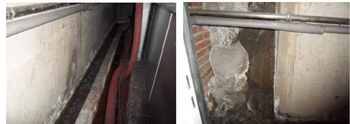
Cámara bufa: canaleta inundada sin relleno (izqda.). Filtración en junta muro con pantalla
