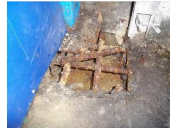
Desagüe foso ascensor acceso. Con agua y parcialmente colmatado.
