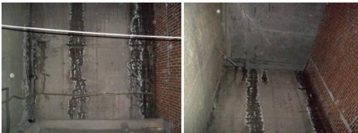
Humedades en el muro de la rampa: por juntas laterales (izqda.) y con losa superior (dcha.)
