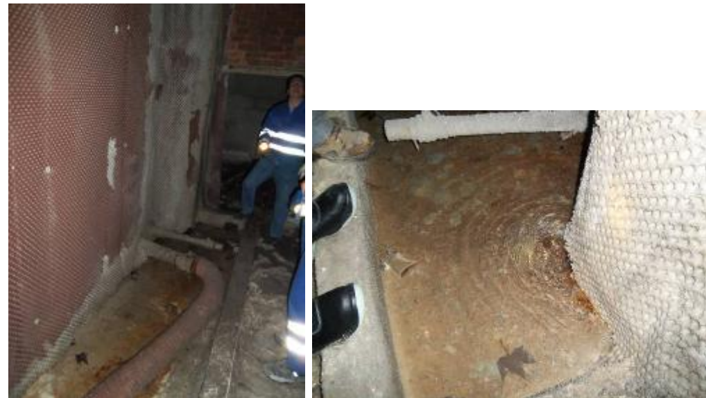
Junta de muro lateral con pantalla estación: lámina drenante y detalle filtración al pie de la misma
