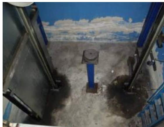
Foso ascensor vestíbulo-andén 1: con restos de humedades.
