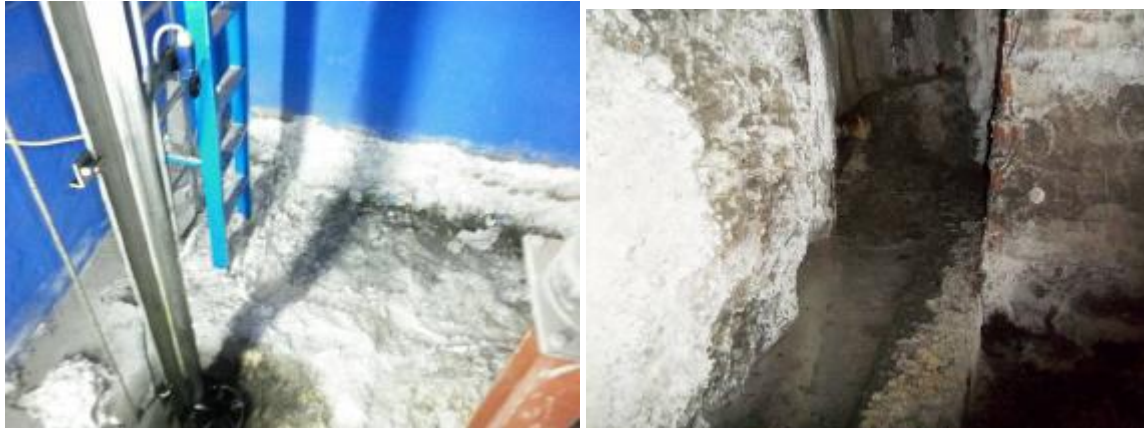
Izqda.: Foso ascensor vestíbulo andén 2. Acumulación de sales
