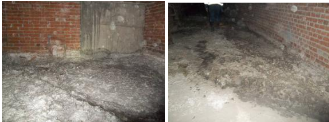
Bajo andén 1: Acumulación de sales bajo salida de emergencia (izqda.). Mortero alterado y roto (dcha.)
