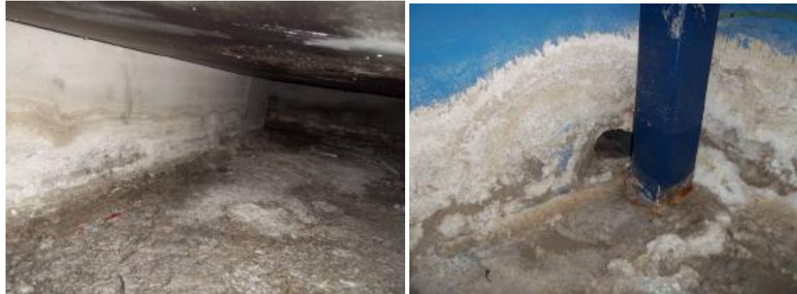
Izqda.: Foso escalera mecánica nº 7 (andén 1): seco, con sales. Dcha.: Foso ascensor (vestíbulo-andén 2): sales y desagüe en paramento lateral.
