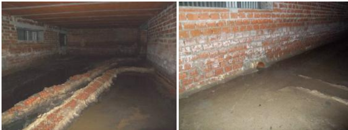
Bajo andén 2: Zona inundada con canaleta transversal de fábrica (izqda.) y Zona encharcada con detalle desagüe (derecha)
