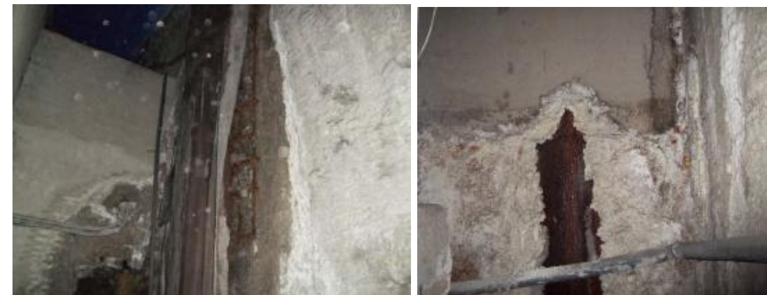
Izqda.: Pantalla frontal final en entronque con túnel, con filtración. Dcha.: Cámara bufa tras andén 2: filtración con sales en muro cierre de rampa
