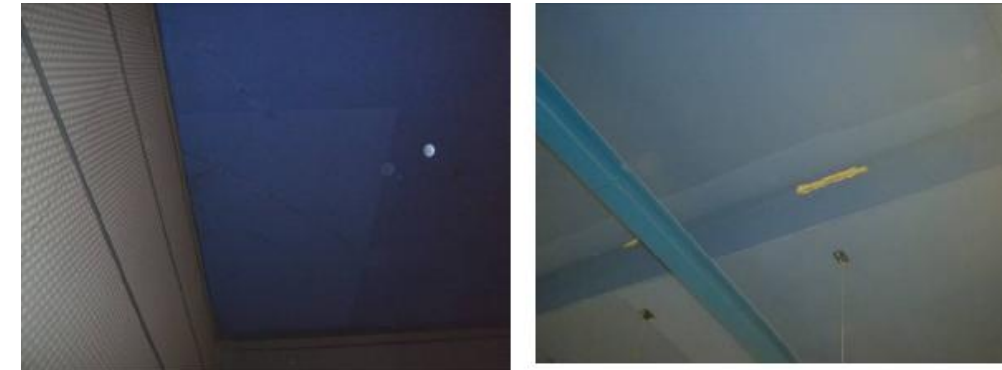
Izqda.: Fisuras y goteras en losa de cables tras la salida de emergencia
