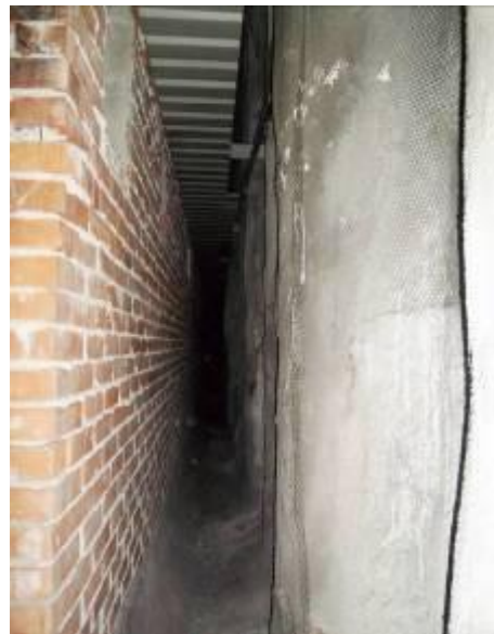
Cámara bufa a nivel vestíbulo (detalle malla de gallinero sin gunitar)
