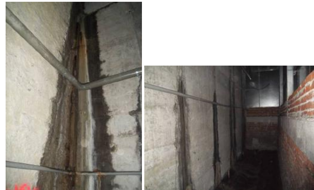
Cámara bufa andén 2: filtración en junta entre pantalla zona ancha y muro de cierre de rampa (izquierda) y filtración a través agujeros para espadines.
