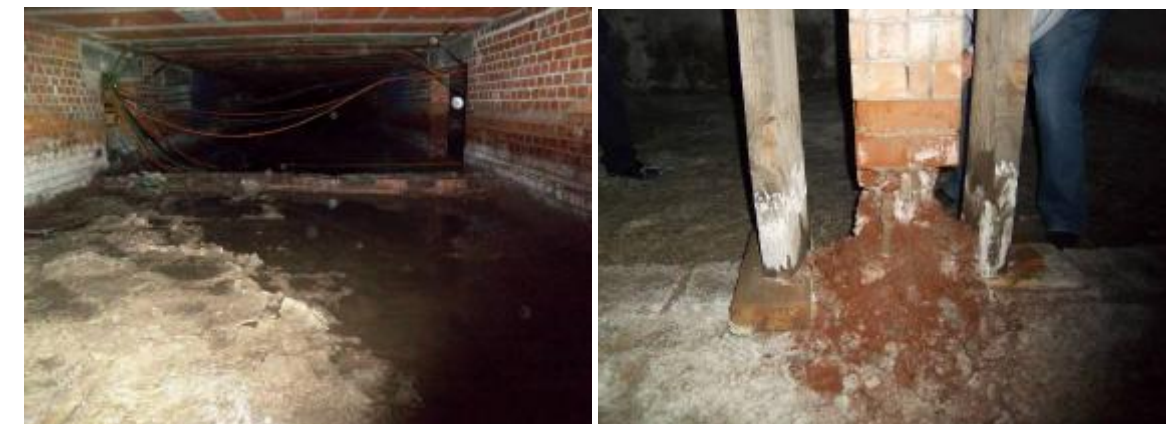
Bajo andén 2. Inundado y acumulación de sales (izqda.) y alteración de pilar (apeados) por acumulación de sales
