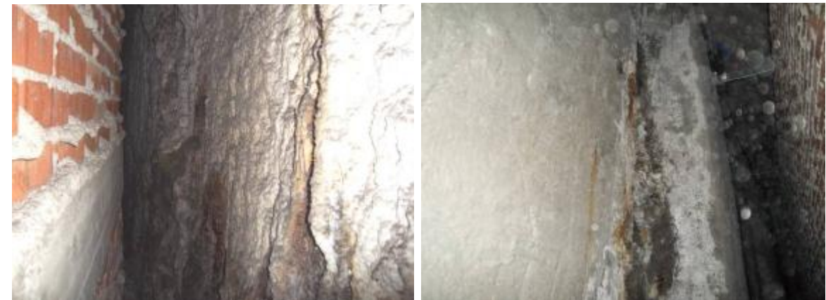
Izqda.: Cámara bufa andén 1, hormigón de pantallas alterado (tras cuarto nº 8). Dcha.: Cámara bufa andén 2. Filtración tras cuarto de enclavamiento por "tecleo" de pantallas.
