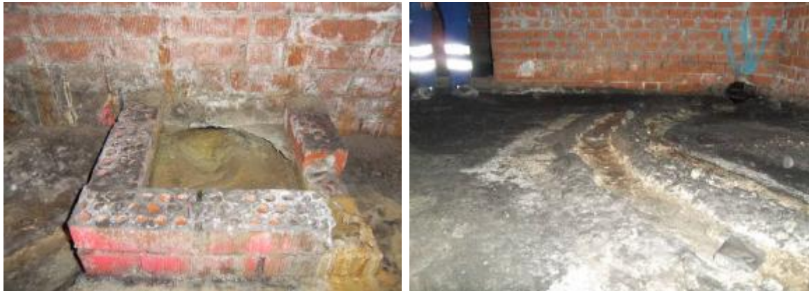
Derecha: arqueta de desagüe colmatada, con mal funcionamiento (andén 1)
