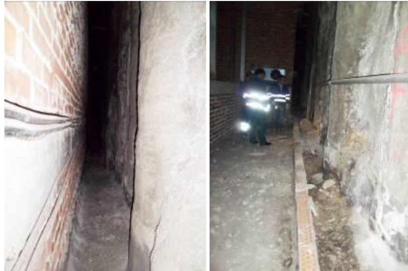
Cámara bufa bajo nivel andén 2. Izquierda: seca (zona detrás de los cuartos). Derecha: canaleta con material caído (zona detrás de las escaleras)
