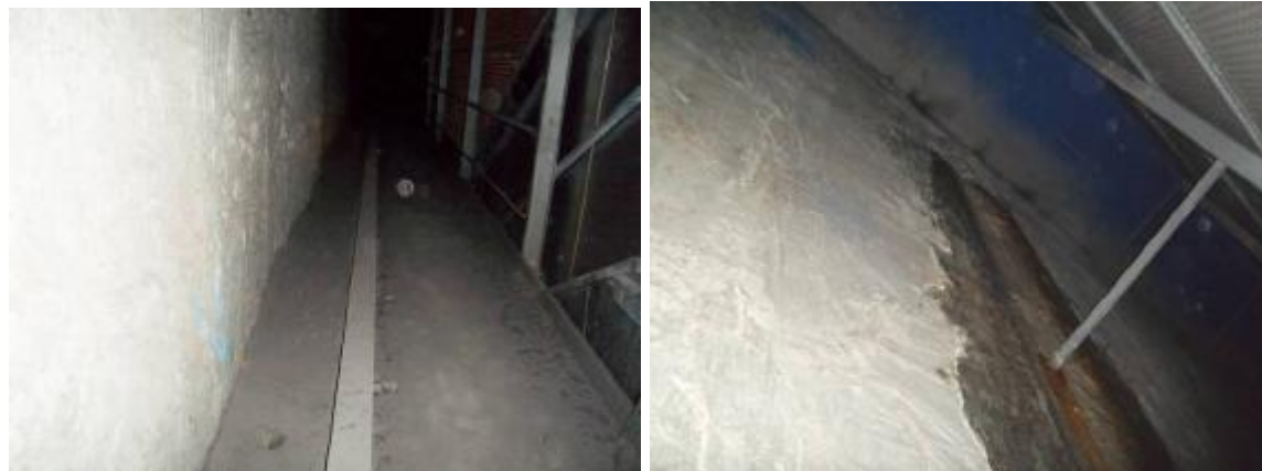
Canaleta en zona ancha (izqda.) y coquera y filtración (dcha.)
