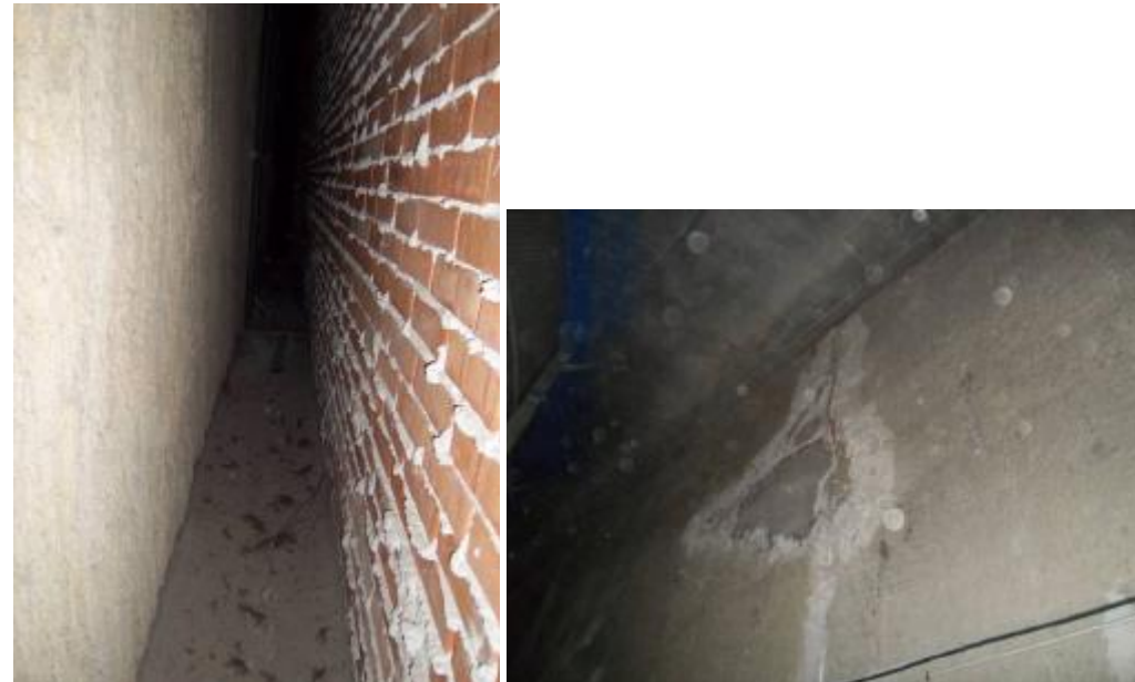
Izqda.: aspecto cámara bufa tras cuartos. Dcha.: coquera reparada con restos de sales en humedad antigua
