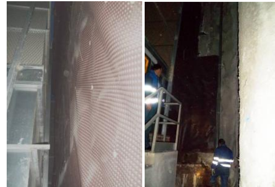
Muro de cierre de la rampa de extracción de tierras: presencia de lámina drenante (izqda.) y surgencia de agua junto pilotes recinto estación (dcha.)
