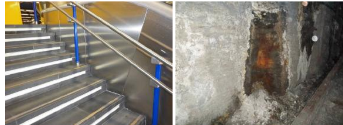
Izqda.: escaleras vestíbulo-andén 2. Escalera fija despegada de lateral de escalera mecánica nº 5. Dcha.: Cámara bufa tras andén 1. Tecleo de pantallas con filtración y arrastre de material.
