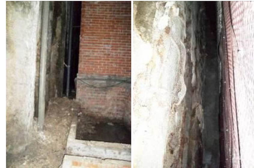
Izquierda: cámara bufa en andén 1 (zona de escaleras) con canaleta totalmente colmatada. Derecha: salida de emergencia andén 2, cámara bufa en nivel pasillo de conexión: lámina drenante en tabiquería
