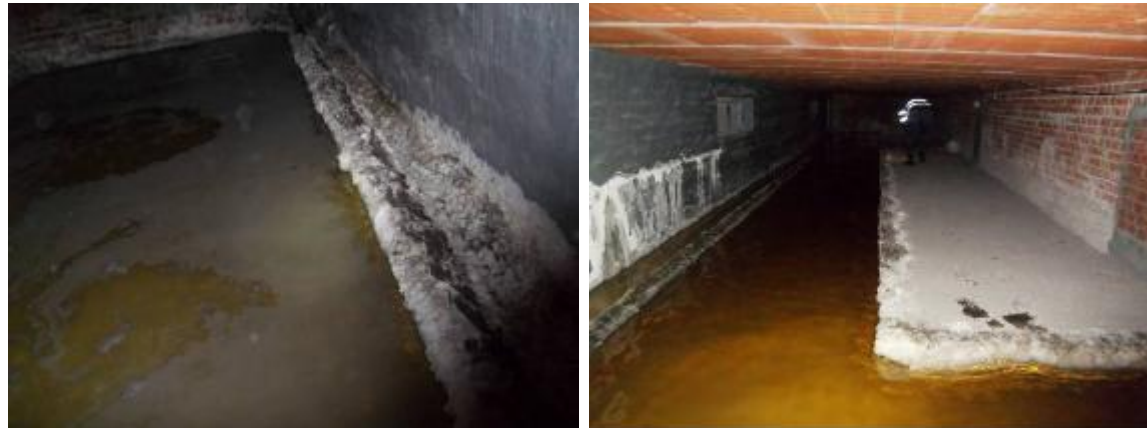
Bajo andén 2: Inundado y canaleta longitudinal inoperativa.
