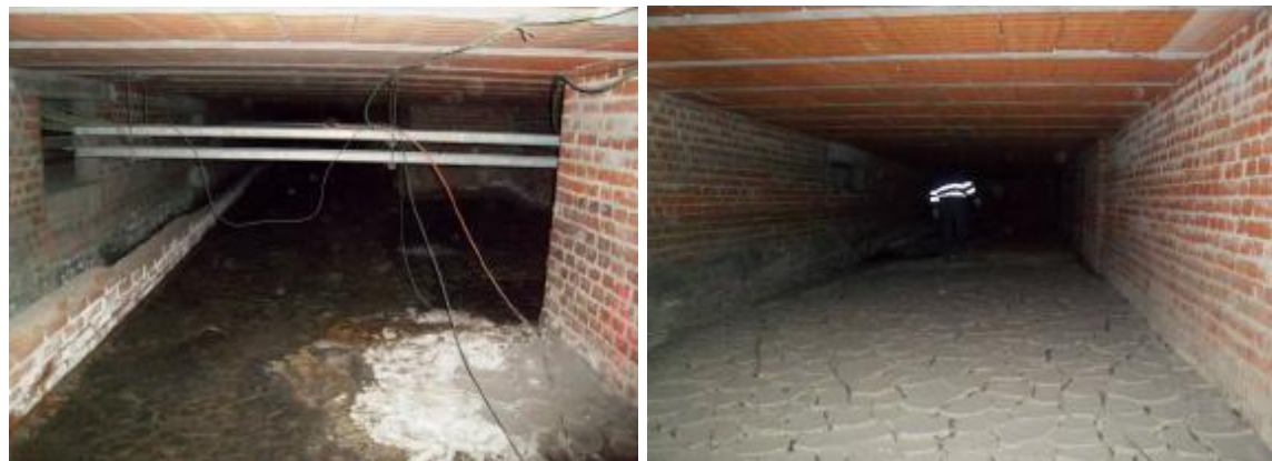
Bajo andén 1 (izqda.): húmedo, localmente encharcado, con barro y presencia de sales.
