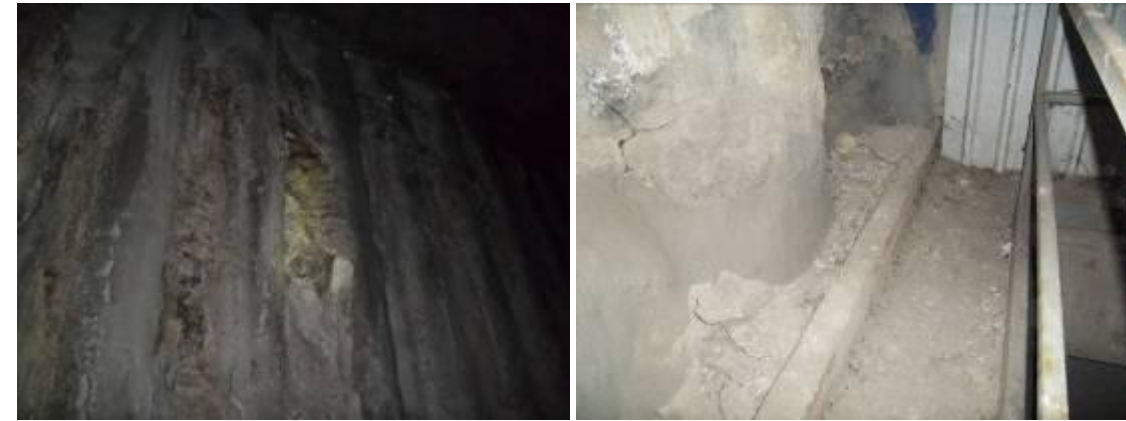
Gunita desprendida por entrada de agua (izquierda) y canaleta rellena con gunita desprendida en pozo de inmisión (derecha)
