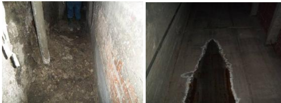
Izqda.: Pantalla en andén 1, filtración en quiebro a zona estrecha, con acumulación de material.
