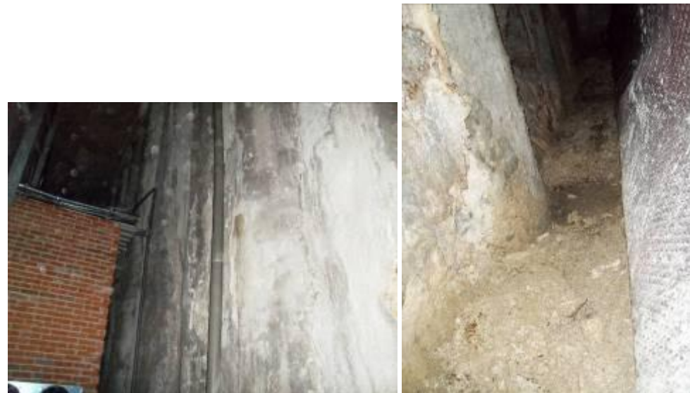
Andén 2. Izquierda: Pilotes con antiguas surgencias de agua. Derecha: salida de emergencia: cámara bufa rellena de material
