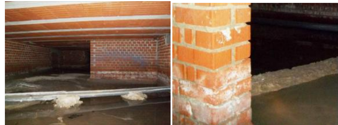
Bajo andén 1. Inundado y acumulación de sales, con canalización de media caña de PVC (izqda.) y alteración de la base del muro (dcha.)
