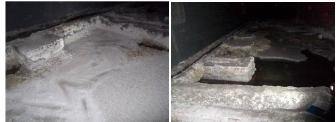
Bajo andén 1: acumulaciones de sales (izqda.) y canaleta transversal cubierta de sales, inoperativa, Recinto entre canaletas inundado (dcha.)
