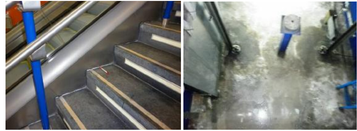
Izqda.: escalera fija despegada de escalera mecánica nº 2.
