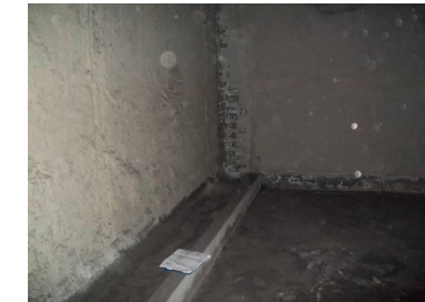
F-30. Nivel vestíbulo (final zona estrecha). Humedad en tabique de salida de emergencia.
