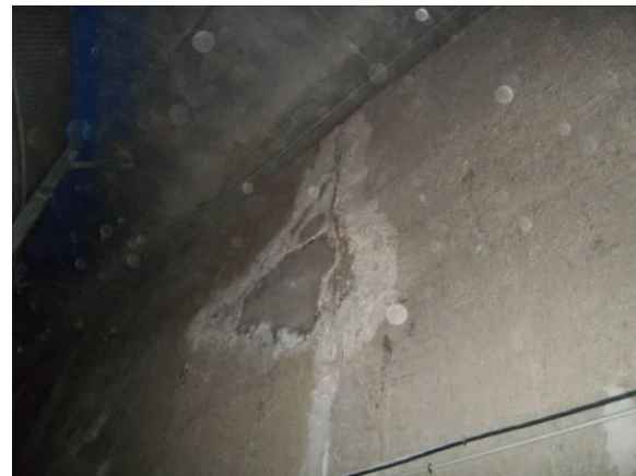
F-21. Nivel vestíbulo. Coquera reparada con humedad antigua y sales en pantalla derecha.
