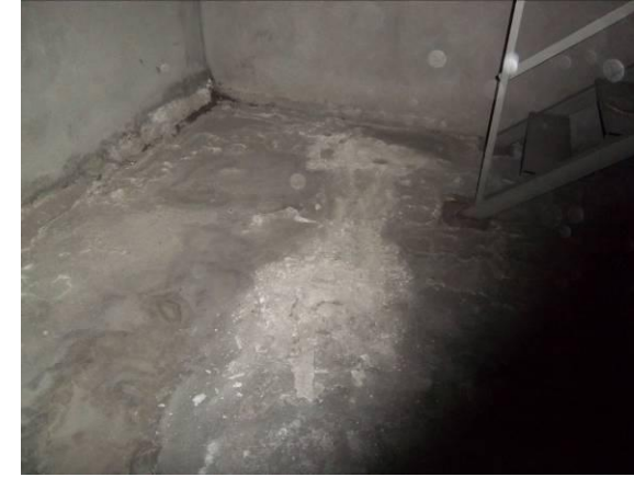
F-82. Pozo de inmisión andén 2 previo sala ventilación. Mortero de pendiente alterado.
