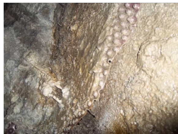
F-88. S. de emergencia andén 2. Cámara bufa. Filtración en 1º rellano.
