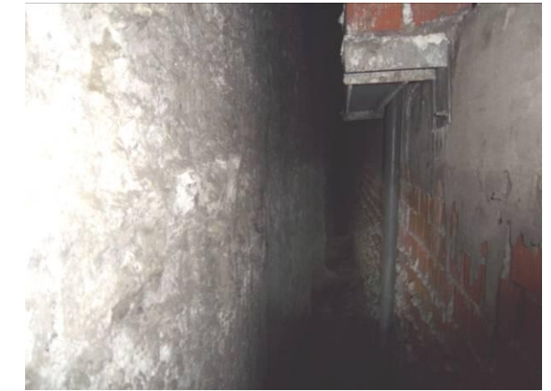
F-40. Cámara bufa tras andén 1 (derecha) en zona estrecha de estación, no accesible.
