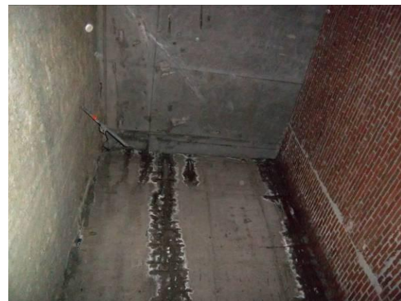
F-22. Nivel vestíbulo. Pozo de inmisión lado izquierdo. Humedades en muro rampa.
