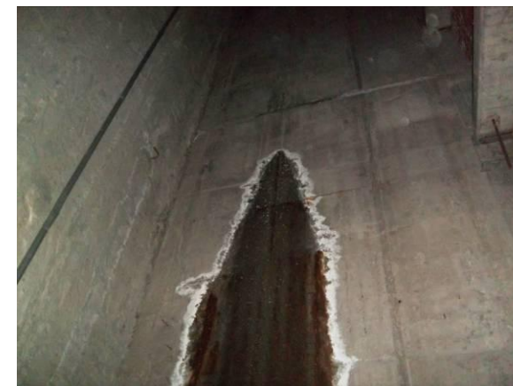
F-79. Pozo de inmisión andén 2. Filtración en muro cierre rampa.
