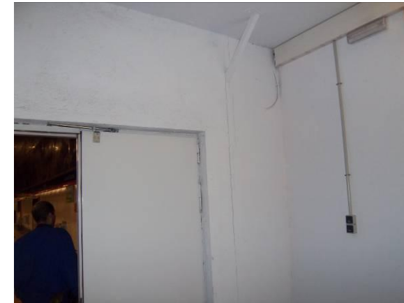
F-108. S. emergencia andén 2, Fisura junto a puerta de acceso a andén.
