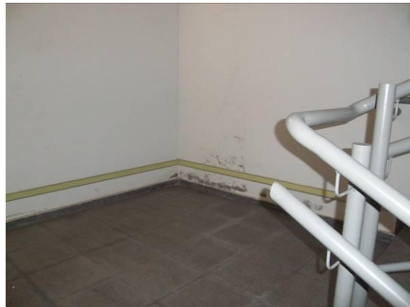
F-102. S. emergencia andén 2, Humedad en cuarto rellano.
