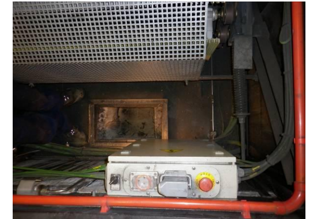
F-6. Acceso. Foso escalera mecánica n.º1. Seco.
