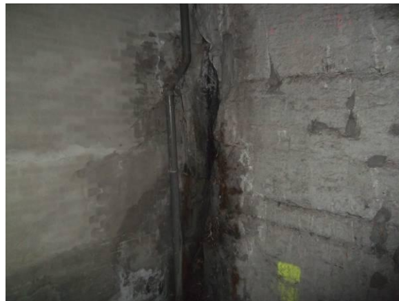
F-94. Pozo compensación andén 2. Filtración entronque pantalla frontal con túnel de línea.
