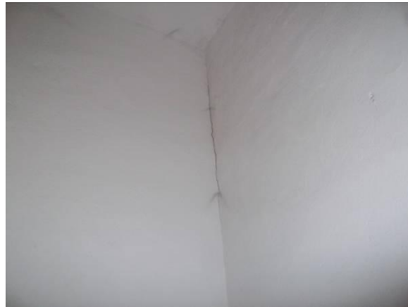
F-83. S. de emergencia andén 1 Fisura en tabiquería junto a puerta de acceso.
