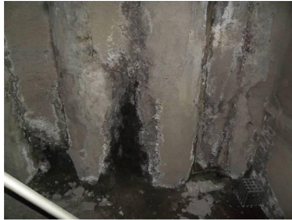
F-68. Pozo inmisión (derecho), nivel bajo andén 1. Humedades y relleno.
