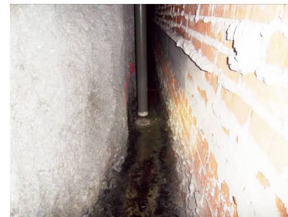
F-38. Cámara bufa andén 1. Tubo de desagüe tras sala de ventilación, vertiendo agua.
