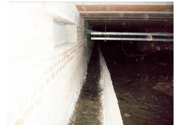
F-54. Bajo andén 1. Canaleta longitudinal con algo de barro.
