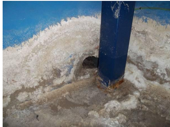
F-57. Foso ascensor vestíbulo-andén 2. Sales y desagüe en paramento lateral.
