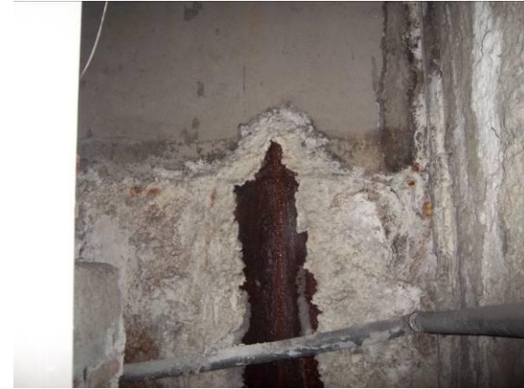
F-55. Cámara bufa tras andén 2. Zona ancha. Filtración con sales en muro cierre rampa.
