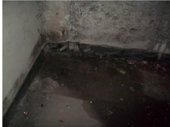
F-73. Pozo de compensación andén 1. Solera con humedad (procedente de pozo de inmisión).
