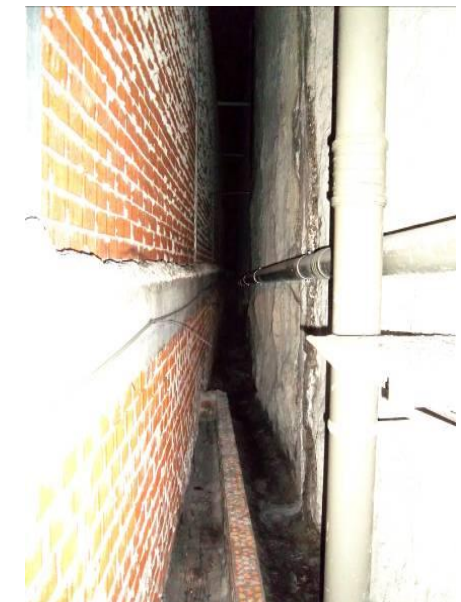
F-41. Cámara bufa andén 2. Vista hacia P.K. decrecientes (tras sala de ventilación).
