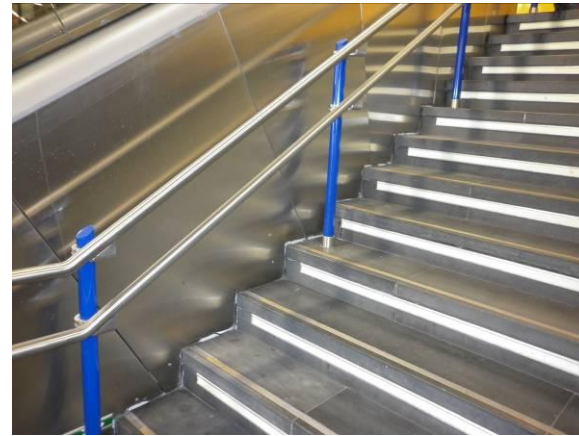
F-34. Escaleras vestíbulo-andén 1. Escalera fija despegada de lateral de esc mec nº 4.
