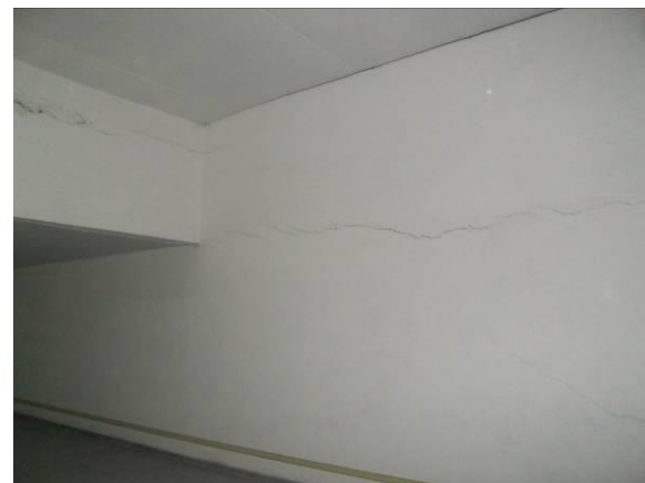
F-93. Salida de emergencia acceso al exterior. Fisuras en tabiquería.
