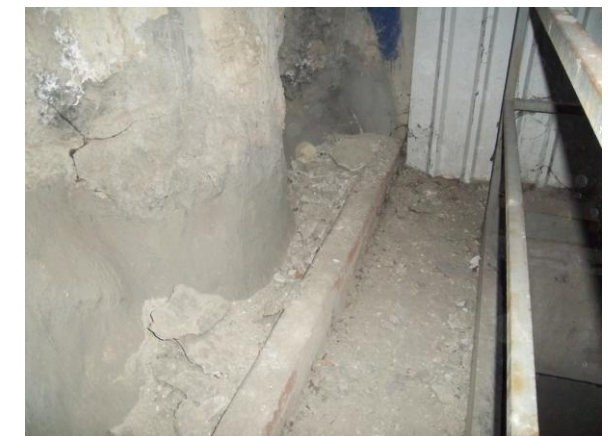
F-67. Pozo. Inmisión (izquierdo) nivel vestíbulo sobre andén 2. Canaleta rellena de gunita.
