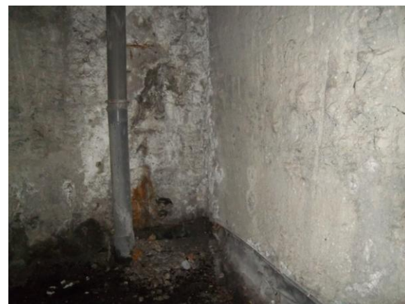
F-59. Pozo de inmisión andén 1. Junta entre pantallas. Superficie de hormigón alterado.
