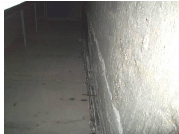
F-57. Cámara bufa tras andén 2. Junta muro cierre rampa con pantalla longitudinal.
