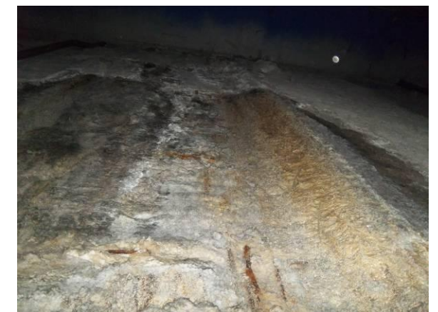
F-65. Cámara bufa andén 1. Filtración a favor de fisura junto entrada cámara bufa.
