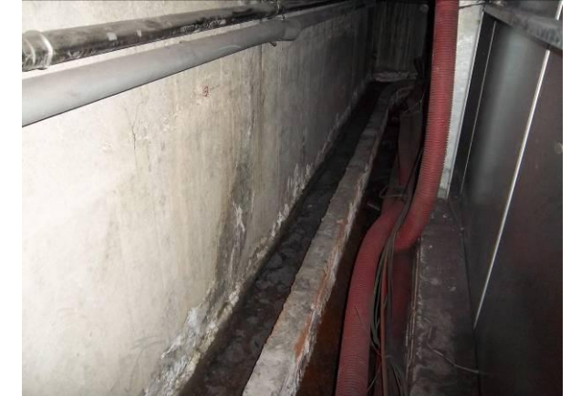
F-4. Cámara bufa acceso (muro frontal). Canaleta inundada, sin relleno.
