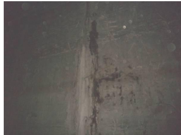
F-14. Nivel vestíbulo. Pantalla lateral derecha. Humedades en zona estrecha,
