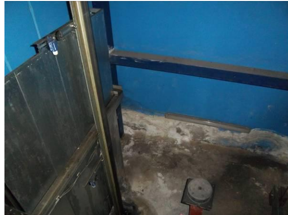
F-55. Foso ascensor vestíbulo-andén 2. Solera seca, pero con sales.
