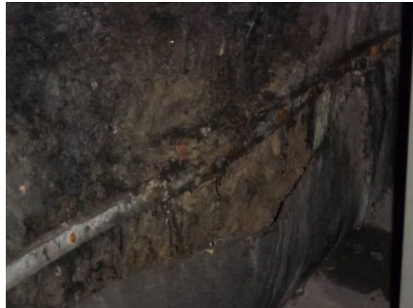
F-75. Pozo de inmisión andén 2. Impermeabilización despegada bajo filtración.
