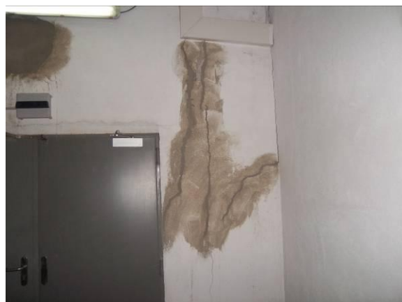
F-84. Salida de emergencia andén 1. Fisuras junto puerta de acceso desde andén.
