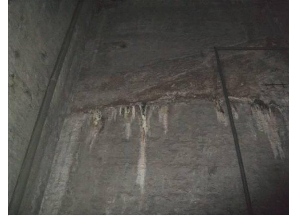
F-49. Pozo de compensación andén 1. Fisura horizontal en pantalla derecha.
