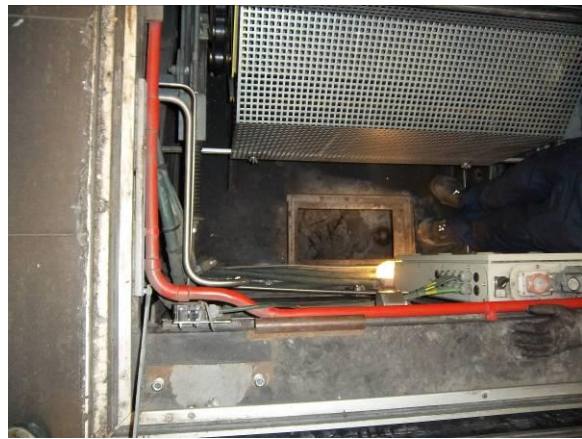
F-45. Escaleras n. intermedio-andén 1. Foso escalera mecanica nº 7, seco.
