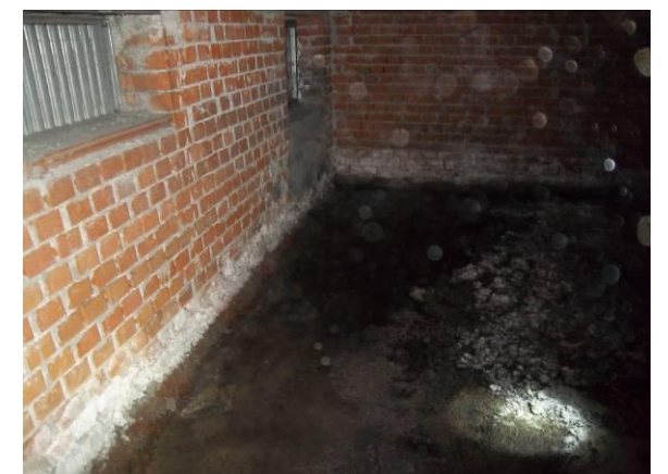
F-73. Bajo andén 2. Mortero alterado y humedad. Zona estrecha inicio bajo andén.
