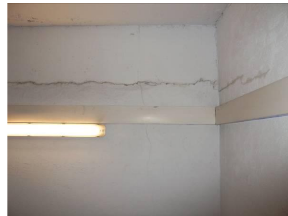
F-99. Salida emergencia andén 2. Fisura en tabiquería de rellano 3º.
