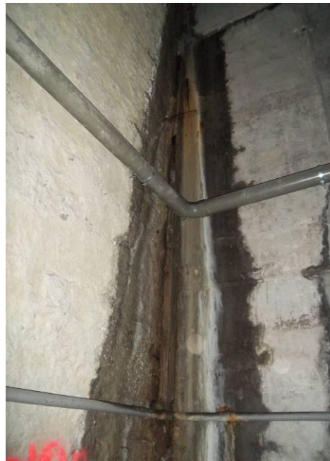
F-44. Cámara bufa andén 2. Filtración en junta entre pantalla (fin zona ancha estación) y muro de cierre de rampa.
