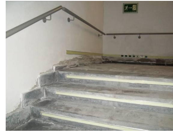
F-62. Salida de emergencia andén 1. Humedad en 1º rellano y zanca escalera.
