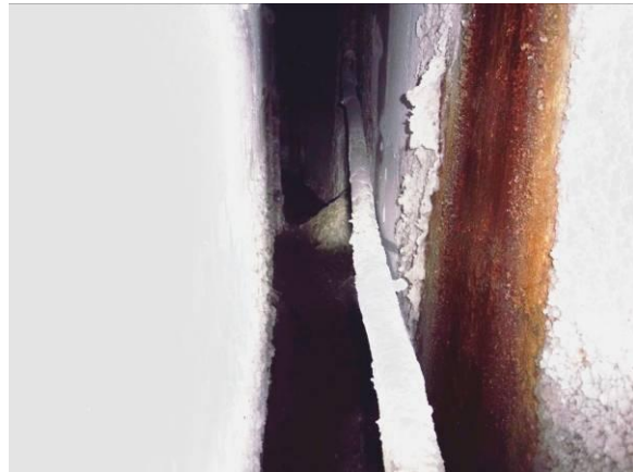
F-56. Cámara bufa tras andén 2. Zona ancha en muro de cierre de rampa.
