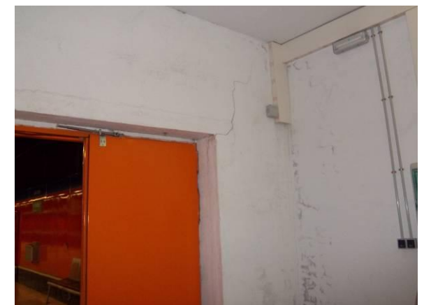
F-67. Salida de emergencia andén 1. Humedad y fisura junto puerta de acceso.
