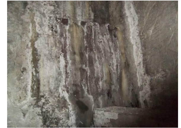
F-44. Nivel andén. Pozo de inmisión. Filtración en junta pantalla y fisura.
