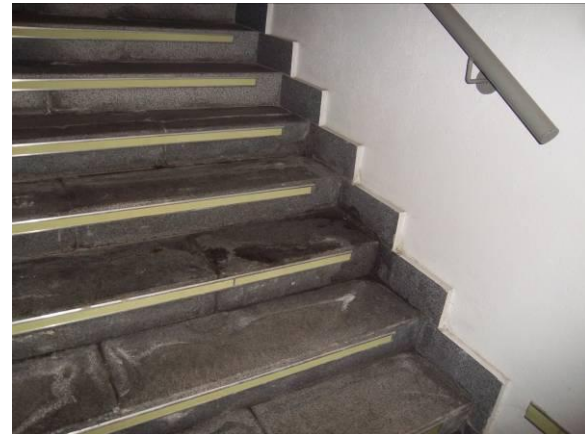
F-86. S. de emergencia andén 2. Humedad y restos de sales en peldaños de escalera.
