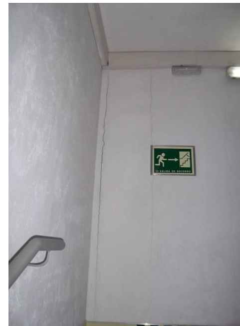
F-88. Salida de emergencia andén 2. Fisuras verticales en rellano 1º.
