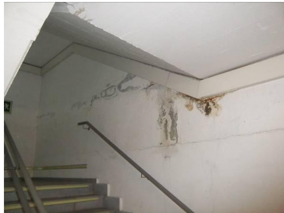
F-83. Salida de emergencia andén 1. Humedad en tabiquería rellano 7º - 8º.
