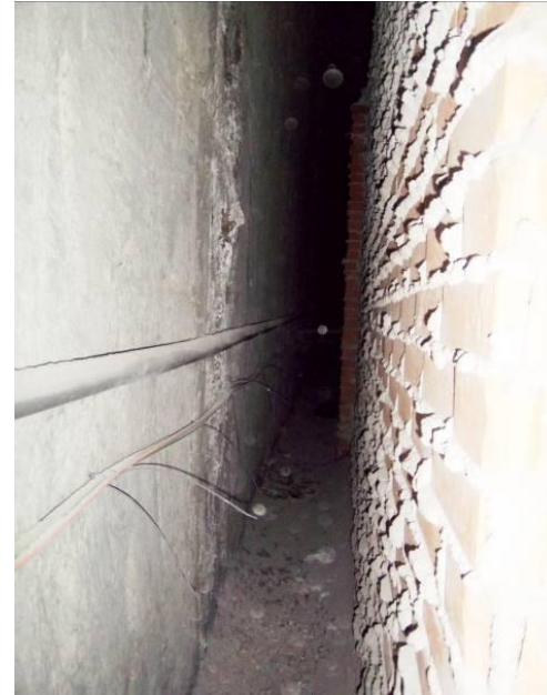
F-20. Nivel vestíbulo. Cámara bufa tras sala de ventilación en lado izquierdo.
