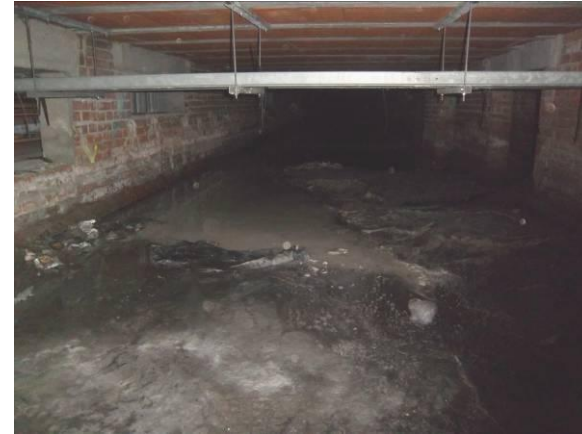
F-79. Bajo andén 1. Zona encharcada, próxima a la plataforma de vías.
