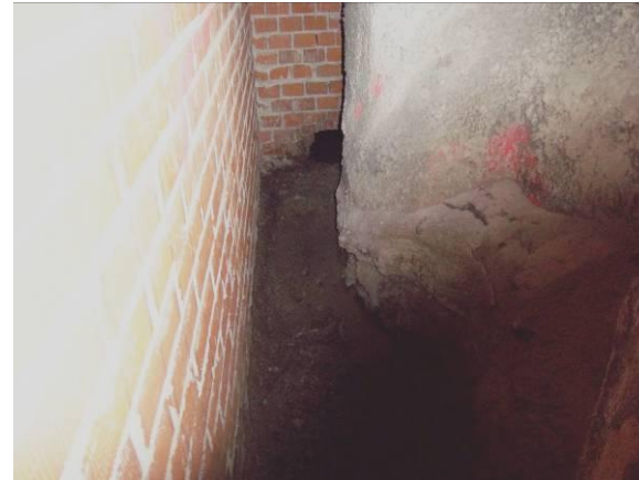
F-2. Acceso. Cámara bufa en paramento lateral. Humedad en base.
