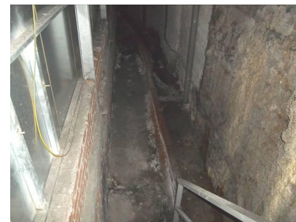
F-64. Cámara bufa andén 1. Filtración a favor de fisura junto entrada cámara bufa.
