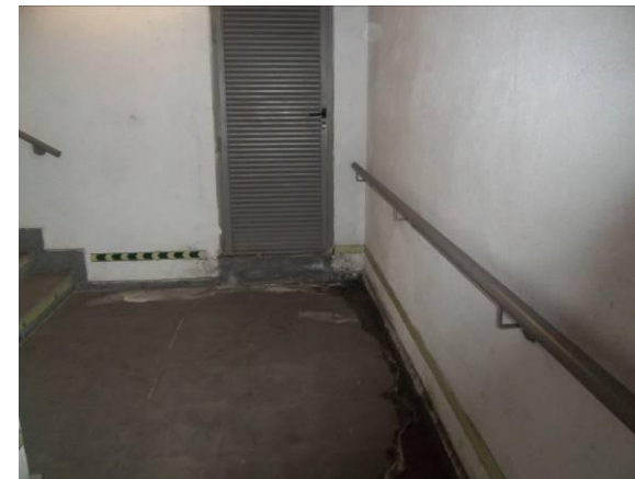
F-92. Salida emergencia andén 1. Agua encharcada en 7º rellano (junto puerta pozo de ventilación).
