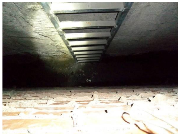
F-98. Salida emergencia andén 2. Cámara bufa a nivel de bajo andén, con agua.
