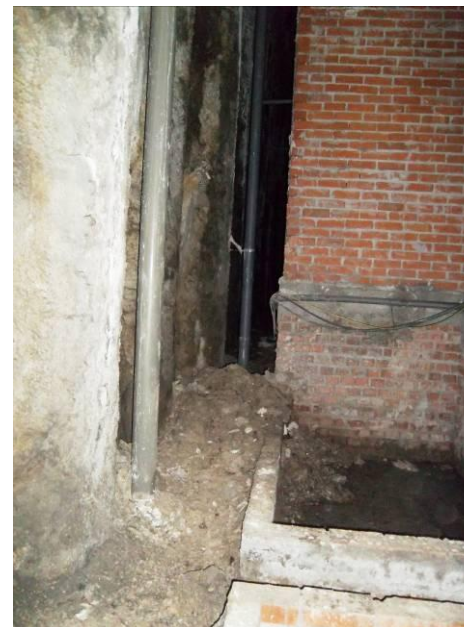
F-40. Cámara bufa tras andén 1. Canaleta colmatada (zona tras escaleras).
