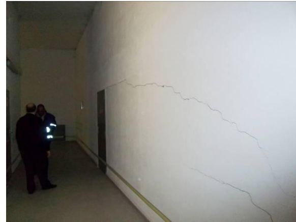
F-69. Salida de emergencia pasillo de conexión. Grietas en tabiquería.
