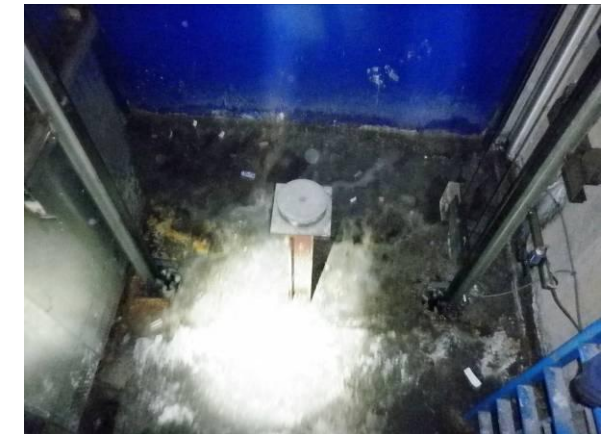
F-8. Acceso. Foso ascensor acceso. Solera humedad, con agua y sales.
