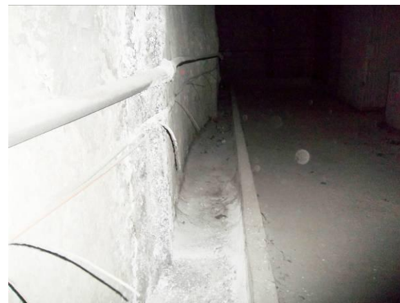
F-14. Nivel vestíbulo. Pantalla frontal inicio estación. Aspecto canaleta a pie de pantalla.
