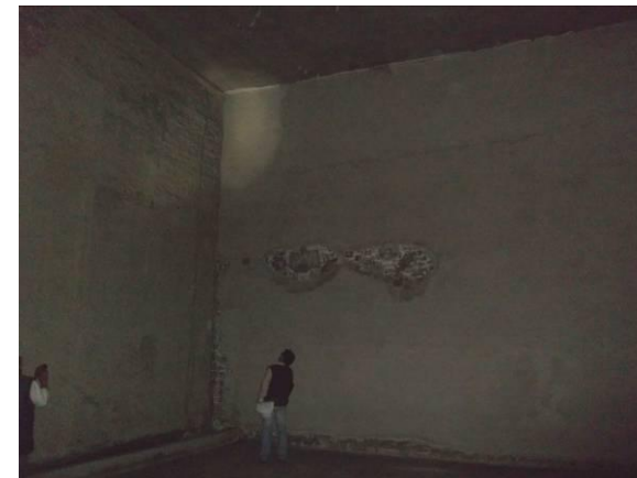
F-29. Nivel vestíbulo (final zona estrecha). Humedad en tabique de salida de emergencia.
