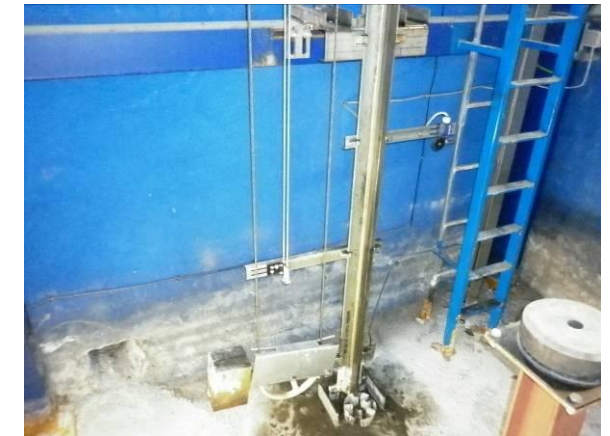
F-36. Foso ascensor vestíbulo-andén 2. Aspecto del desagüe.
