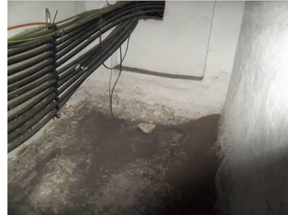
F-95. Salida emergencia andén 1. Cuarto del seccionador, humedad y sales en solera.
