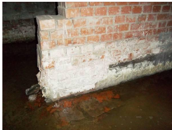
F-72. Bajo andén 2. Alteración de muros de fábrica de ladrillo en bajo andén.
