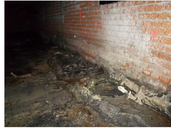
F-52. Bajo andén 1. Mortero alterado junto muro de separación plataforma de vías.
