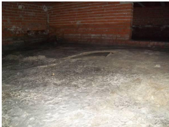
F-82. Bajo andén 1. Zona bajo cuarto disponible nº 8. Seca, mortero alterado.
