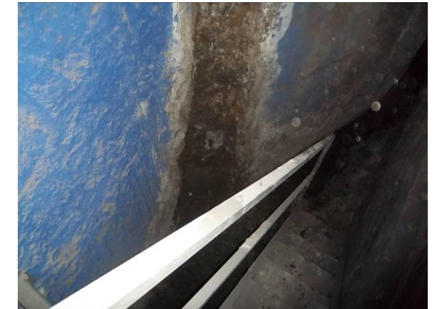
F-56. Nivel andén. Pantalla izquierda (andén 2). Humedad en junta de pantalla.
