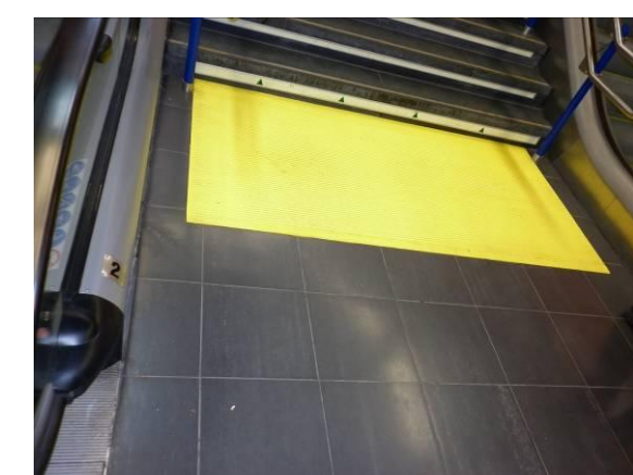
F-6. Escaleras acceso (Escaleras mecánicas nº 1 y nº 2).
