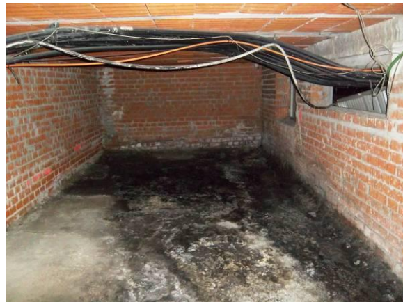
F-53. Bajo andén 1. Inicio de bajo andén 1. Zona encharcada y con mortero de pendiente alterado.
