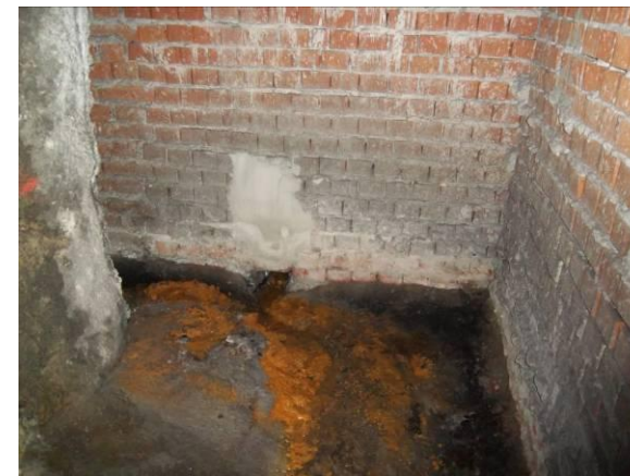
F-50. Cámara bufa andén 2. Drenaje cámara bufa a bajo andén en muro rampa.
