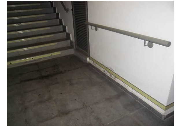
F-82. S. de emergencia andén 1. Humedad junto puerta hueco de ventilación.
