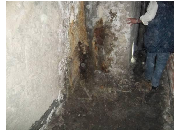
F-74. Cámara bufa andén 2. Filtración tras cuarto de enclavamiento. Detalle parte inferior junta.
