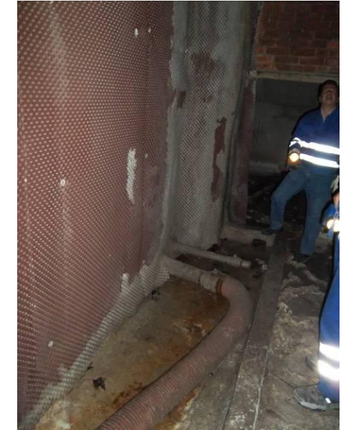
F-77 Pozo de extracción. Junta de muro lateral derecho de pozo y pantalla de estación.
