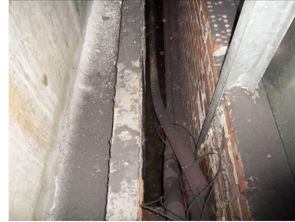
F-5. Cámara bufa acceso. Foso escalera mecánica nº 4 con agua acumulada.
