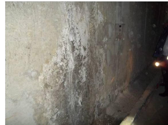
F-22. Nivel vestíbulo. Humedad con sales en pantalla derecha.
