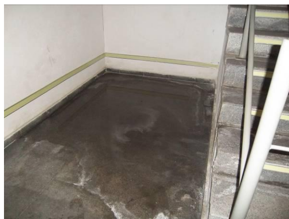
F-87. S. de emergencia andén 2. Acumulación de agua en base de escalera (nivel andén).
