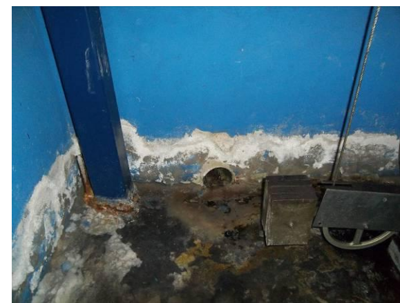
F-53. Foso ascensor vestíbulo-andén 1. Desagüe, pintura descarnada en paramento.
