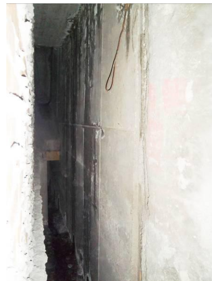
F-58. Salida de emergencia andén 1. Muro rampa. Agua por agujeros para espaldines.
