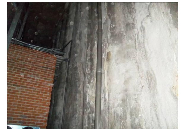
F-36. Pilotes nivel andén 2. Antiguas surgencias
