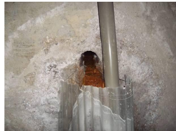
F-40. Entrada de agua por taladro en pantalla derecha.
