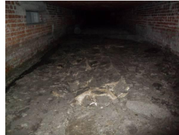
F-86. Bajo andén 2. Zona estrecha de la estación. Vista hacia P.K. decrecientes.
