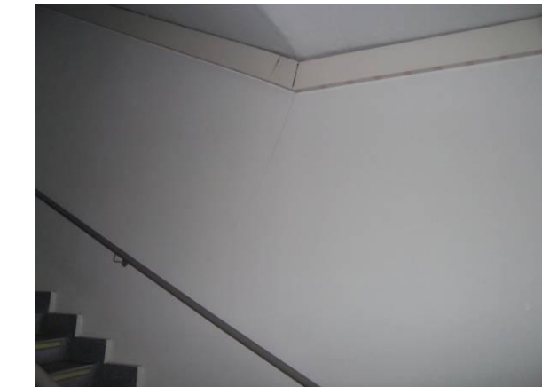
F-98. S. emergencia andén 1, Fisura en tabiquería nivel andén.
