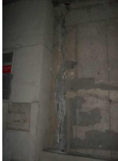
F-19. Humedad antigua en junta pantalla-muro rampa a nivel vestíbulo.
