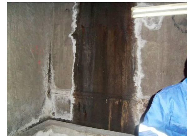
F-80. Pozo de inmisión andén 2. Filtración en muro cierre rampa.
