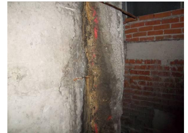
F-49. Cámara bufa andén 2. Filtración en junta de muro de cierre de rampa con pantalla (inicio zona estrecha estación).
