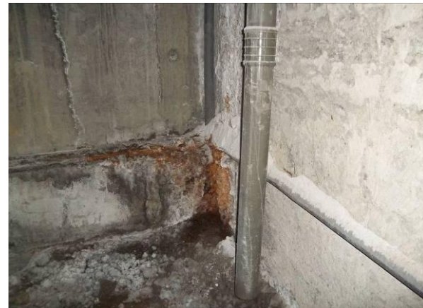
F-50. Cámara bufa andén 2. Filtración con sales en junta muro rampa con pantalla.
