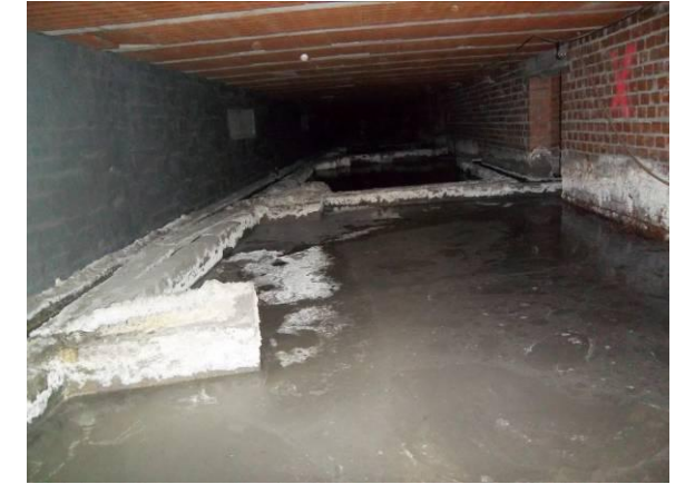
F-66. Bajo andén 1. Inundado. Inspección de abril de 2013.
