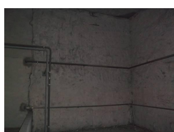
F-21. Nivel vestíbulo. Pantalla frontal y lateral derecha en pozo de inmisión. Seca.
