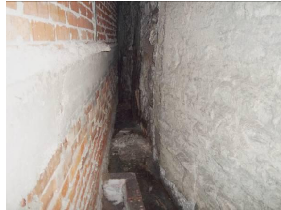
F-67. Cámara bufa andén 1. Hormigón de pantallas alterado, tras cuarto nº 8.
