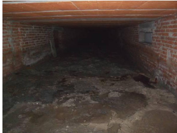
F-80. Bajo andén 1. Zona encharcada, al inicio de zona estrecha de estación.
