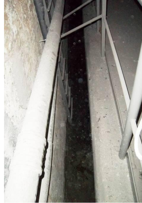
F-48. Cámara bufa tras andén 2 tras caja de ascensor. Humedad en su base.
