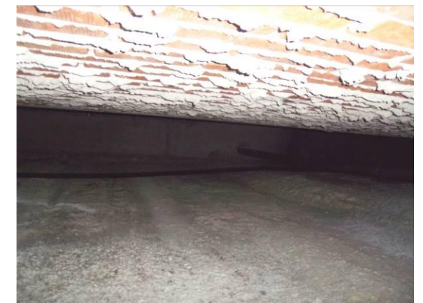
F-39. Cámara bufa andén 1. Filtración en junta entre pantallas con lámina drenante.
