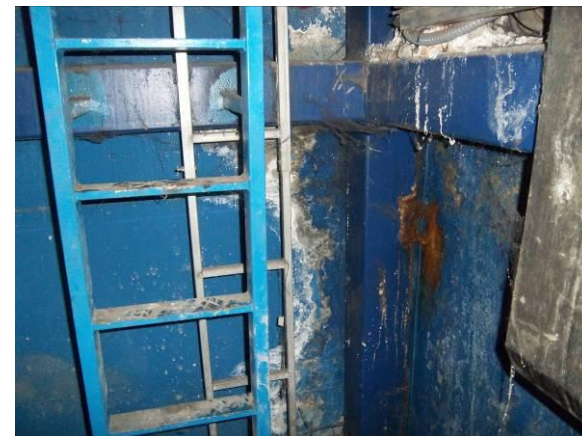
F-16. Ascensor acceso. Foso ascensor. Agua y sales en paramento izquierdo.
