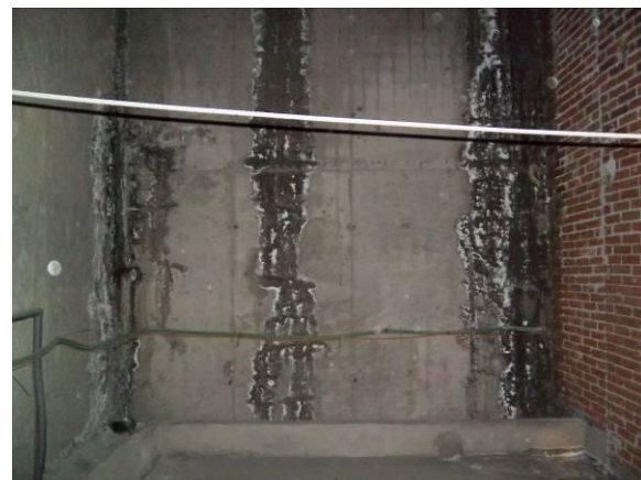
F-21. Nivel vestíbulo. Pozo de inmisión lado izquierdo. Humedades en muro rampa.
