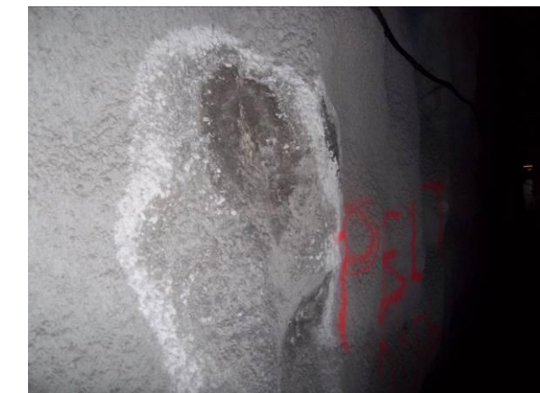
F-16. Humedad antigua en pantalla derecha tras revestimiento metálico.
