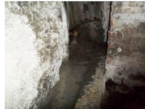
F-78. Pozo de inmisión andén 1. Cámara bufa anegada y colmatada. Inoperativa.
