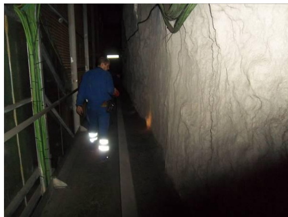
F-15. Camara bufa nivel vestíbulo tras escaleras acceso andén. Pantalla derecha.
