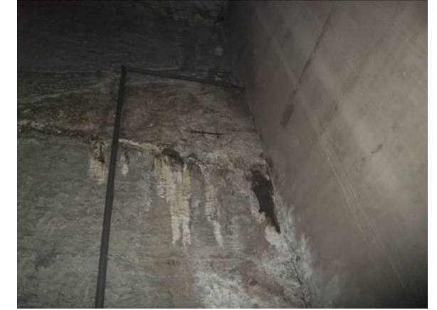
F-50 Pozo de compensación andén 1. Fisura horizontal en pantalla derecha.
