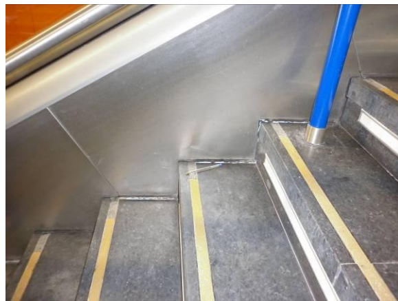
F-31. Escalera de hormigón vestíbulo.-andén 2, despegada de escalera mecánica nº 6.
