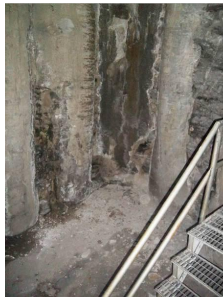
F-70. Pozo inmisión (izquierdo), nivel bajo andén 2. Humedades y relleno.
