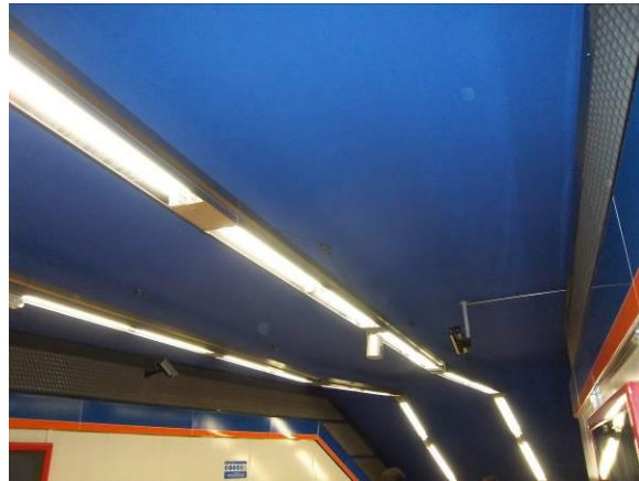
F-3. Aspecto losa de cubierta del acceso cara inferior desde acceso).
