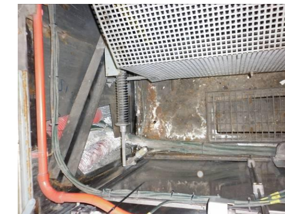
F-9. Acceso. Foso escalera mecánica nº 2. Humedad y algunas sales.
