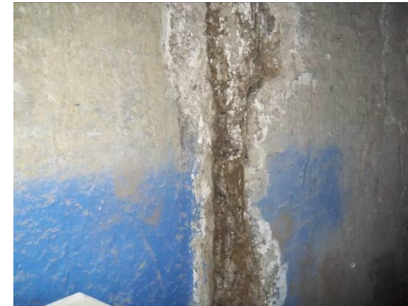
F-55. Nivel andén. Pantalla izquierda (andén 2). Humedad en junta de pantalla.
