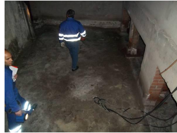
F-75. Pozo de inmisión andén 2. Agua, sales y mortero de pendiente alterado.
