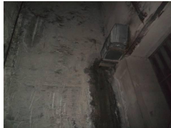
F-93. Pozo inmisión andén 2. Inicio estación. Cajon para recogida de goteo nivel superior.
