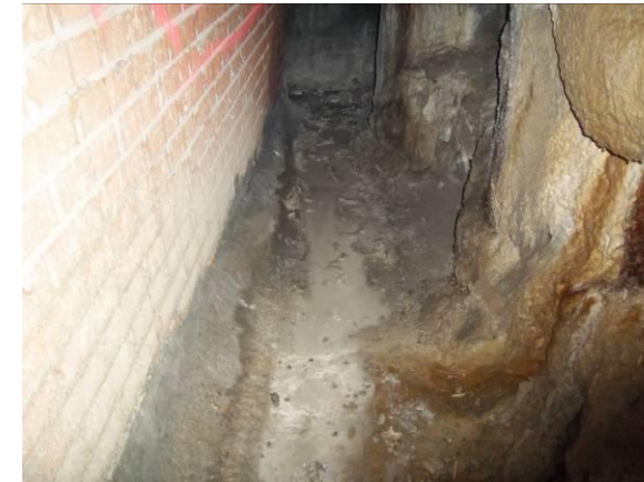
F-5. Acceso. Filtración entre pilotes en pantalla frontal. Humedad y mortero alterado en cámara bufa.
