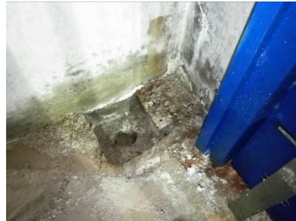
F-14. Foso ascensor acceso. Desagüe sin rejilla y con algo de relleno (sales).
