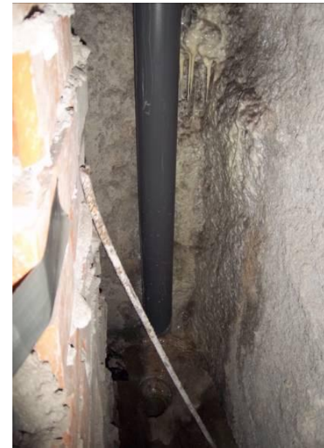
F-89. S. de emergencia andén 2. Cámara bufa 3º rellano. Filtración en junta en pantallas.
