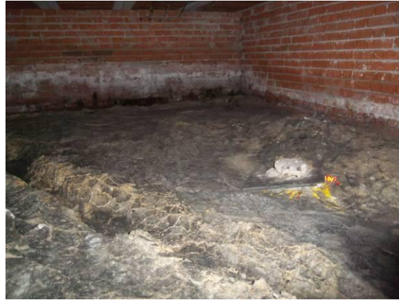
F-78. Bajo andén 1. Zona bajo sala de ventilación. Seca, mortero alterado.
