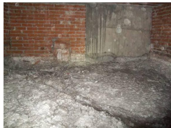
F-71. Bajo andén 1. Acumulación de sales bajo salida de emergencia.
