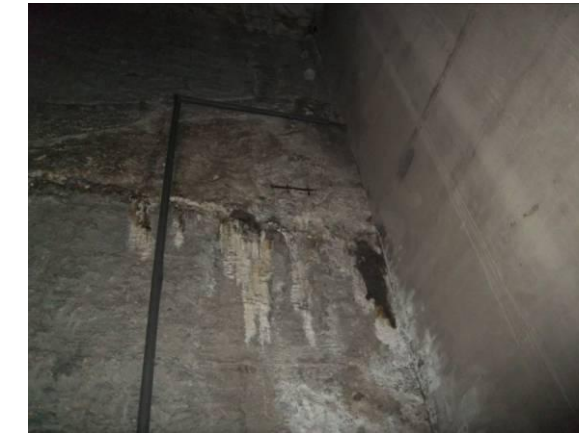
F-79. Pozo de compensación andén 1. Fisura horizontal en pantalla derecha.
