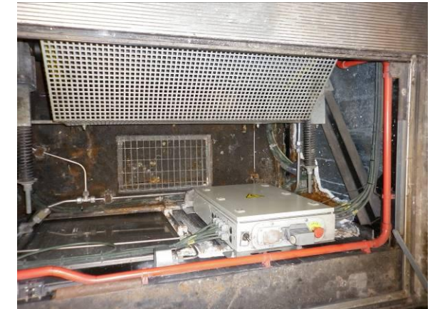
F-8. Acceso. Foso escalera mecánica nº 1. Humedad.
