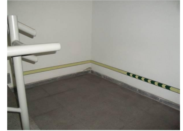
F-96. S. emergencia andén 1, Humedad en primer rellano.
