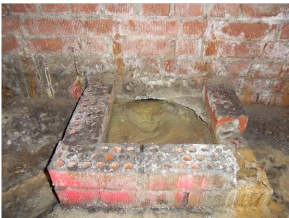
F-55. Bajo andén 1. Arqueta de desagüe colmatada y prácticmanete inoperativa.
