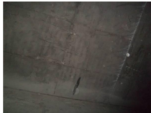
F-22. Losa de cubierta. Zona estrecha de estación. Antigua gotera y eflorescencias.
