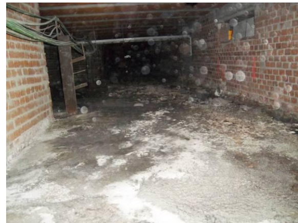
F-69. Bajo andén 1. Mortero alterado y sales. Zona ancha frente cuarto de alta.
