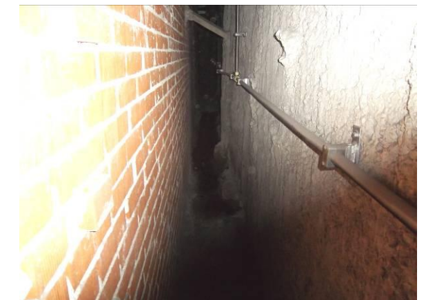
F-18. Nivel vestíbulo. Cámara bufa tras cuartos en zona ancha estación.
