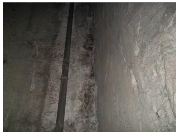
F-58. Pozo de inmisión andén 1. Junta entre pantallas. Superficie de hormigón alterado.
