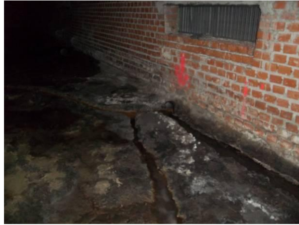
F-63. Bajo andén 2. Desagüe hacia drenaje central en zona estrecha de estación.
