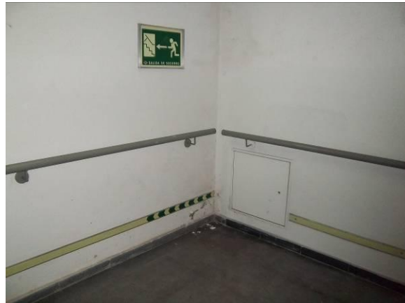
F-85. S. de emergencia andén 2. Humedad en tabiquería del 1º rellano.
