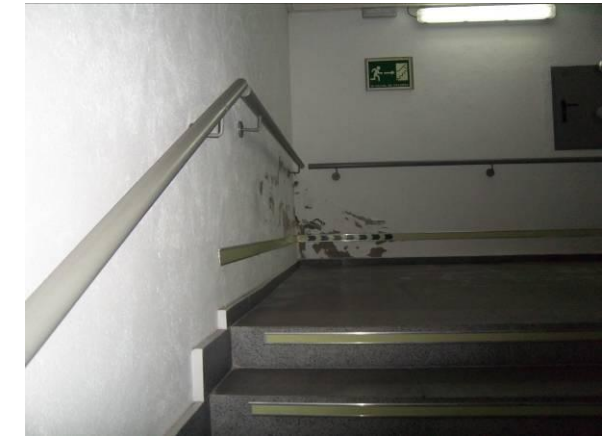
F-78. S. de emergencia andén 1. Humedad en primer rellano.
