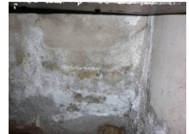
F-28. Interior foso escalera mecánica nº 5. Sales.
