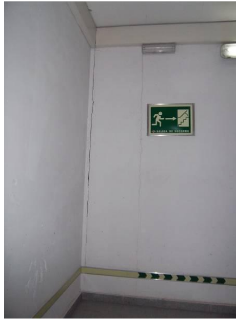
F-90. Salida de emergencia andén 2. Fisuras verticales en rellano 2º.
