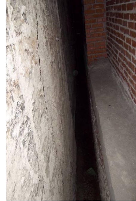
F-72 Salida de emergencia andén 2. Cámara bufa nivel bajo andén, húmeda.
