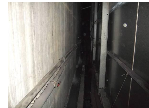
F-4. Cámara bufa acceso (muro lateral). Canaleta húmeda, sin relleno.
