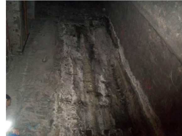
F-76. Pozo de inmisión andén 1. Fisura y filtración en pantalla.
