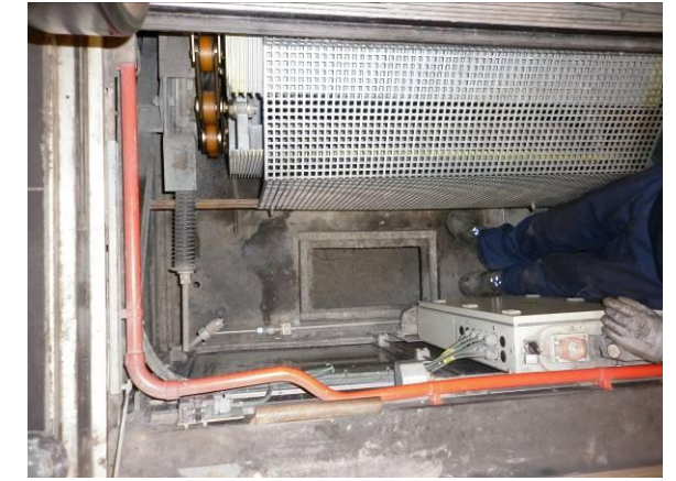
F-24. Foso escalera mecánica nº 3. Con algo de agua.
