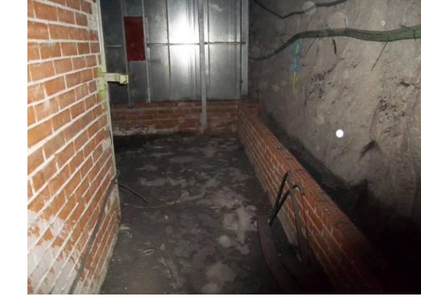
F-20. Ascensor acceso. Aspecto pantalla y canaleta a nivel vestíbulo.
