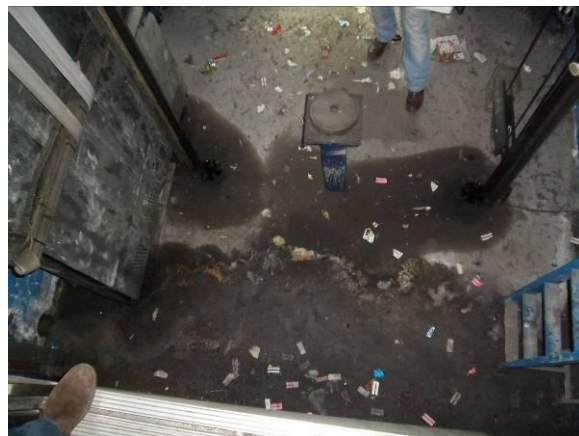
F-15. Ascensor acceso. Foso ascensor. Solera seca y algo de humedad junto puerta.
