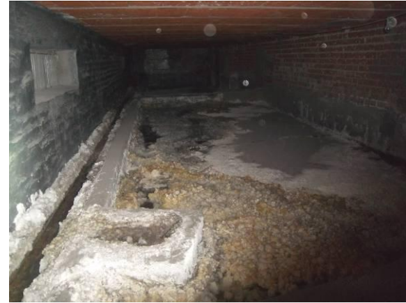
F-60. Bajo andén 1. Acumulación de sales. Vista hacia P.K. crecientes.
