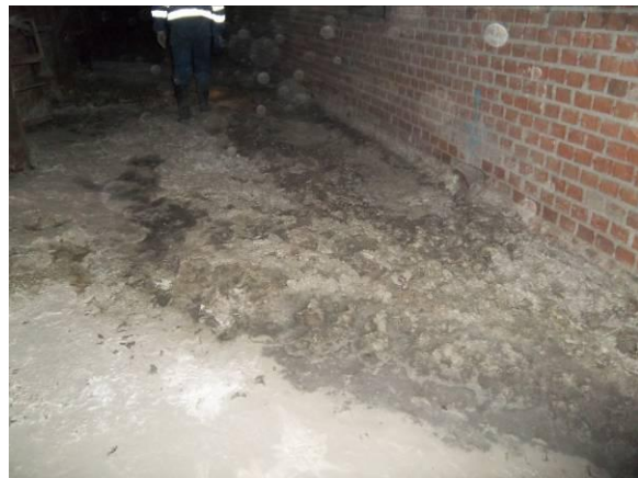
F-68. Bajo andén 1. Mortero alterado y roto. Desagüe frente cuarto disponible.
