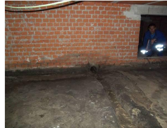
F-57. Bajo andén 1. Canalizaciones transversales "medias cañinas" en bajo andén.
