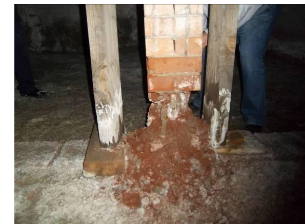
F-62. Bajo andén 2. Alteración de pilar en bajo andén por sales. Pilar apeado
