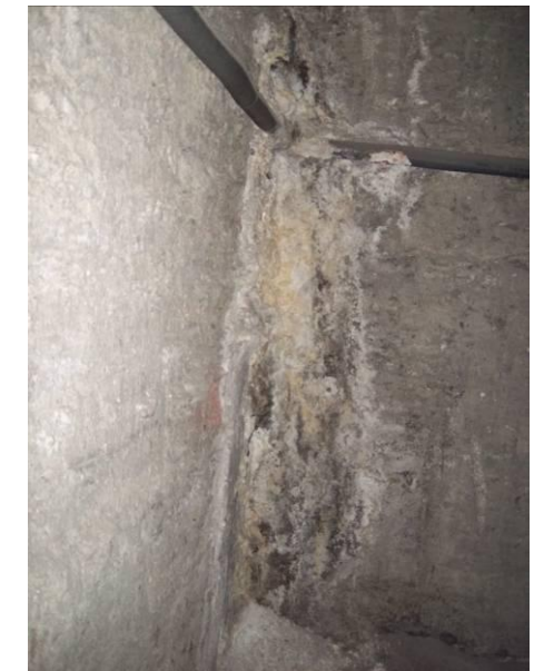
F-42. Cámara bufa tras andén 1. Humedad y sales en junta entre pantalla transversal y longitudinal.
