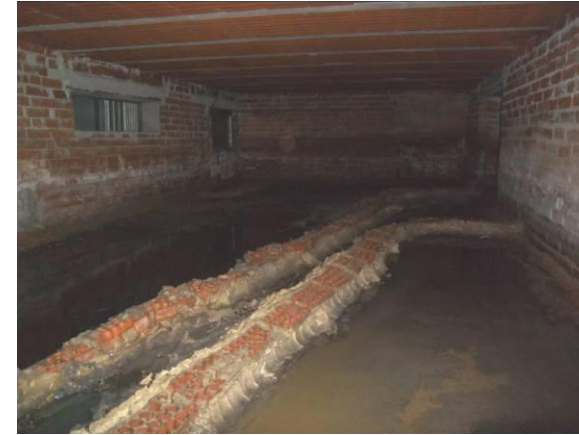
F-84. Bajo andén 2. Zona inundada a su inicio. Canaleta transversal de fábrica.
