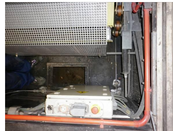
F-25. Foso escalera mecánica nº 4. Humedad.
