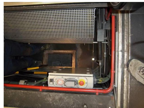
F-48. Escaleras n. intermedio-andén 2. Foso escalera mecanica nº 9, seco.
