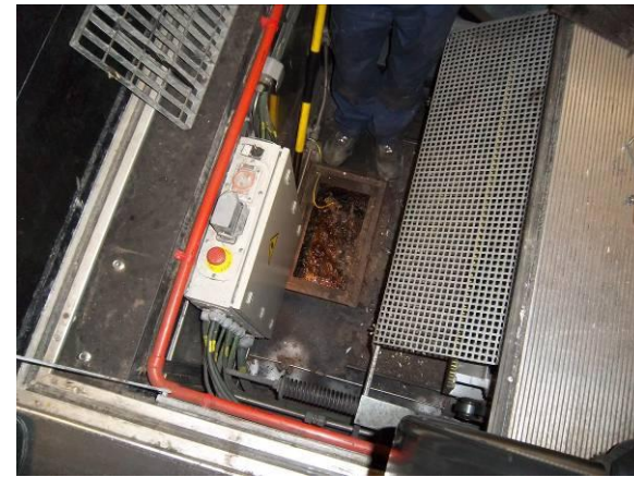
F-14. Escaleras acceso, Foso escalera mecánicas nº 4. Agua y sales.
