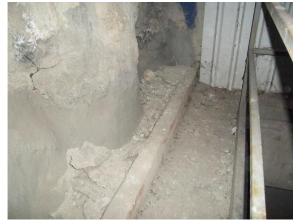
F-20. Canaleta rellena con gunita caída. Pozo inmisión (nivel vestíbulo).
