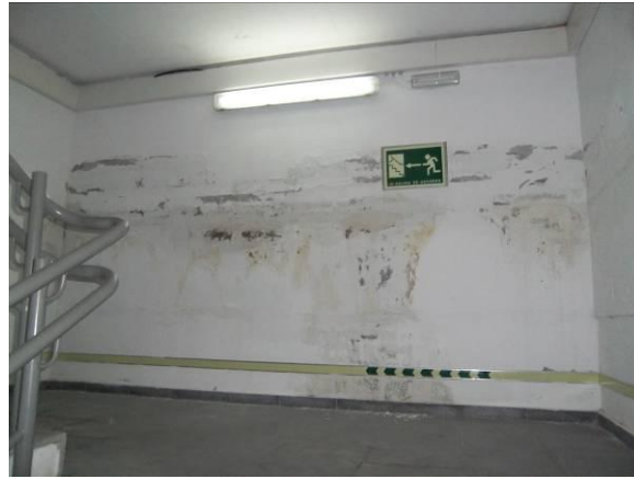
F-55. Salida de emergencia andén 1. Humedad en tabiquería rellano quinto.
