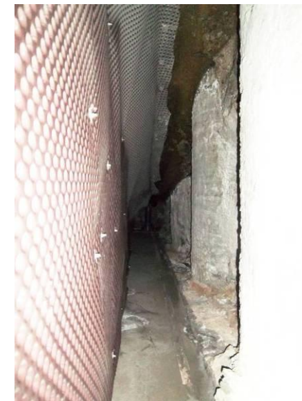
F-61. Salida de emergencia andén 2. Cámara bufa, lamina drenante en trasdos tabiquería.
