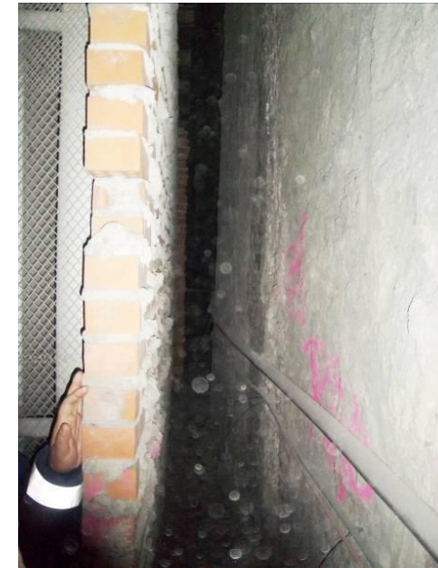
F-15. Nivel vestíbulo. Cámara bufa tras sala de ventilación en lado derecho.
