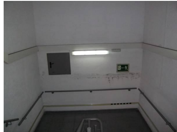
F-84. S. de emergencia andén 2. Humedad en tabiquería del 5º rellano.
