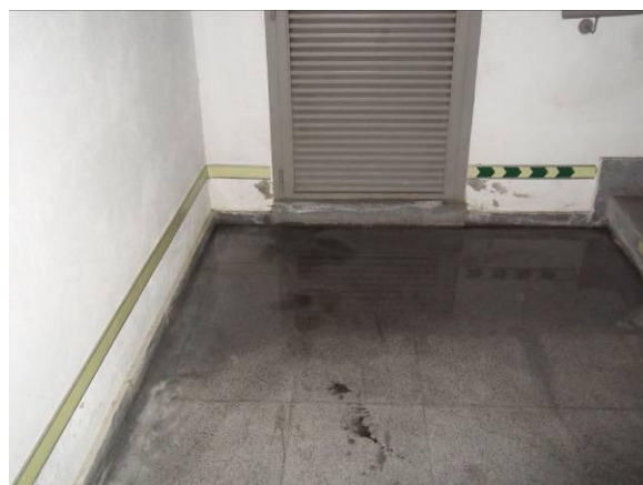
F-104. S. emergencia andén 2, Acumulación agua junto puerta de pozo ventilación.
