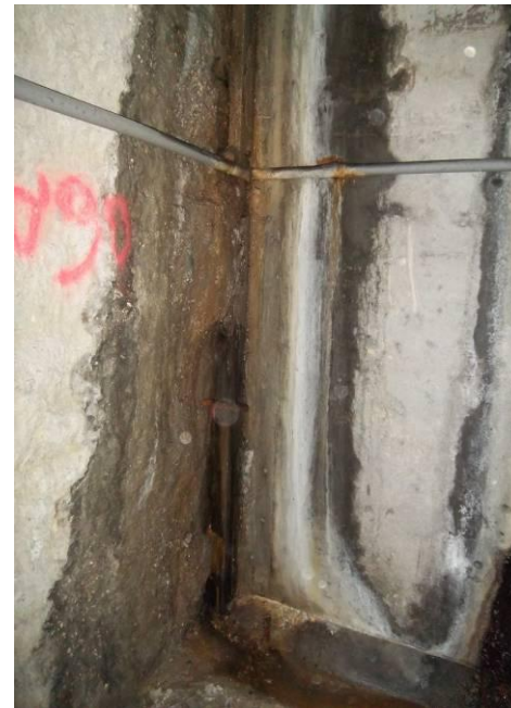
F-45. Cámara bufa andén 2. Filtración en junta entre pantalla (fin zona ancha estación) y muro de cierre de rampa.
