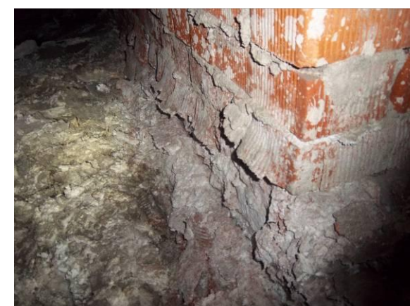
F-74. Bajo andén 2. Alteración muros bajo andén. Zona bajo escaleras de acceso.
