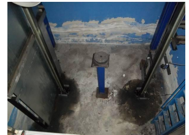
F-30. Foso ascensor vestíbulo-andén 1. Seco. Pintura descarnada.
