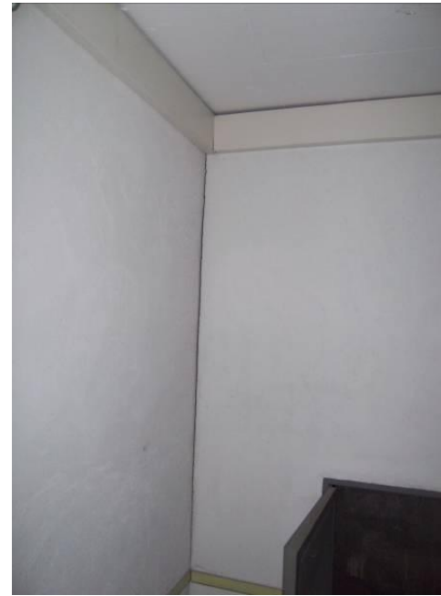
F-91. Salida de emergencia andén 2. Fisuras en rellano 2º.
