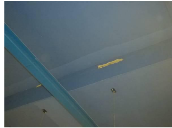
F-38. Hormigón desprendido en canto de losa de cables.
