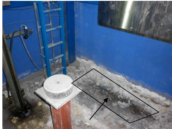
F-40. Nivel andén. Foso ascensor vestíbulo-andén 2. Mortero de solera alterado.
