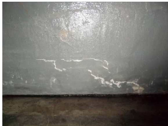
F-74. Bajo andén 2. Impermeabilización de muro. Fisuras con sales.
