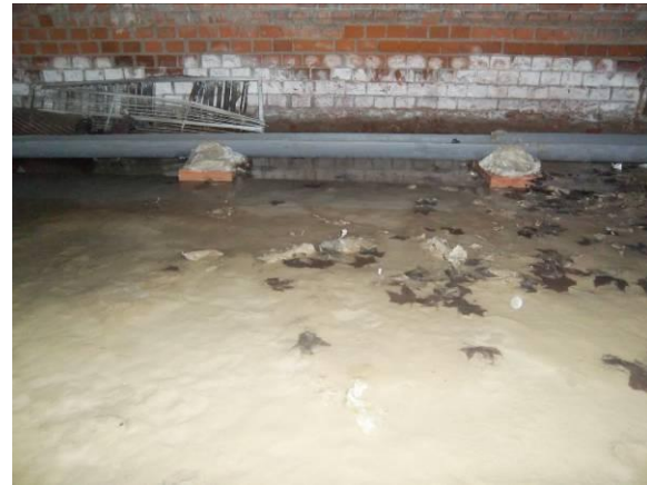
F-57. Bajo andén 1. Inundado y acumulación de sales.
