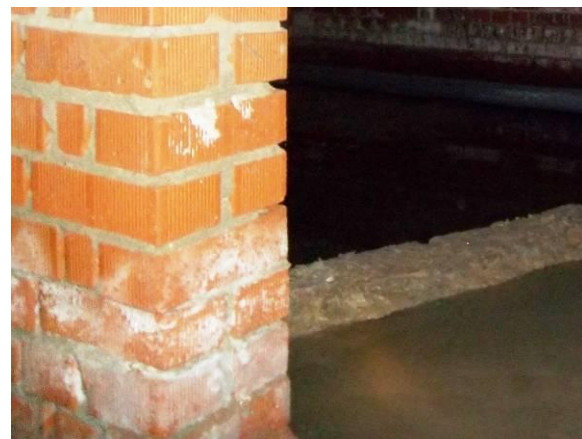
F-59. Bajo andén 1. Alteración de la base del muro.
