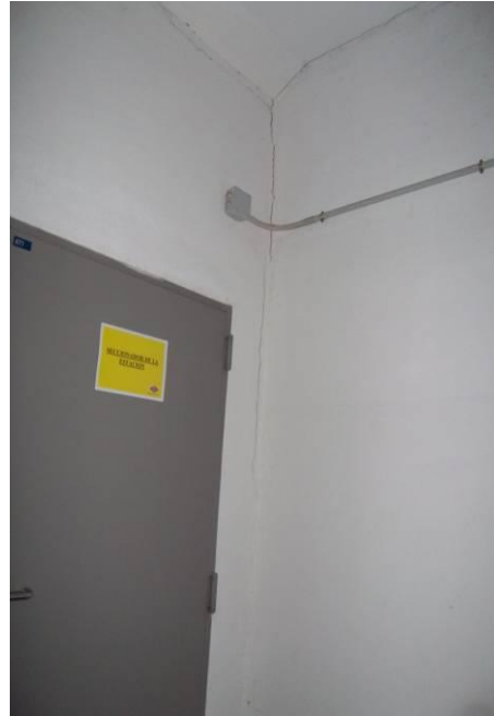
F-68. Salida de emergencia andén 1. Fisura junto 2ª puerta de acceso.
