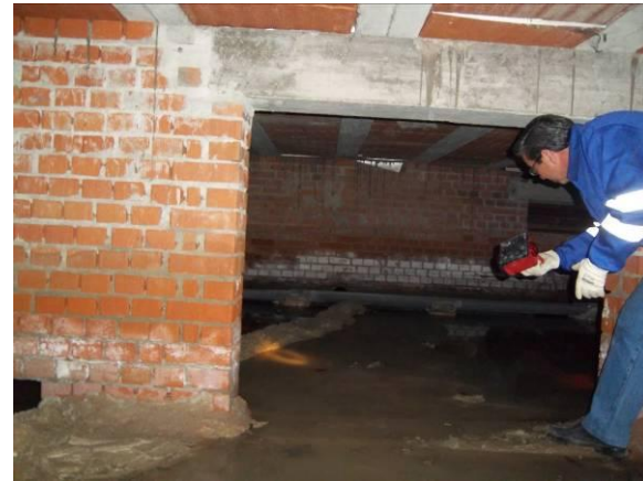
F-58. Bajo andén 1. Inundado y acumulación de sales.
