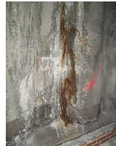
F-17. Entrada de agua entre pilotes nivel vestíbulo. Pantalla lateral izquierda.
