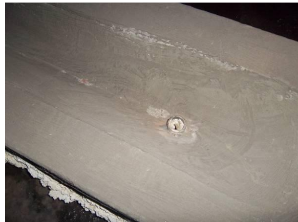
F-67. Bajo andén 1. Posible drenaje agua bajo contrabóveda (subpresión).
