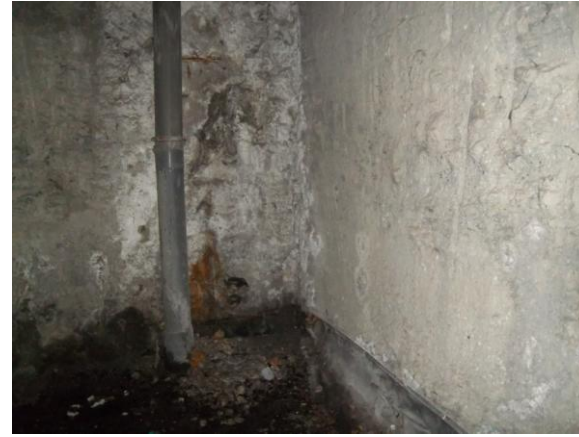
F-91. Pozo inmisión andén 1. Inicio estación. Junta con humedad y hormigón alterado.
