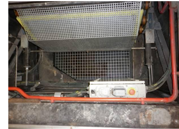
F-8. Foso escalera mecánica nº 2. Agua corriendo.
