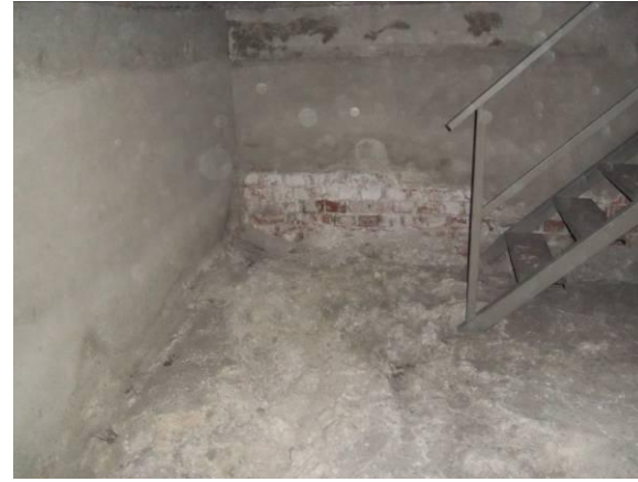
F-77. Pozo de inmisión andén 1 tras de sala ventilación. Humedad y mortero alterado.
