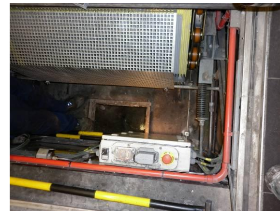
F-27. Foso escalera mecánica nº 5. Con algo de agua.
