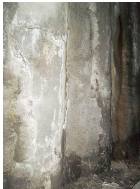
F-39. Cámara bufa tras andén 1. Filtraciones entre pilotes (zona tras escaleras).
