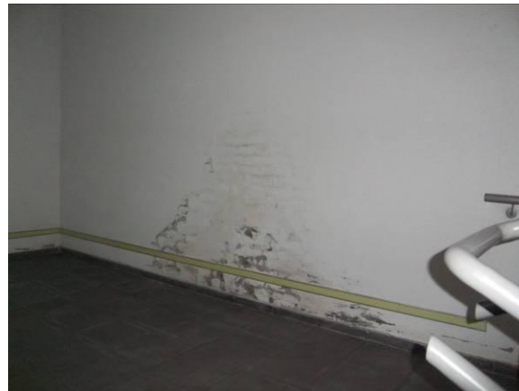
F-103. S. emergencia andén 2, Humedad en quinto rellano (Pasillo de conexión).
