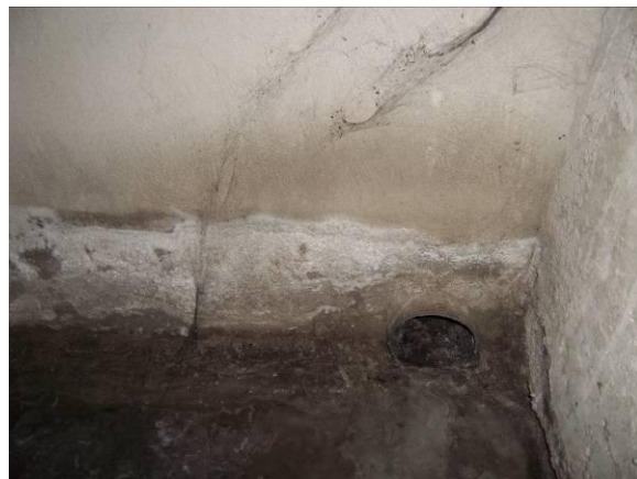
F-25. Desagüe foso escalera mecánica nº 3. Humedad y algo de agua.
