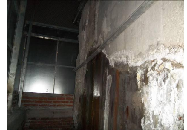
F-52. Muro rampa abombado y fisurado en parte inferior. Filtración por fisura con sales.
