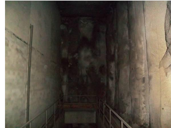
F-64. Pozo inmisión (derecho) nivel vestíbulo sobre andén 1. Pantalla de pilotes seca.
