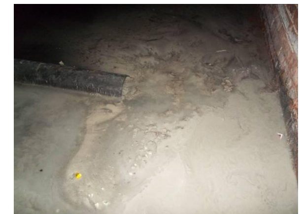
F-77. Bajo andén 1. Tubo transversal de PVC vertiendo agua a bajo andén.
