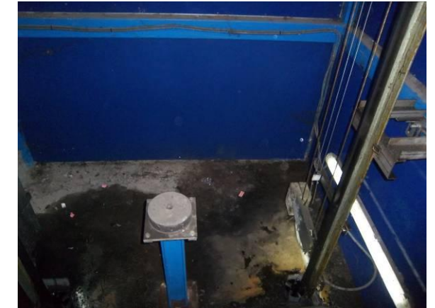
F-8. Foso de ascensor de acceso. Humedad con agua y sales en solera.
