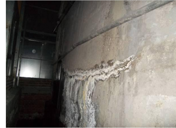
F-51. Muro rampa abombado y fisurado en parte inferior. Filtración por fisura con sales.
