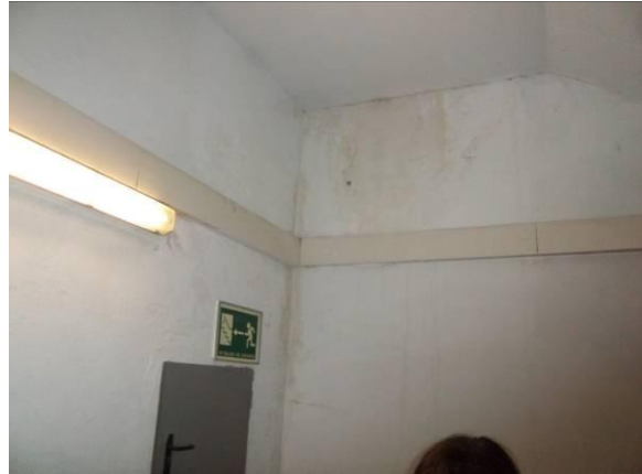
F-86. Salida emergencia andén 1. Humedad en tabiquería de 5º rellano.
