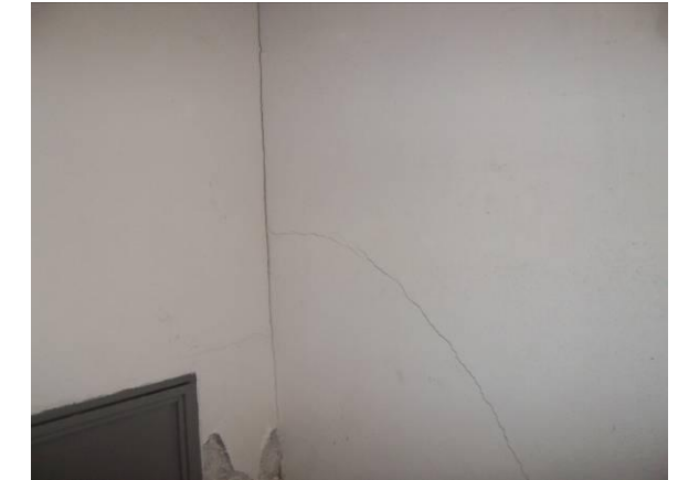
F-87. Salida de emergencia andén 1. Fisuras en rellano 1º.
