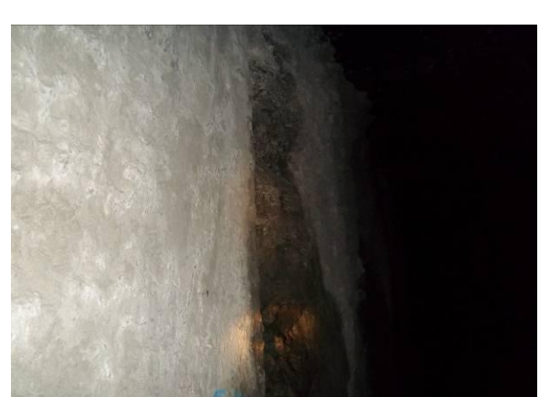
F-22. Pantalla de rampa de acceso. Filtración en junta entre pantallas.
