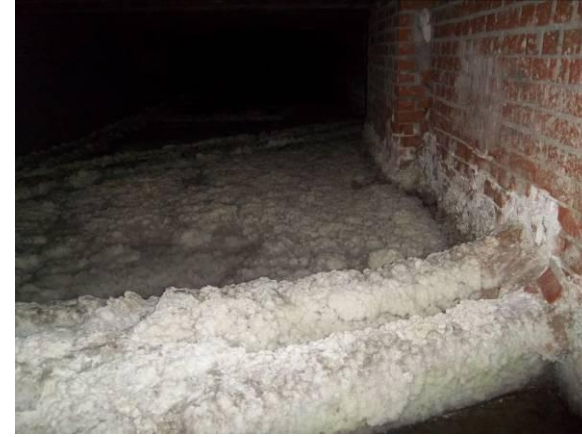
F-71. Bajo andén 2. Acumulaciones de sales muy importantes.
