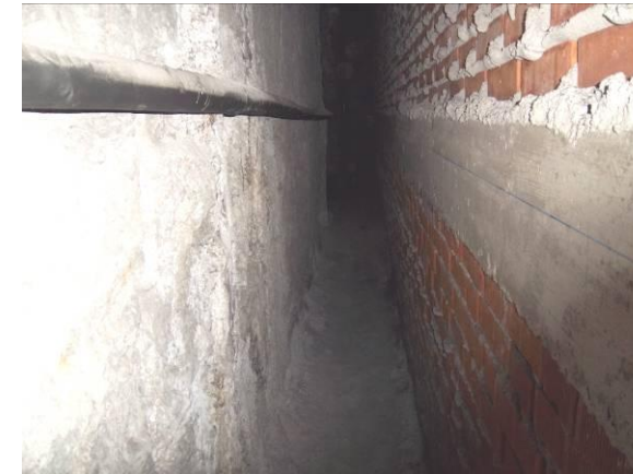
F-72. Cámara bufa andén 2. Aspecto tras cuarto de comunicaciones.
