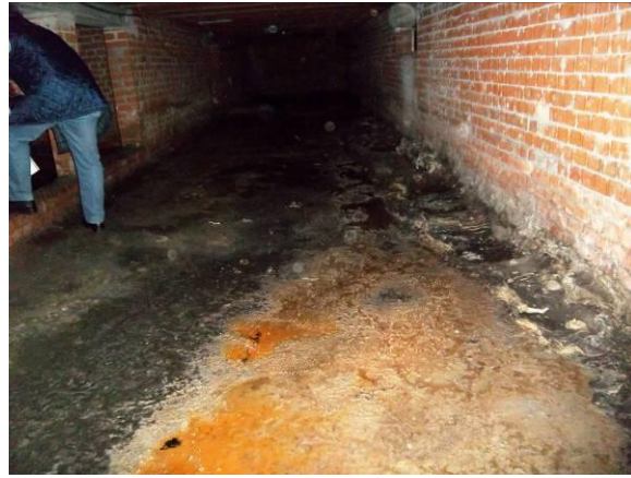
F-51. Bajo andén 1. Zona encharcada y con mortero de pendiente alterado.
