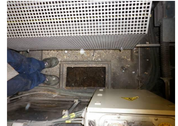
F-6. Acceso. Foso escalera mecánica nº 2. Humedad.
