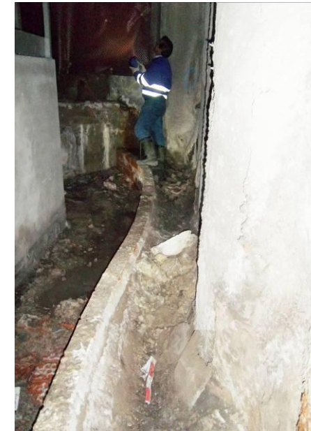
F-41. Cámara bufa tras andén 1. Canaleta rellena de gunita.
