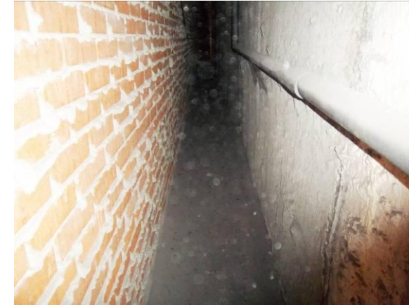
F-17. Nivel vestíbulo. Pantalla lateral derecha en cámara bufa tras cuartos.
