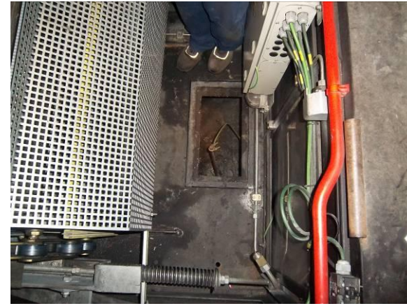
F-24. Foso escalera mecánica nº 3. Húmedo, con algo de agua.
