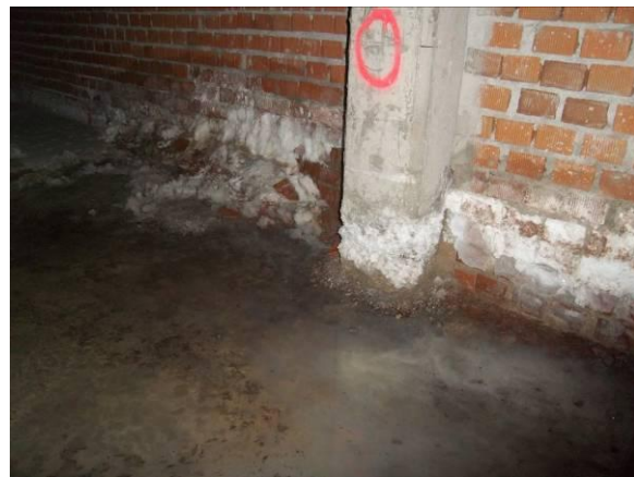
F-73. Bajo andén 2. Alteración de pilar de hormigón de apoyo de escaleras.
