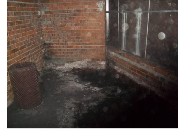
F-18. Ascensor acceso. Trasdos tabique lateral izquierdo a nivel vestíbulo.
