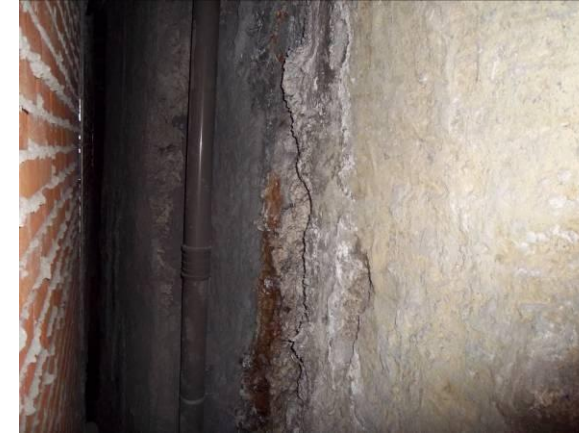
F-53. Nivel andén. Pantalla izquierda (andén 2). Humedad en junta de pantalla.
