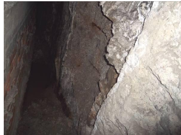
F-69. Cámara bufa andén 1. Detalle de hormigón alterado, tras cuarto nº 8.
