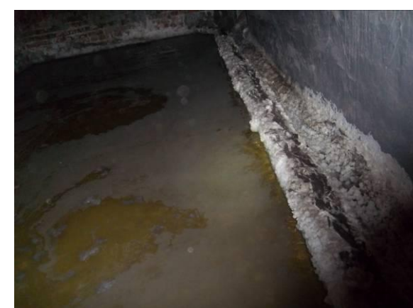
F-68. Bajo andén 2. Inundado y canaleta longitudinal inoperativa.
