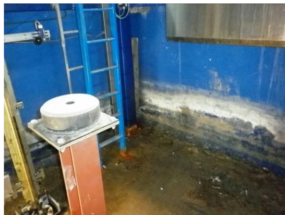
F-33. Foso ascensor vestíbulo-andén 1. Humedad en solera y pintura descarnada.
