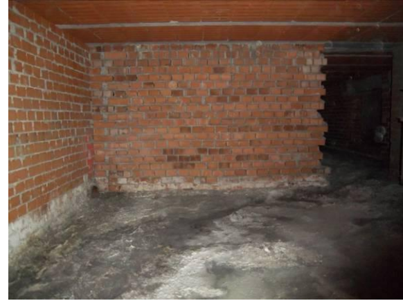
F-67. Bajo andén 1. Mortero alterado y sales. Final de zona estrecha de estación.
