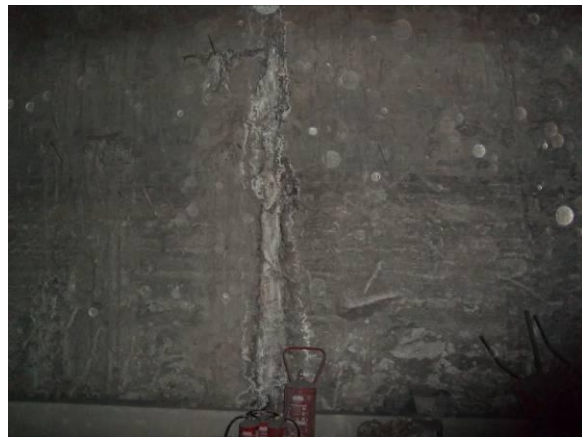
F-15. Nivel vestíbulo. Pantalla lateral derecha. Humedades en zona ancha.
