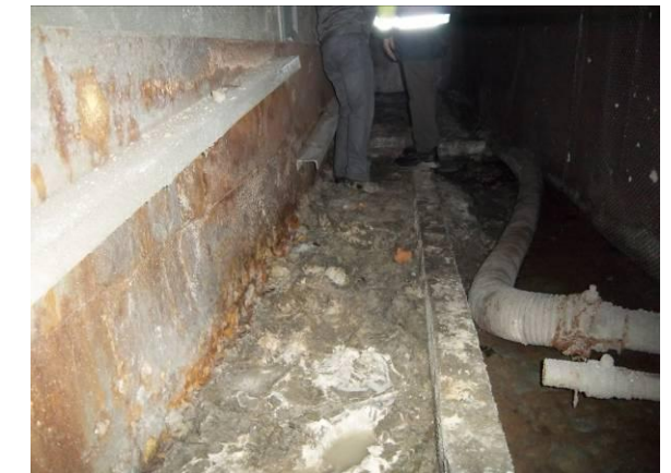
F-79 Pozo de extracción. Aspecto de canaleta y solera de pozo en lado derecho. Gran acumulación de sales.
