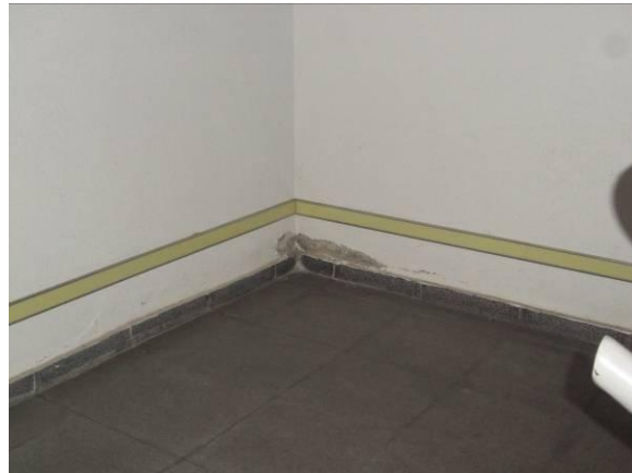
F-100. S. emergencia andén 2. Humedad en primer rellano.
