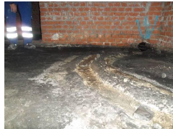
F-66. Bajo andén 2. Canalización "media caña", alterada y colmatada.
