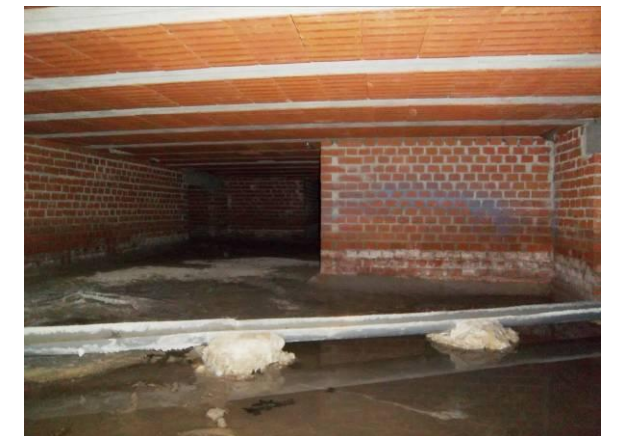
F-56. Bajo andén 1. Inundado y acumulación de sales. Media caña de PVC.
