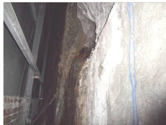
F-42. Nivel andén. Pantalla derecha (andén 1). Filtración en inicio de zona estrecha.
