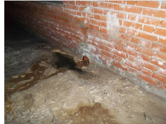
F-81. Bajo andén 1. Aspecto cuarto tubo de desagüe (P.K. 4+442.69) al drenaje central.
