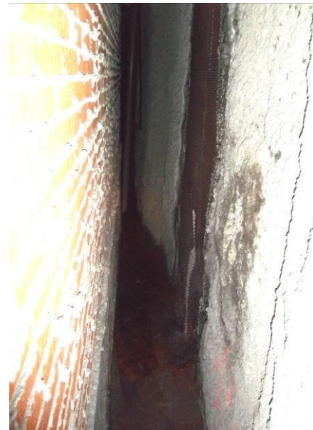
F-35. Cámara bufa andén 1. Filtración en junta entre pantallas con lámina drenante.
