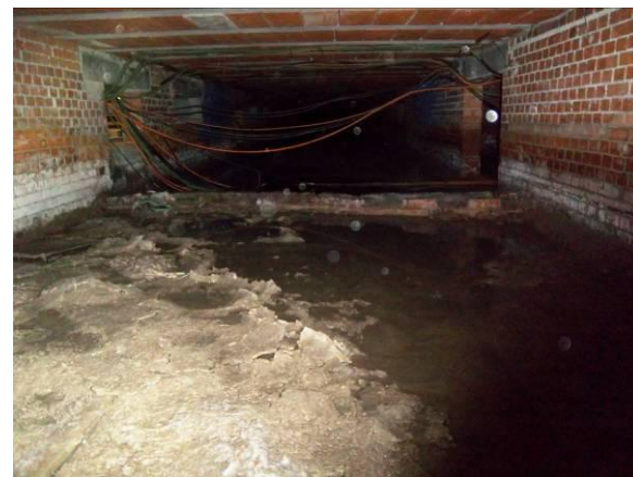
F-60. Bajo andén 2. Inundado y acumulación de sales.
