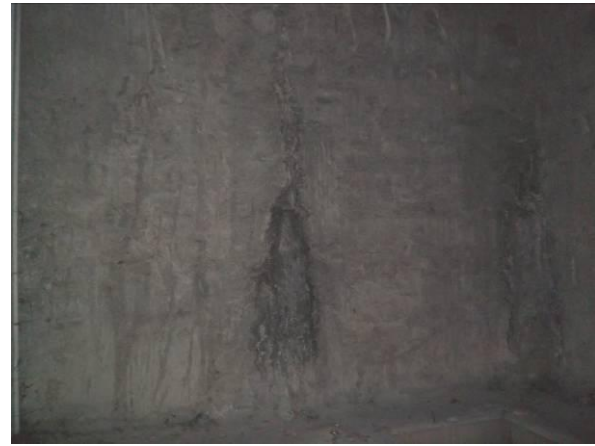
F-23. Nivel vestíbulo. Pantalla lateral izquierda. Humedad en pozo compensación.
