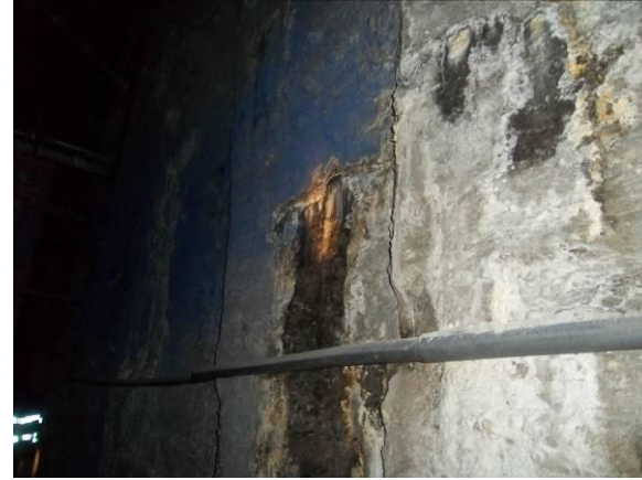
F-44 Cámara bufa tras andén 1. Zona ancha estación tras escaleras. Filtración.
