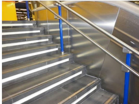
F-35. Escaleras vestíbulo-andén 2. Escalera fija despegada de lateral de esc mec nº 5.
