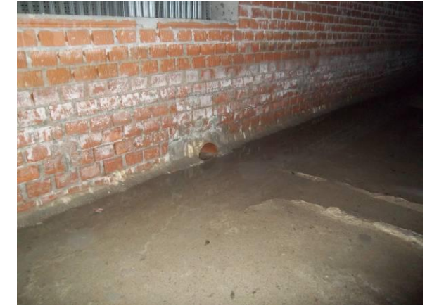
F-85. Bajo andén 2. Zona encharcada. Detalle segundo desagüe.
