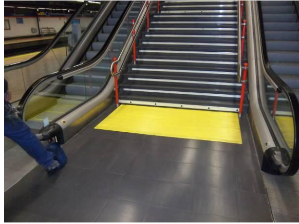
F-43. Escaleras nivel intermedio-andén 1 (Escaleras mecánicas nº 7 y nº 8).
