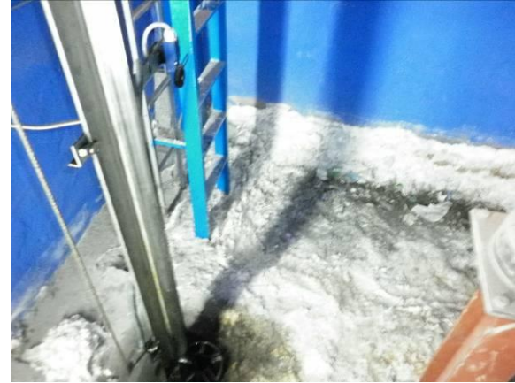
F-39. Nivel andén. Foso ascensor vestíbulo-andén 2. Acumulación de sales.
