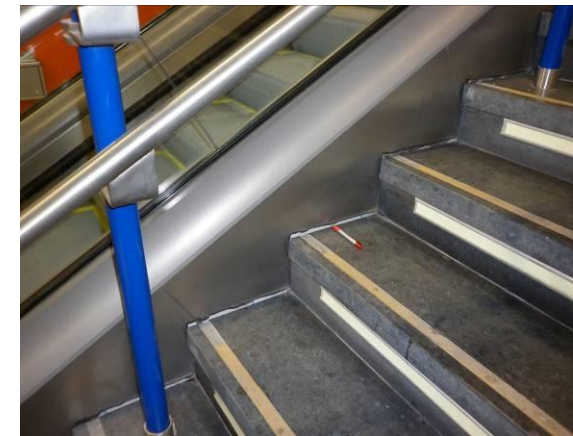
F-9. Escalera de hormigón en acceso. Despegada de escalera mecánica nº 2.
