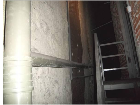
F-43. Cámara bufa andén 2. Filtración en junta entre pantallas con lámina drenante.
