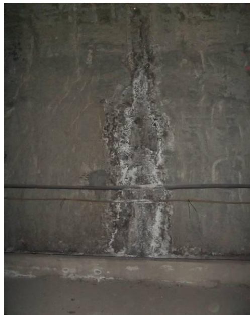
F-13. Nivel vestíbulo. Pantalla frontal inicio estación. Humedad en junta de pantalla.
