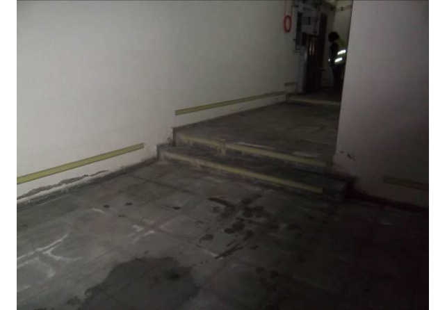
F-95. Salida de emergencia acceso al exterior. Acumulación de agua en rellano procedente de puerta acceso a pozo ventilación.
