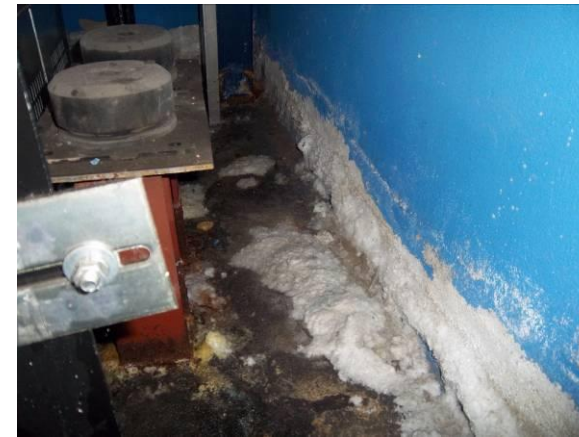
F-51. Foso ascensor vestíbulo-andén 1. Sales junto paramento lateral.
