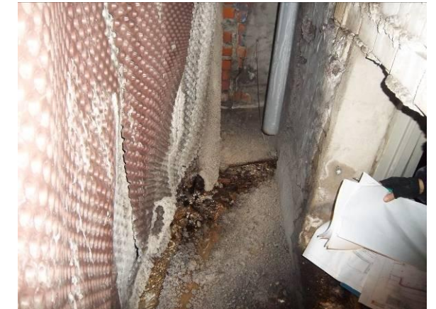
F-58. Nivel andén. Pantalla izquierda (andén 2). Filtración en junta de pantalla.
