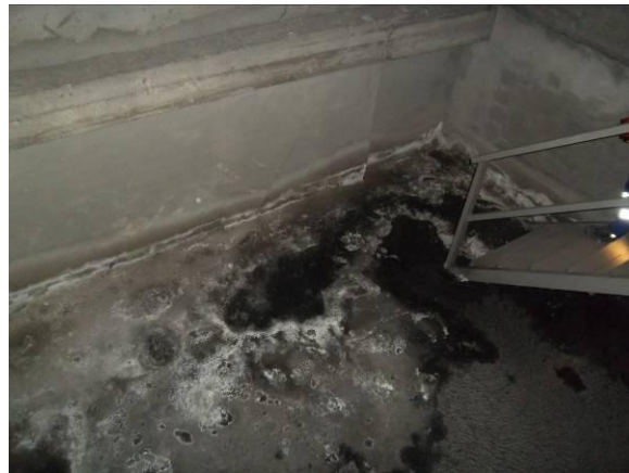
F-92. Pozo inmisión andén 1. Tras sala de ventilación. Mortero pendiente alterado.
