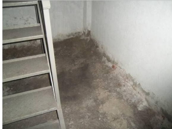
F-94. Salida emergencia andén 1. Cuarto del seccionador, humedad y sales en solera.
