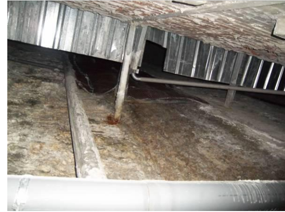
F-49. Nivel andén. Pantalla derecha (andén 1). Filtración en zona ancha de estación.
