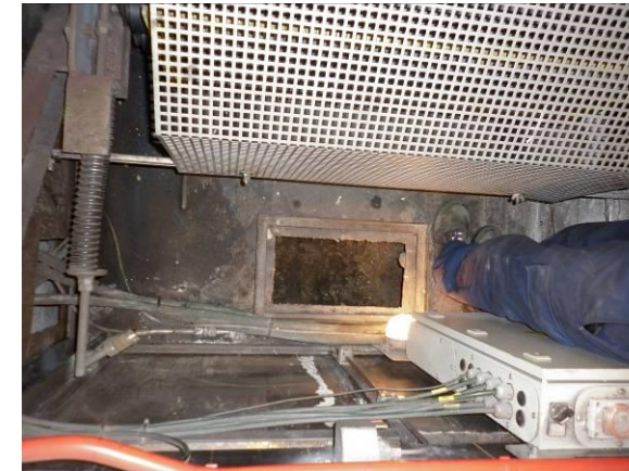
F-5. Acceso. Foso escalera mecánica nº 1. Humedad y sales.
