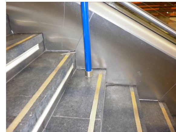
F-32. Escalera de hormigón vestíbulo.-andén 2, despegada de esc. mecánica nº 5.
