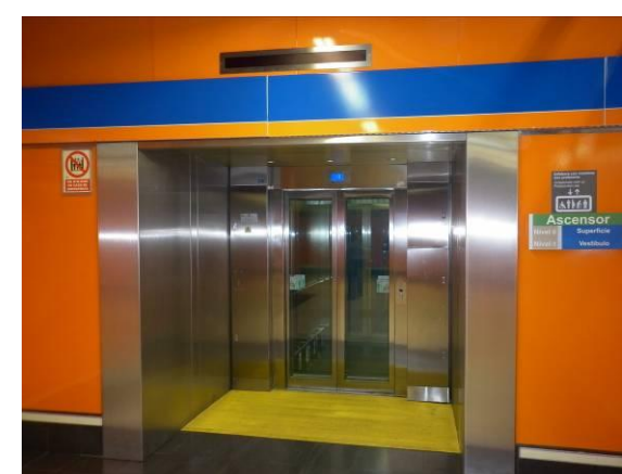
F-11. Ascensor acceso. Vista a nivel de vestíbulo.
