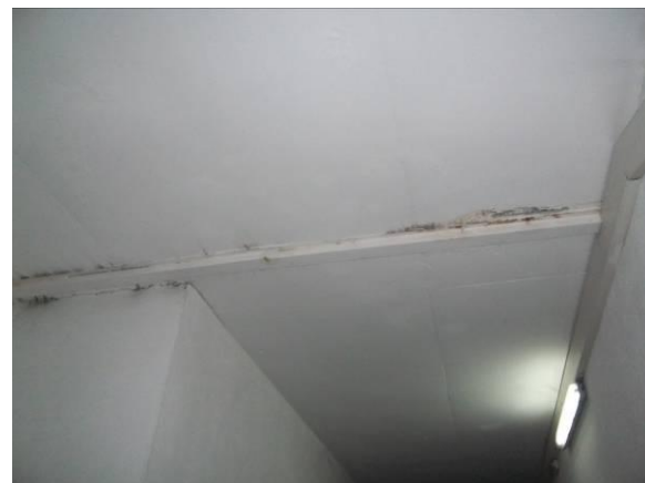
F-92. Salida de emergencia acceso al exterior. Humedad en losa de cubierta.
