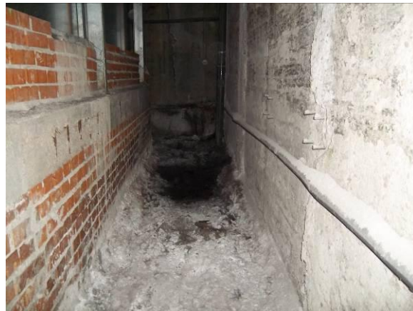
F-49. Cámara bufa tras andén 2 en zona ancha tras escaleras. Acumulación de sales.
