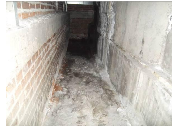
F-53. Cámara bufa andén 2, a base muro rampa. Agua estancada y muchas sales.
