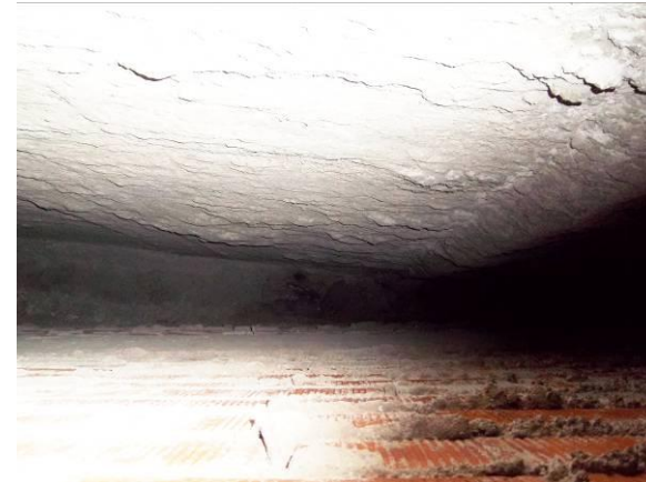
F-97. Salida emergencia andén 1. Cámara bufa a nivel de bajo andén.
