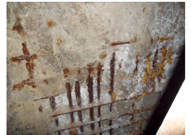
F-65. Salida de emergencia andén 1. Aspecto pantalla a nivel de andén. .
