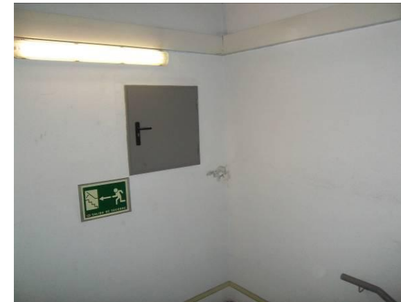
F-97. S. emergencia andén 1. Humedad en quinto rellano (a nivel vestíbulo).
