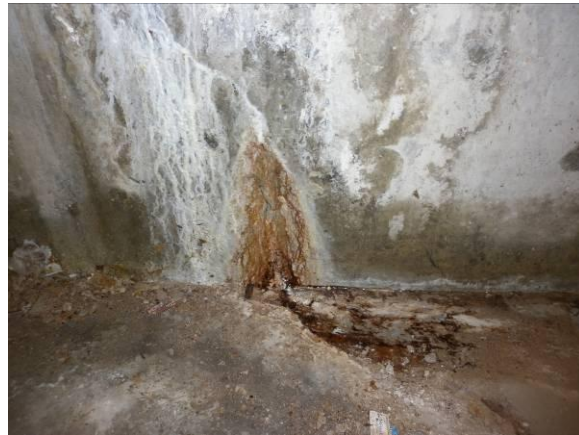
F-13. Foso ascensor acceso. Surgencia en paramento de foso, bajo puerta.
