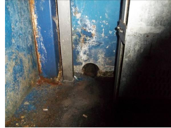
F-17. Ascensor acceso. Foso ascensor. Vista del desagüe.
