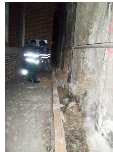
F-35. Cámara bufa nivel andén 2. Canaleta rellena. (Zona tras escaleras)
