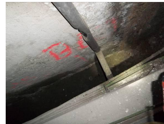
F-45. Cámara bufa nivel andén 1 tras caja ascensor. Humedad en la base.
