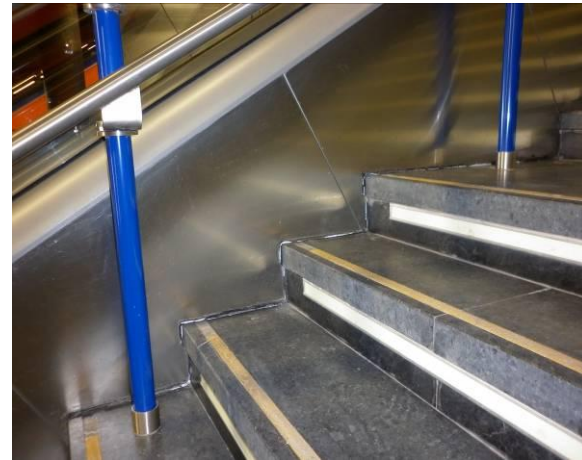
F-30. Escalera de hormigón vestíbulo.-andén 1, despegada de esc. mecánica nº 4.
