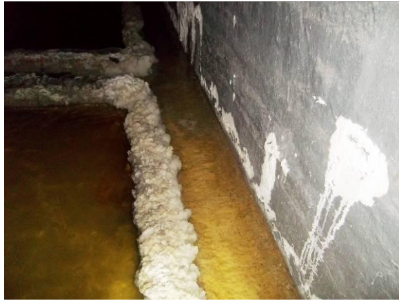
F-70. Bajo andén 2. Canaleta longitudinal inoperativa. Acumulación de sales.
