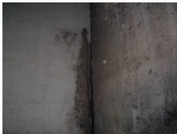
F-88. Salida emergencia andén 1. Trasdos de tabiquería de salida de emergencia andén 1. Rellano 5º y 7º.
