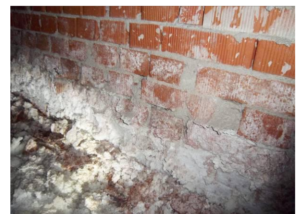
F-75. Bajo andén 2. Alteración muros bajo andén. Muro de separación plataforma vías.
