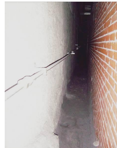
F-17. Nivel vestíbulo. Cámara bufa tras cuartos en zona ancha estación.
