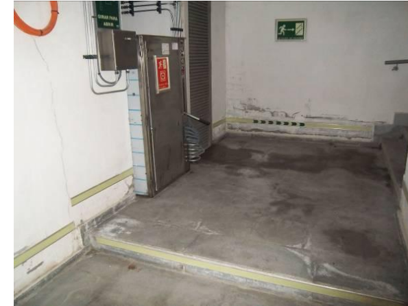
F-94. Salida de emergencia acceso al exterior. Acumulación de agua junto puerta acceso a pozo ventilación.
