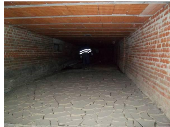
F-46. Bajo andén 2. Aspecto general en zona estrecha. Húmedo y con barro.
