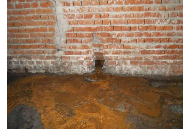
F-62. Bajo andén 2. Desagüe de cámara bufa en zona de muro de rampa.
