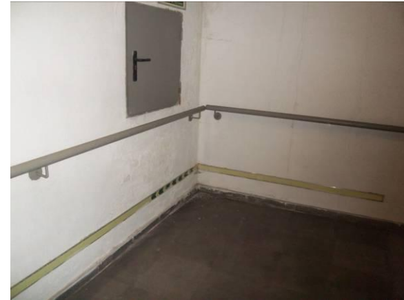
F-87. Salida emergencia andén 1. Humedad en tabiquería de 5º rellano.
