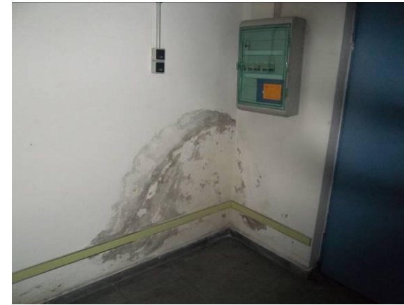
F-77. S. de emergencia andén 1. Humedad junto puerta de acceso (a nivel andén).
