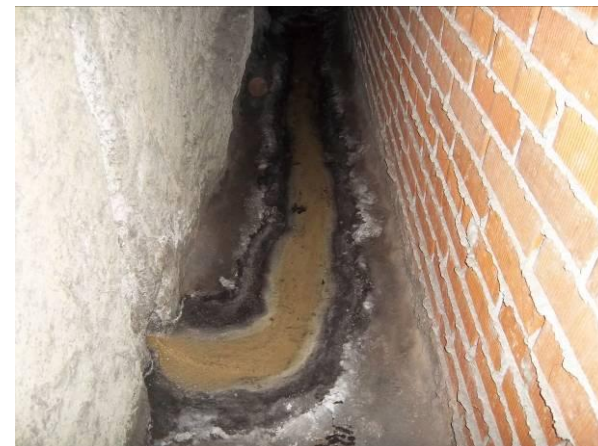
F-14. Taladro en pantalla derecha nivel vestíbulo, tras cuartos. Mana agua.
