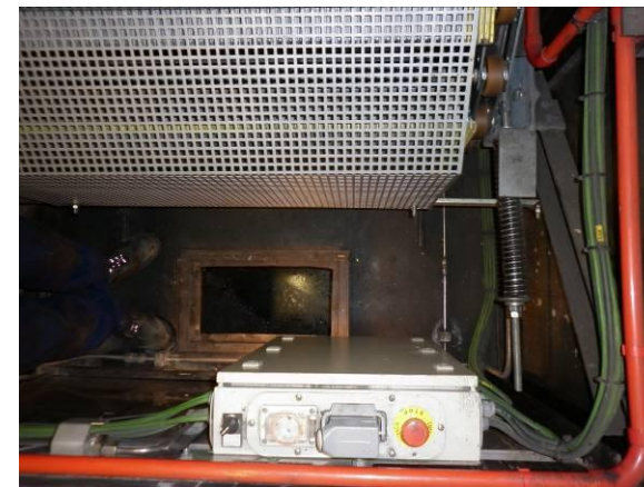
F-23. Foso escalera mecánica nº 3. Agua.
