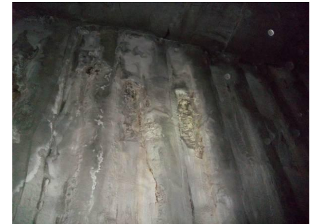
F-16. Gunita desprendida por entrada de agua. Pantalla lateral izquierda.
