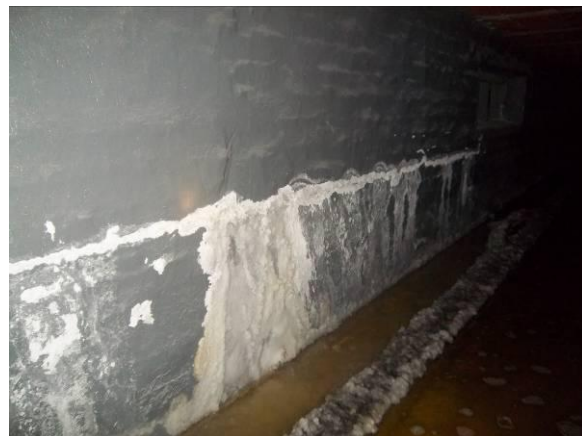
F-75. Bajo andén 2. Impermeabilización de muro. Fisuras con sales.
