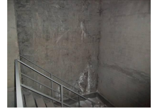
F-83. Pozo de inmisión andén 2 tras sala ventilación. Humedad en pantalla.
