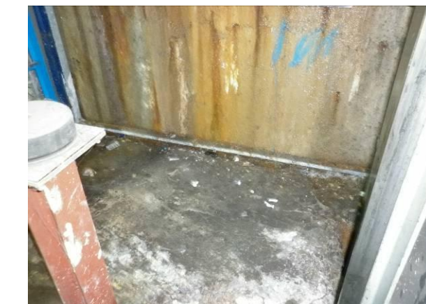
F-10. Acceso. Foso ascensor de acceso. Mortero de solera alterado.
