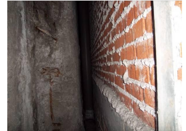
F-63. Cámara bufa andén 1. Tecleo de pantallas tras sala ventilación.
