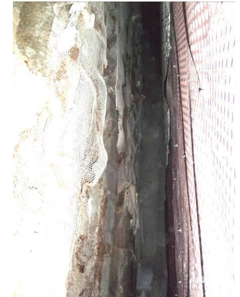
F-60. Salida de emergencia andén 2. Cámara bufa nivel pasillo conexión. Lámina drenante en tabiquería.
