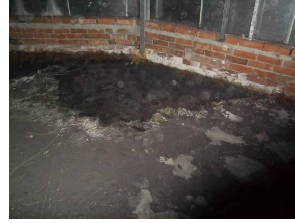
F-19. Ascensor acceso. Acumulación en agua y sales en trasdos tabiquería caja ascensor.
