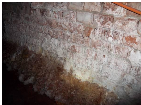
F-63. Bajo andén 1. Alteración de muros de fábrica de ladrillo en bajo andén.
