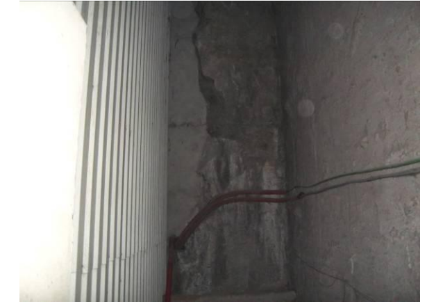
F-18. Nivel vestíbulo. Pantalla lateral y frontal en pozo compensación.
