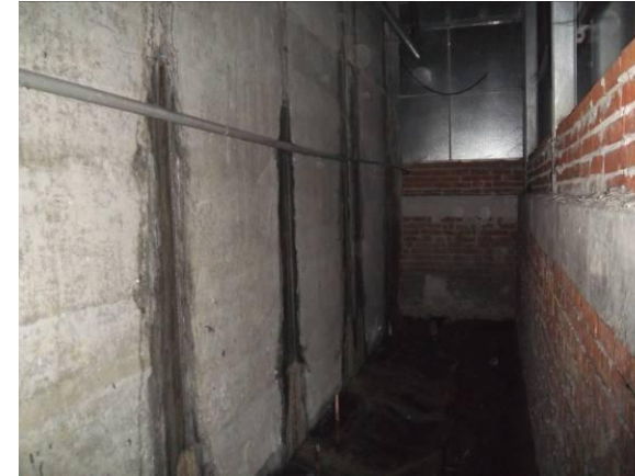
F-48. Cámara bufa andén 2. Filtración en muro rampa por agujeros para espadines.
