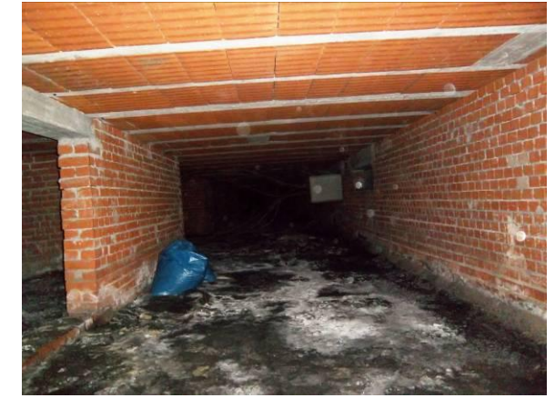
F-58. Bajo andén 2. Zona encharcada y próxima a la plataforma de vías.
