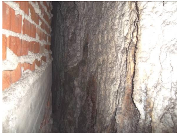
F-68. Cámara bufa andén 1. Hormigón de pantallas alterado, tras cuarto nº 8.
