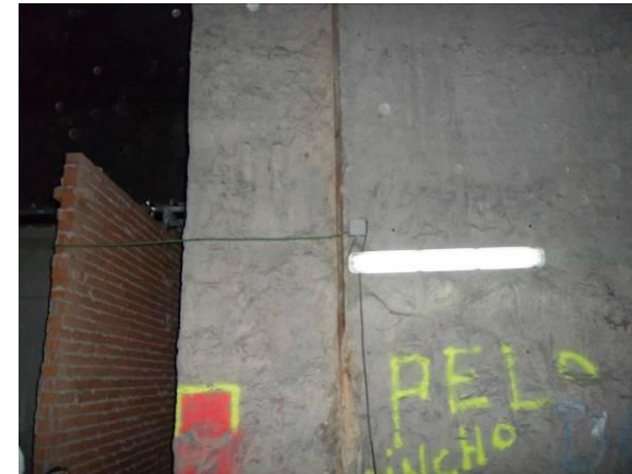
F-27. Nivel vestíbulo (pantalla izquierda en inicio zona estrecha). Antigua humedad.
