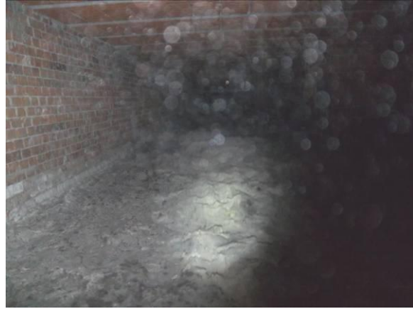
F-66. Bajo andén 1. Mortero totalmente alterado y roto. Zona central estación.
