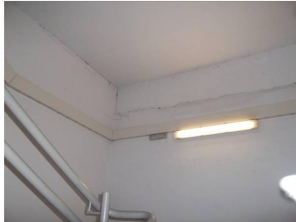
F-96. Salida emergencia andén 1. Fisura en tabiquería del rellano 3º.
