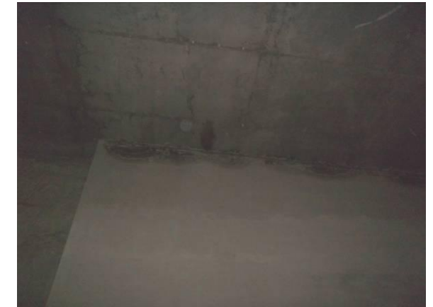
F-28. Nivel vestíbulo. Muro cierre rampa en pantalla izquierda. Humedades en junta con losa cubierta.
