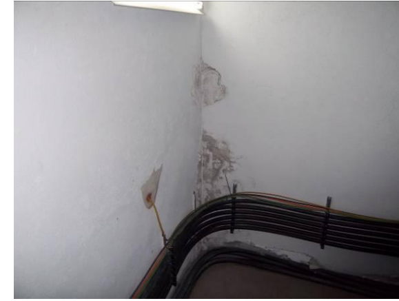
F-95. S. emergencia andén 1. Humedad en cuarto de seccionador.
