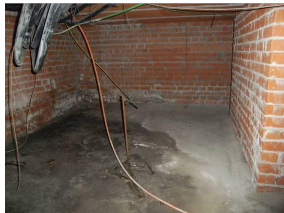
F-56. Bajo andén 1. Zona alejada de plataforma de vías. Mortero de pendiente poco alterado.
