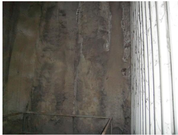
F-19. Pilotes con humedades en pozo inmisión (nivel vestíbulo).
