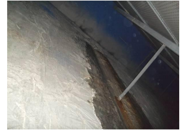
F-20. Nivel vestíbulo. Pantalla lateral izquierda. Coquera y filtración.
