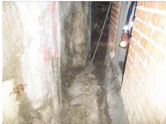
F-3. Acceso. Aspecto de cámara bufa en su acceso. Agua y mortero de base alterado.
