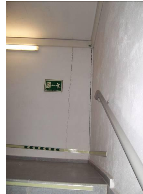
F-86. Salida de emergencia andén 1. Fisuras verticales en rellano 1º.
