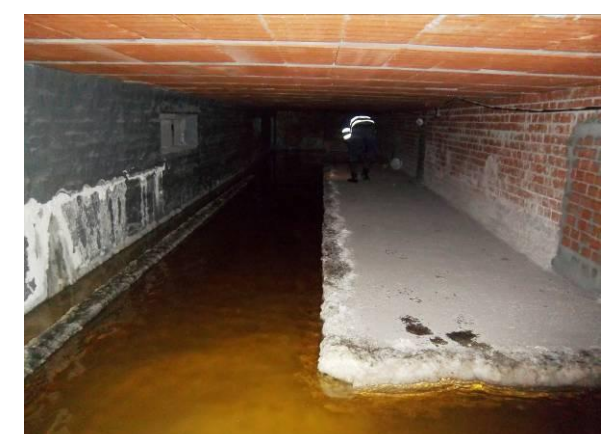
F-69. Bajo andén 2. Inundado y canaleta longitudinal anegada e inoperativa.
