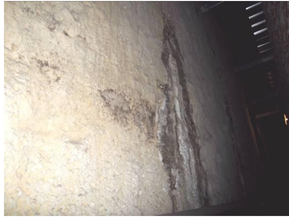
F-42. Cámara bufa andén 2. Antigua filtración en junta de pantallas (tras sala de ventilación).
