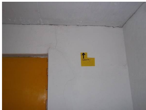
F-57. Salida de emergencia andén 1. Grieta junto a puerta de acceso.
