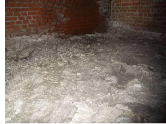
F-72. Bajo andén 2. Mortero alterado y roto. Zona anexa a muro cierre de rampa.
