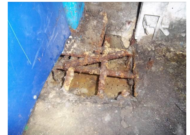
F-10. Desagüe foso ascensor acceso. Con agua y parcialmente colmatado.
