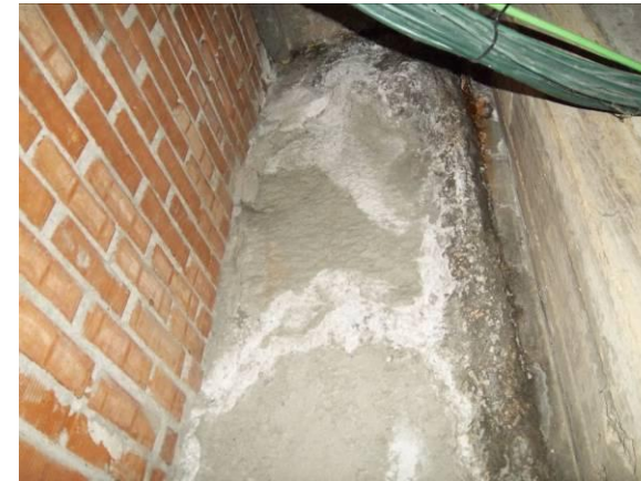
F-7. Cámara bufa acceso. Filtración en junta muro de hormigón acceso y pantalla.
