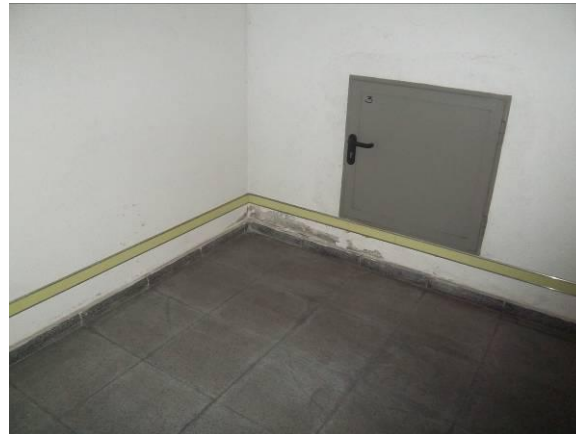
F-101. S. emergencia andén 2. Humedad en segundorellano.
