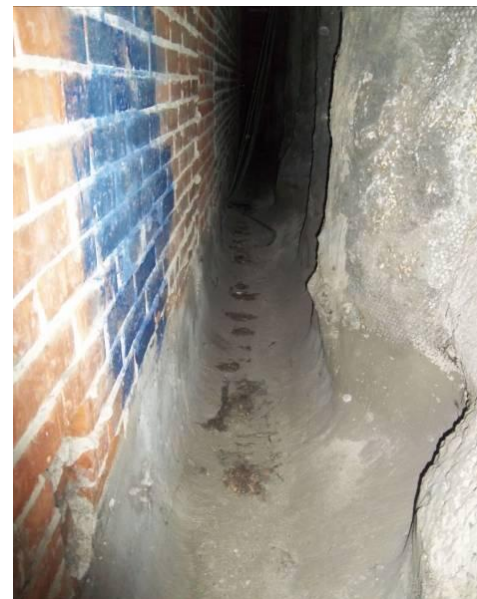
F-14. Cámara bufa nivel vestíbulo. Pantalla lateral izquierda (hacia PK crecientes).
