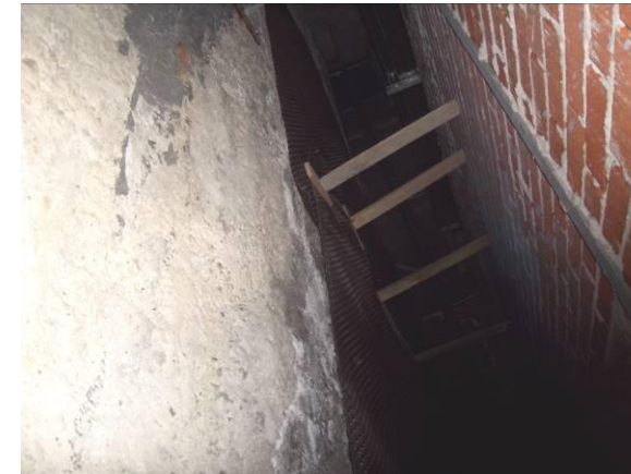
F-57. Nivel andén. Pantalla izquierda (andén 2). Filtración en junta de pantalla.
