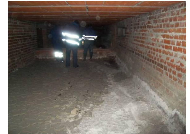
F-52. Bajo andén 1. Aspecto general. Húmedo y con barro.
