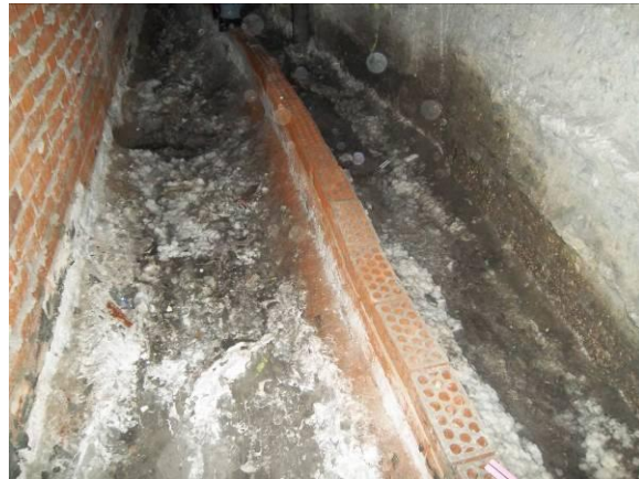
F-66. Cámara bufa andén 1. Aspecto canaleta en la zona tras escaleras.
