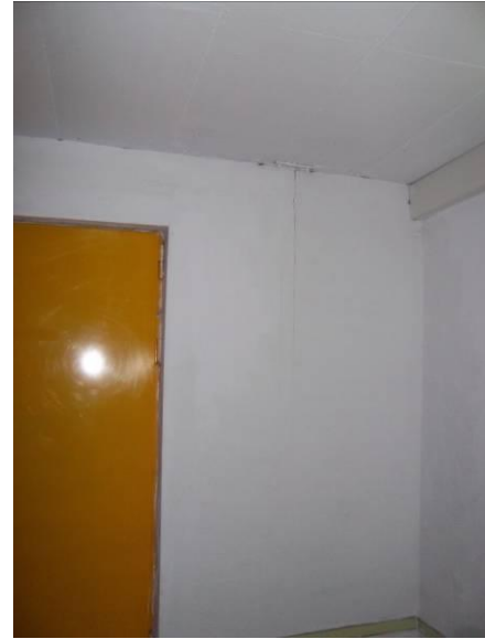
F-63. Salida de emergencia andén 2. Grieta junto a puerta de acceso.
