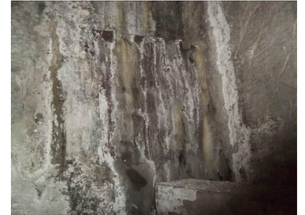
F-77. Pozo de inmisión andén 1. Fisura y filtración en pantalla.
