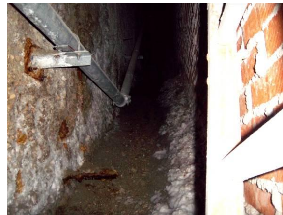
F-64. Salida de emergencia andén 1. Cámara bufa con agua y sales a nivel andén.
