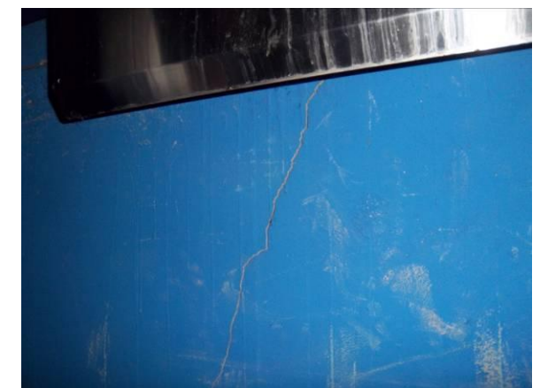
F-54. Foso ascensor vestíbulo-andén 1. Grieta en paramento bajo puerta.
