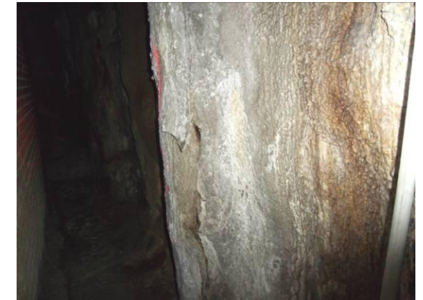
F-6. Acceso. Cámara bufa en paramento frontal. Gunita de recubrimiento desprendida.
