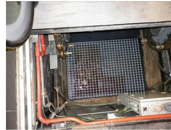
F-7. Foso escalera mecánica nº 1. Con agua.
