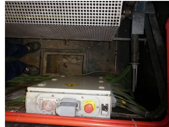
F-7 Acceso. Foso escalera mecánica n.º2. Seco.
