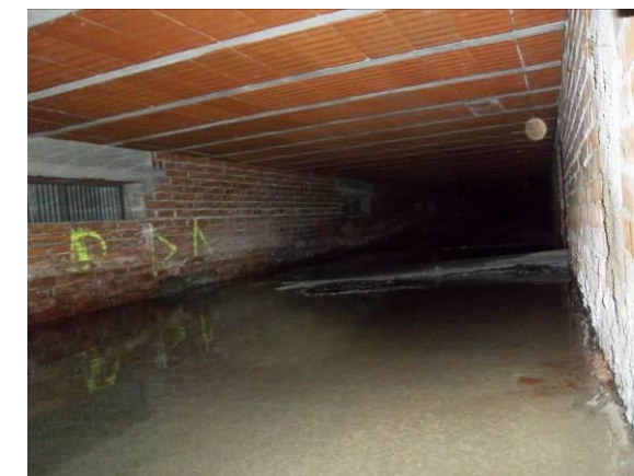
F-76. Bajo andén 1. Zona inundada inicio del bajo andén, próximo a la plataforma de vías.
