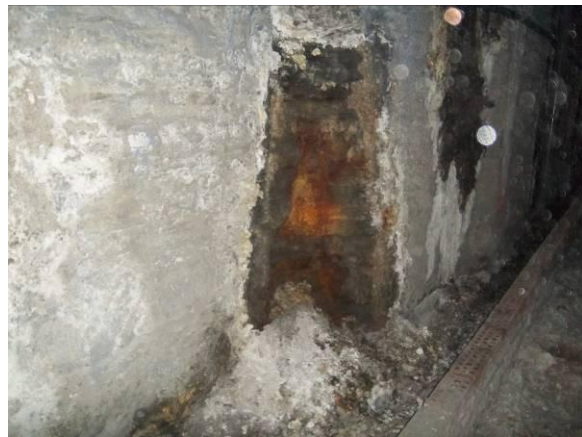
F-45. Cámara bufa tras andén 1. Zona ancha estación tras escaleras. Tecleo y filtración.
