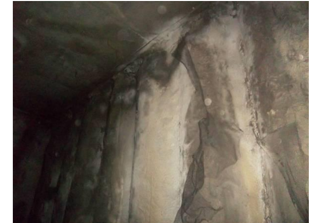
F-65. Pozo inmisión (derecho) nivel vestíbulo sobre andén 1. Pantalla de pilotes seca.
