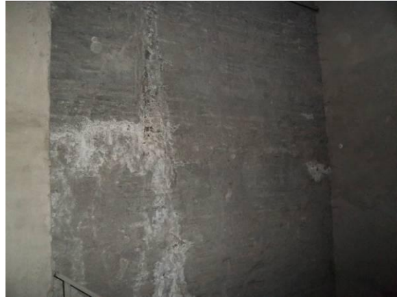
F-76. Pozo de inmisión andén 1 previo sala ventilación. Pantalla con humedad antigua.
