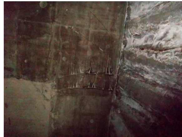
F-12. Eflorescencias en cara inferior losa cubierta (zona estrecha estación).
