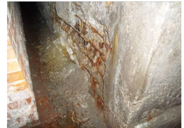
F-54. Cámara bufa andén 2 Coquera en pantalla y armadura vista junto muro rampa.
