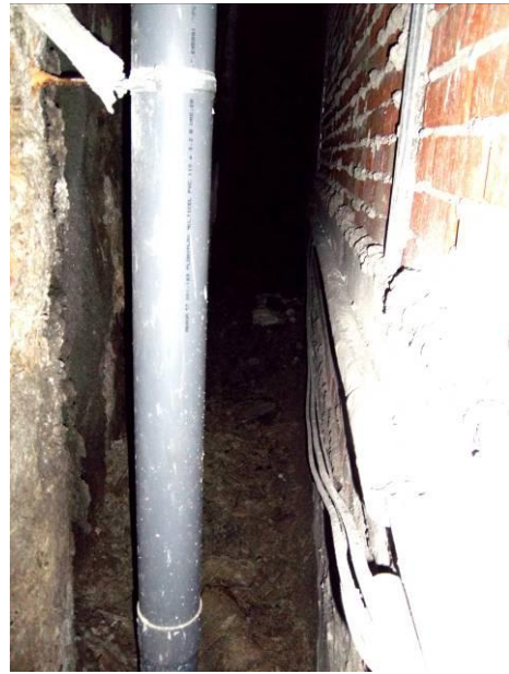
F-37. Cámara bufa tras andén 1. Humeda y rellena de gunita (zona tras cuartos).
