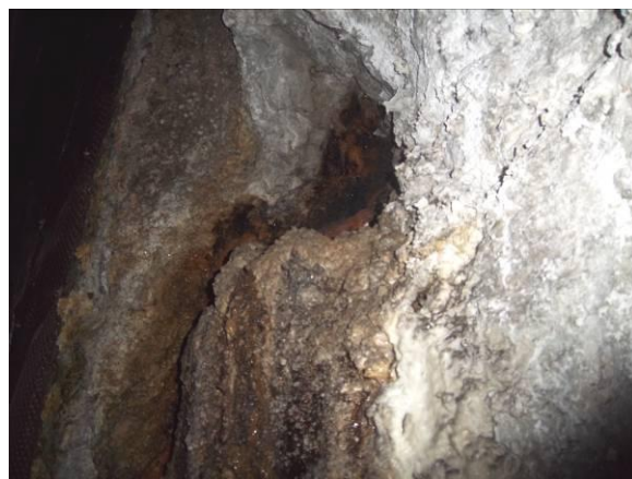
F-41. Nivel andén. Pantalla derecha (andén 1). Coquera en pantalla con humedad.
