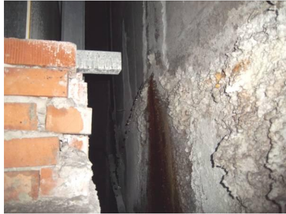
F-54. Cámara bufa tras andén 2. Zona ancha. Filtración con sales en muro cierre rampa.
