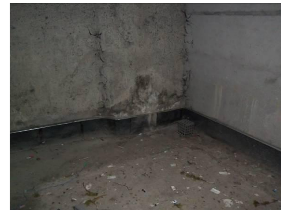
F-69. Pozo de inmisión andén 1. Solera seca el 16-04-2013.
