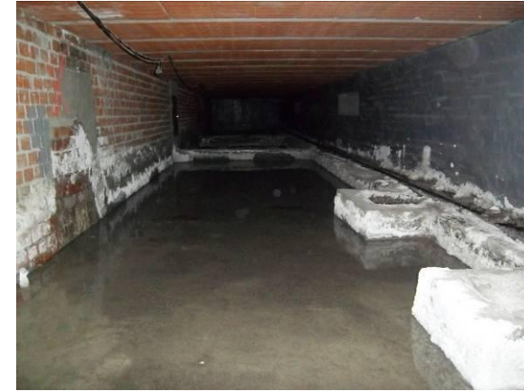
F-65. Bajo andén 1. Inundado. Inspección de abril de 2013.
