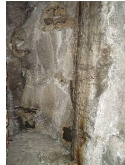
F-59. Salida de emergencia andén 1. Surgencia entre pilotes. Cámara bufa en tercer rellano.
