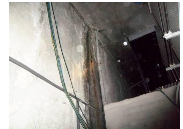
F-46. Cámara bufa nivel andén 1. Filtración en junta pantallas tras cuarto enclavamiento.
