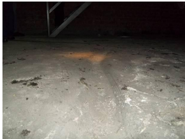
F-65. Bajo andén 2. Aspecto de mortero de pendiente en pozo de acceso a bajo andén.
