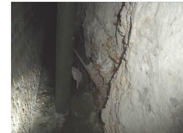
F-55. Cámara bufa andén 2. Còquera con armadura vista en pantalla zona estrecha.
