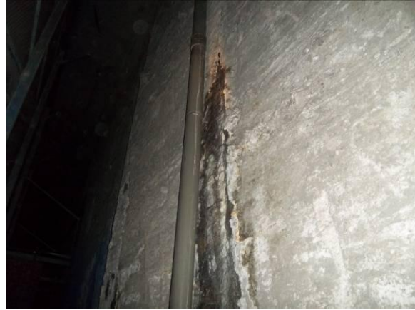
F-43. Cámara bufa tras andén 1. Zona ancha estación tras escaleras. Filtración en junta.
