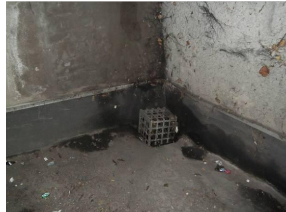
F-76. Pozo de inmisión andén 2. Desagüe semicolmatado. Humedad en tabiquería.
