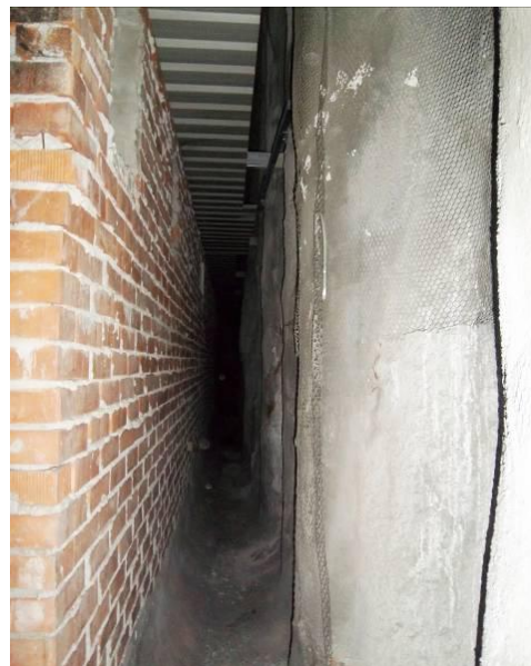
F-13. Cámara bufa nivel vestíbulo. Pantalla lateral izquierda (hacia PK crecientes).
