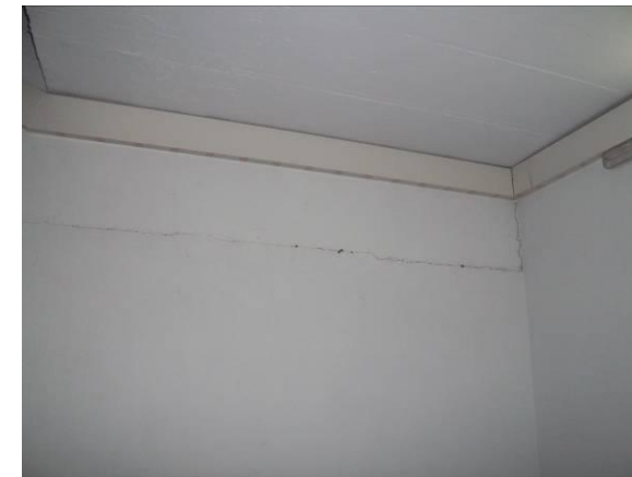
F-99. S. emergencia andén 1, Fisura en tabiquería tercer rellano.
