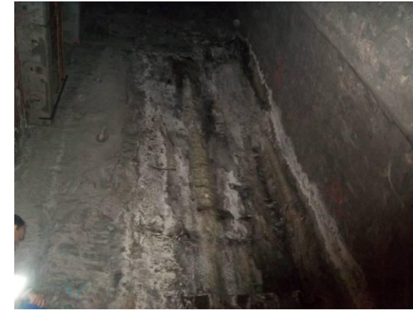
F-43. Nivel andén. Pozo de inmisión. Filtración en junta pantalla y fisura.
