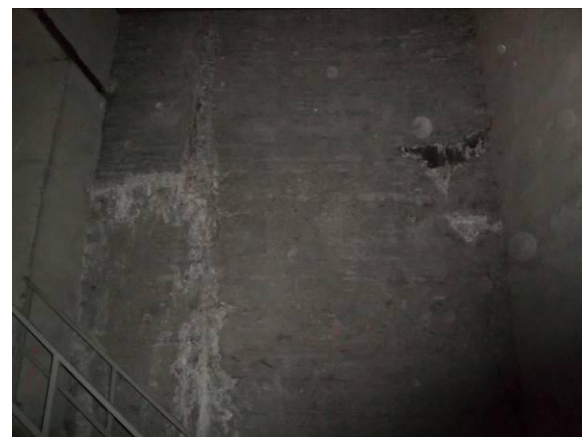
F-48 Pozo de inmisión andén 1 previo sala ventilación. Pantalla con humedad antigua.
