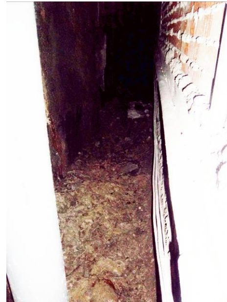
F-38. Cámara bufa tras andén 1. Humeda y rellena de gunita (zona tras cuartos).
