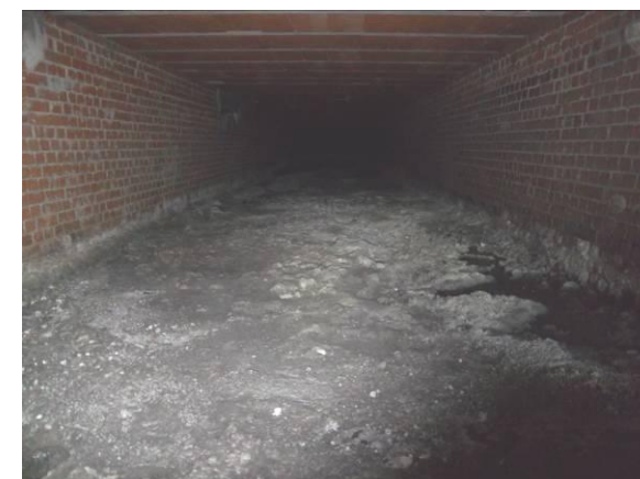
F-72. Bajo andén 2. Mortero alterado y roto. Zona estrecha. Vista hacia PK decrecientes.
