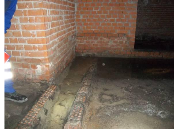
F-54. Bajo andén 1. Canaleta transversal de fábrica. Tubo de desagüe colmatado.
