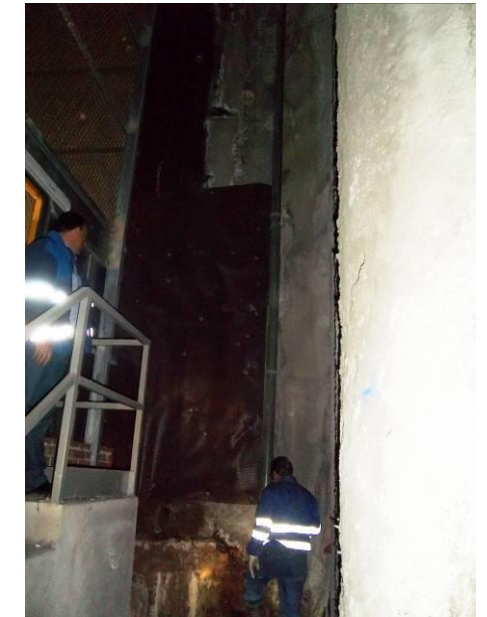
F-42. Junta pilotes muro cierre rampa. Surgencia.
