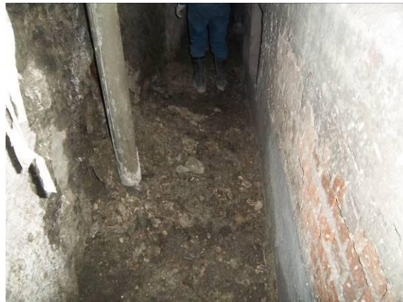
F-50. Nivel andén. Pantalla derecha (andén 1). Filtración final de zona ancha estación.
