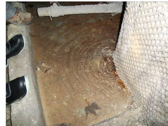
F-78 Pozo de extracción. Filtración en junta entre muro derecho de pozo y pantalla estación.
