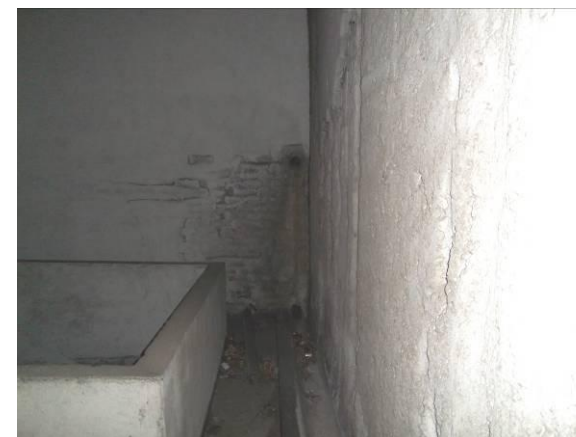
F-66. Pozo de compensación. Humedad en trasdos de tabique salida emergencia andén 1
