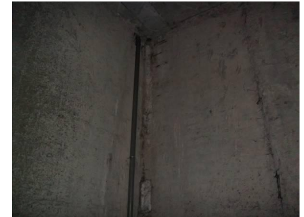
F-68. Pozo de inmisión andén 1. Pantallas perimetrales, secas.
