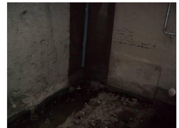
F-72. Pozo de compensación andén 1. Filtración con lámina drenante.
