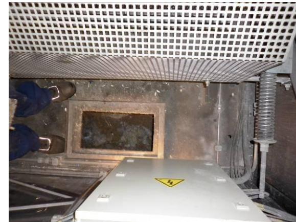
F-34. Nivel andén. Foso escalera mecánica nº 6, húmedo y con algunas sales.
