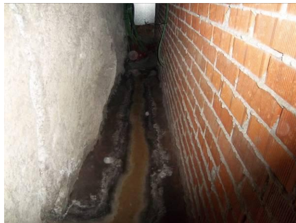
F-13. Camara bufa nivel vestíbulo. Pantalla derecha en zona tras cuartos. Agua.
