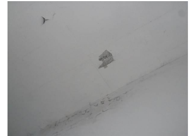
F-90. Salida de emergencia, losa de cubierta. Pintura desconchada.
