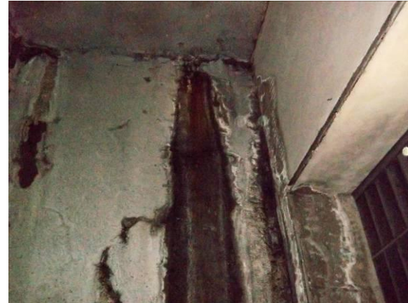
F-74. Pozo de inmisión andén 2. Filtración en pantalla lateral, junto a losa vestíbulo.
