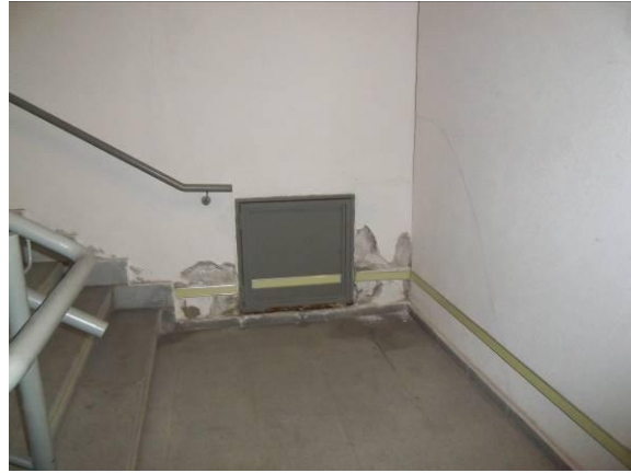
F-81. Salida de emergencia andén 1. Humedad en tabiquería rellano 1º.
