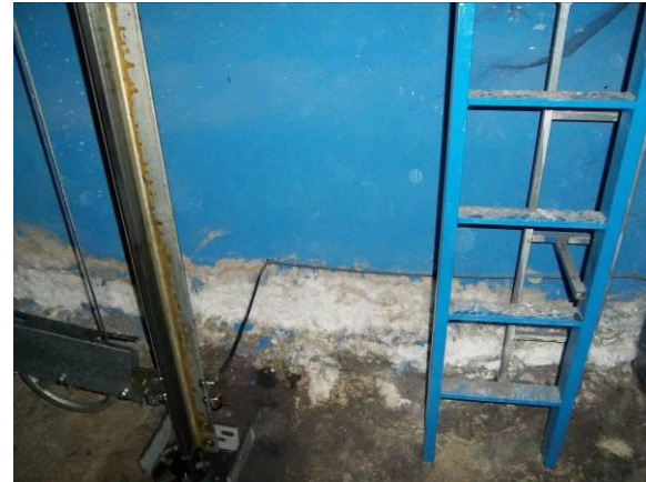
F-56. Foso ascensor vestíbulo-andén 2. Sales y pintura descarnada.
