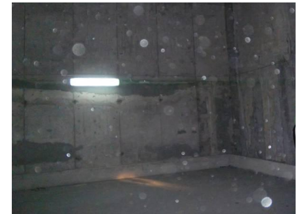
F-18. Muro cierre rampa a nivel vestibulo. Canaleta a pie de pantalla y de muro.
