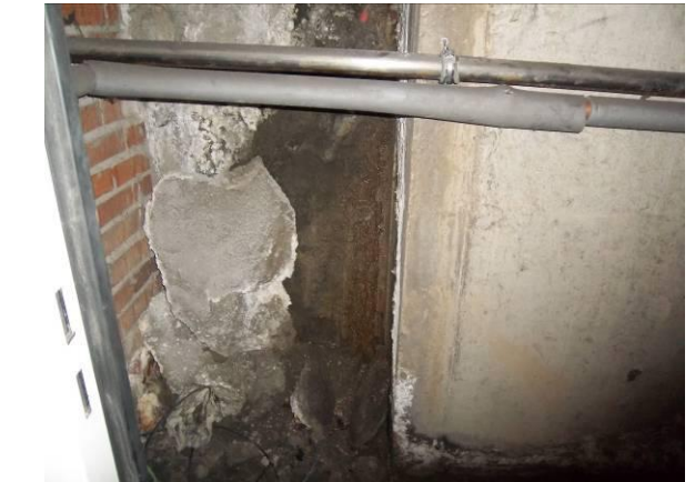
F-8. Cámara bufa acceso. Filtración en junta muro de hormigón acceso y pantalla.
