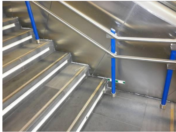
F-33. Escaleras vestíbulo-andén 1. Escalera fija despegada de lateral de esc mec nº 3.
