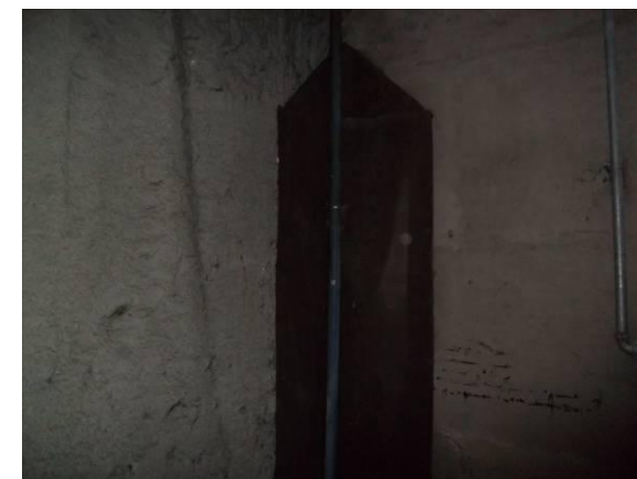
F-71. Pozo de compensación andén 1. Filtración con lámina drenante.
