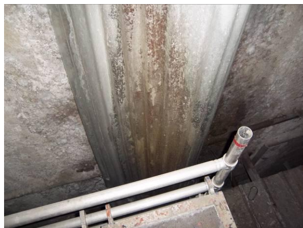
F-41. Entrada de agua por taladro en pantalla derecha.
