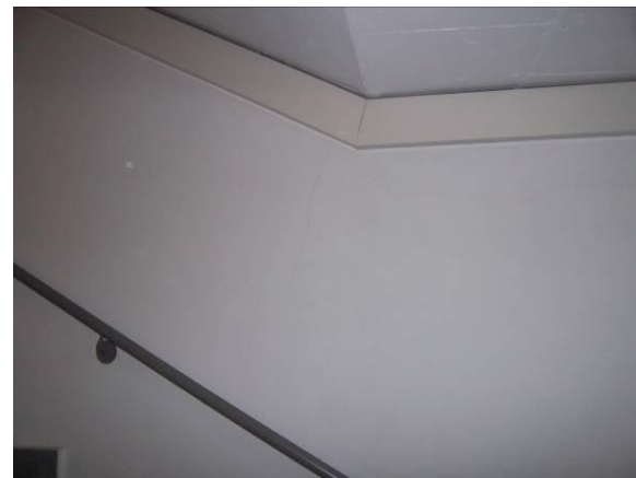
F-56. Salida de emergencia andén 1. Fisura en tabiquería entre rellano 1º y 2º.
