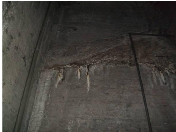
F-78. Pozo de compensación andén 1. Fisura horizontal en pantalla derecha.
