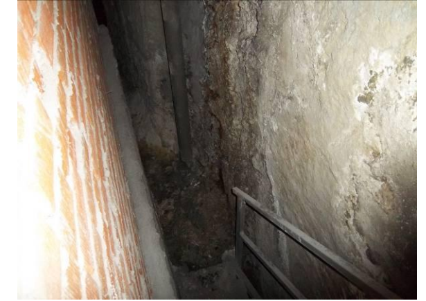
F-54. Nivel andén. Pantalla izquierda (andén 2). Humedad en junta de pantalla.
