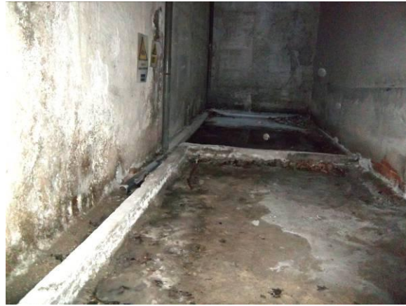
F-74. Pozo de compensación andén 1. Humedades, agua encharcada y sales
