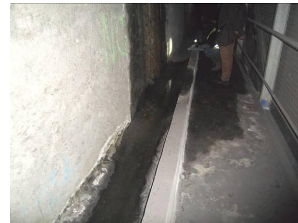
F-21. Nivel vestíbulo. Pantalla lateral izquierda. Filtración, agua en canaleta.
