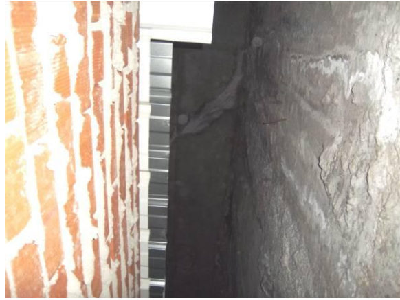
F-11. Nivel vestíbulo. Losa de cubierta, eflorescencia a favor de fisura.
