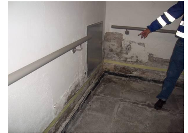
F-63. Salida de emergencia andén 1. Humedad en 1º rellano.
