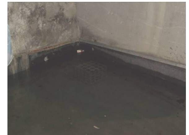
F-70. Pozo de inmisión andén 1. Inundado el 17-02-2014 (más de 0.50 m de agua).
