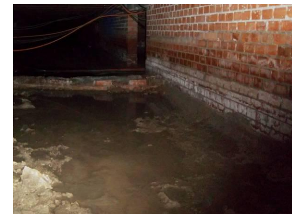
F-61. Bajo andén 2. Inundado. Canaleta en mal estado.
