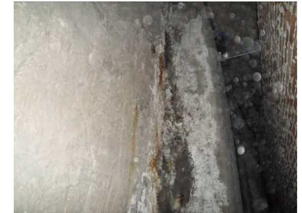
F-73. Cámara bufa andén 2. Filtración tras cuarto de enclavamiento. "Tecleo" de pantallas.
