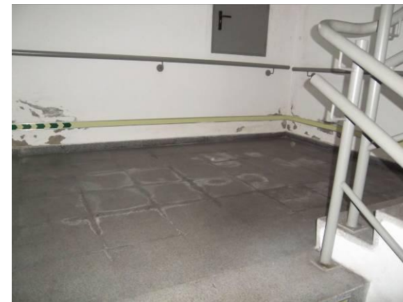
F-79. S. de emergencia andén 1. Humedad en primer rellano y solado con sales.
