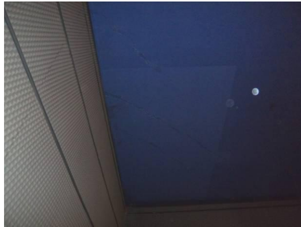
F-37. Fisuras y goteras en losa de cables sobre andén 1 tras la salida de emergencia.
