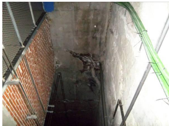
F-39. Humedad y eflorescencias en losa vestíbulo sobre cámara bufa andén 1.
