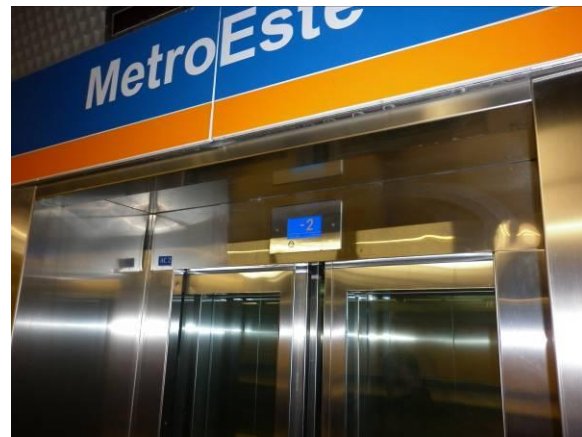
F-29. Ascensor vestíbulo-andén 1.
