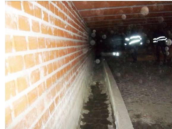
F-49. Bajo andén 2. Canaleta longitudinal con algo de barro.
