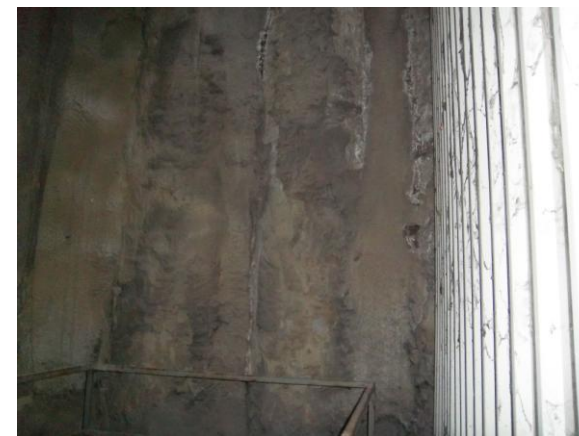
F-66. Pozo inmisión (izquierdo) nivel vestíbulo sobre andén 2. Humedades.
