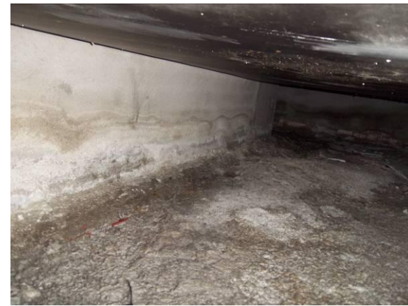
F-46. Escaleras n. intermedio-andén 1. Foso escalera mecanica nº 7, seco, con sales.
