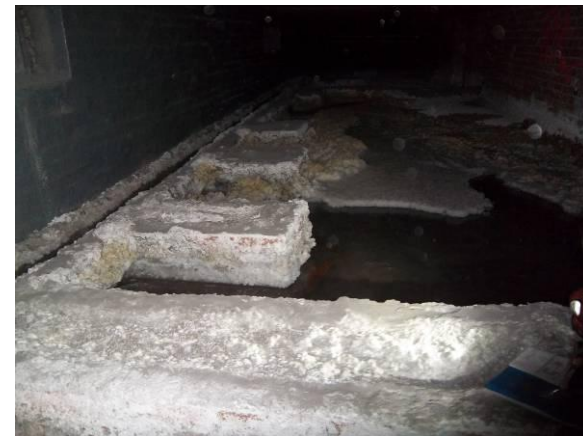
F-62. Bajo andén 1. Canaleta transversal cubierta de sales. Inoperativa.
