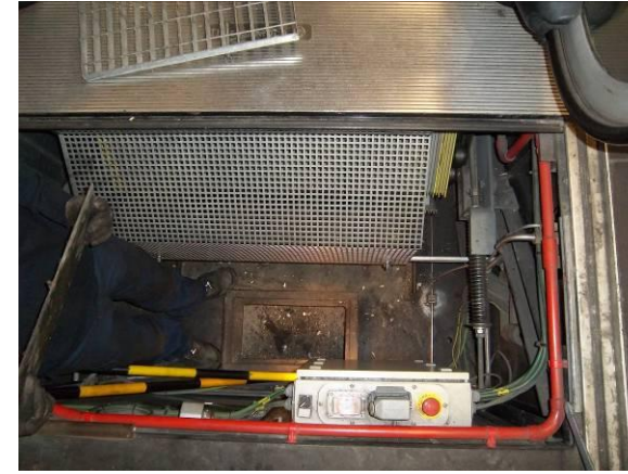
F-49. Escaleras n. intermedio-andén 2. Foso escalera mecanica nº 10, seco.
