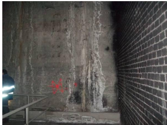
F-13. Nivel vestíbulo. Pantalla lateral derecha. Humedades en zona estrecha.
