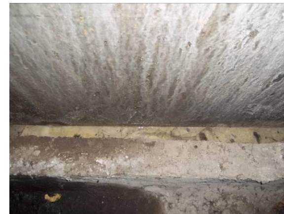
F-9. Foso ascensor acceso. Canaleta en paramento izquierdo con agua y sales.
