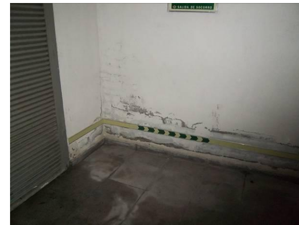
F-96. Salida de emergencia acceso al exterior. Humedad en tabiquería junto puerta de acceso a pozo ventilación.
