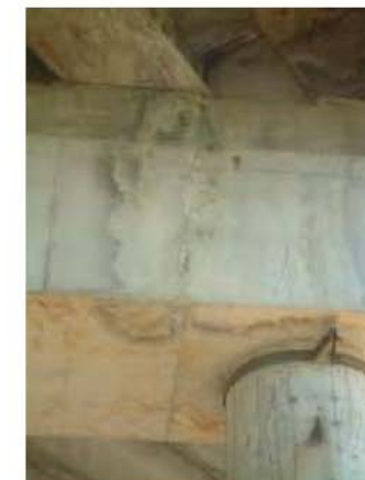
Fisuras/grietas, librería 9, en Elemento Cargadero del Componente P2 (Deterioro 57)
