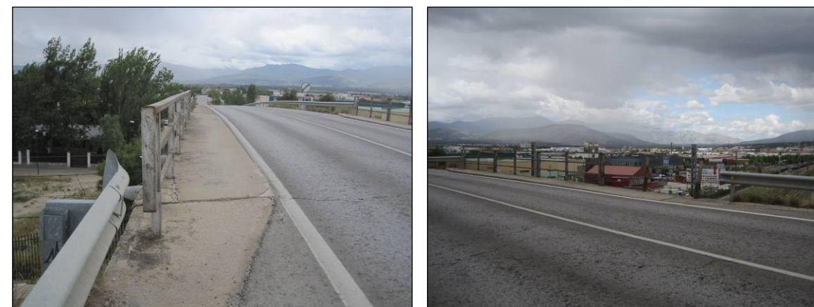
Figuras nº 21 y nº 22. Barandillas de protección en estructura del P.K. 2+300 de la M-510. (Fuente: Elaboración propia. Junio de 2013).
