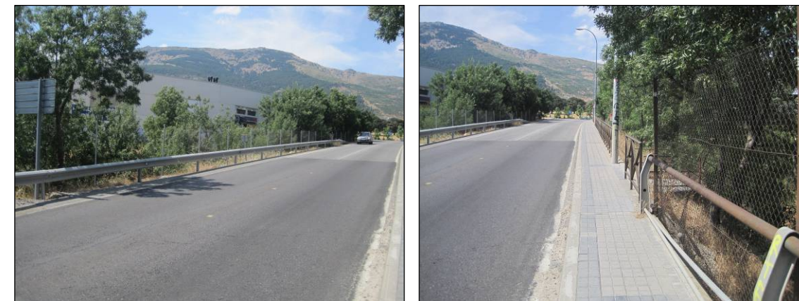
Figuras nº 32 y nº 33. Sistemas de contención en la zona previa de la estructura del P.K. 8+000 de la M-600. (Fuente: Elaboración propia. Julio de 2013).
