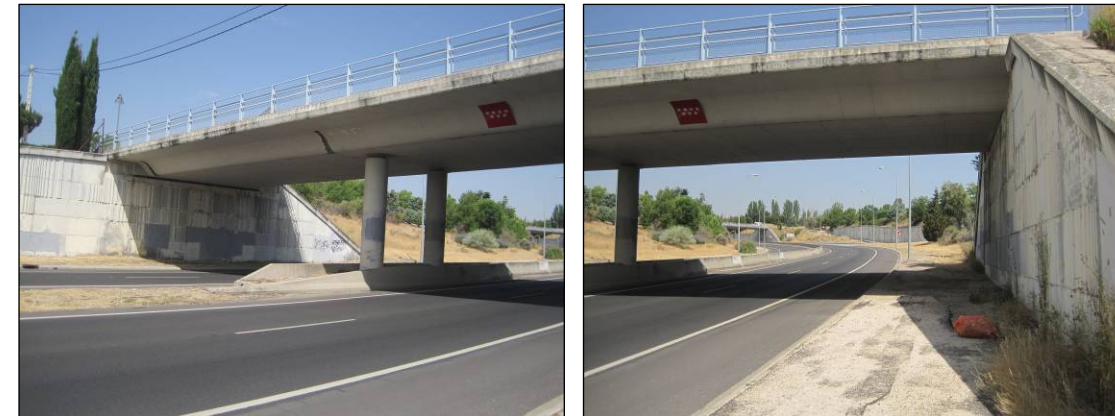
Figuras nº 5 y nº 6. Vista de ambos vanos de la estructura del paso superior de la Avda. de Rodajos. (Fuente: Elaboración propia. Julio de 2013).
