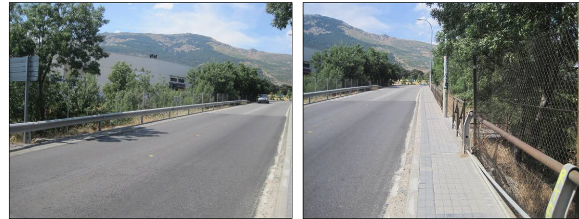
Figuras nº 30 y nº 31. Sistemas de contención en la zona previa de la estructura del P.K. 8+000 de la M-600. (Fuente: Elaboración propia. Julio de 2013).
