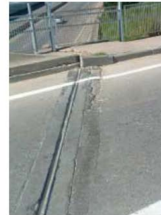
Fisuras/grietas/cuarreamiento en el aglomerado de los alrededores de la junta (cajeado), librería 2, en Elemento J. calz. perfil elas del Componente J1E1 (Deterioro 9)
