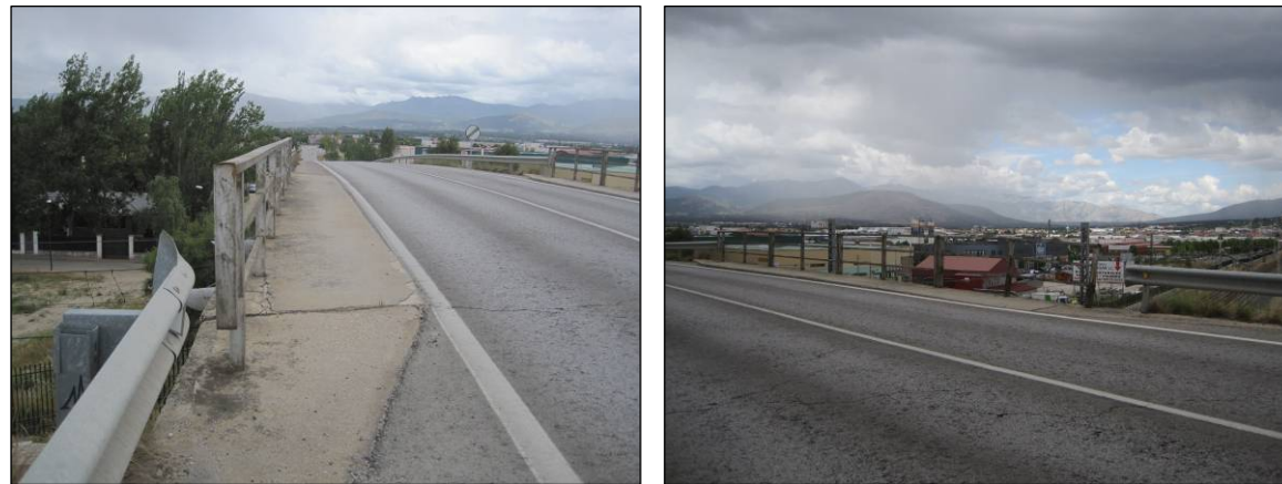
Figuras nº 31 y nº 32. Barandillas de protección en estructura del P.K. 2+300 de la M-510. (Fuente: Elaboración propia. Junio de 2013).
