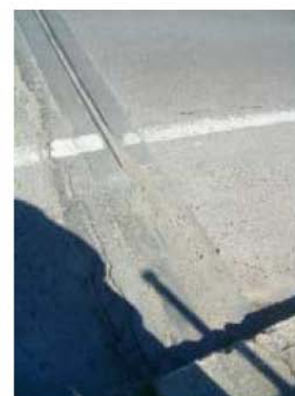
Movimiento impedido, librería 3, en Elemento J. calz. perfil elas del Componente J1E2 (Deterioro 16)
