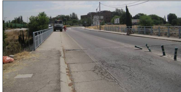
Figura nº 2. Vista de la calzada del paso superior de la Avda. de Rodajos. (Fuente: Elaboración propia. Julio de 2013).
