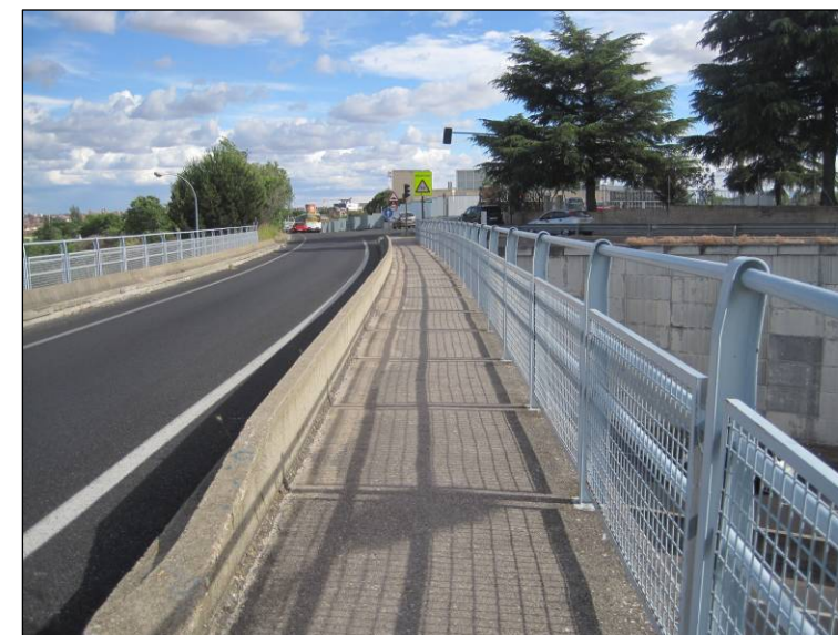
Figura nº 10. Vista de la calzada del paso superior de la M-508 P.K. 3+000. (Fuente: Elaboración propia. Junio de 2013).
