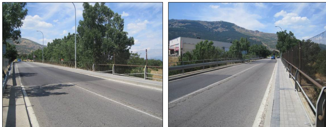
Figuras nº 30 y nº 31. Deterioros en los elementos de contención de la estructura del P.K. 8+000 de la M-600. (Fuente: Elaboración propia. Julio de 2013).
