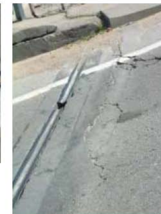
Fisuras/grietas/cuarreamiento en el aglomerado de los alrededores de la junta (cajeado), librería 2, en Elemento J. calz. perfil elas del Componente J1E2 (Deterioro 13)
