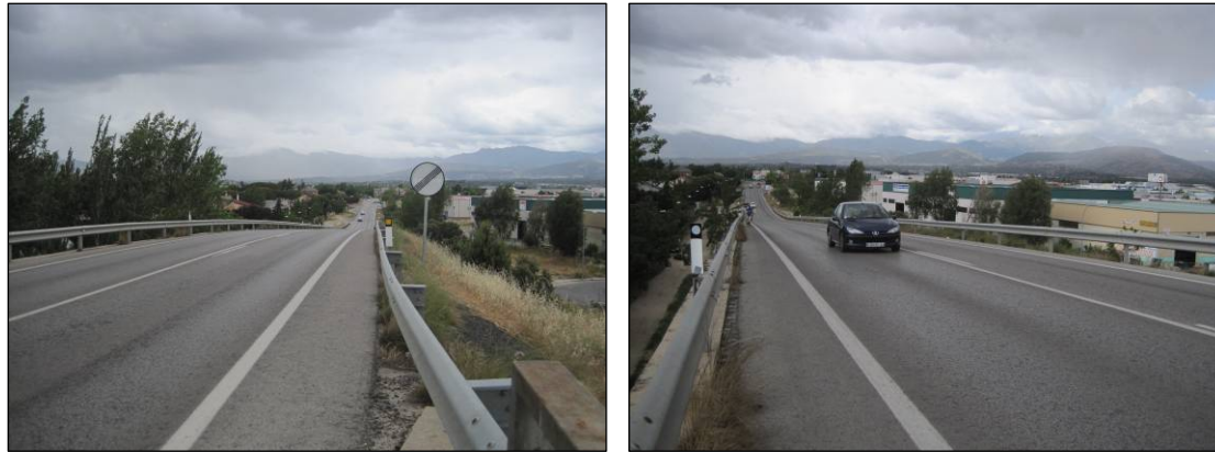
Figuras nº 20 y nº 21. Barreras metálicas de seguridad en el tramo posterior a la estructura del P.K. 2+300 de la M-510. (Fuente: Elaboración propia. Junio de 2013).
