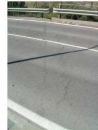
Fisuras, librería 29, en Elemento Pavimento asfáltico (Deterioro 83)
