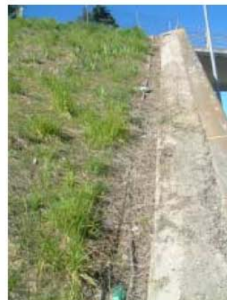
Elemento obstruido, librería 12, en Elemento Bajantes (Deterioro 31)
