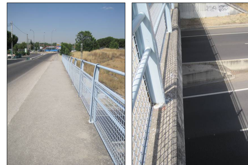
Figuras nº 6 y nº 7. Disposición de pretilles en estructura de la Avda. de Rodajos. (Fuente: Elaboración propia. Julio de 2013).
