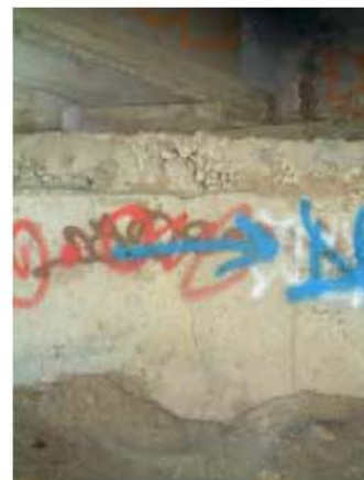
Fisuras/grietas, librería 3, en Elemento D cargad/V durmiente del Componente E2 (Deterioro 75)
