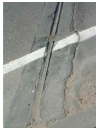
Movimiento impedido, librería 3, en Elemento J. calz. perfil elas del Componente J1E1 (Deterioro 8)
