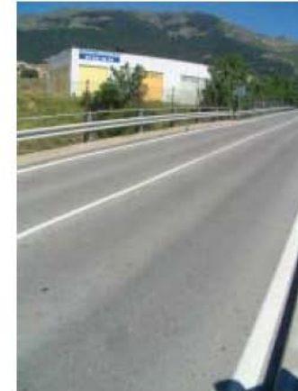
Fisuras, librería 2, en Elemento Pavimento asfáltico (Deterioro 81)
