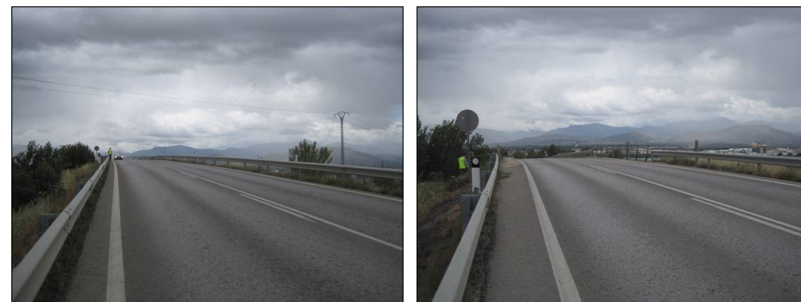
Figuras nº 33 y nº 34. Barreras metálicas de seguridad en el tramo de antelación a la estructura del P.K. 2+300 de la M-510. (Fuente: Elaboración propia. Junio de 2013).
