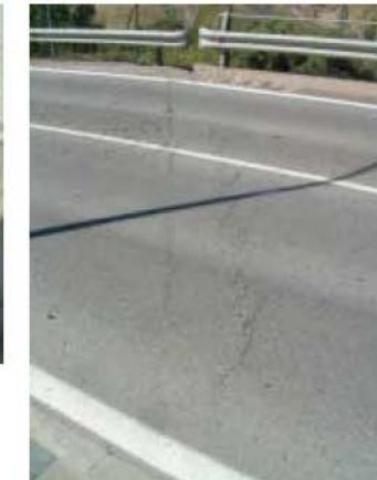
Movimiento impedido, librería 5, en Elemento J. calzada sin det. del Componente J1E2 (Deterioro 28)
