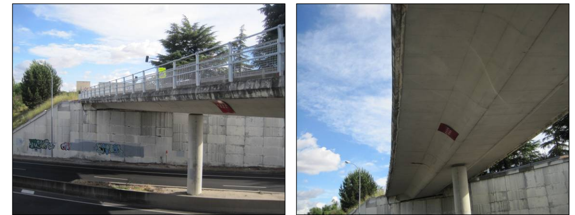
Figuras nº 17 y nº 18. Vistas del tablero del paso superior de la M-508 P.K. 3+000. (Fuente: Elaboración propia. Junio de 2013).
