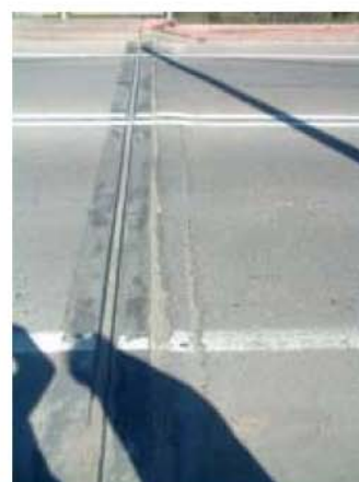
Fisuras/grietas/cuarreamiento en el aglomerado de los alrededores de la junta (cajeado), librería 2, en Elemento J. calz. perfil elas del Componente J1E1 (Deterioro 12)
