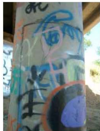
Fisuras/grietas, librería 13, en Elemento Fustes/célula/V del Componente P1 (Deterioro 42)
