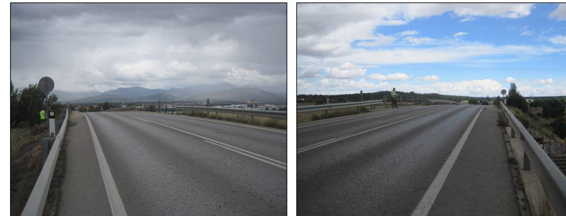
Figuras nº 19 y nº 20. Vista de la calzada de la estructura de la M-510 P.K. 2+300. (Fuente: Elaboración propia. Julio de 2013).
