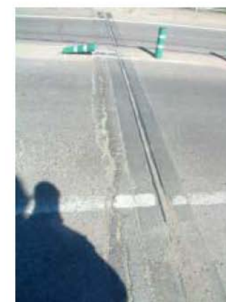
Fisuras/grietas/cuarreamiento en el aglomerado de los alrededores de la junta (cajeado), librería 2, en Elemento J. calz. perfil elas del Componente J1E2 (Deterioro 15)
