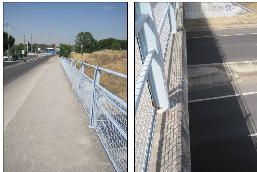
Figuras nº 4 y nº 5. Disposición de pretiles en estructura de la Avda. de Rodajos. (Fuente: Elaboración propia. Julio de 2013).
