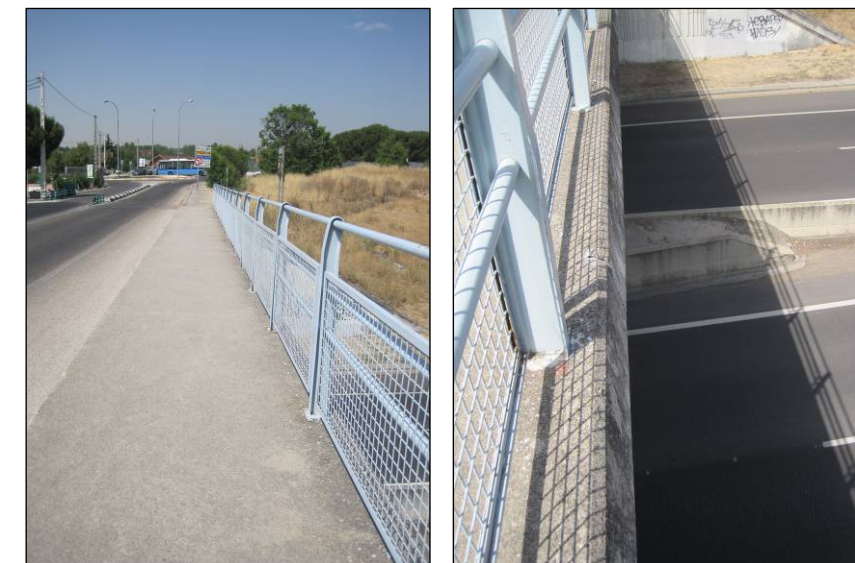
Figuras nº 10 y nº 11. Disposición de pretiles en estructura de la Avda. de Rodajos. (Fuente: Elaboración propia. Julio de 2013).
