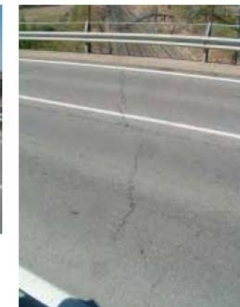
Movimiento impedido, librería 5, en Elemento J. calzada sin det. del Componente J1P2 (Deterioro 32)
