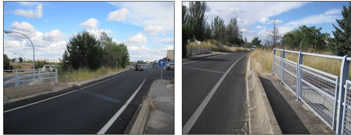
Figuras nº 12 y nº 13. Sistemas de contención en aproximación lado Prado del Rey (izquierda) y lado Húmera (derecha). (Fuente: Elaboración propia. Junio de 2013).
