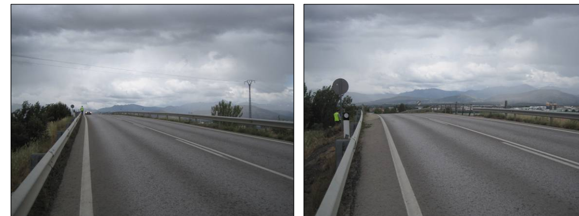
Figuras nº 18 y nº 19. Barreras metálicas de seguridad en el tramo de antelación a la estructura del P.K. 2+300 de la M-510. (Fuente: Elaboración propia. Junio de 2013).
