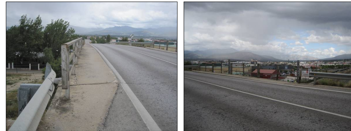
Figuras nº 16 y nº 17. Barandillas de protección en estructura del P.K. 2+300 de la M-510. (Fuente: Elaboración propia. Junio de 2013).
