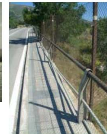
Rotura, librería 0, en Elemento Barandillas (Deterioro 78)
