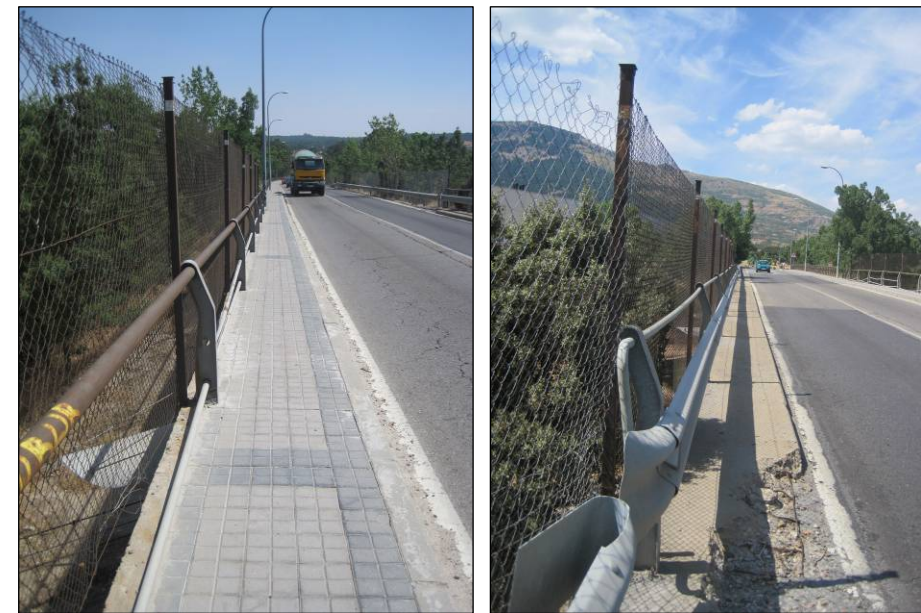
Figuras nº 51 y nº 52. Vistas de la valla antivandálica en bordes de la estructura del P.K. 8+000 de la M-600. (Fuente: Elaboración propia. Julio de 2013).
