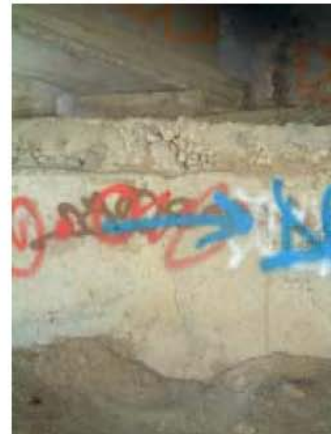
Degradación superficial, librería 3, en Elemento D cargad/V durmiente del Componente E2 (Deterioro 72)
