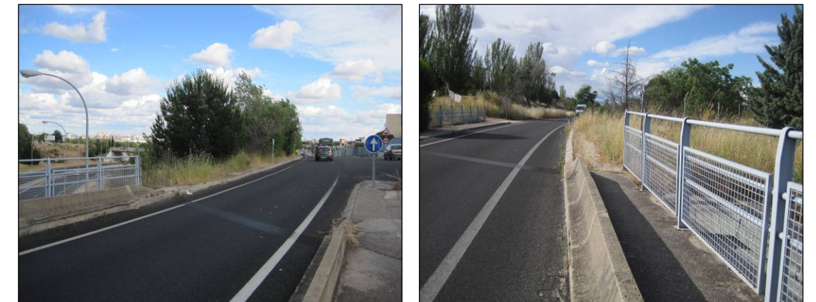
Figuras nº 14 y nº 15. Sistemas de contención en aproximación lado Prado del Rey (izquierda) y lado Húmera (derecha). (Fuente: Elaboración propia. Junio de 2013).
