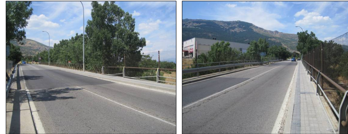
Figuras nº 49 y nº 50. Deterioros en los elementos de contención de la estructura del P.K. 8+000 de la M-600. (Fuente: Elaboración propia. Julio de 2013).
