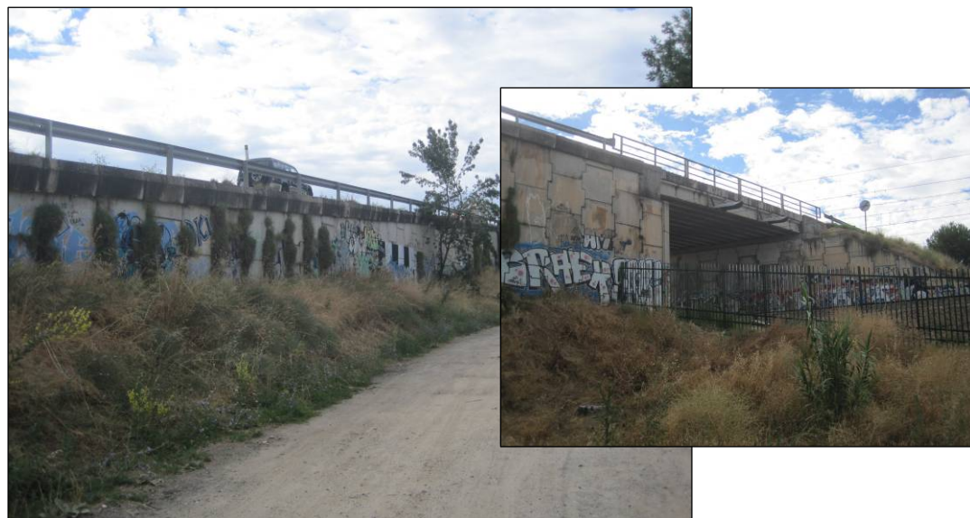
Figuras nº 22 y nº 23. Muro de tierra armada en terraplén lado Guadarrama de la estructura del P.K. 2+300 de la M-510. (Fuente: Elaboración propia. Junio de 2013).
