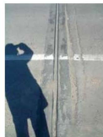
Movimiento impedido, librería 3, en Elemento J. calz. perfil elas del Componente J1E1 (Deterioro 13)
