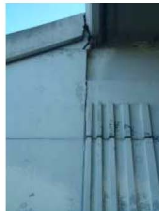
Fisuras/grietas, librería 2, en Elemento M.F tierra reforzada del Componente E1 (Deterioro 23)
