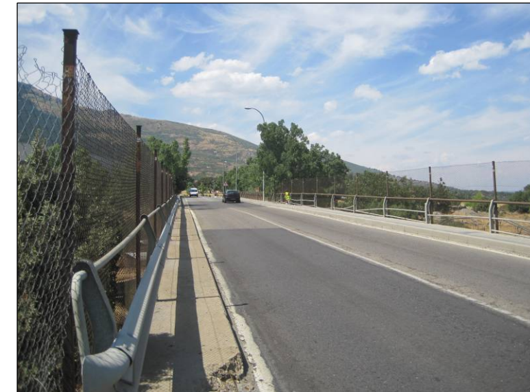
Figura nº 24. Sistemas de contención en estructura de la M-600 (P.K. 8+000). (Fuente: Elaboración propia. Julio de 2013).
