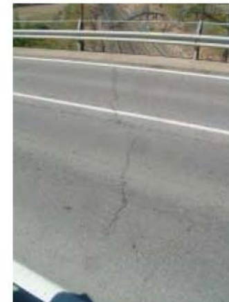
Fisuras, librería 29, en Elemento Pavimento asfáltico (Deterioro 83)
