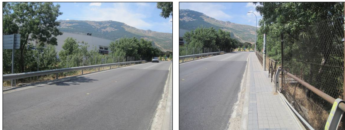
Figuras nº 54 y nº 55. Sistemas de contención en la zona previa de la estructura del P.K. 8+000 de la M-600. (Fuente: Elaboración propia. Julio de 2013).
