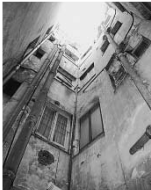
Estado inicial del patio interior
